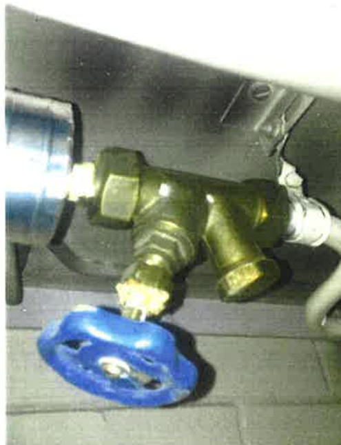
Käyttövedessä paikoin korroosioita, kuntotutkimus ja venttiilien uusintoja
