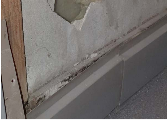
Kuva 4. Tuulensuojakivilevy 3 mm IV-konehuone, näyte 1.
