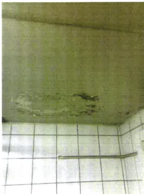
Pyykkituvan katossa maali hilseilee
