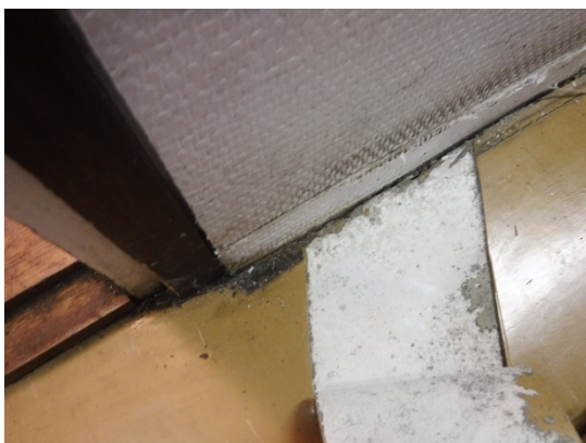
Kuva 16. Muovimatto, liima ja tasoite, toimistotilat, näyte 13.
