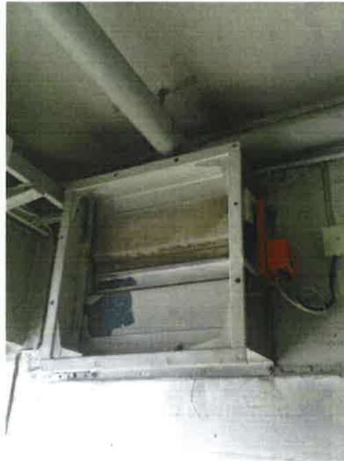
Kompressorin korvausilmassa ei ole suodatinta
