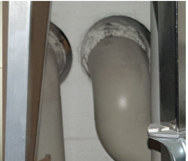
Kuvat 3.1.4 Osa asbestipitoisista putkieristeistä on poistettu. Paikoin asbestipitoisia materiaaleja todettiin myös Genopakilla päällystettyjen putkien läpiviennissä.
