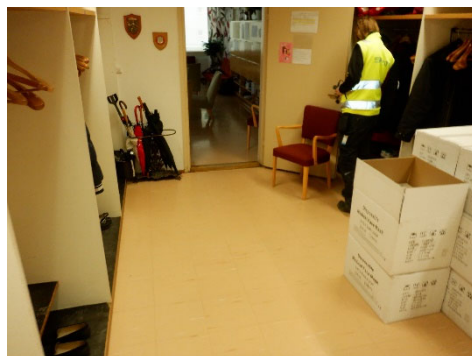
Kuva 3.2.5 1. krs. lattiaan vaalea kvartsivinyylilaatta. Näyte ASB 14 kvartsivinyylilaatasta, mustasta liimasta ja tasoitteesta, kansliatilasta. Mustassa liimassa on asbestia (antofylliitti).
