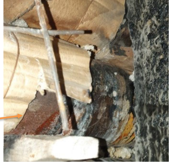
Kuvat 3.1.6 Rakenteissa kulkee aaltopahvilla päällystettyjä vesiputkia. Aaltopahvin ja vesiputken välissä on asbestia sisältävää vaaleaa eristettä.
