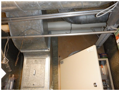
Kuva 4.4.1. IV-kanavien tiivistepunokset saattavat sisältää asbestia, kuva kellarikerroksen IV-konehuoneesta.
