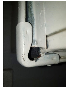
Kuva 4.4.2. IV-kanavatiiviste kellarin varastotilassa solukumia.
