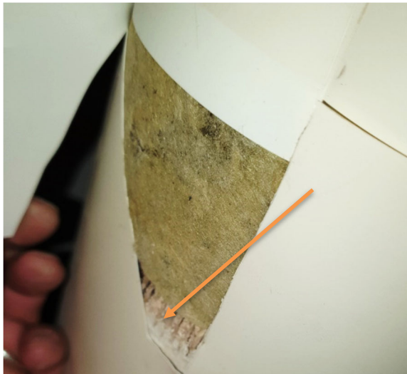
Kuvat 3.1.3 Osa asbestipitoisista putkieristeistä on poistettu. Paikoin asbestipitoisia materiaaleja todettiin myös Genopakilla päällystetyissä putkissa.
