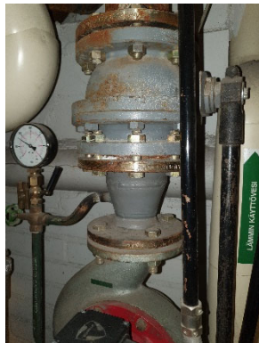
Kuva 4.4.3. Lämmönjakuhuoneen putken laippaliitos saattaa sisältää asbestia.
