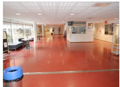
Kuva 3.2.6 1. krs. lattiaan punainen kvartsivinyylilaatta. Näyte ASB 25 kvartsivinyylilaatasta ja mustasta liimasta, aulatilasta. Mustassa liimassa on asbestia (antofylliitti).
