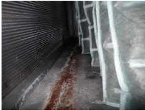
Kuva 7.1.9. Tuloilmakoneen TK4 pohjalla oli merkkejä veden päästystä kammion pohjalle.
