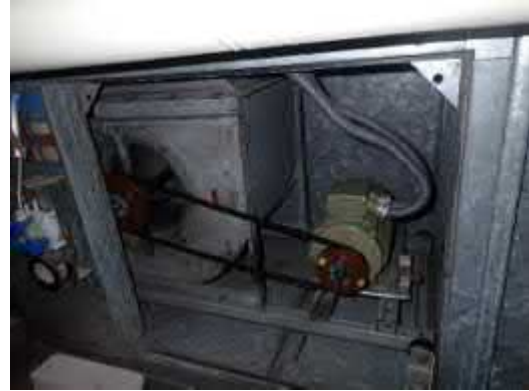
Kuva 7.1.2. Tuloilmakone TK1 oli melko puhdas.
