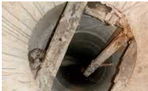
Kuva 6.1.11. Salaojien tarkastuskaivoissa vaurioitunutta puutavaraa.
