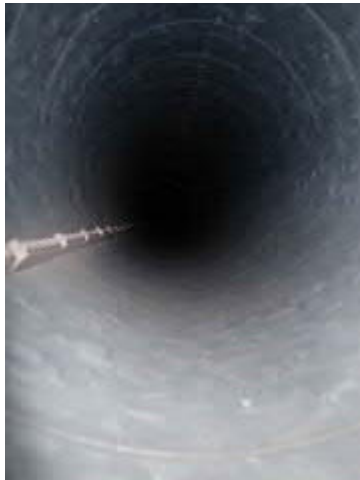
Kuva 7.1.3. Tuloilmakanavistossakaan (tila 007) ei ollut merkittävästi pölyä.
