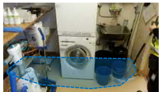
Kuva 5.3.7. Kosteuspoikkeama-alue siivouskeskuksen lattian märkätilamuovimatossa. Poikkeama-arvot 90-100, vertailuarvot 50-60.
