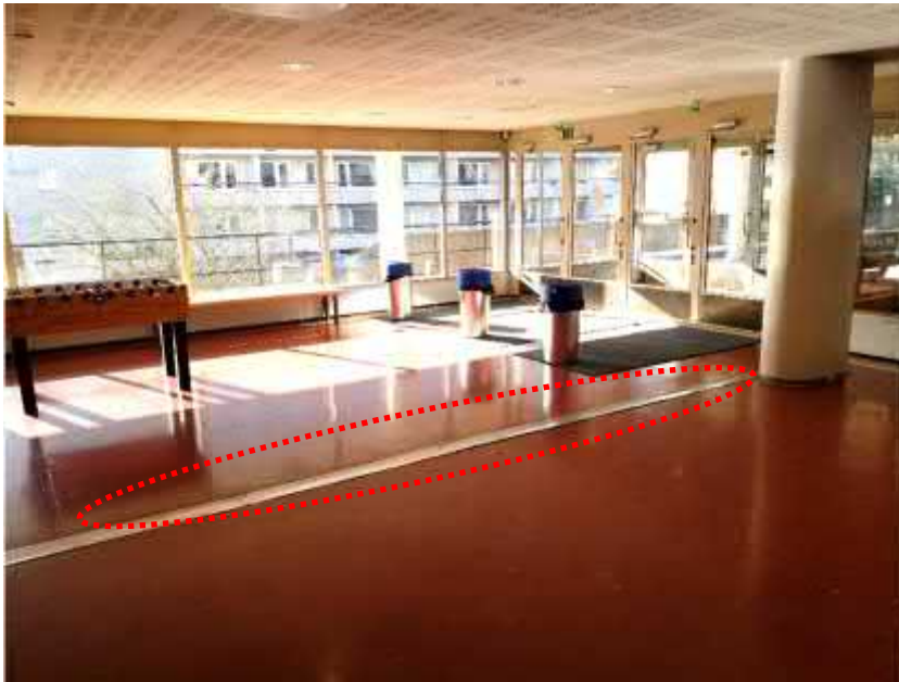
Kuva 6.6.15. Putkitunnelista on merkittävää ilmavuotoa liikuntasaumasta sisääntuloaulaan.
