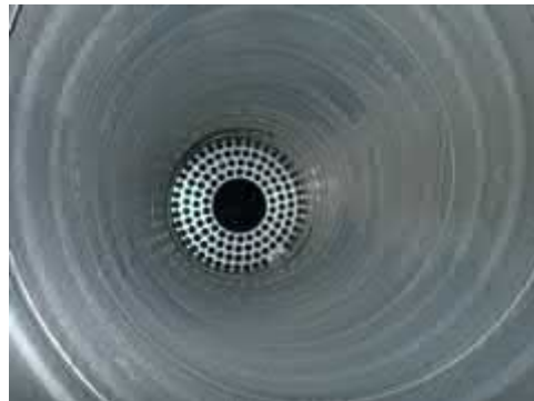
Kuva 7.1.15 Tuloilmakanavistossa (tila 311) ei ollut merkittävästi pölyä.
