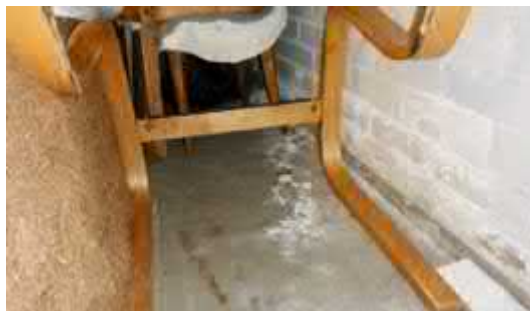
Kuva 5.1.4. Paikallista pinnoitteen kosteusvaurioitumista lattiassa ja perusmuurin sisäpinnassa.
