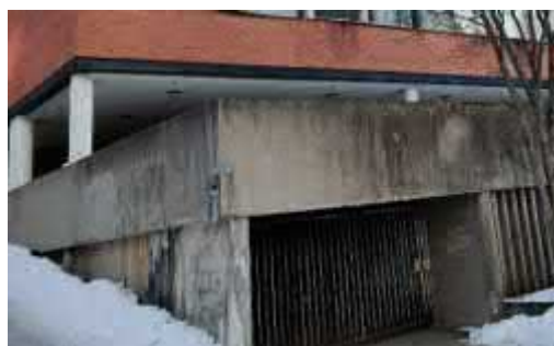
Kuva 6.1.16. Betonimuurin rapautumista autohallin lounaispäädyssä
