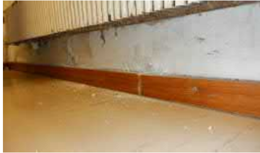
Kuva 5.3.8. Tyttöjen pukuhuoneen maanpaine-seinän sisäpinnan alaosassa vanhoja kosteusvauriojälkiä (ei pintakosteuspikkeamaa).
