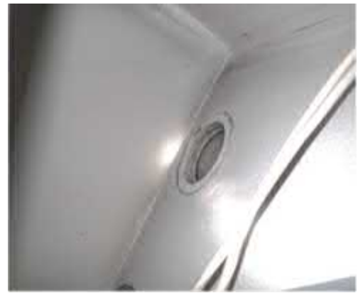
Kuva 7.2.7 Luokan 311 alakaton yläpuolisessa tilassa havaittiin vanha tulppaamaton kanavan pää, joka voi vaikuttaa tilan painesuhteisiin.
