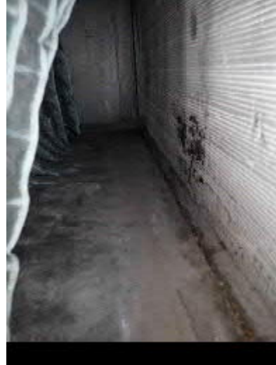
Kuva 7.1.5. Tuloilmakoneessa TK2 oli jonkin verran likaa.
