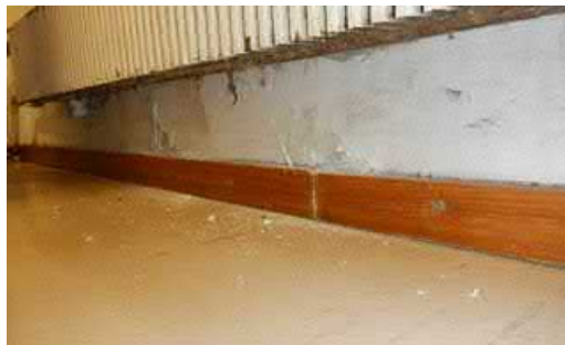
Kuva 6.1.25. Maanpaineseinän alaosan sisäverhousmuurauksessa oli vanhoja kosteusvauriojälkiä, tyttöjen pukuhuonetila.
