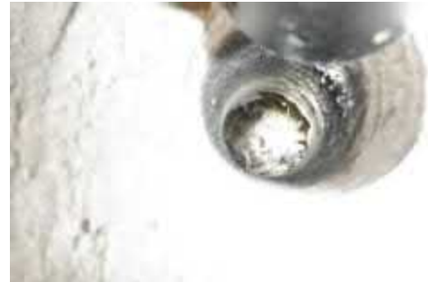
Kuva 6.1.8. AP-rakenteessa oli sementtilastuvillalevy-eriste, jonka materiaalinäytteessä todettiin mikrobivaurioitumista.
