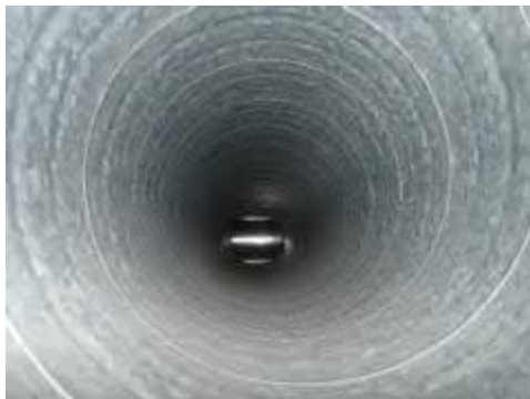
Kuva 7.1.11. Tuloilmakanavistossakaan (tila 302) ei ollut merkittävästi pölyä.
