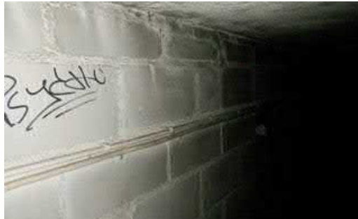
Kuva 6.6.12. Ilmavuotojälkiä sisäverhoukseen muurauksen takan olevasta eristetilasta.
