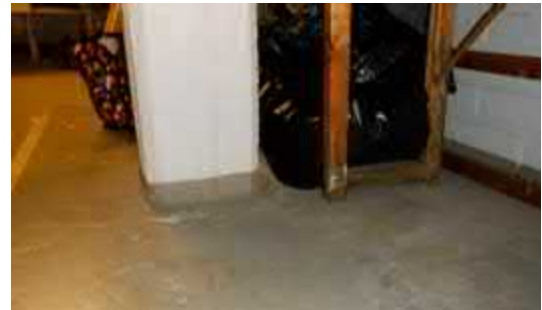
Kuva 5.1.3. Alemman kellarikerroksen lattiamaalit olivat kuluneita. Rakennepinnoilla ei yleisesti ottaen ollut liiallisen kosteuden aiheuttamia pinnoitevauriota.
