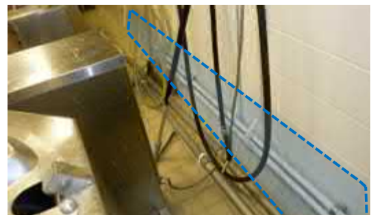
Kuva 5.3.3. Keittiötilan seinässä (tyttöjen WC-tilan vastainen laatoitettu kiviseinä) pintakosteuspoikkeamaa.
