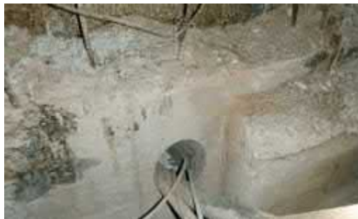
Kuva 6.6.4. Onkalotilassa kellarikerroksen perusmuurin yläosa, epätiivitä tekniikkaläpivientejä kellarikerroksen suuntaan.
