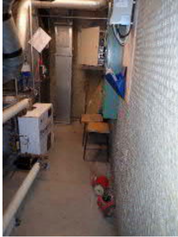
Kuva 7.1.1. Konehuoneen 002 seinillä on kanaverkon takana paljasta mineraalivillaa.
