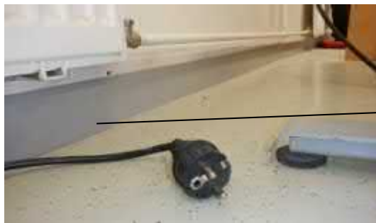
Kuva 5.2.8. Metallityöluokassa muovinen JL-jalkalista oli liimattu seinän sisäverhouskivilevyn pintaan asennettuun lautaan.
