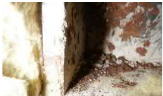
Kuva 6.1.14. I-profiilipilarin lattialiittymässä ei havaittu epätiiveyttä/rakenteellisia vauriota. Teräspilarin alaosassa pintaruostetta.
