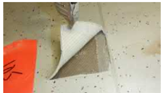
Kuva 5.2.5. Mittauspisteessä V1 maton liimakerros oli aistinvaraisesti tarkastellen vaurioitunut (tummentunut, pehmenyt, pistävä haju).
