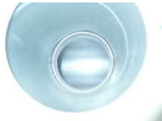
Kuva 7.1.21. Tuloilmakanavistossa (tila 141) ei ollut merkittävästi pölyä.
