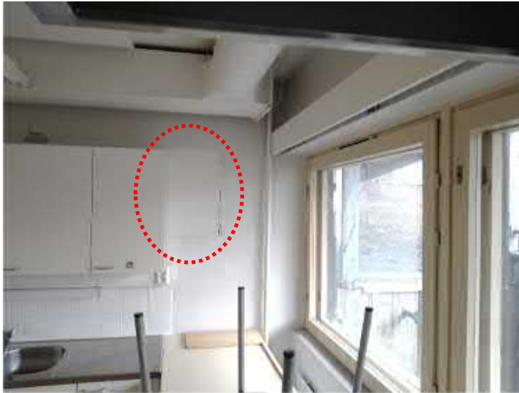
Kuva 6.2.7. Kotitalousluokan (205) päätyseinässä on vanha ummistettu ikkuna-aukko, jonka liittymästä on merkittäviä ilmavuotoja.
