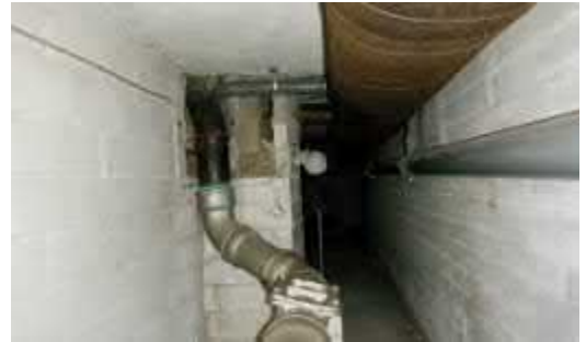
Kuva 6.6.13. Putkitunnelissa on paikoin näkyvissä ulkoseinän eristetila ja epätiivitä rakenneläpivientejä.
