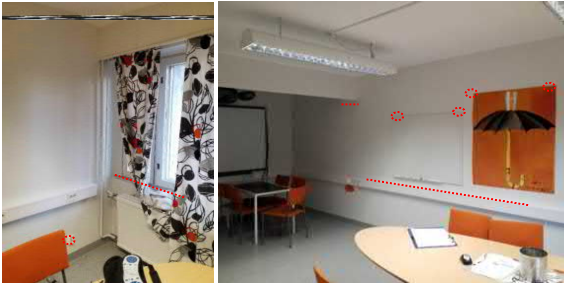
Kuva 6.1.27. Ilmavuotoa tilassa 141 (OH) ikkunaliittymistä ja maanvastaisen seinän sisäverhouslevyn liittymistä ja läpivienneistä.
