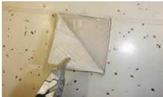
Kuva 5.2.6. Viiltomittauspiste V2, ei poikkeavaa maton liimakerroksessa.
