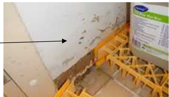
Kuva 5.3.5. Siivouskomeron puolella maalatussa kipsilevyseinässä kosteusvauriota.
