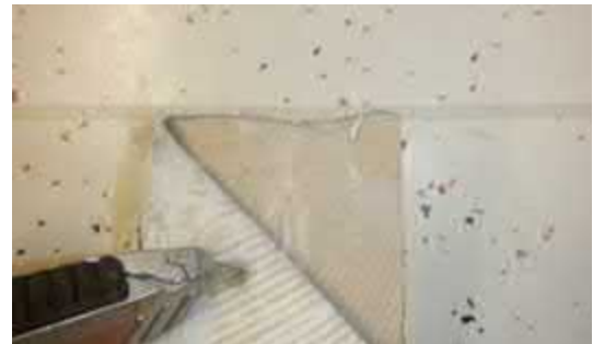
Kuva 5.2.7. Viiltomittauspiste V3, ei poikkeavaa maton liimakerroksessa.
