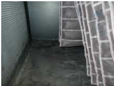
Kuva 7.1.7. Tuloilmakoneen TK3 pohjalla oli pinttynyttä likaa ja merkkejä veden pääsystä kammion pohjalle.
