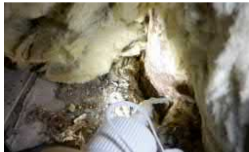
Kuva 6.6.8. Merkkisavulla tarkastellen putkikanaali oli alipaineinen luokkatilan suuntaan.
