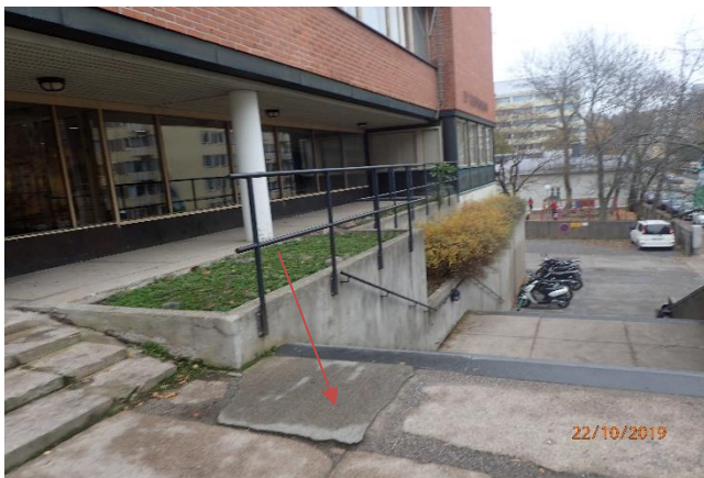
Portaiden yläosassa kompastumisvaara.
