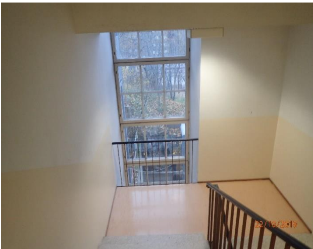
Portaikot ovat tyydyttävässä kunnossa.
