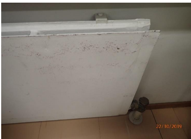
Lämmityspatterit ovat välttävässä kunnossa.
