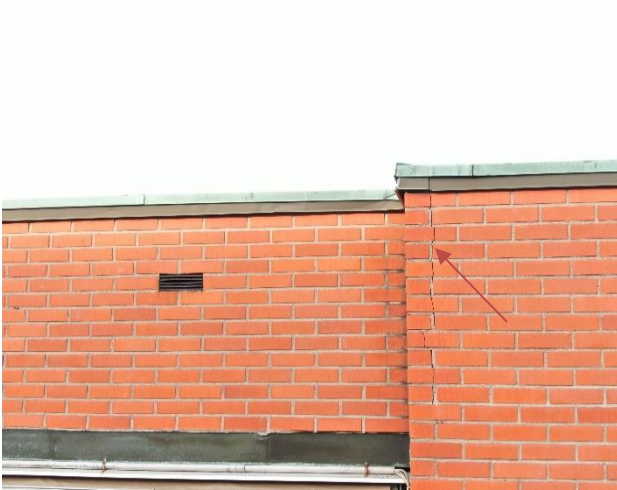
Tiilijulkisivussa on halkeama.
