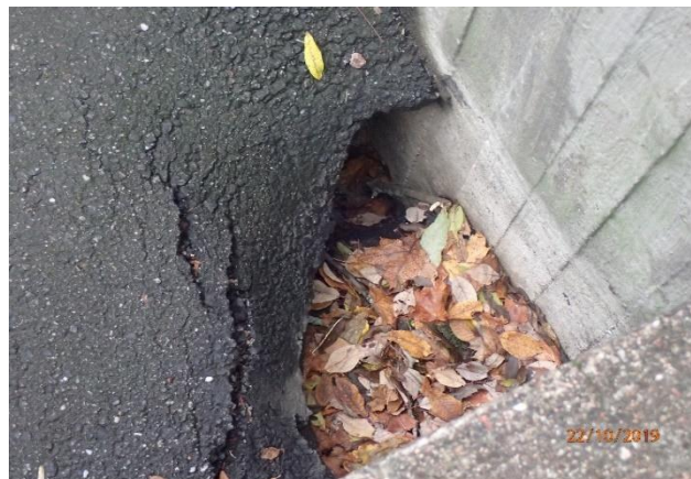
Rakennuksen itäpuolella on veden aiheuttamaa maan eroosiota.
