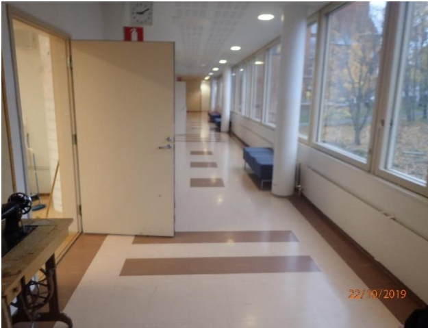
Käytävät ovat tyydyttävässä kunnossa.
