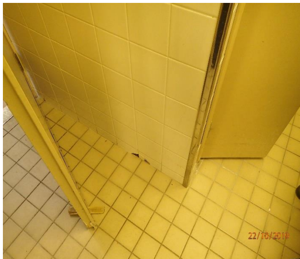
Seinän alaosassa on reikä.
