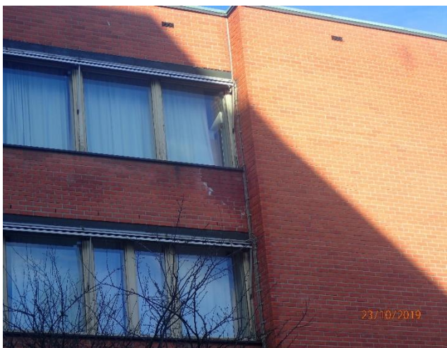
Luostarinkadun puoleinen kosteusjälki.
