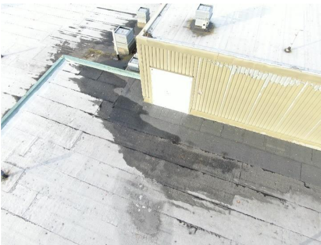
Vesikatolla saattaa esiintyä lämpövuotoa.
