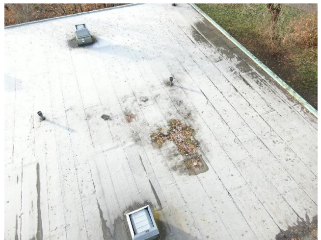
Puiden lehtiä on kattokaivojen ympärillä.
