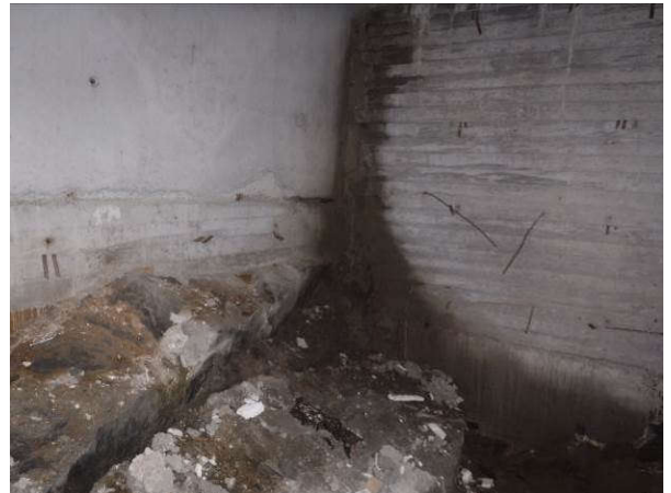
Rakentamattomaan tilaan tulee vettä ulkonurkan kohdalta
