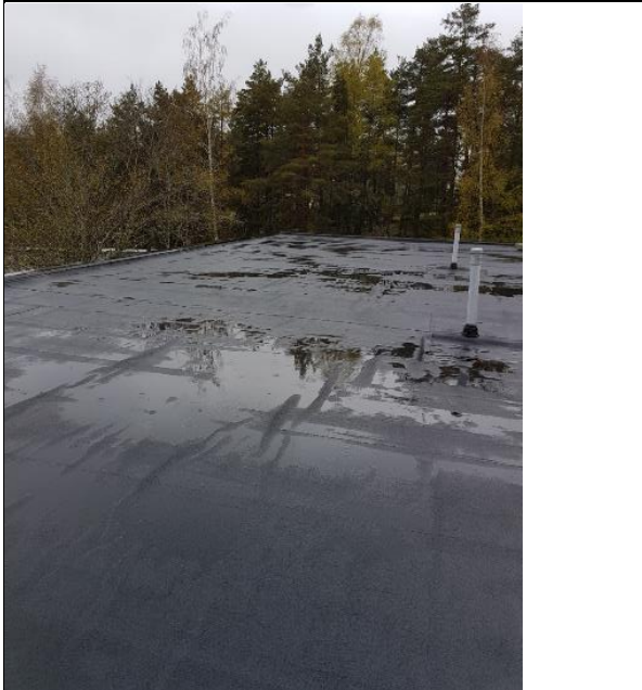
Kuva 5.55. Luokkasiiven vesikatolle lammikoituu vettä.
