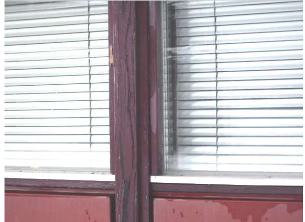
Ikkunoiden ulkopuolisissa karmirakenteissa ja listoituksissa on säärasituksesta johtuvaa puun halkeilua ja maalipinnan hilseilyä. Ikkunoiden liittymät eivät ole kaikilta osin tiiviit
