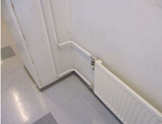
Lämpöjohdot ovat perinteisiä teräsputkiasennuksia
