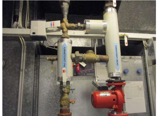
Toimilaitteet ovat osin alkuperäisasennuksia
