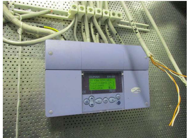
Ilmanvaihtokoneiden paikallissäätimet on ilmeisesti liitetty DDC-rakennusautomaation piiriin
