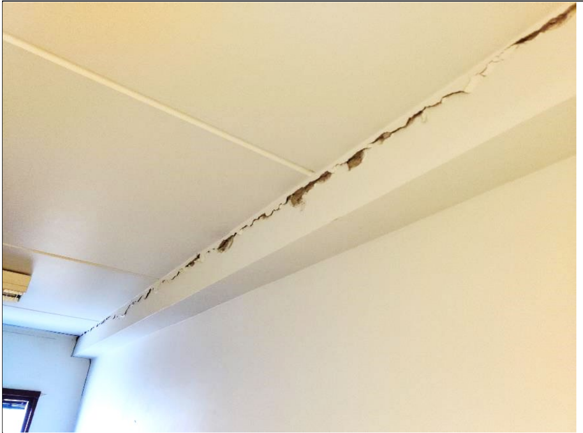
Kuva 5.62. Nivelosan ja luokkasiiven liittymässä (liikuntavälinevarastossa) on laaja halkeama.
