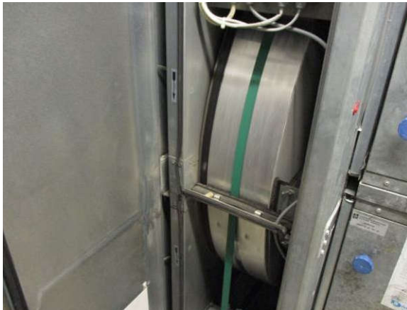
Ilmanvaihtokoneissa on pyörivät LTO-roottorit
