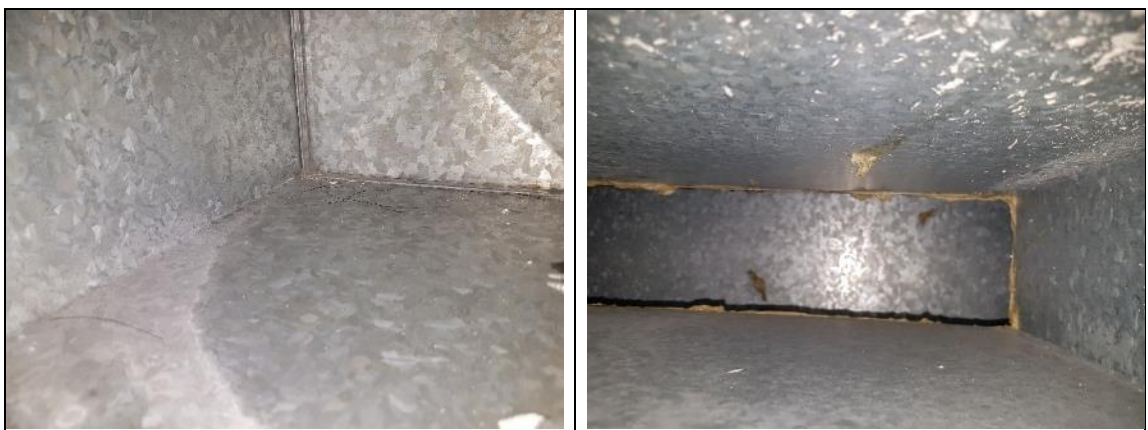
Kuva 5.78. Tuloilmakanavan pohjalla todettiin sekä irtolikaa että pinttynyttä likaa.
