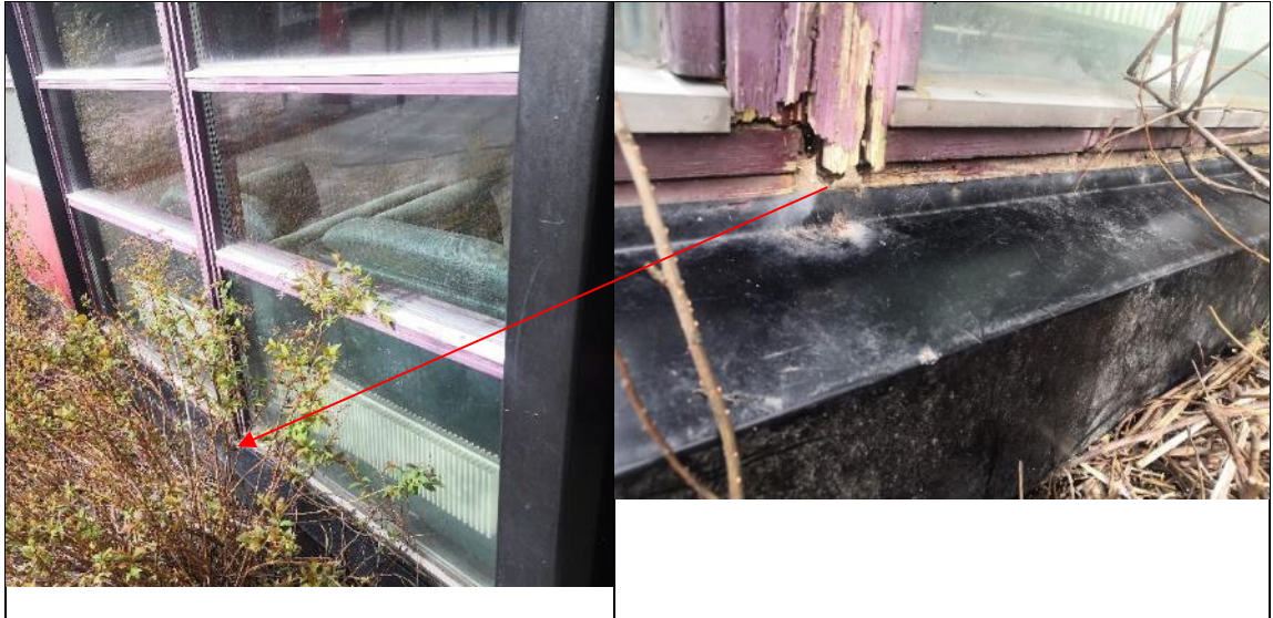
Kuva 5.43. Itäsivulla maanpinnan lähellä olevissa ikkunakarmeissa on lahovaurioita.
