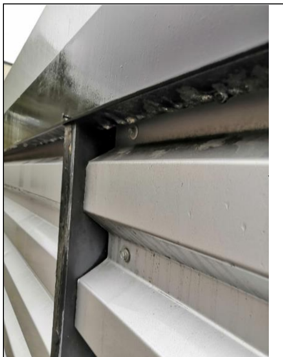
Kuva 5.57. Luokkasiiven pitkällä sivulla sadevedet ohjautuvat räystäältä julkisivuja päin. Vettä pääsee myös julkisivun peltiprofiiliin ja pystyvuun väliin.
