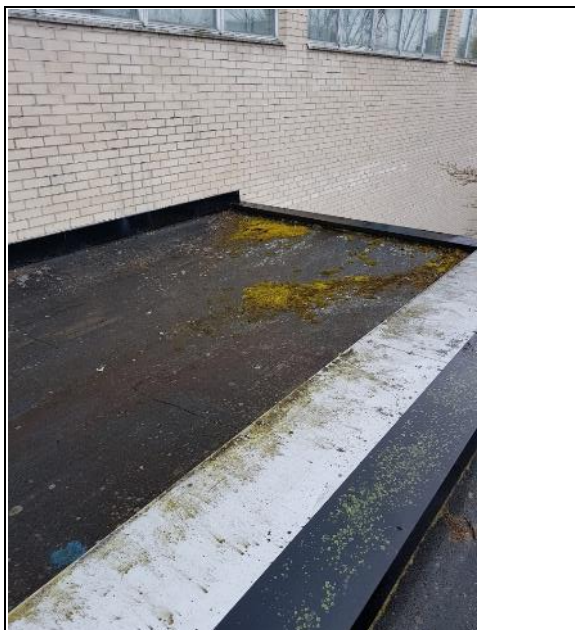
Kuva 5.59. Nivelosan vesikatolle on kertynyt sammalta
