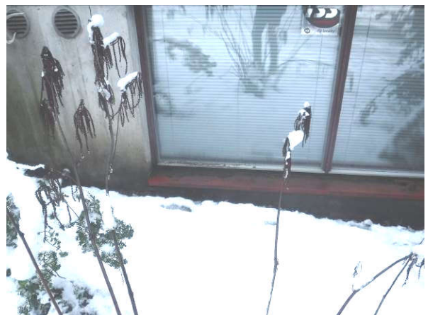
Maanpinta on lähellä ikkunan alareunaa
