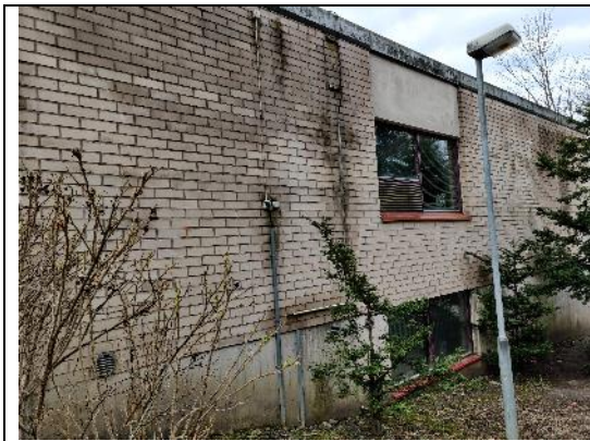
Kuva 5.6. Pohjoissivun tiilijulkisivussa on kosteusrasituksen jälkiä.
