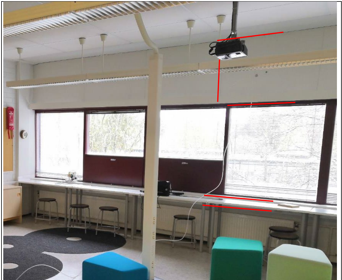
Kuva 5.41. Merkittävää ilmavuotoa ikkunaliittymistä, sähkökourun takaa, ulkoseinän ja yläpohjan liittymästä sekä lujalevyn saumoista/halkeamista (tila 112).
