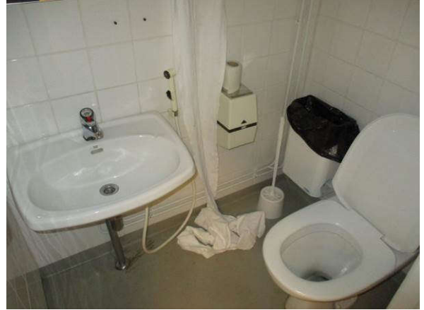
Vesi- ja viemärikalustusta
