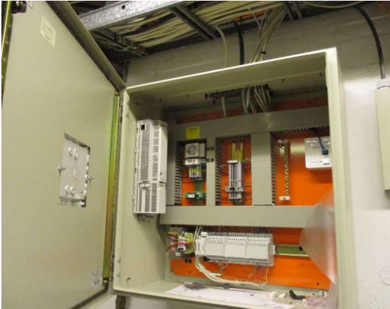
VAK-kaappi lämmönjakuhuoneen seinällä
