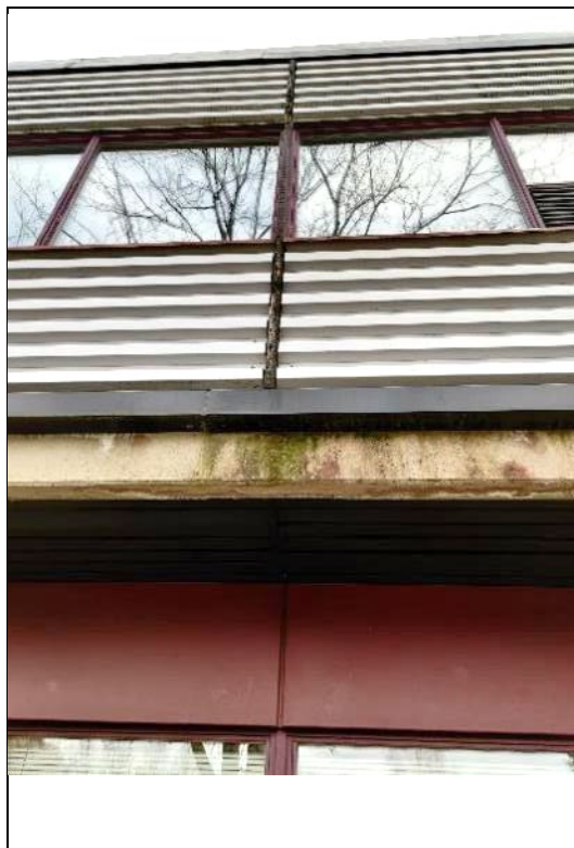
Kuva 5.8. Luokkasiiven pitkällä julkisivulla on kosteusrasituksen jälkiä.
