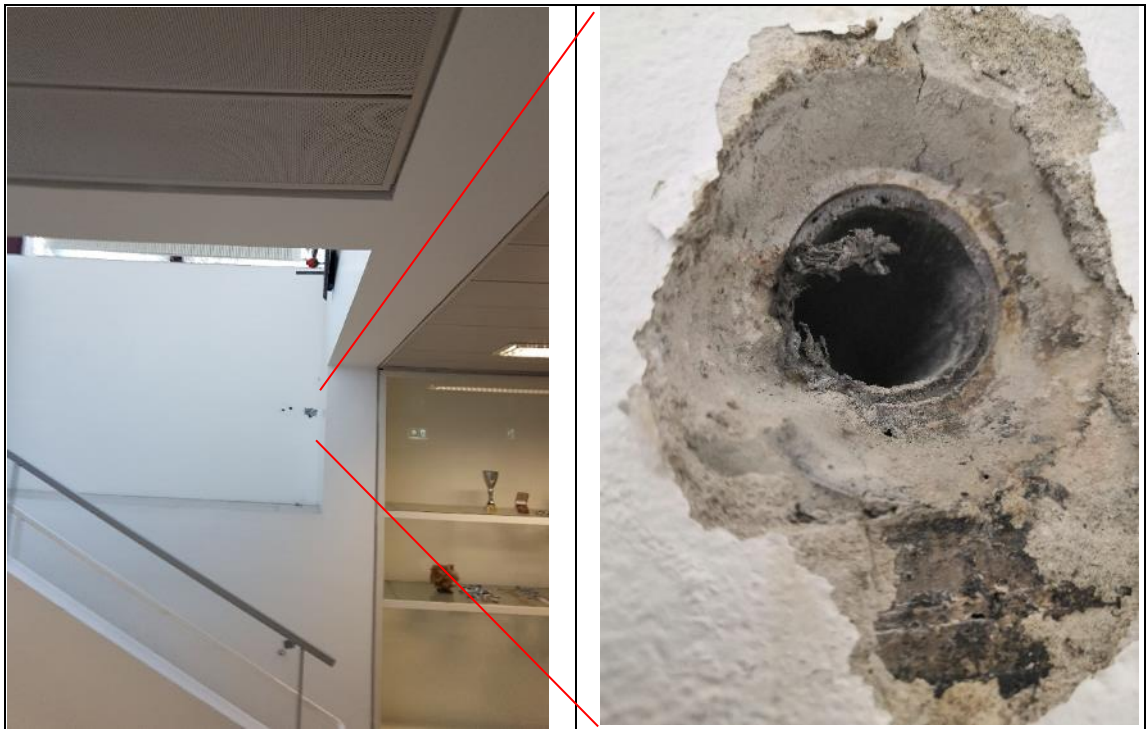
Kuva 5.26. Aulan 038 maanvastaisessa seinässä on paikallinen kosteusjälki, joka on syntynyt maaperään saakka ulottuvan läpiviennin kautta kulkeutuneesta vedestä.
