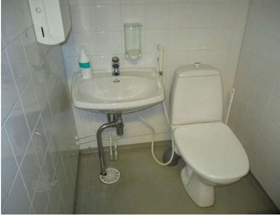
Vesi- ja viemärikalustusta
