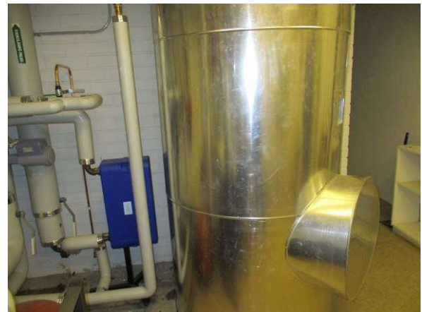
Käyttövesisiirrin on uusi ja lämminkäyttövesivaraaja alkuperäinen
