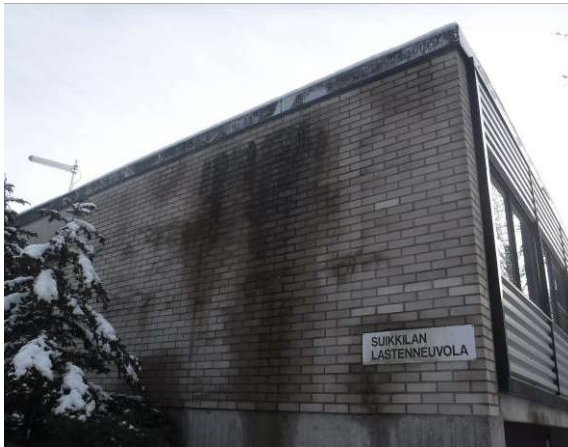
Suojapelliltä valuu sadevesiä julkisivulle. Riskinä kosteusvaurion syntyminen ulkoseinän sisälle. Rakennuksessa ei ole räystäitä, jotka suojaisivat ulkoseiniä
