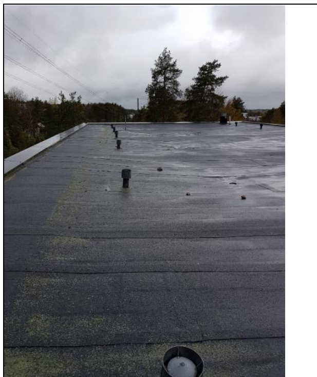
Kuva 5.60. Liikuntasalin vesikatto näyttää aistinvaraisesti toimivalta. Yläpohjan tuuletus on toteutettu alipainetuulettimilla.
