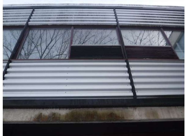
Betonirakenteeseen kohdistuu ylimääräinen kosteusrasitus ylhäältä valuvista sadevesistä
