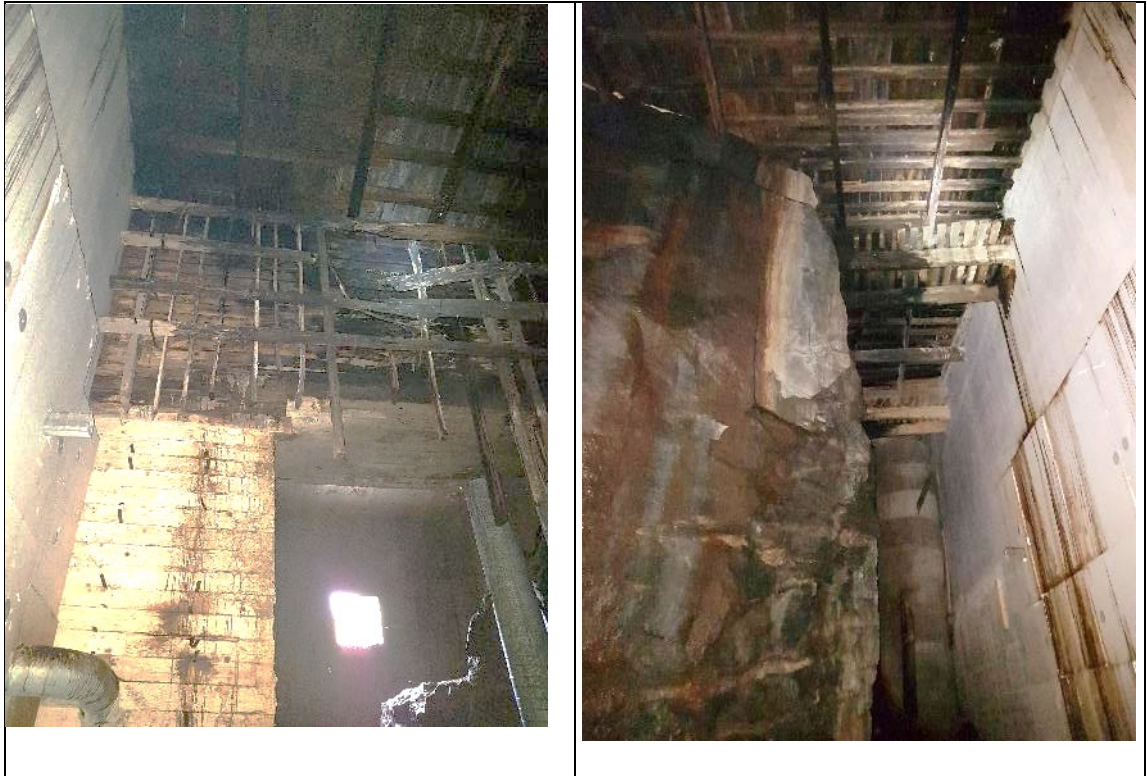
Kuva 5.20. Sulkutilassa on lahonneita muottilaudoituksia.
