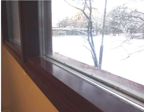
Ikkunoissa on lämpölaselementit
