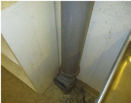
Viemärit ovat muovia
