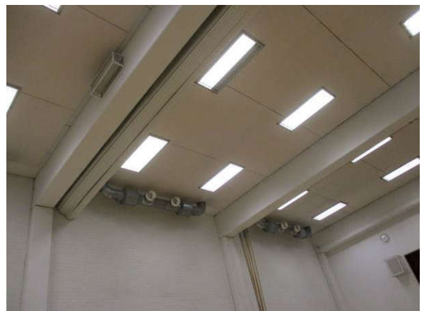
Ilmanvaihtolaitteita liikuntasalin katon rajassa
