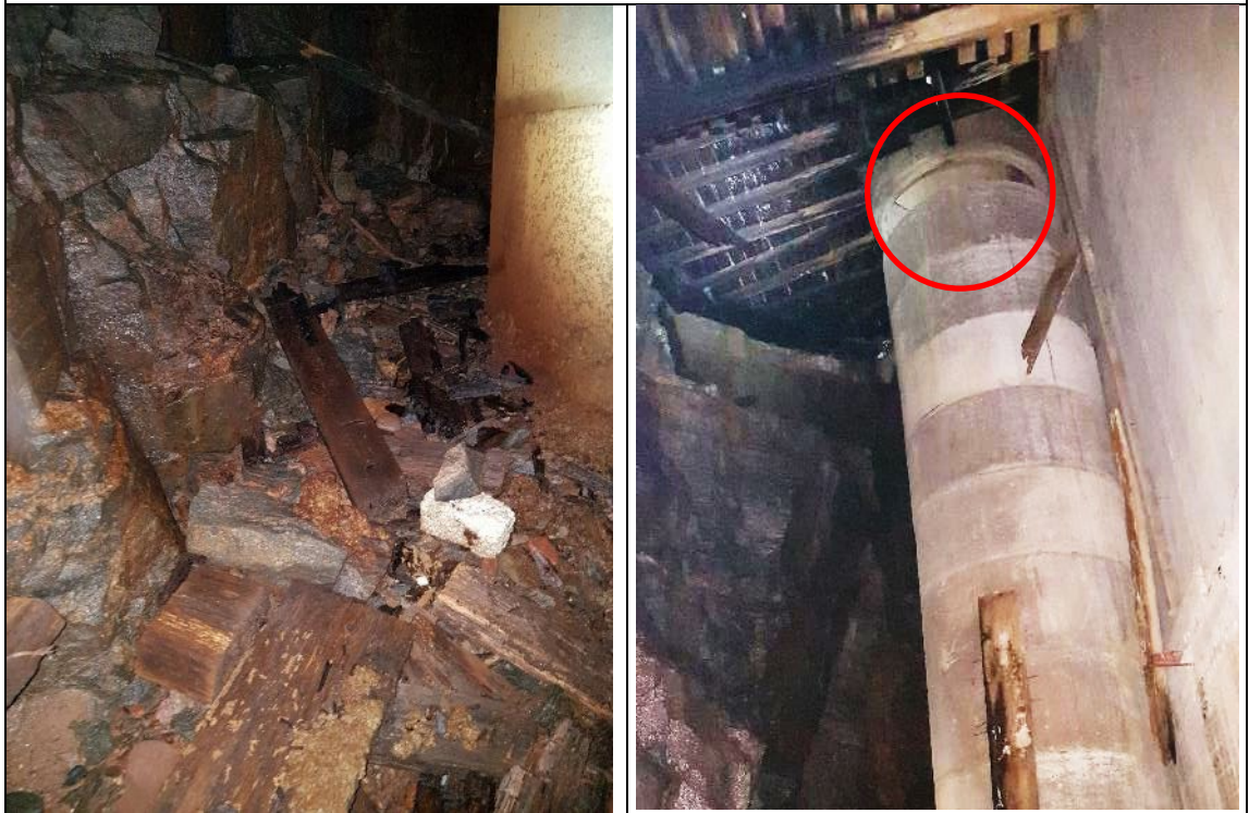
Kuva 5.21. Sulkutilan pohjalla on paikon sadevettä. Sadevesikaivo on yläosasta poikki.
