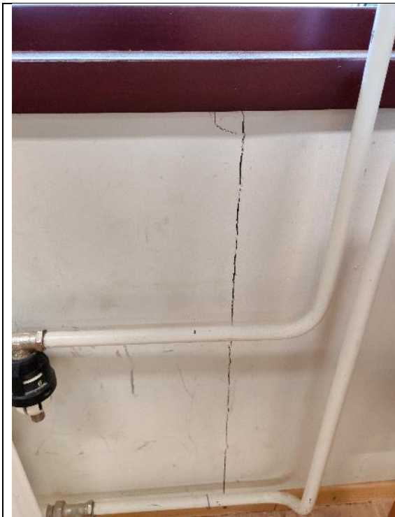
Kuva 5.36. Halkeama luokkasiiven kellarikerroksen levyrakenteisessa ulkoseinässä (teknisen työn luokka 027).
