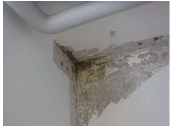
Kosteusvaurio pohjakerroksen ulkoseinässä
