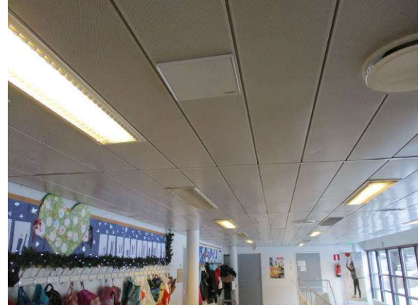
Putkistot on asennettu alas laskettujen kattojen suojaan ja näkyviin
