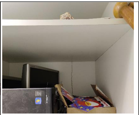
Kuva 5.39. Halkeama luokkasiiven ensimmäisen kerroksen maanvastaisessa ulkoseinässä (varasto 123).
