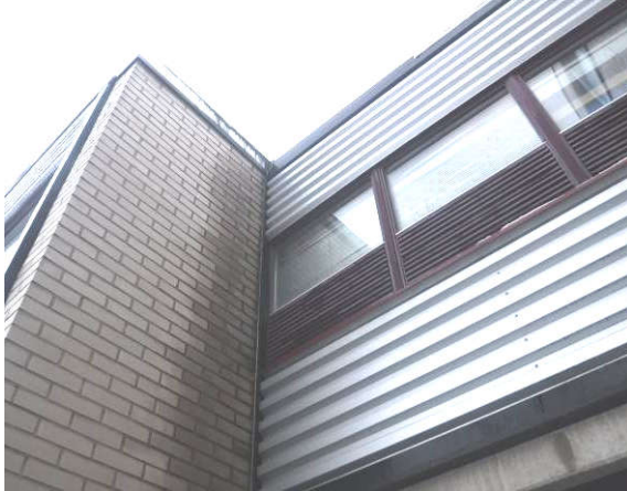
Suojapellitykseltä valuva sadevesi kastelee kalkkihiiekkakivimuurausta ja sisänurkkaa
