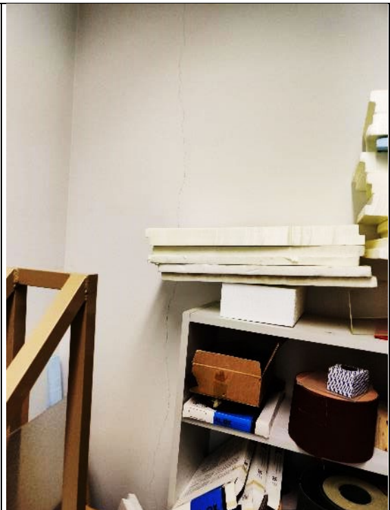
Kuva 5.37. Halkeama luokkasiiven kellarikerroksen maanvastaisessa ulkoseinässä (varasto 045).
