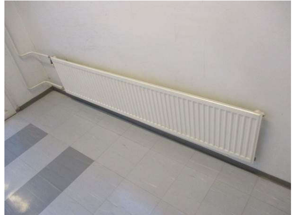
Patterit ovat hyväkuntoisia
