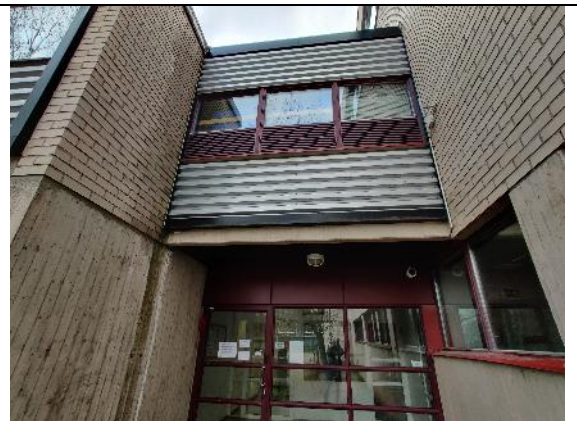
Kuva 5.7. Nivelosan vieressä olevassa luokkasiiven tiilijulkisivussa (vasen reuna) on kosteusrasituksen jälkiä. Oikealla olevassa liikuntasalirakennuksessa jälkiä ei ole.
