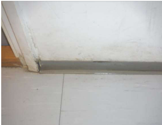
Seinien alaosissa on normaalista käytöstä johtuvia kulumajälkiä
