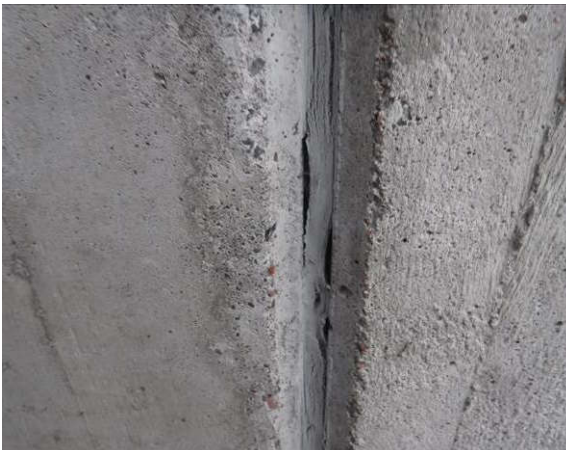
Liikuntahallin sokkelin elastisissa saumauksissa on halkeamia
