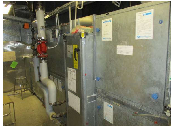
Liikuntasalin ja pukutilojen ilmanvaihtokone
