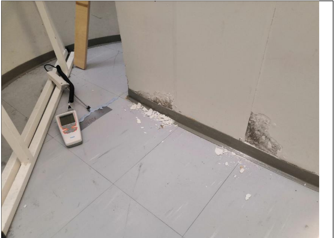
Kuva 5.12. Pyöreässä porrashuoneessa (001) on paikallinen kosteusvaurio, joka on syntynyt seinäkotelon sisällä olevan sadevesiviemärin vuodosta.
