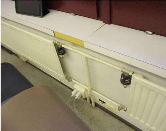
Patteriventtiilin ovat pääosin alkuperäisasennuksia
