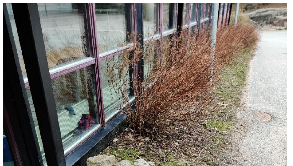
Kuva 5.10. Ulkoseinän vierustalla on runsaasti kasvillisuutta (kuva luokkasiiven itäsivulta).
