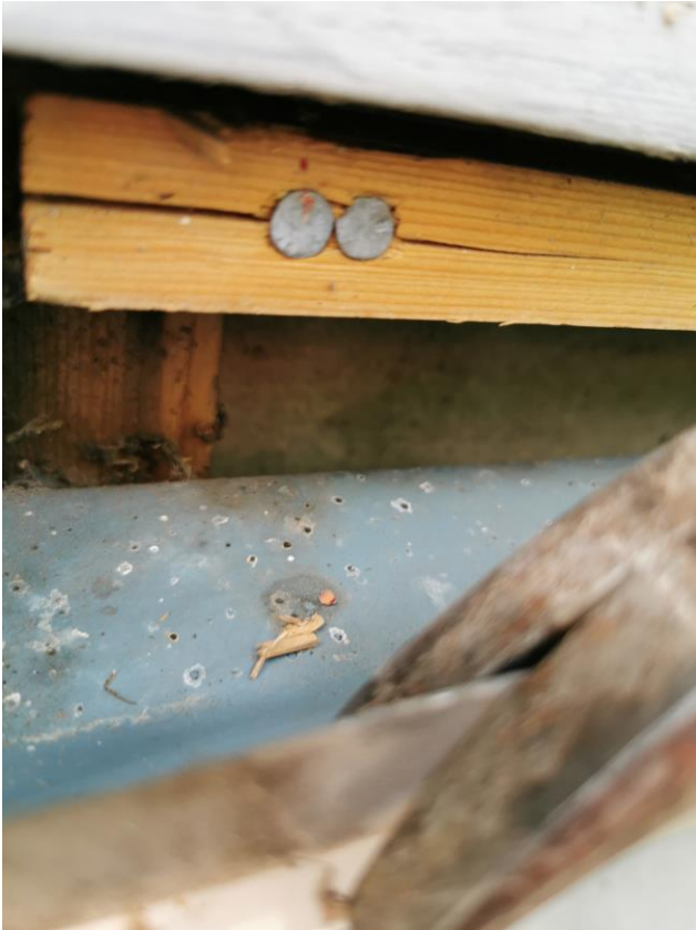
Kuva julkisivun asbestipitoisesta lujalevystä.
