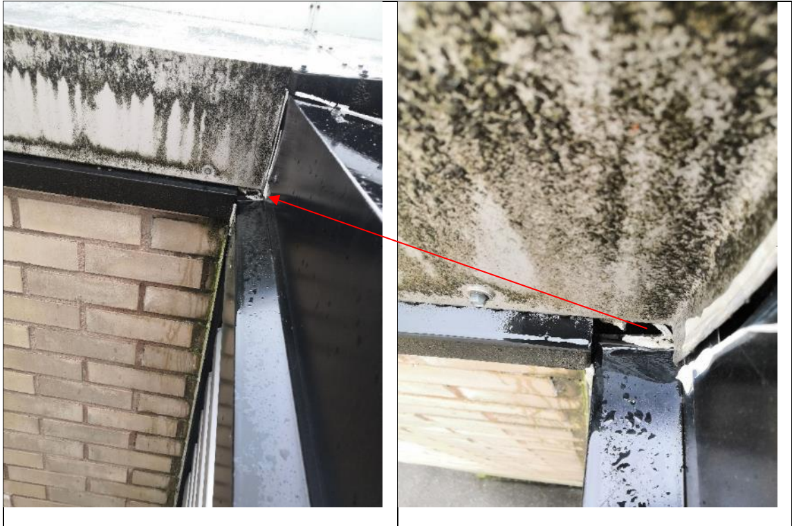
Kuva 5.58. Luokkasiiven päädyissä räystäältä tuleva vesi kerääntyy räystääspellityksen liittymiin, josta se valuu seinäpintaa pitkin.
