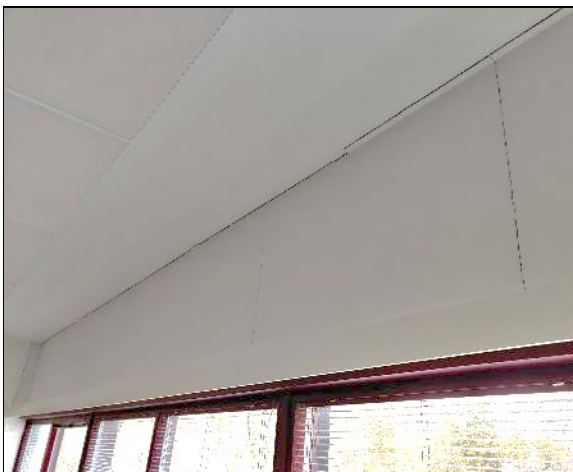
Kuva 5.38. Halkeamia luokkasiiven ensimmäisen kerroksen levyrakenteisessa ulkoseinässä (luokka 111).
