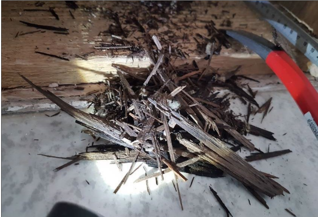
Kuva 5.32. Rakennevausten yhteydessä ulkoseinän puuosissa havaittiin paikon lahovaurioita (kuva tilasta 106, R42). Myös tilassa 112 (R31) todettiin lahovaurioita.
