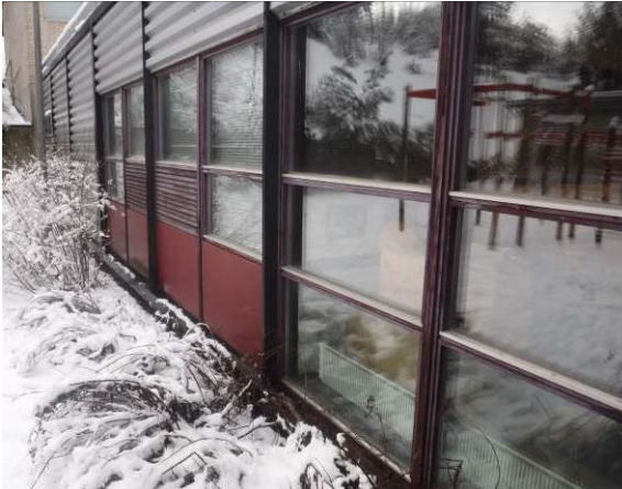
Sisäpihan puoleista julkisivua ja rakennuksen vierustaa; kallistuksissa puutteita
