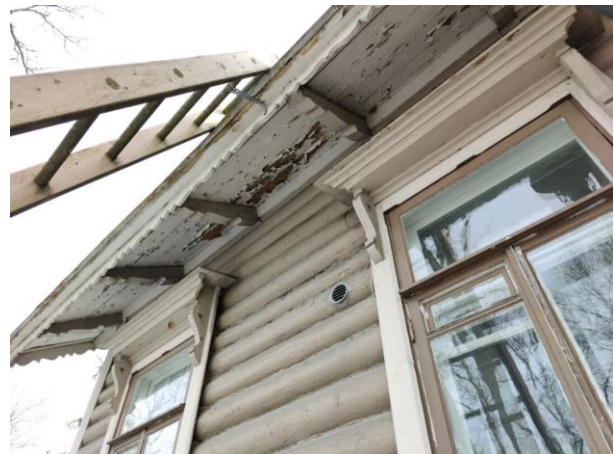
Kuva 24. Rakennuksen pääsisäänkäynnin puolella räystäslaudoitukset ovat heikkokuntoisia.
