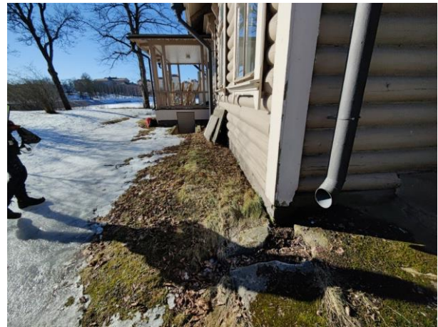
Kuva 4. Sadevedet on ohjattu rakennuksen vierustalle. Sisäänkäynnin betoniset askelmat ovat voimakkaasti sammaloituneita.
