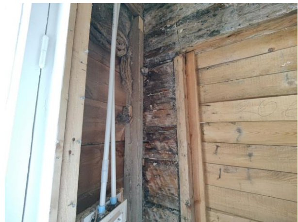
Kuva 32. Makuuhuoneen ikkunan vieressä on puukoolattu seinärakenne, jonka eristeenä oleva villa on voimakkaasti tummunutta.
