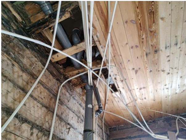
Kuva 51. 2. kerroksen wc-tilan kohdalla väliseinän yläosa on lahovaurioitunut.
