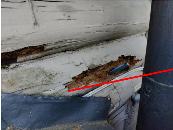
Kuva 25. Kellariin johtavan sisäänkäynnin kohdalla havaittiin merkittäviä lahovaurioita hirsirakenteissa. Sisäänkäyntikatoksen puutteellisesti tiivistetyn pellityksen kohdalla kosteutta on kulkeutunut sisäpuolisiin rakennekerroksiin asti.
