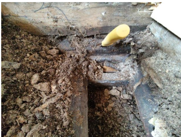
Kuva 14. Ulkoseinän ja alapohjarakenteen liitoskohdassa puurakenteet ovat voimakkaasti lahonneet.
