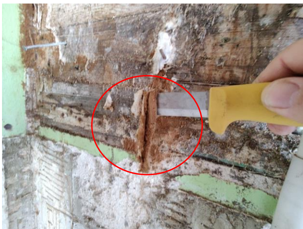
Kuva 45. Välipohjan aluslaudoitusten pinnassa havaittiin runsaasti mikrobikasvustoa.
