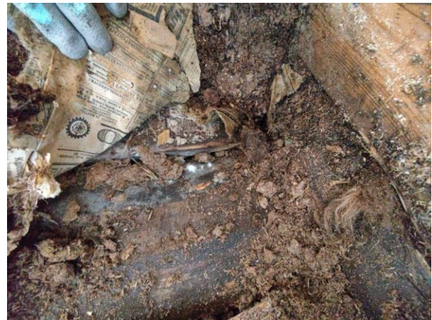
Kuva 11. Rakenneavaus keittiötilassa. Alapohjan kaikki rakennekerrokset ovat kastuneet. Rakenteessa on aktiivista mikrobikasvustoa ja lahoa.
