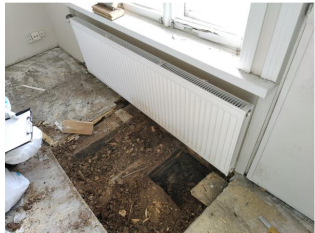
Kuva 40. Parvekkeen edustalla sijaitsevan huoneen välipohjarakenteeseen tehtiin rakenneavaus RA8. Rakenteen eristekerroksissa ja puurakenteissa havaittiin merkittäviä mikrobi- ja lahovaurioita.
