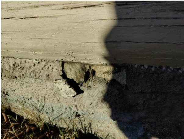
Kuva 21. Kivisokkeli on rapattu. Sokkelissa ei ole tuuletusaukkoja alapohjarakenteen osalla. Rappauksessa havaittiin halkeilua.
