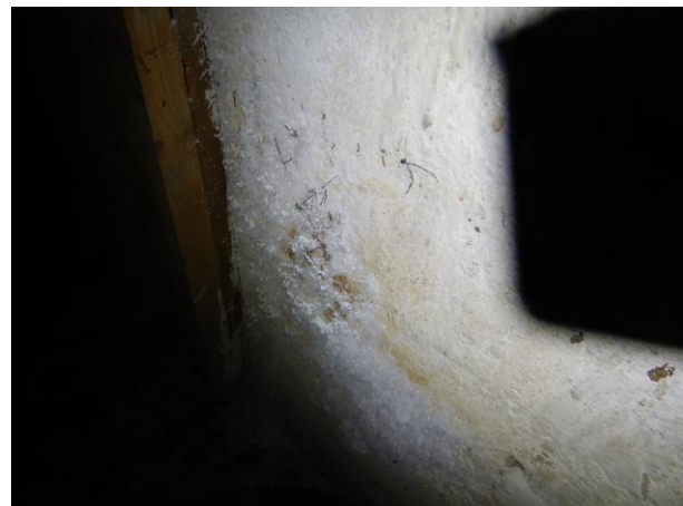
Kuva 7. Härmää betoniseinän sisäpuolella kellarikerroksessa.
