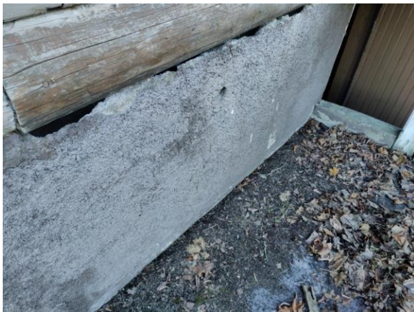
Kuva 23. Kellarin sisäänkäynnin vieressä havaittiin epätiivis sokkelin ja hirsiseinän liitos.
