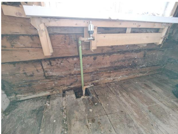
Kuva 31. Sisäpuolelta lämmöneristettyjen hirsiseinien pinnassa havaittiin näkyvää mikrobikasvustoa. Hirsiseinien tilkkeenä on pellavarivettä tai sammalta.
