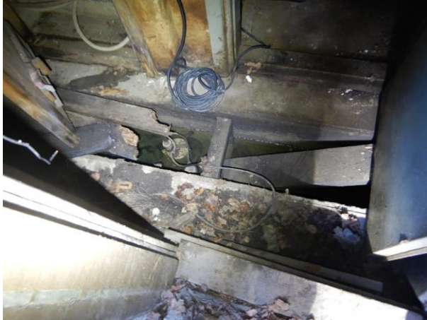
Kuva 8. Kellarin alapohjakanaalissa on vettä. Kellarin ulko-ovi on turvonnut ja vaurioitunut eikä sulkeudu kunnolla.
