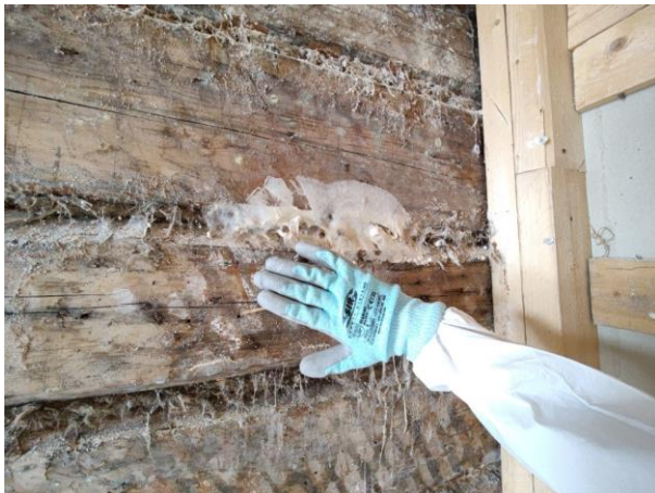
Kuva 49. Sienikasvua väliseinä rakenteessa.
