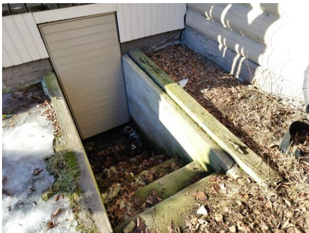
Kuva 5. Maanpinnan kallistukset ovat tasaisia. Rakennuksen itäsivustalla sijaitsevan terassin alle johtaa portaikko. Sadevesisuppilo on tukossa kuvan oikeassa laidassa.
