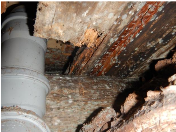
Kuva 43. Kellarin ja 1. kerroksen välinen välipohjarakenne. Puurakenteet ovat voimakkaasti laho- ja mikrobivaurioituneita.
