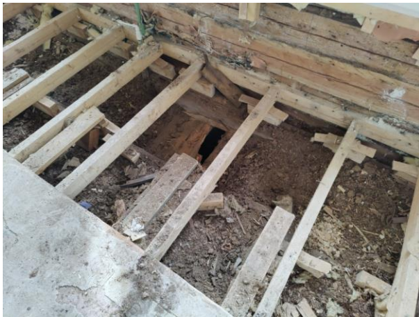
Kuva 10. Rakenneavaus RA1. Ryömintätilaa vasten sijaitsevat rossilaudat ovat lahonneet. Eristekerroksissa ja puurakenteissa havaittiin laajoja mikrobivaurioita.
