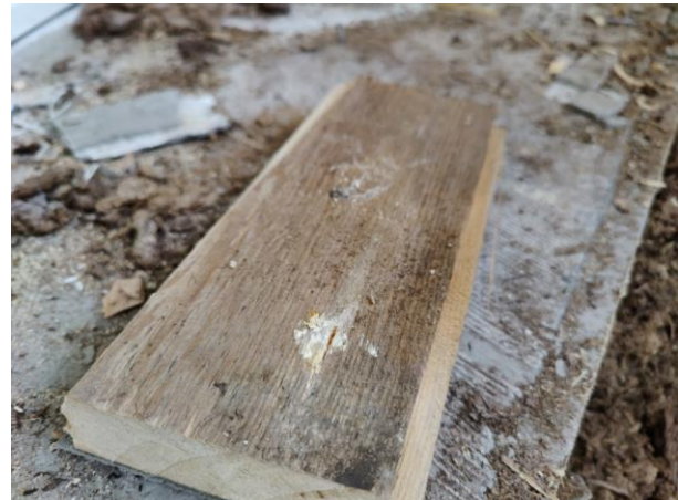
Kuva 42. Välipohjan puurakenteessa havaittiin mikrobikasvustoa.
