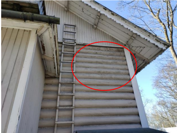
Kuva 29. Maalipinta on monin paikoin heikkokuntoinen julkisivussa.
