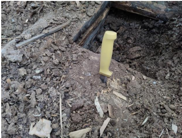
Kuva 41. Rakenneavaus RA8. Välipohjan kannatinpalkistoissa on lahovaurioita. Eristekerroksissa on kosteutta.
