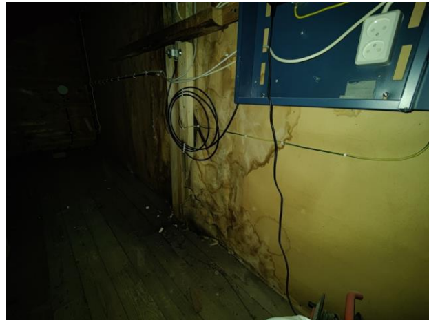
Kuva 52. Ullakkotilassa havaittiin kosteusjälkiä arviolta kattovuodon aiheuttamana.
