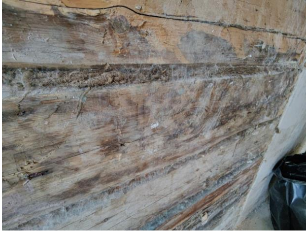
Kuva 47. Laajaa mikrobikasvustorihmastoa väliseinähirren pinnassa sekä tilkemateriaaleissa.
