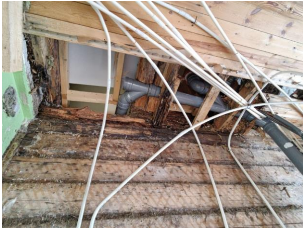
Kuva 37. Toisen kerroksen wc-tilassa on sattunut vesivahinko. Välipohjarakennetta on purettu wc-tilan kohdalla. Välipohjan kannatinpalkisto on vaurioitunut.
