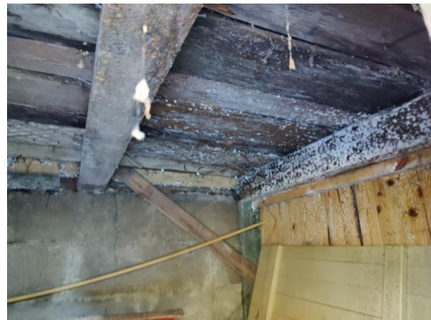
Kuva 20. Pohjoissivustan eteisen aluslaudoituksissa havaittiin mikrobikasvustoa.
