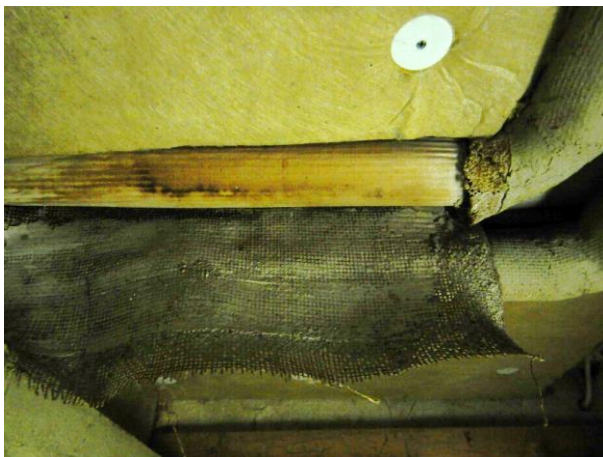
Kuva 6. Mahdollisesti asbestilla eristettyjä lämpöputkia. Eriste on rikkiäinen.
