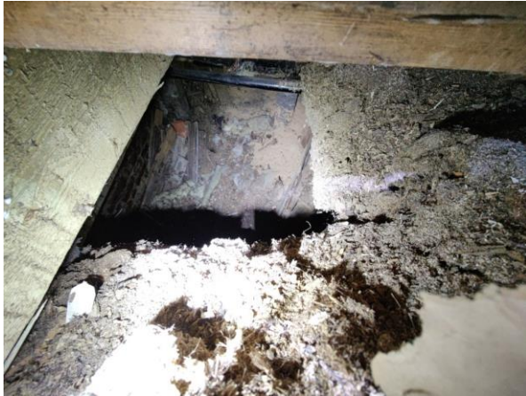
Kuva 16. Eteisaulan alapohjarakenteen aluslaudoituksia puuttuu kokonaan.
