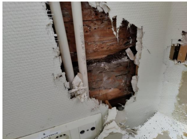
Kuva 34. Ulkoseinään tehty rakenneavaus RA 6. Kohdassa ei havaittu eristekerrosta. Ulkoseinän sisäpinnassa on mikrobikasvustoa.
