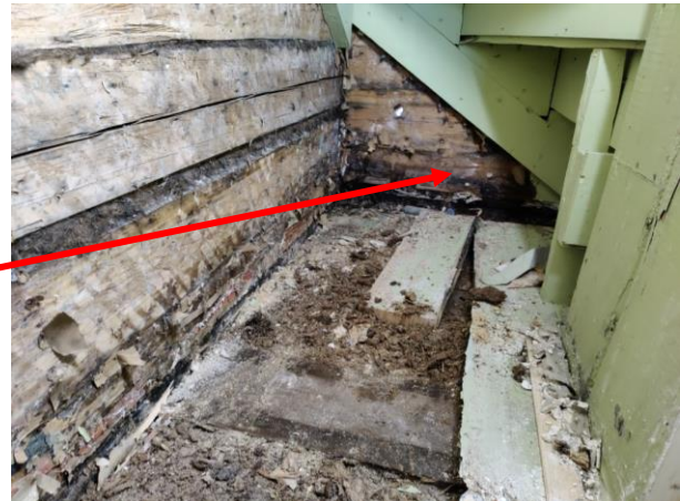
Kuva 26. Sisäpuoliset ulkoseinärakenteet ovat kastuneet kellarin sisäänkäynnin kohdalla.
