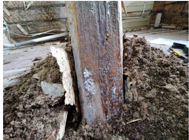
Kuva 13. Keittiön rakenneavauksessa havaittiin mikrobikasvustoa puurakenteissa.
