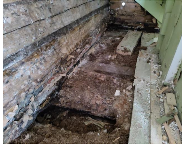
Kuva 17. Kuva kellarin sisäänkäynnin kohdalta alapohjan ja väliseinän liitoskohdasta. Puurakennekerroksissa on lahoa sekä laajoja mikrobivaurioita.
