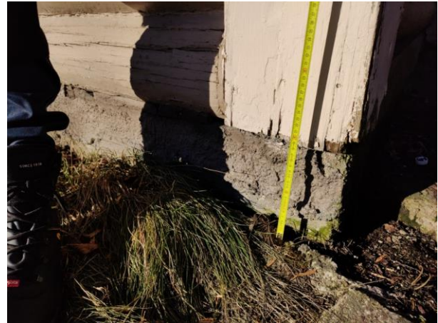
Kuva 22. Sokkelin korkeus on paikoin erittäin matala ja ulkoseinärakenteisiin kohdistuu kosteusrasitusta (lahovaurioita ulkokulman laudoituksissa).
