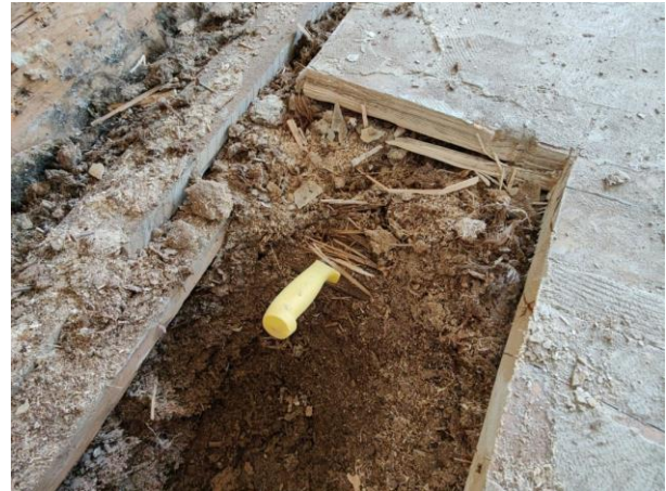
Kuva 9. Alapohjan kannatinpalkit ovat voimakkaasti lahonneet. Alapohjan eristekerrokset ovat kastuneet.
