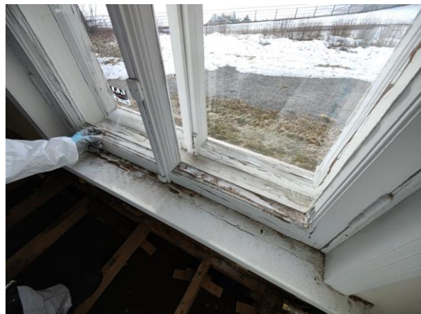
Kuva 36. Ikkunan maalipinta on heikkokuntoinen.
