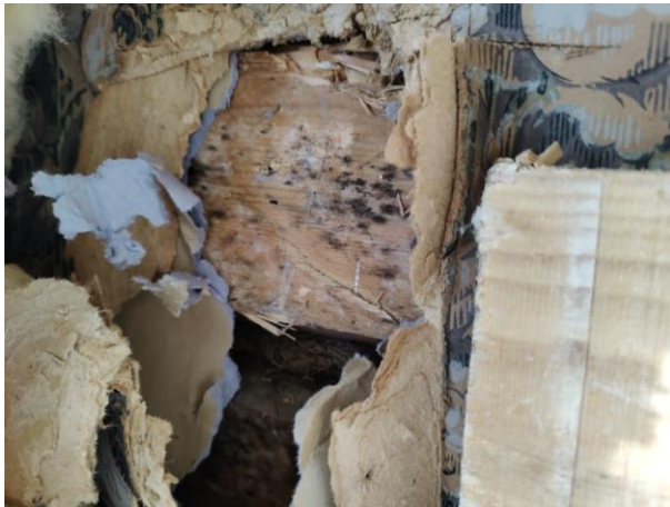
Kuva 33. Ulkoseinän rakenneavaus RA5. Lisälämmöneristeen taustalla sijaitsevan hirsirungon pinnassa on mikrobikasvustoa.
