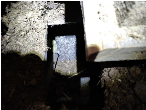
Kuva 18. Ryömintätilassa havaittiin olevan erittäin heikko tuulettuvuus. Tilassa sijaitsevien betonipilarien pinnat ovat kauttaaltaan mikrobikasvuston peitossa.
