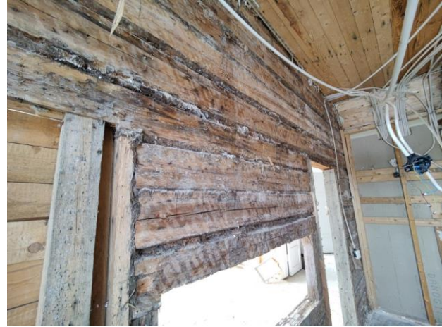
Kuva 48. Kuva keittiön puolelta. Väliseinä kokonaisuudessaan mikrobivaurioitunut pintaosista sekä tilkemateriaalien osalta.
