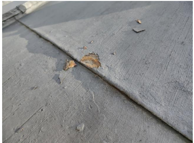
Kuva 56 Maalipinnan alapuolella vesikatteessa havaittiin voimakasta ruostumista.
