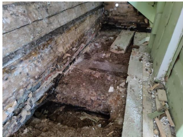
Kuva 54. Lahovaurioita pääsisäänkäynnin väliseinän alaosassa.
