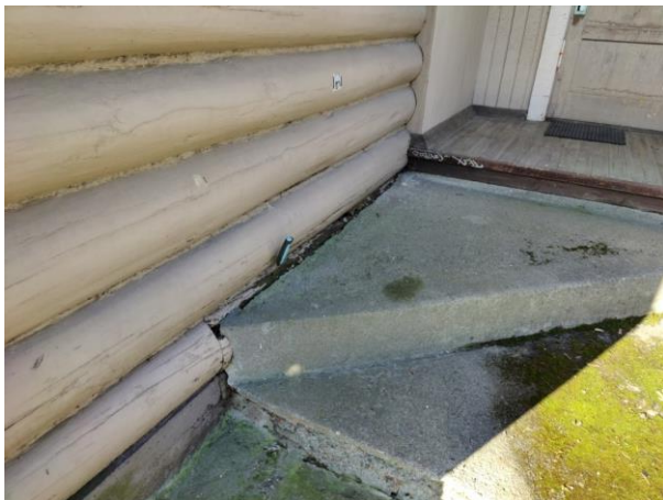
Kuva 27. Pohjoissivustalla sijaitseva betoniportaikko on valettu ulkoseinähirsiiä vasten. Hirsi on lahovaurioitunut portaankohdalla.
