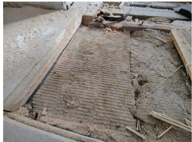
Kuva 15. 1. Kerroksen parvekehuoneen alapohjaan on lisätty mineraalivillaeristettä. Eristeessä havaittiin kosteusjälkiä.
