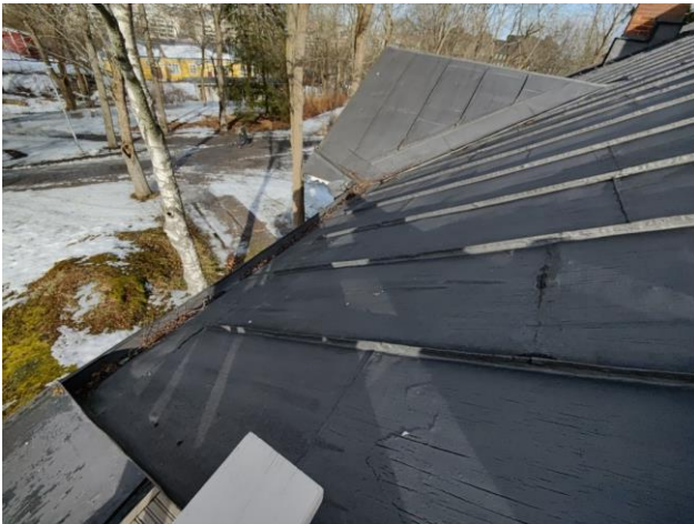
Kuva 55. Kohteen vesikatteena on saumattu peltikate. Katteen maalikerros on heikkokuntoinen. Katteessa on runsaasti halkeilua.
