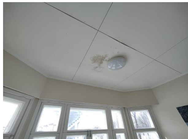
Kuva 46. Kosteusjälkiä 1. kerroksen erkkerin kohdalla.
