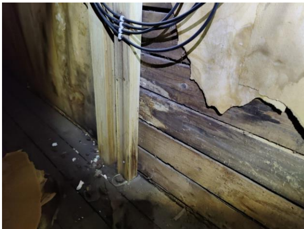
Kuva 53. Vaurioita ullakon väliseinälaudoituksessa.
