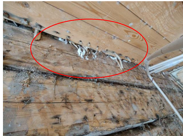
Kuva 44. Mikrobikasvustoa välipohjan ja väliseinän liitoskohdassa.
