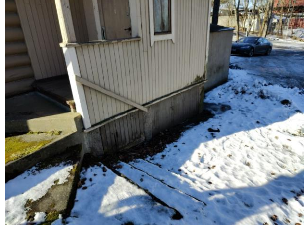
Kuva 30. Pohjoissivustalla sijaitseva sisäänkäynnin julkisivulaudoituksissa havaittiin lahovaurioita ja kosteusjälkiä.
