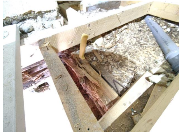
Kuva 38. WC-tilan välipohjarakenteen puurakenteissa havaittiin lahovaurioita. Eristekerrokset ovat myös vaurioituneet.
