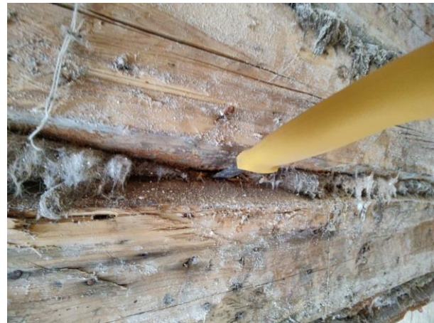
Kuva 50. Väliseinä hirsien tilkeväleissä on lahoa ja merkittäviä mikrobivauriota, joita on käytännössä mahdoton korjata ilman rakenteiden laajempaa purkamista.
