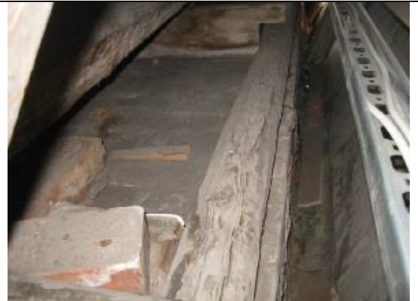
38. Sivuntelo alaosa, tiiliseinän yläosan ja alasarren välissä on allas, johon vesi jää makaamaan mahdollisen kattovuodon jälkeen
