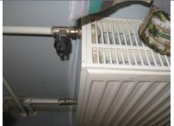
92. Patteriventtiin termostaattiosa oli irrotettu
