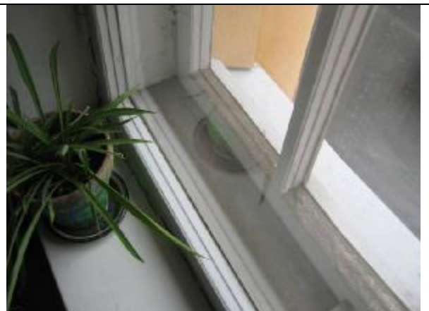
32. Pölyä ja nokea ikkunan puitteiden välissä
