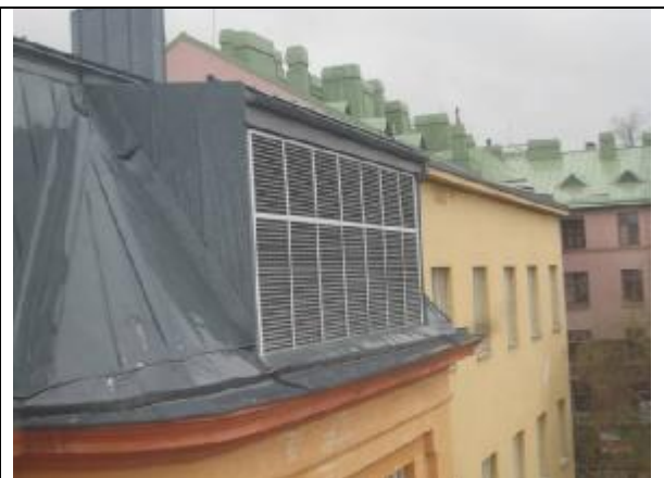
50. Jalkokouru ilmanottosäleikön kohdalla, säleikön yläpuolella riippukouru
