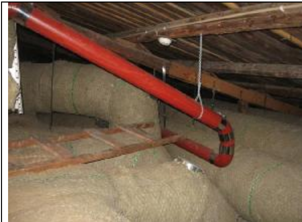
97. Yläpohjatilassa olevassa viemärin tuuletusputkessa lähes vaakasuoria osia, putki lämmöneristämätön
