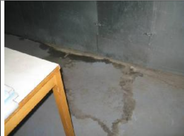
81. Kosteusjälki ilmastointikonehuoneen lattiassa kammion seinän vieressä
