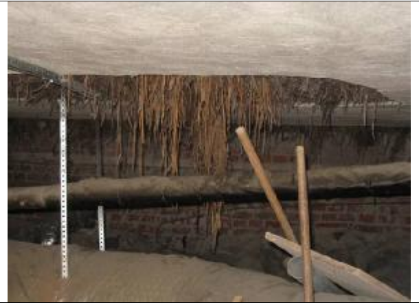
8. Voimistelu/juhlasalin alustatila, alapohjan alapintaa on purettu siten, että lämmöneristys (järviruokoa tai vastaavaa) on osittain näkyvissä
