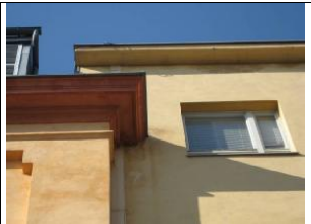
22. Kosteusjälkiä/vaurioita pihan puoleisessa sivussa, alkuperäisen rakennuksen ja laajennusosan rajalla
