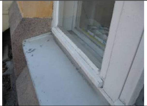
28. Ikkunoita on korjattu todennäköisesti useissa vaiheissa, ulkopuitteen vesilista on todennäköisesti uusittu
