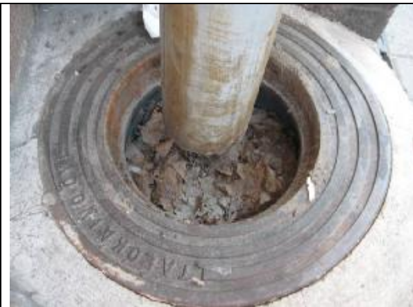
11. Syöksytornin alla oleva sadevesikaivo, ritiläkansi poistettu, kannen alla puiden lehtiä yms.
