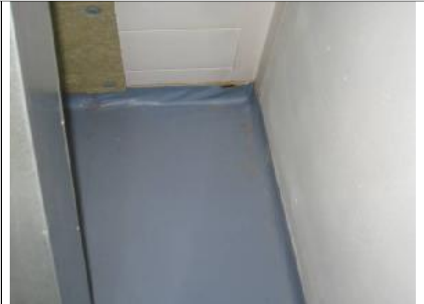
82. Ilmastointikonehuoneen lattian muovimaton nostoseinälle, vähäistä poimuilua
