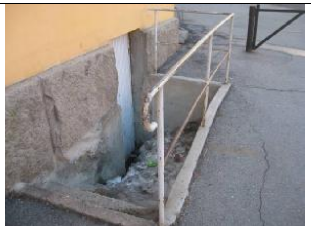
20. Alustatilan porrassyvennys, rakennuksen koillispuolella; Tukimuurissa vähäistä pullistumista; Lunta ei ole poistettu syvennyksestä. Lumi lisää oven ja alustatilan kosteusrasitusta.
