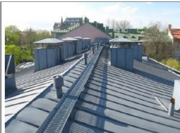
45. Luoteissiiven vesikatto, kulkukäytävän vieressä ullakon/yläpohjatilan alipainetuulettimia, oikealla viemärin tuuletusputken peltinostossa syöpyymää
