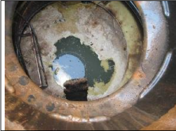
95. Rasvanerotuskaivo, keittiön jätevedet
