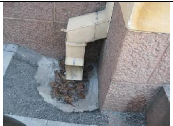
12. Syöksytornin alla oleva sadevesikaivo Aurakadun puolella, ritiläkannen päällä roskia
