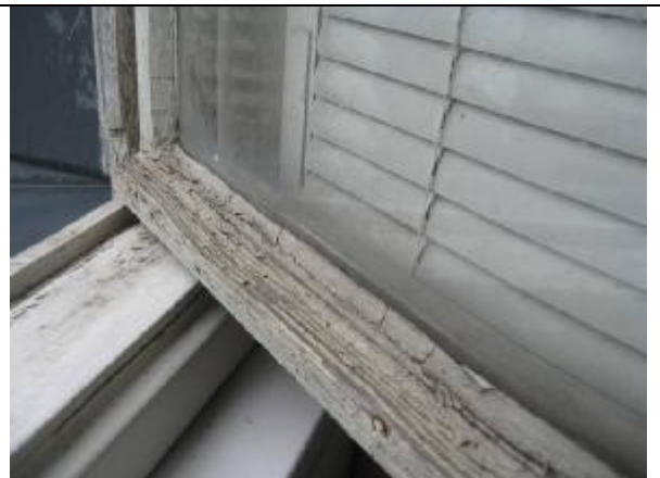
30. Ikkunan ulkopuitteen alaosa, haurastumista
