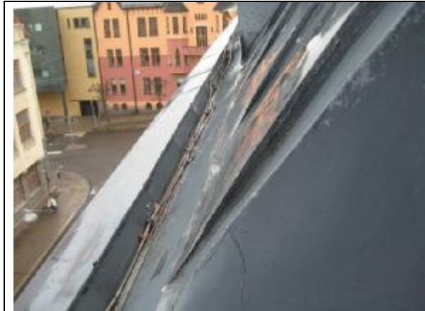
47. Maariankadun puoleinen jalkokouru, vastuskaapelit
