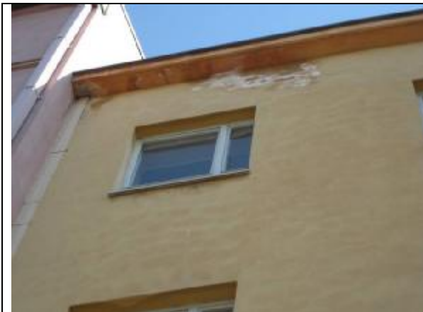
21. Kosteusjälki/vaurio Aurakadun puoleisessa julkisivussa räystäään alapuolella
