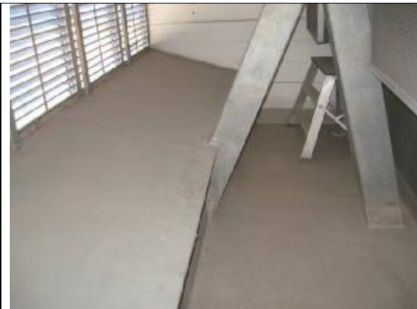
83. Ilmanottokammio, lattian päällysteenä ja vedeneristeenä muovimattoa
