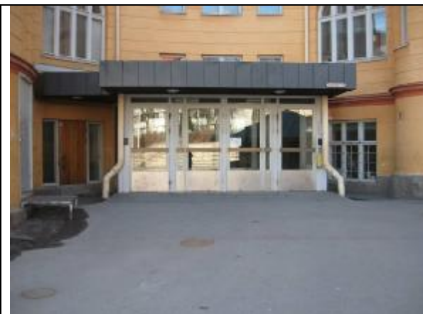
19. Pihan puoleisen sisäänkäynnin yhteydessä ei ole ulkoporrasta. Oven edusta on laatoitettu kivilaatoilla. Vasemmalla olevan wc-tilan ulko-oven alaosa on lähellä maanpinnan tasoa ja kosteusvaurioille alttiina.
