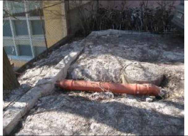
16. Naapurikiinteistöllä (Aurakatu 15) havaittiin viemäriputken pää tonttien rajalla olevan tukimuurin läheisyydessä
