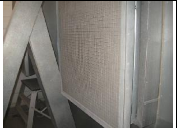
86. Tuloilmakammiossa oleva tuloilmakanavan karkea suodatin
