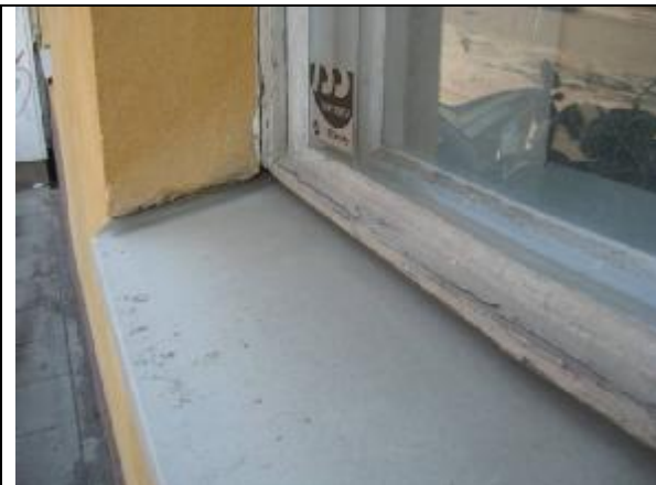
29. Ikääntymisen vaikutuksia ikkunan ulkopuitteessa
