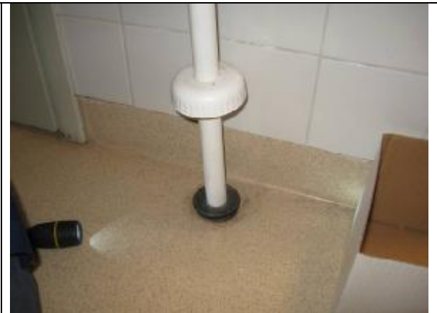
98. Pesualtaan muoviviemäriin liittyminen kumiliitoskappaleella valurautaputkeen, liitos epätiivis
