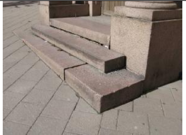
18. Entisen pääsisäänkäynnin porraskivissä havaittiin vähäistä siirtymää
