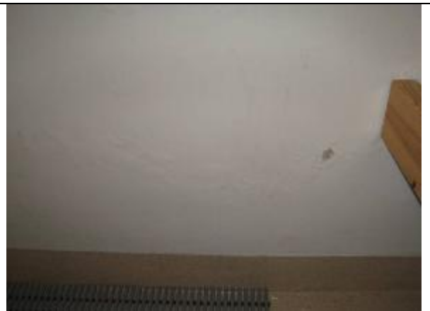
66. Voimistelusalin pukuhuone, maalin irtoamista kosteuden vaikutuksesta ulkoseinän alaosaan
