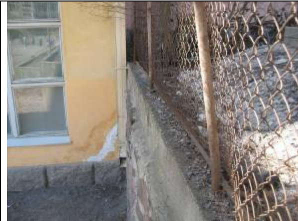
17. Julkisivussa on havaittavissa tontin rajan läheisyydessä kosteusjälkiä, jotka ovat aiheutuneet naapurin puoleisesta kosteusrasituksesta tai syöksytorven alapään vuodosta
