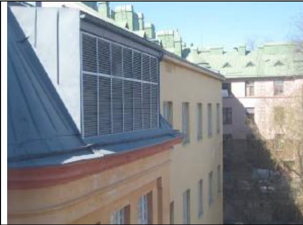
85. Tuloilmasäleikkö, rakennuksen koillissivulla
