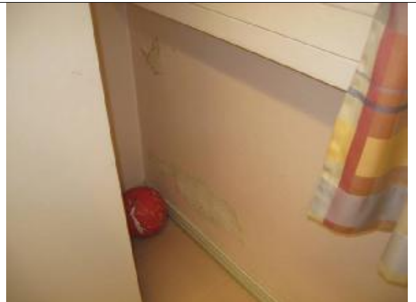
62. Luokka 302, maalin irtoamista ulkoseinästä, seinässä ei havaittu kuitenkaan normaalista poikkeavaa kosteutta
