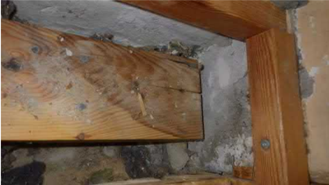
Kuva 20. Liikuntasalin ulkonurkkaan tehty rakenneavaus. Kulmassa merkkejä kosteusrasituksesta.
