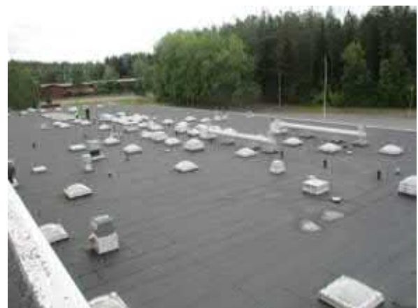
Vesikatolla on runsaasti huippuimureita
