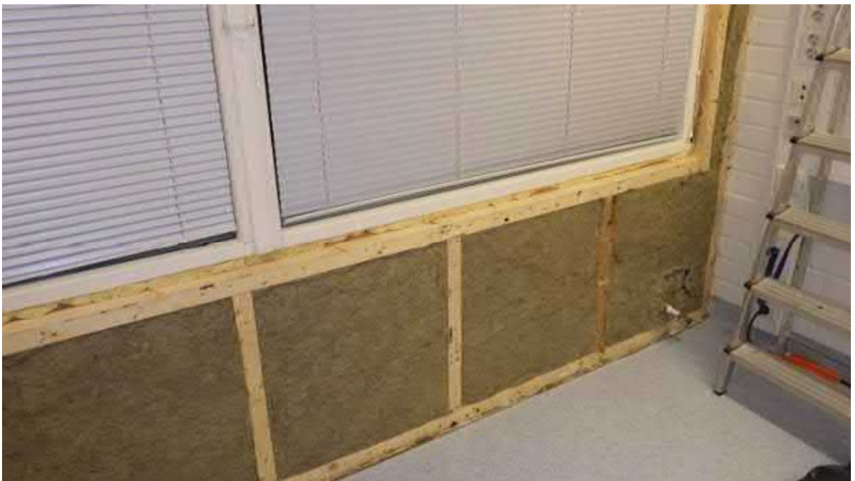
Kuva 23. Seinärakenteen avaus sisäpihan puolella sijaitsevaan perhetuvan ryhmätilaan. Haiseva puun kappale sijaitsi ikkunan oikeassa reunassa lämmöneristeen takana.
