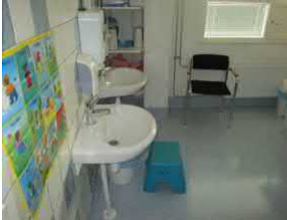
Vesi- ja viemärikalustusta
