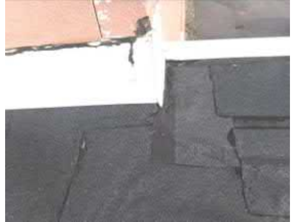
Kattoa on paikattu moneen otteeseen
