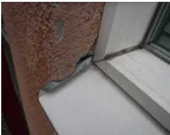
Ikkunan vesipellin liittyminen rappaukseen; paikallinen epätiiviyiskohta
