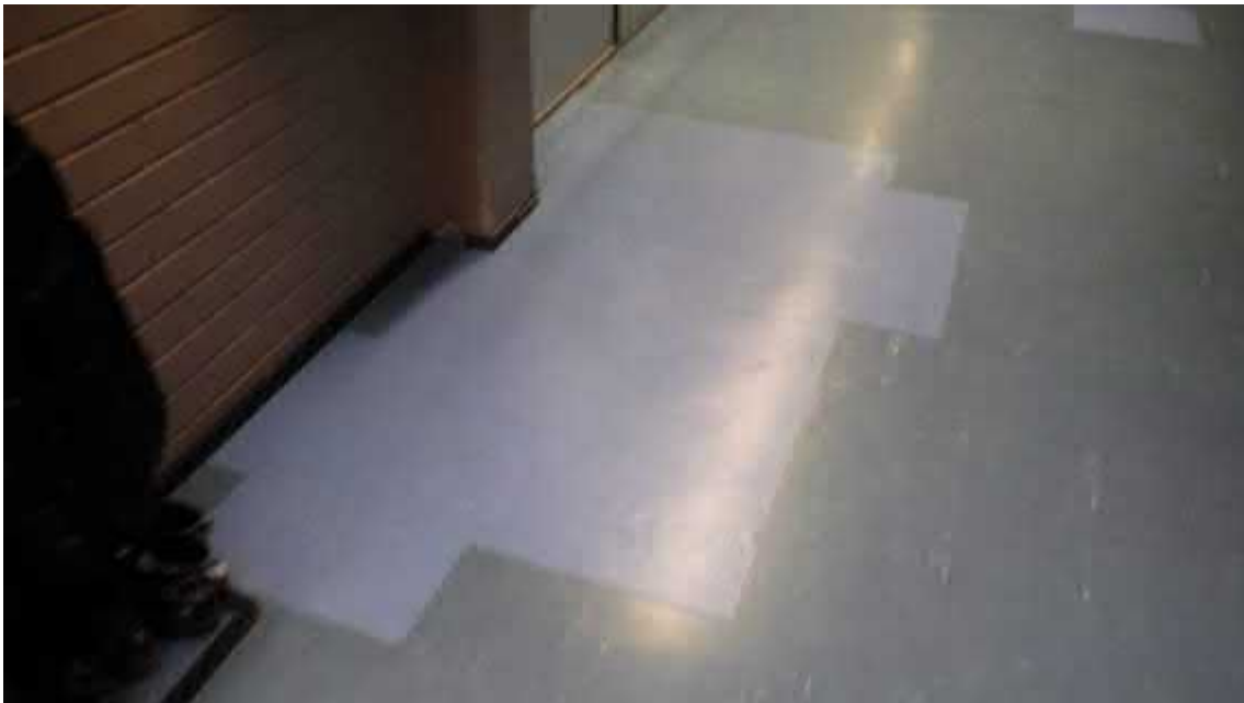
Kuva 11. Alueella on korjattu vanha kosteusvaurio.
