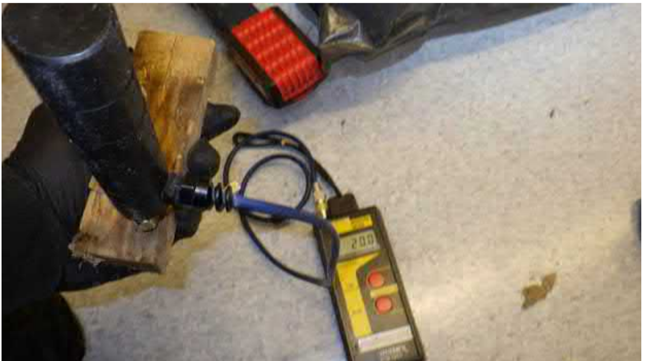
Kuva 25. Seinärakenteen avaus sisäpihan puolella sijaitsevaan perhetuvan ryhmätilaan, puun kappaleessa kosteutta ja selvä mikrobiperäinen haju.
