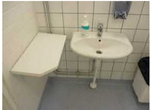
Vesi- ja viemärikalustusta
