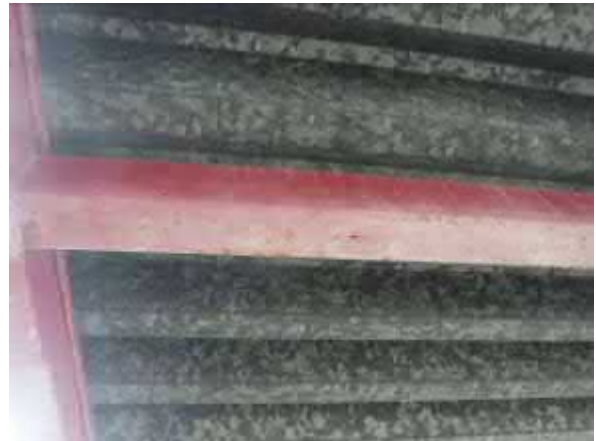
Katoksen teräsosissa korroosiovaurioita
