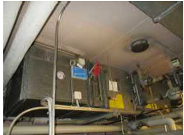
Tuloilmakone lämmönjakuhuoneen katossa
