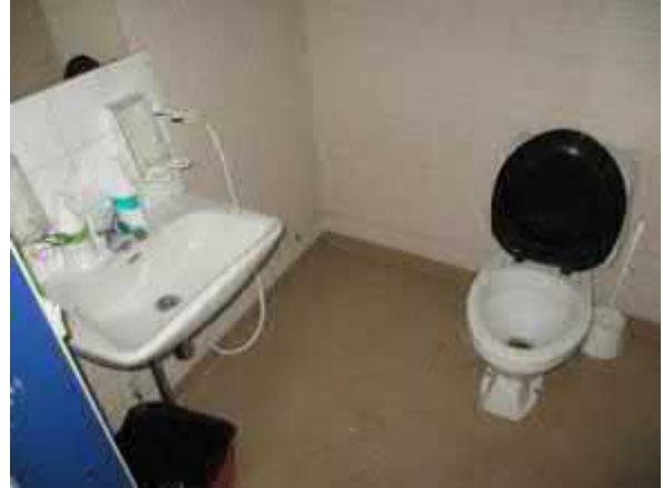
Vesi- ja viemärikalustusta
