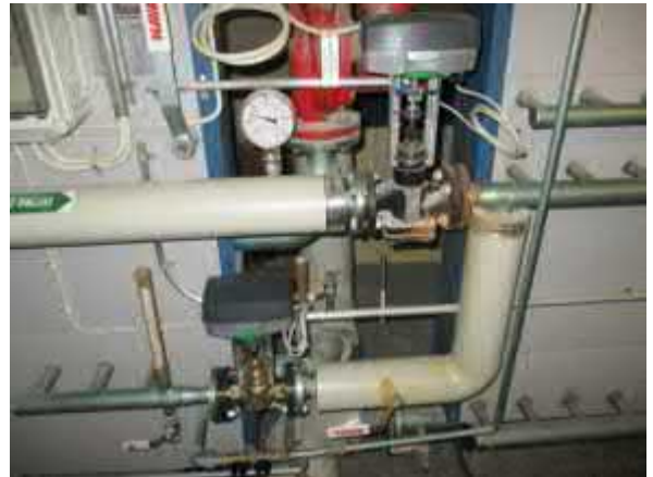
Lämmönjakokeskusta on huoltokorjattu tarpeen mukaan
