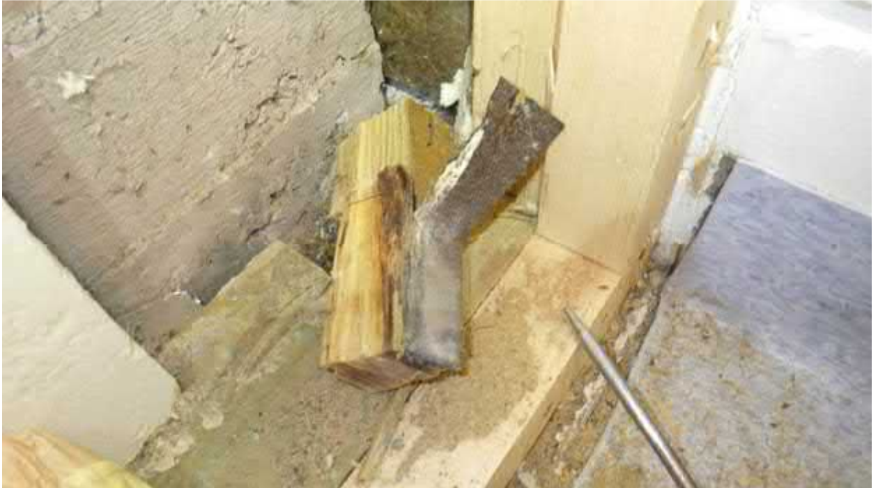
Kuva 24. Seinärakenteen avaus sisäpihan puolella sijaitsevaan perhetuvan ryhmätilaan, alaohjauspuun ulkopinnassa ei vaurioita, alapuolella kermi.
