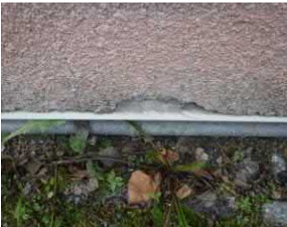
Sokkeli on matala ja sade-/ sulamisvedet kastelevat seinän alaosa
