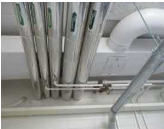
Alkuperäisiä lämpö- ja vesijohtoja
