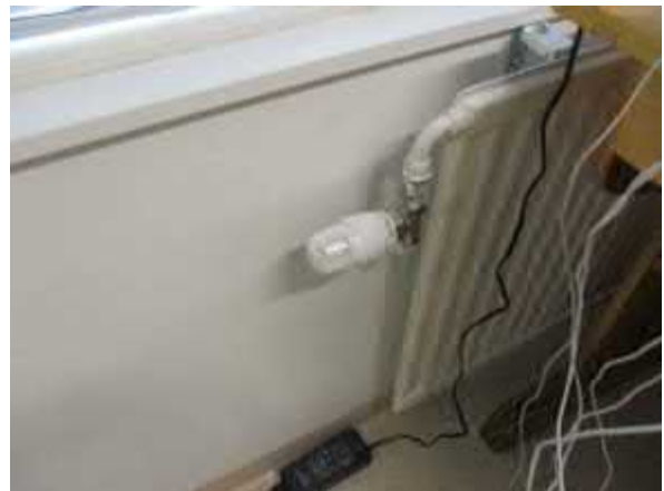
Patteriventtiileitä on osin uusittu 2000-luvulla
