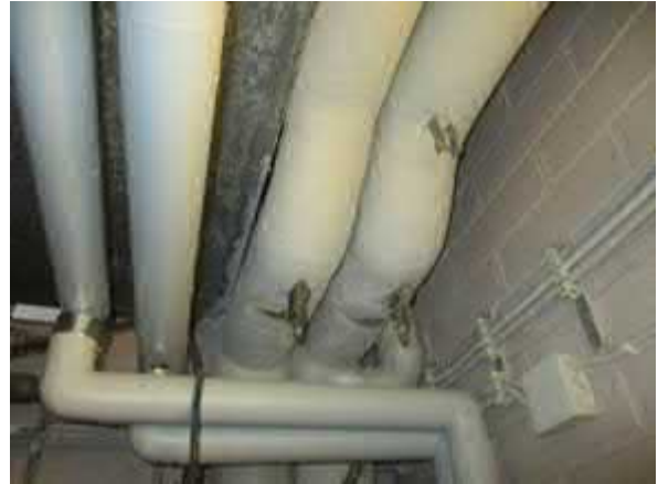
Todennäköisesti asbestia sisältäviä putkieristeitä lämmönjakohuoneessa
