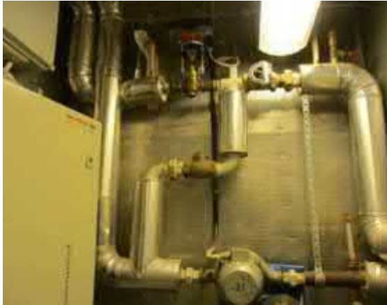
Putkieristeet IV-koneiden yhteydessä ovat peltipinnoitettuja
