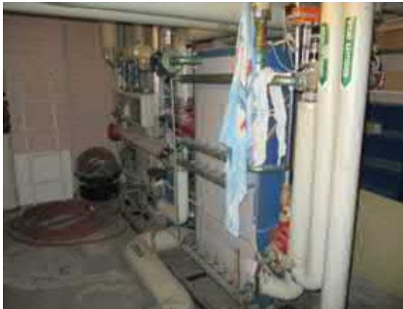
Lämmönjakokeskus on vm. 1993
