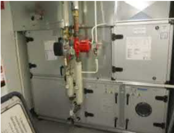
Keittiön tuloilmakone vuodelta 2005
