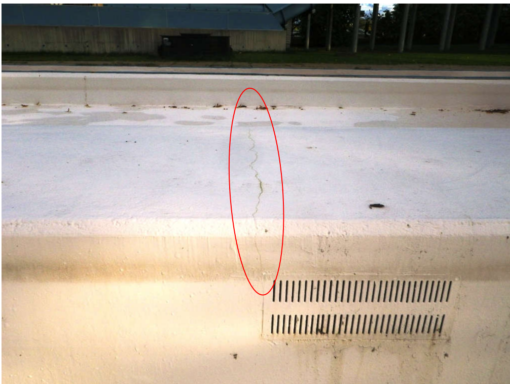
Kuva 12. Halkeamavaurio altaisen välikannaksen yläpinnassa
