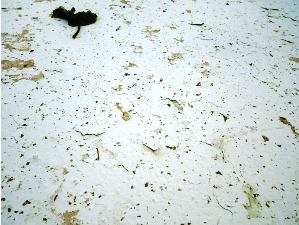
Kuva 13. Vaurioita altaan pohjan pinnoitteissa
