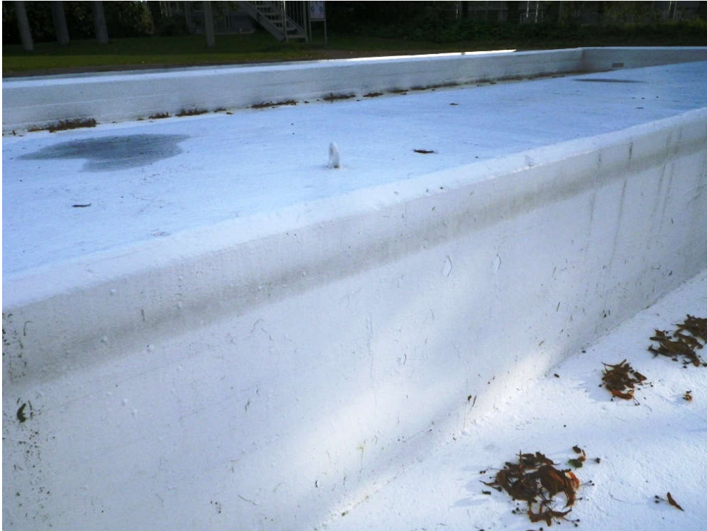
Kuva 11. Pinnoitevaurioita altaiden välikannaksen seinämässä
