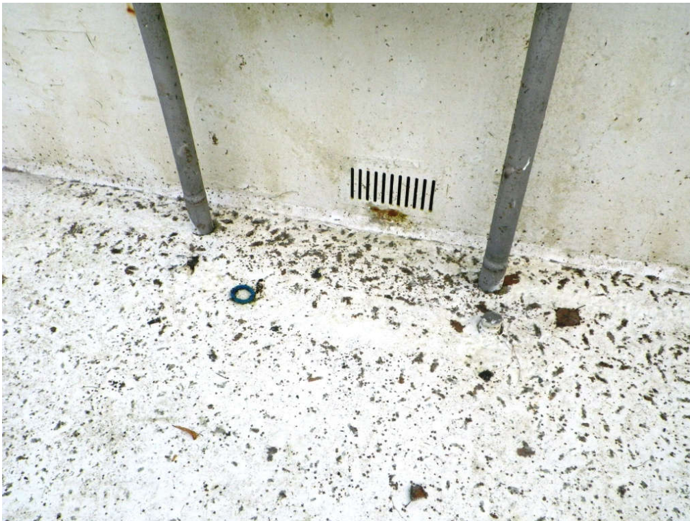
Kuva 16. Portaan alapään kiinnitys on puutteellinen
