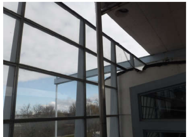
Ylemmällä tasolla olevaa lasiseinämää. Teräsosissa alkavaa korroosiota
