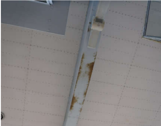
Paikallinen ruostevaurio, ruoste on rakenteen pinnalla
