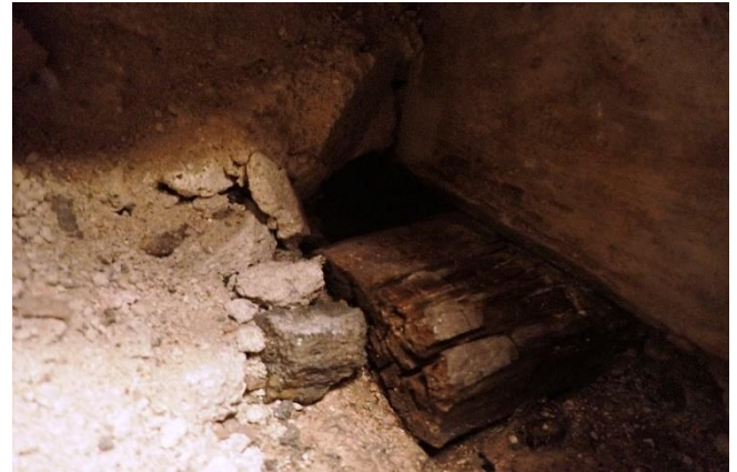
Kuva 10. Lattiahirttä kannattelevassa tukihirressä lahovauri- oitumista (tila 160).
