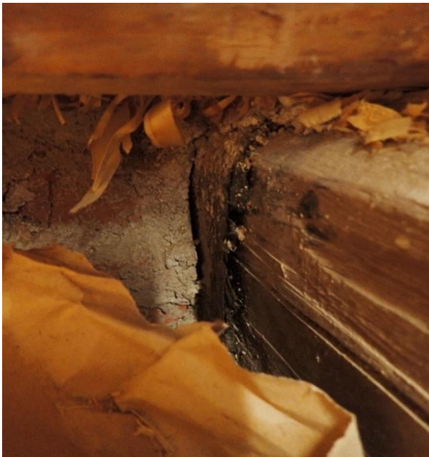
Kuva 33. Välipohjan primäärikannatinhirsien seinän tukevassa päässä on bitumikermiä VP2.
