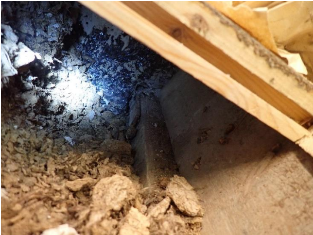
Kuva 31. Rakennuskohtaus VP1, tilassa 248. Eristettyjen kattojen kohdalla ulkoseinässä on bitumisivelyä.
