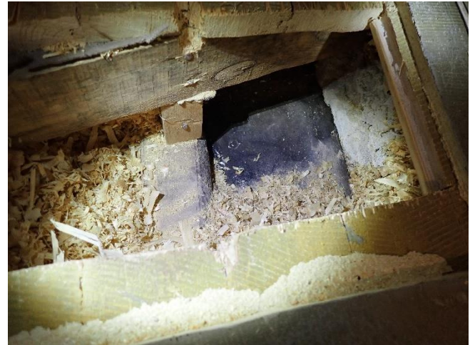
Kuva 32. Rakennuskohtaus VP3, tila 250. Betonilaatan päällä on tervapaperia.
