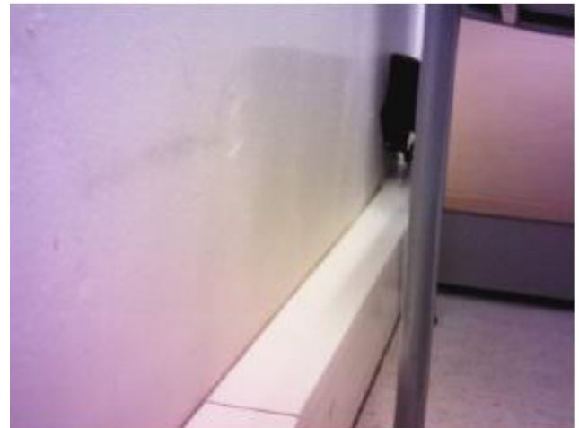
Kuva 12. Lattian ja ulkoseinän rajapinnassa ilmavuotoa tilassa 164
