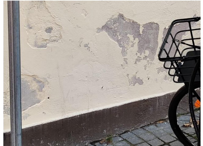
Kuva 18. Rappausvaurioita seinän alaosassa.
