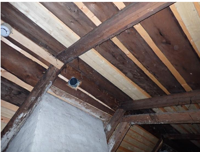
Kuva 37. Osittain uusittua ruodelaudoitusta.
