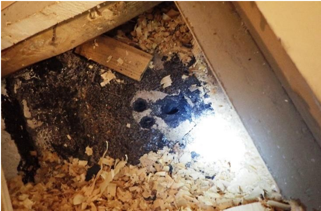
Kuva 9. Valuasfalttia alapohjarakenteessa (tila 156)
