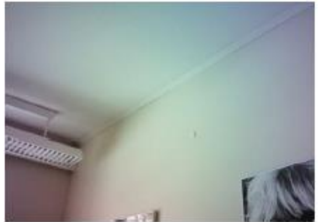
Kuva 48. Ilmavuotoa yläpohjasta, tila 244.
