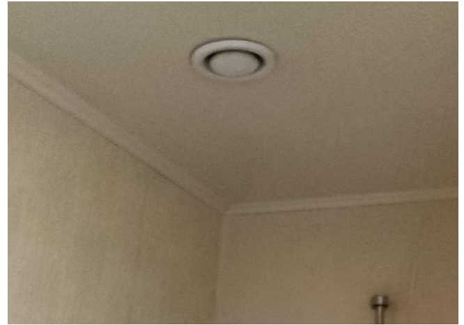
Kuva 64. Poistoilmaventtiili suihkutilassa, tila 158.
