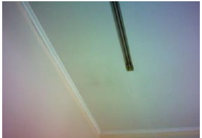
Kuva 50. Lämpövuoto yläpohjassa, tila 246
