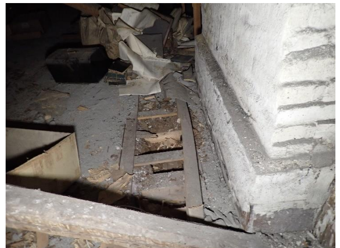
Kuva 38. Yläpohjassa ylimääräistä irtainta.
