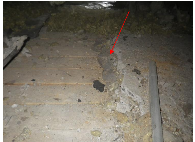
Kuva 60. Palo-permannon alla tervapaperi.
