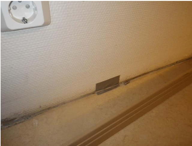
Kuva 61. Asbestinäyte kokoushuoneen seinälevystä. Levy sisältää asbestia.
