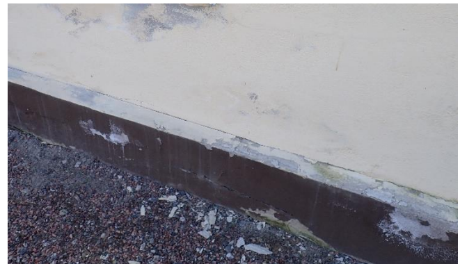
Kuva 29. Rappausvaurioita seinän alaosassa.
