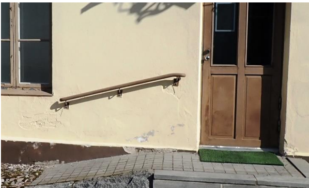
Kuva 28. Rappausvaurioita seinän alaosassa.
