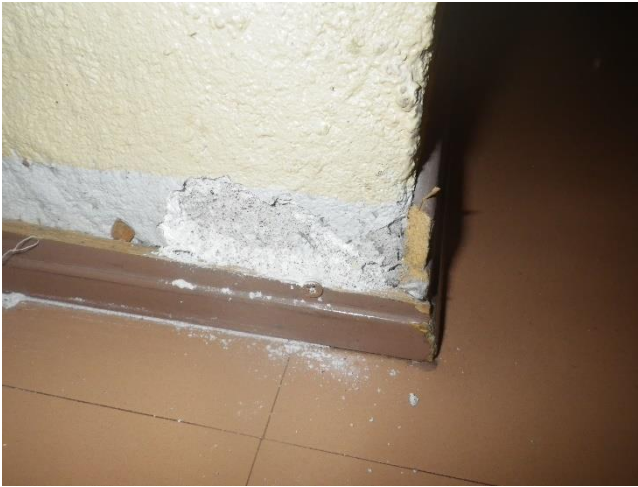
Kuva 30. Kosteusvaurioita seinän alaosassa, tila 130.
