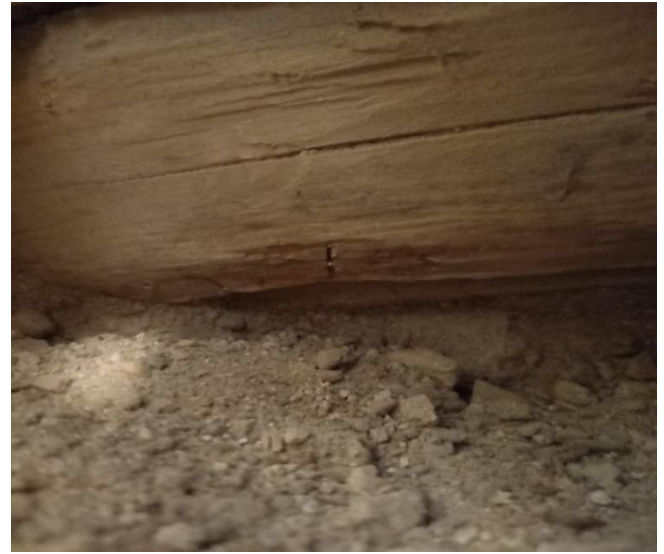
Kuva 19. Lattiapalkissa (hirsi) lahovaurioitumista.
