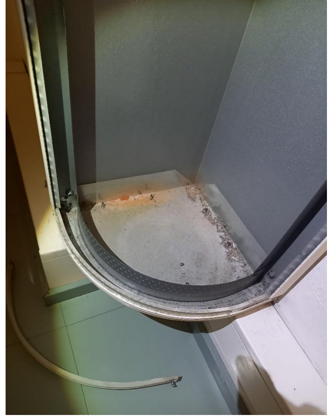
Kuva 70. Likaa tuloilmapäätelaitteen sisällä.
