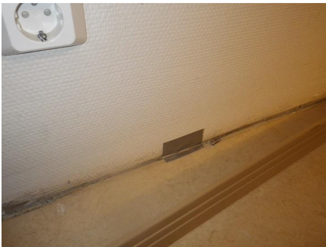
Kuva 1. Tilan 232 väliseinälevystä kerätty näyte sisältää asbestia (HA.11).
