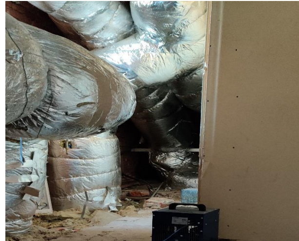
Kuva 51. Yläpohjassa on paljon IV-kanavistoa.
