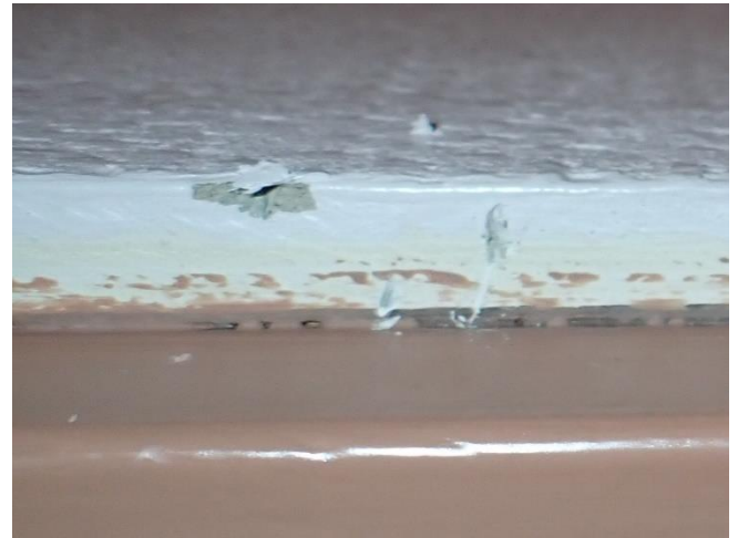
Kuva 62. Tilan 224 käytävän puoleinen seinälevy sisältää asbestia (kokemusperäinen havainto).
