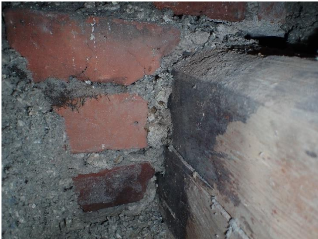
Kuva 59. Yläpohjahirren päässä terväsively.
