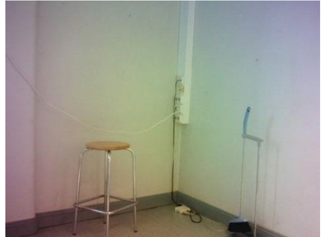
Kuva 21. Lattian ja ulkoseinän rajapinnassa ilmavuotoa tilassa 144.
