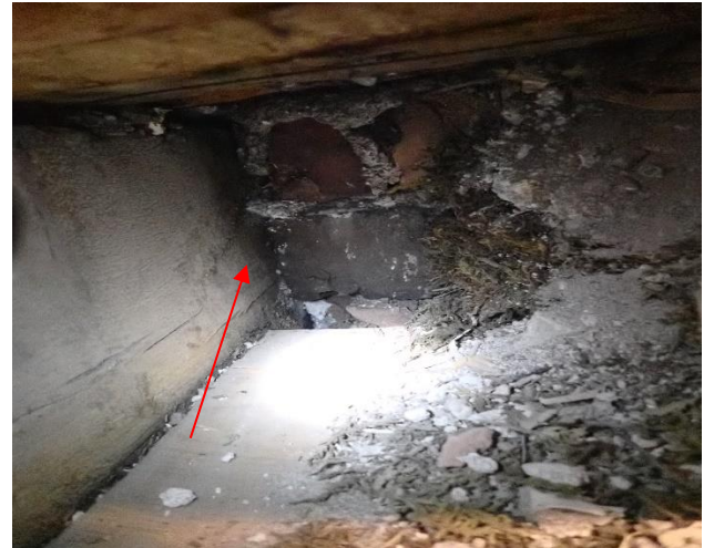
Kuva 46. Ulkoseiniin tukeutuvien puupalkkistojen tukipinnoissa ei havaittu kosteussuojausta
