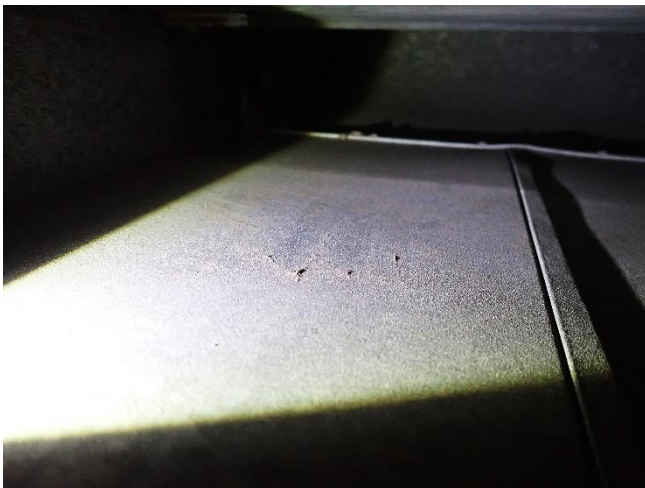
Kuva 59. Pölyä ja likaa tuloilmakanavassa tilassa 102
