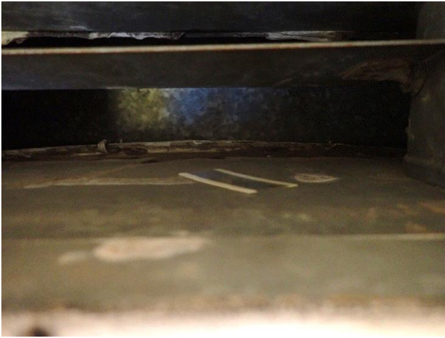
Kuva 61. Pölyä ja likaa tuloilmakanavassa tilassa 308
