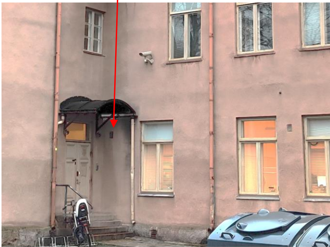
Kuva 17. Ensimmäisen kerroksen tilan 103 ulkoseinässä on kylmä alue, joka on aiheutunut ulkoseinässä olevan vanhan korvausilmaventtiin puutteellisesta ummistamisesta.
