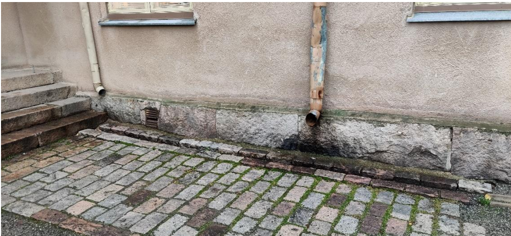
Kuva 2. Sadevedet johdetaan rakennuksen vierustalla oleviin avokouruihin. Kellarin raitisilma-aukot ovat lähellä maanpintaa.
