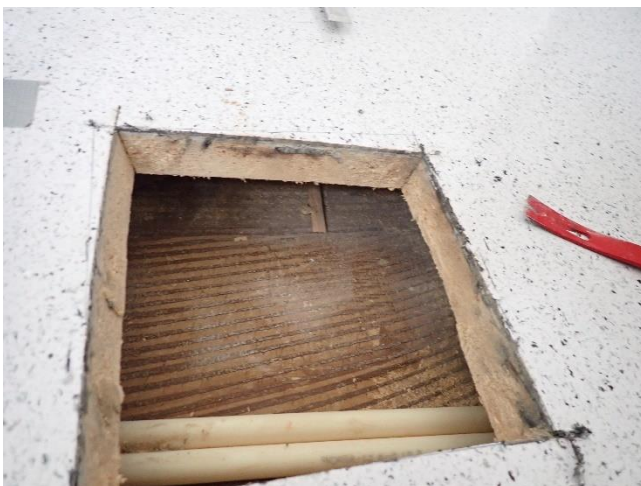
Kuva 1. Lastulevyn yläpinnan liimassa on asbestia (antofylliitti).
