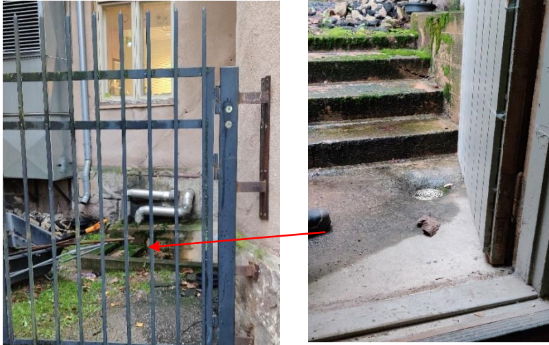
Kuva 4. Kellarin oven edustalla oleva kaivo ei vedä kovilla sateilla, jolloin vettä pääsee oviaukosta sisään
