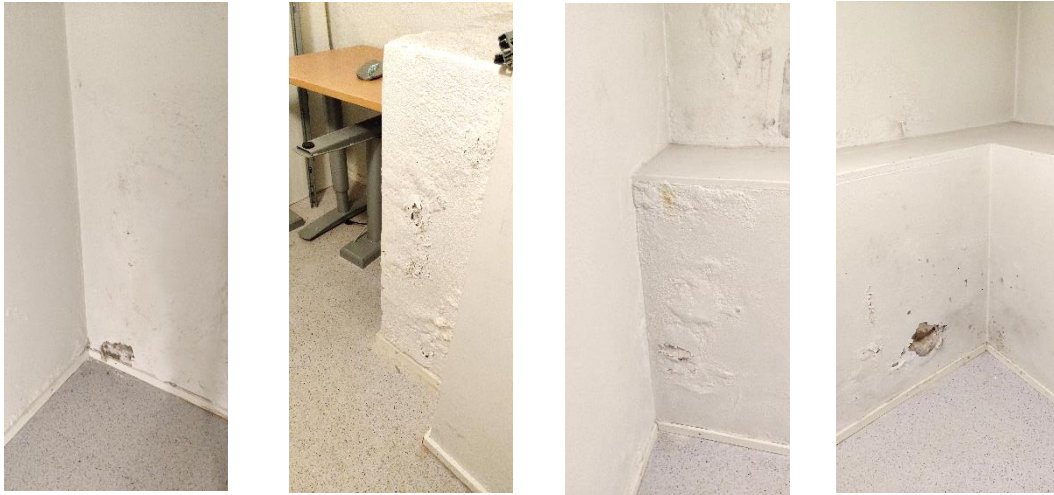
Kuva 12. Käytävällä 006, varastossa 009 ja porrashuoneessa 010 on kosteusvauriojälkiä seinien alaosissa.
