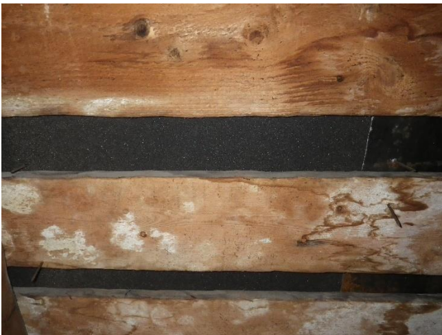
Kuva 37. Aluskatteena on huopa. Kattoruoteissa on paikoin vanhoja kosteusvauriojälkiä.
