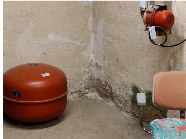
Kuva 4. IV-konehuoneen ja lämmönjakohuoneen seinätaasoitteissa/maalissa on asbestia (amosiitti)
