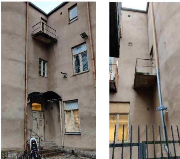
Kuva 3. Sisäpihan puolella on kaksi huonokuntoista parvekettä. Syöksytorvia on osittain uusittu.
