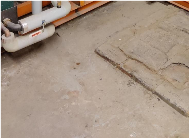
Kuva 3. Lämmönjakohuoneen harmaassa maalissa on asbestia (antofylliitti).
