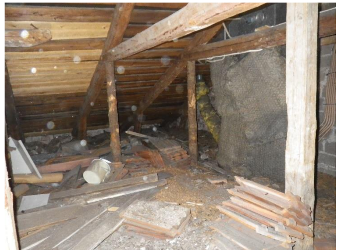
Kuva 38. Kattoruoteita on paikoin uusittu. Yläpohjatilassa on jonkin verran rakennusjätettä ja muuta tavaraa.
