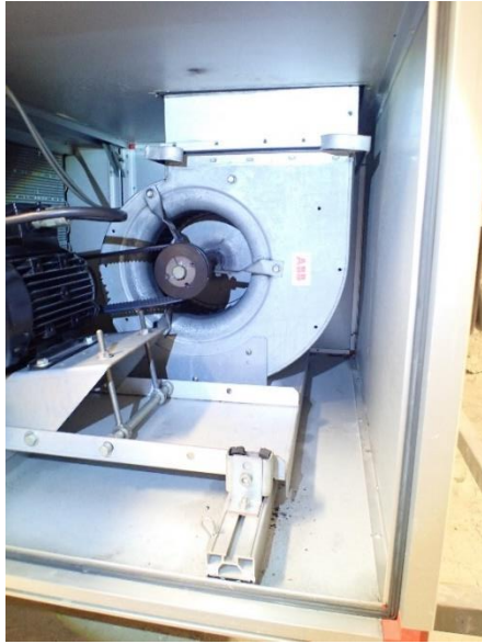
Kuva 57. Tuloilmakone on puhdas
