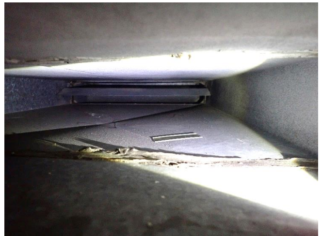
Kuva 60. Pölyä ja likaa tuloilmakanavassa tilassa 207
