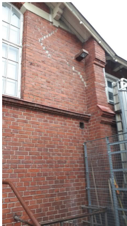
Kuva 13. Ulkoseinässä näkyvää halkeamaa.
