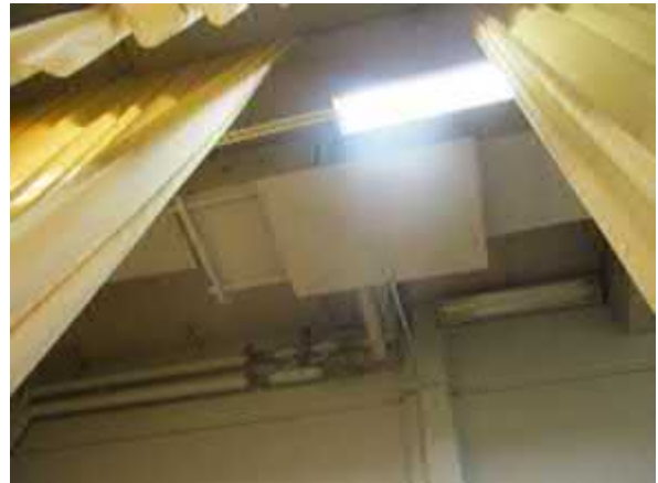
Liikuntasalin tuloilmakone on vaikea huollettava, huoltoa varten joutuu rakentamaan telineet
