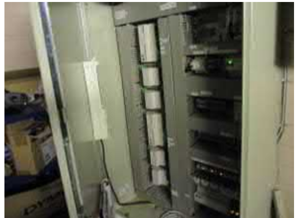
VAK-kaappi lämmönjakohuoneen seinällä
