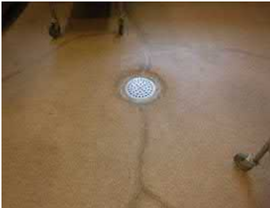
Keittiön massalattiassa halkeamia
