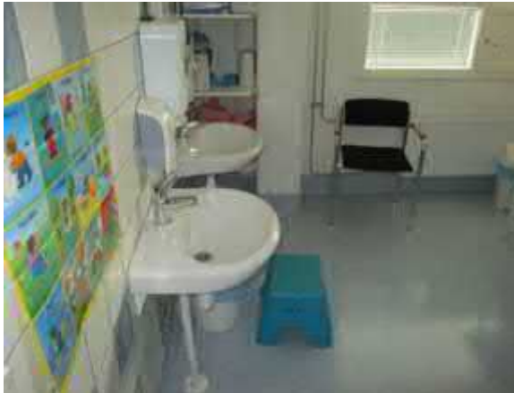
Vesi- ja viemärikalustusta
