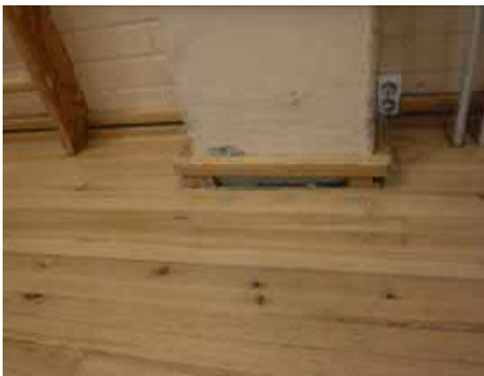
Liikuntasalin ja kantavan pilarin liittymää. Seinissä ja lattiassa kulumajälkiä.
