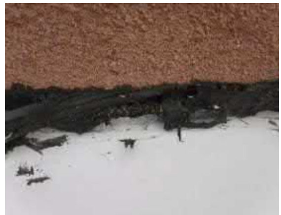
Juuripelti liikuntahallin seinää vasten; tiivisteeseen tarkoitettu bitumi valuu pellille
