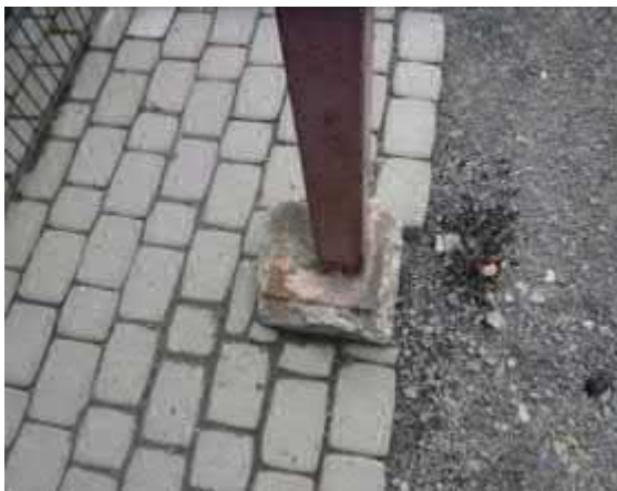
Samaisen katoksen teräspilarin liitos peruspila- Pihavarusteita riin; korjaustarvetta
