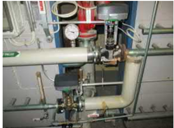
Lämmönjakokeskusta on huoltokorjattu tarpeen mukaan
