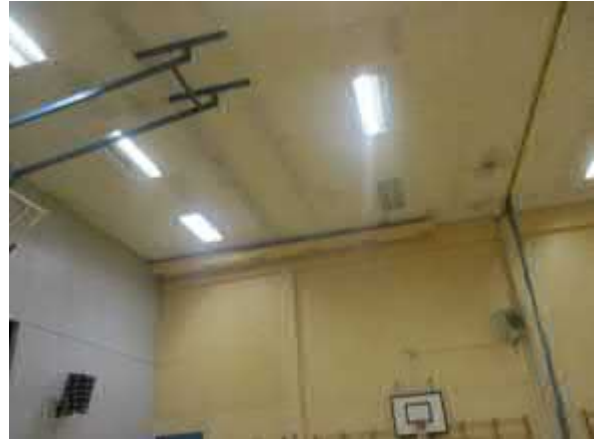
Ilmanvaihtolaitteita liikuntasalin katon rajassa
