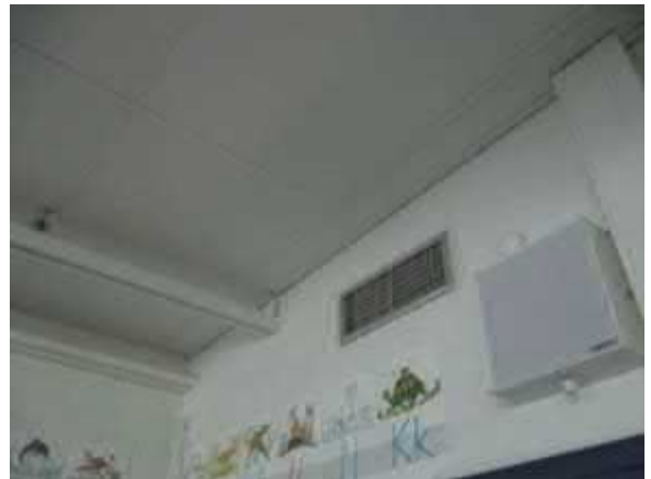
Yksi tuloilmalaite luokkatilassa
