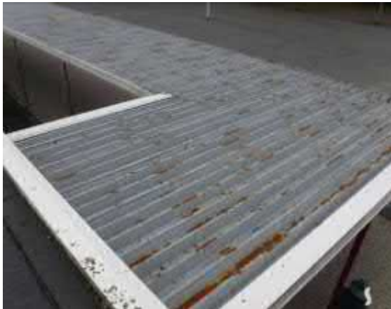
Sisäpihan katosta; profiilipellit ruosteessa
