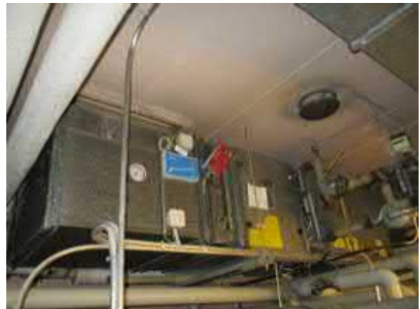
Tuloilmakone lämmönjakuhuoneen katossa
