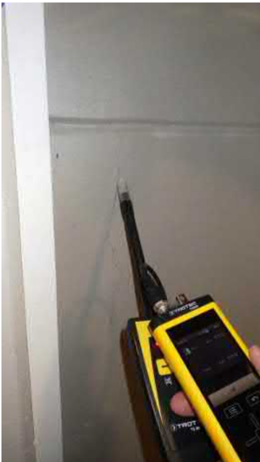
Kuva 21. Ilmavuoto seinän halkeaman kautta.
