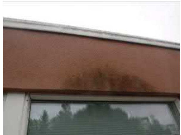
Tummentuma ikkunan yläpuolella
