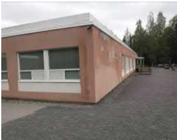
Päädyssä on rappauksessa laajoja vaurioita
