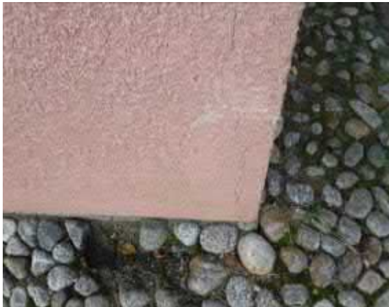
Vaurio rappauksessa rakennuksen ulkonurkalla
