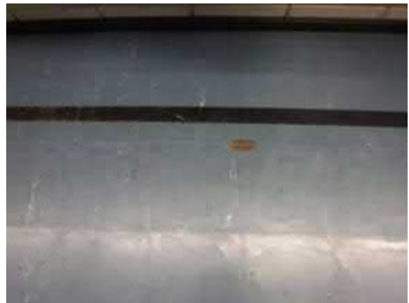
Vanhat vinyylilaatat halkeilevat, osin laatat ovat vaurioituneet
