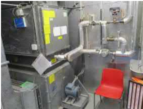
Tuloilmakoneet ovat perusrungoltaan pääosin alkuperäisasennuksia
