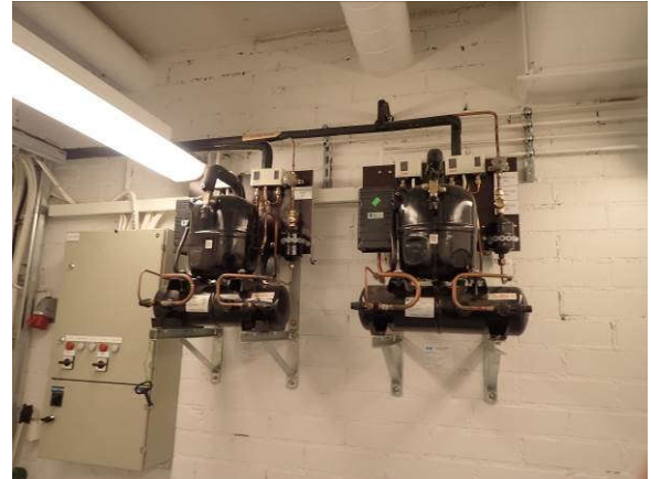
Keittiön kylmiöiden kompressorit
