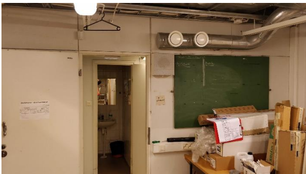
Kuva 3. B-siiven alakerrassa havaittiin sementtilevyä kevyissä väliseinissä.
