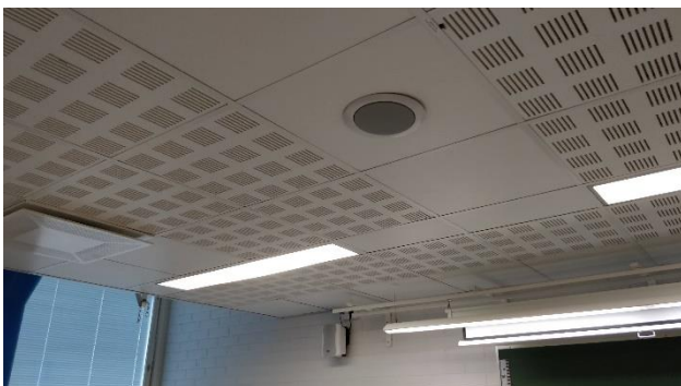
Kuva 15. A-siivessä luokkatilojen katoissa havaittiin alas laskettua kipsilevyä.
