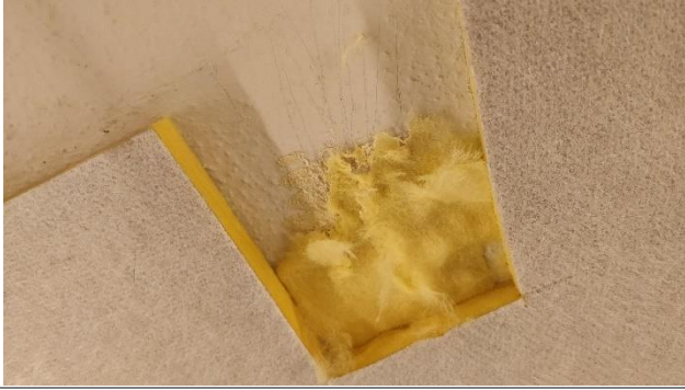
Kuva 1. B-siivessä katoissa havaittiin liimakiinnitteisiä villalevyjä. Mikäli havaitaan laastikiinnitteisiä villalevyjä, tulee niiden asbestipitoisuus kartoittaa ennen purkutöitä.
