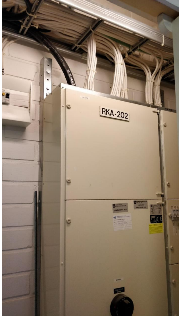
Kuva 14. Sähkötekniikka on pääosin uusittua.
