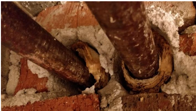
Kuva 5. Tilan b007 katossa havaittiin pahvieristeisiä putkia, joissa pahvin ja putken välissä on vaalea asbestipitoinen huopa.
