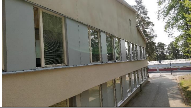
Kuva 18. Julkisivuissa havaittiin maalattua betonia ja uudempaa sementtilevyä. Tilaajalta saadun tiedon perusteella julkisivuja on uusittu 2000-luvulla.
