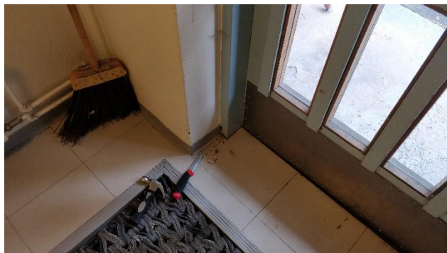
Kuva 12. B-siiven alakerran aulan vinyylilaattojen ja uudemman tasoitteen alla havaittiin mustaa pikiliimaa.
