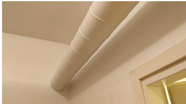
Kuva 6. Rakennuksessa havaittiin peltisiä iv-kanavia.
