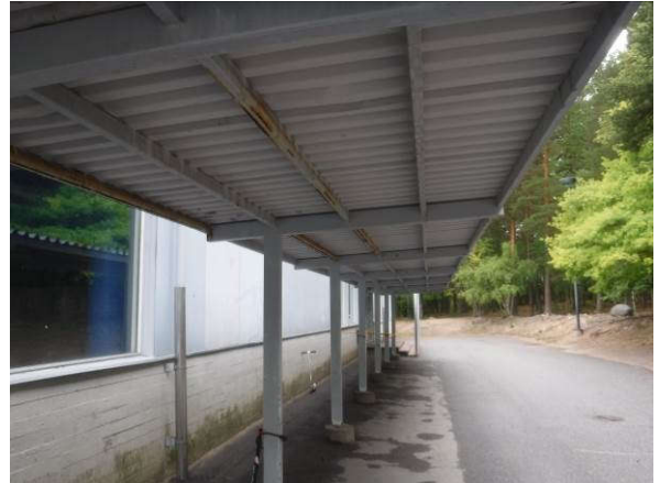
Katoksen teräsosissa korroosiota. Katos kallistuu rakennukseen päin
