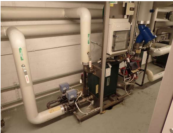
Lämmityksen ja ilmanvaihdon lämmönsiirrin
