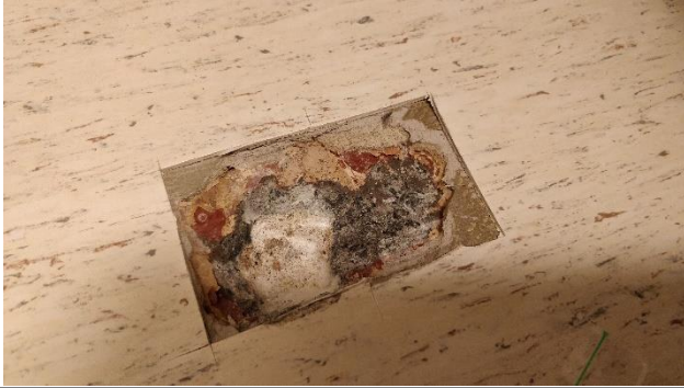
Kuva 7. Lattioissa havaittiin vanhoja tasoitteita uudempien pintamateriaalien alla. Vanhat tasoitteet eivät sisällä asbestia.
