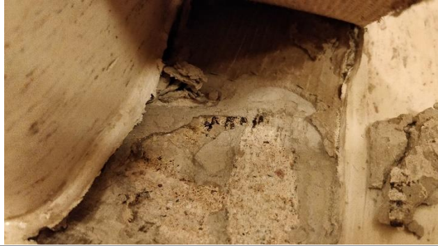
Kuva 8. Lattioiden uudempien pintamateriaalien alla havaittiin paikoitellen asbestipitoista pikiliimaa.
