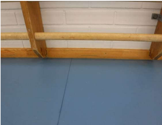
Liikuntasalin lattia ja seinän liittymää; jalkalistaan on asennettu tuuletusrakoja, joista ilmavirtaukset pääsevät lattiapinnoitteen alle
