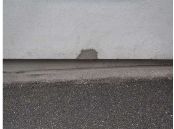
Takasivustalla sokkeli on osin matala. Vaurio julkisivuverhouksessa, joka on korjattu laastilla
