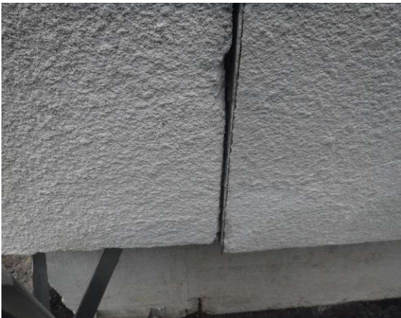
Julkisivussa oleva liikuntasäama
