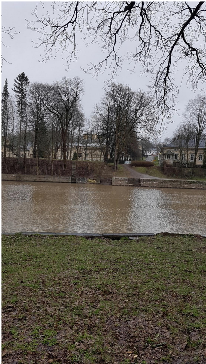
Arkkipiispantalon kohdalla oleva vanha rantamuri 1810-luvulta kuvassa vasemmalla. Oikealla kuvassa uudempi rantamuri, jota on korjattu viimeksi 1980-luvulla.
