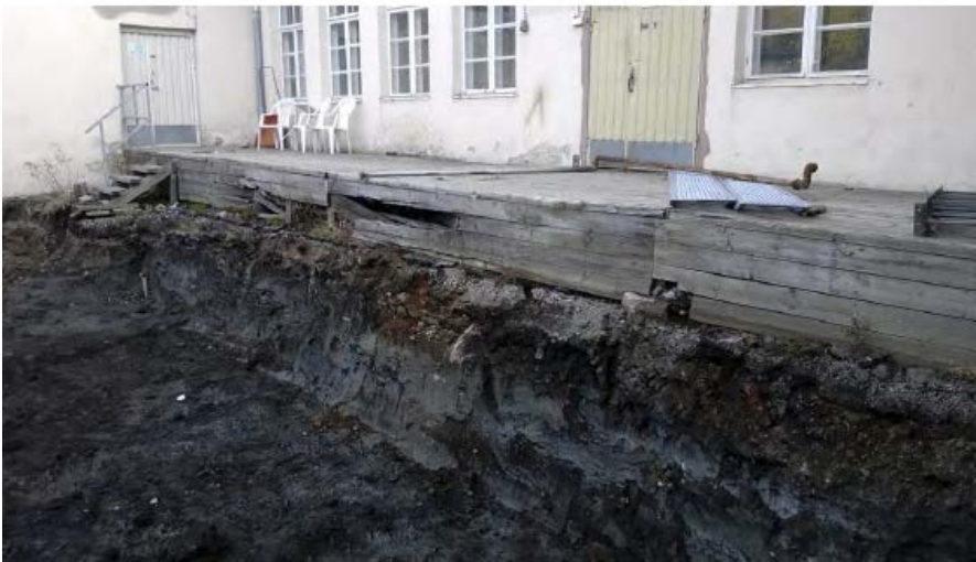
Kuva 2. Myös takapihan lastauslaiturin, joka purettiin, alla oli pilaantunutta maata.
