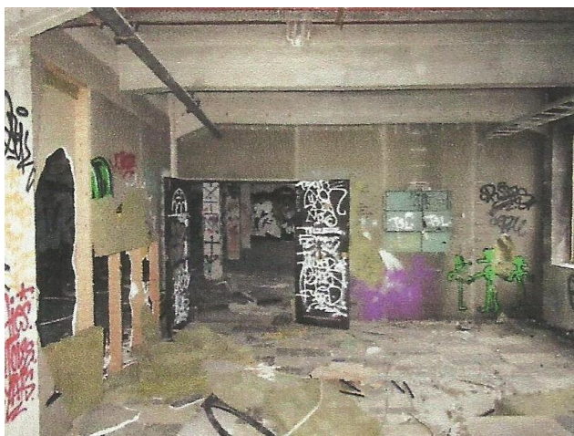
Kuva 11. Osittain rikkoutuneita asbestisementtilevyjä 2 krs:n seinissä. CONTRO Oy , 18.12.2020
