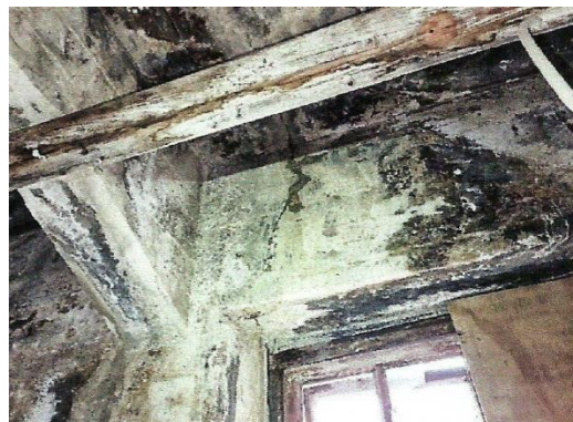
Kuva 9. Kosteus- ja mikrobivaurioita 4 krs:n betoni- ja puurakenteissa. CONTRO Oy , 18.12.2020
