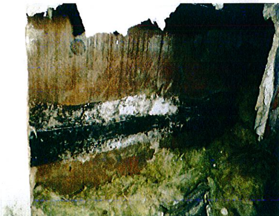
29. Sisäpuolelta ehjän ulkoseinän levytyksen ja eristyksen ala hirsien tilkevälissä kasvustoa
