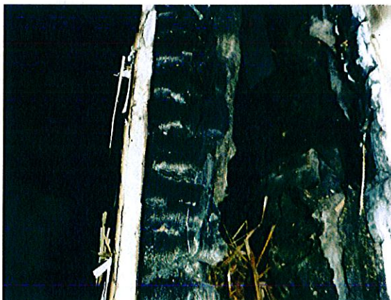
23. As. 9 ulkoseinän lisäeristyksen koolaus ikkunan pielessä. Palo levinnyt villan ja hirsiseinän välissä, kipsilevy päällä täysin ehjä.
