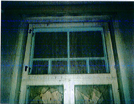
15. As. 5 ikkuna, karmit kastuneet, noki ja sammutusveden jälkiä
