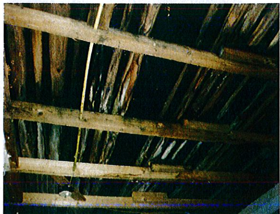
18. As. 7 huoneen katto kastunut, kasvustoa
