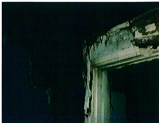
24. As. 9 huoneen väliseinä, palo levinnyt levytyksen ilmaraossa.
