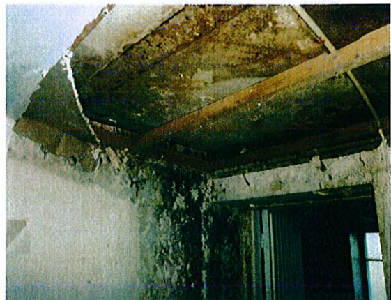
12. Pyykkituvan eteisen katto, betonilaatta ja kipsilevyt kastuneita, ratakiskon laipat ruosteessa, seinässä kasvustoa
