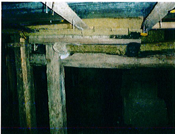
11. As. 10 KPH:n alapuolella lattia painunut, puupilareiden alapääät lahoja, kivipilareiden päällä olevat graniittiportaatt kallistuneet
