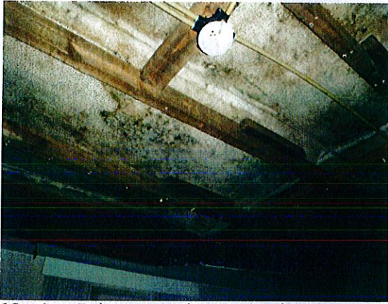
13. As. 5 huoneen katto, koolauksen alla vanha kattoverhous, märkää ja kasvustoa
