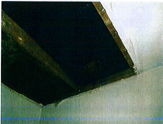
17. As. 7 eteisen katto, palo levinnyt villan ja aluslaudoituksen välissä
