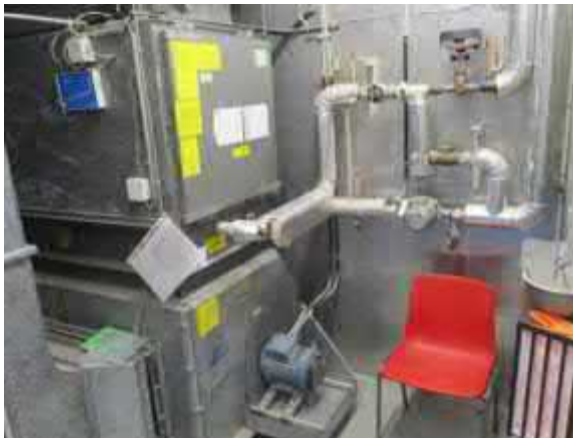
Tuloilmakoneet ovat perusrungoltaan pääosin alkuperäisasennuksia
