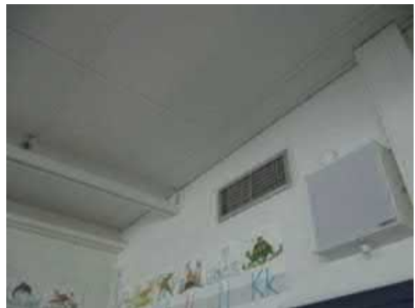
Yksi tuloilmalaite luokkatilassa
