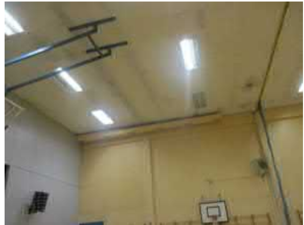
Ilmanvaihtolaitteita liikuntasalin katon rajassa
