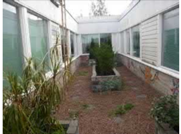
Rakennuksen keskellä on pieni sisäpiha, jossa sokkeli on korkeampi. Kattosaneerauksen yhteydessä sisäpiha voidaan kattaa, jolloin rakenteet saadaan sääsuojaan
