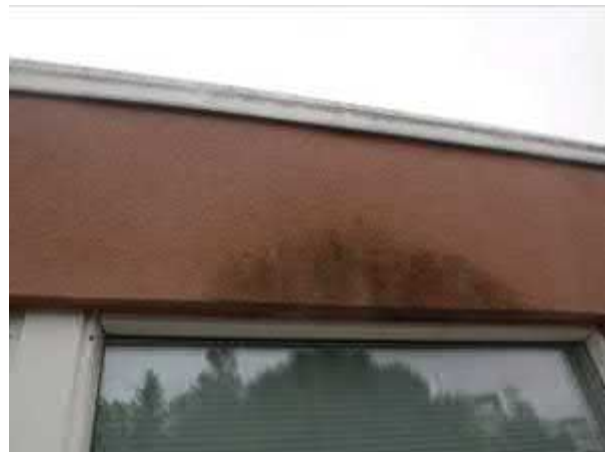
Tummentuma ikkunan yläpuolella
