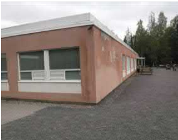
Päädyssä on rappauksessa laajoja vaurioita
