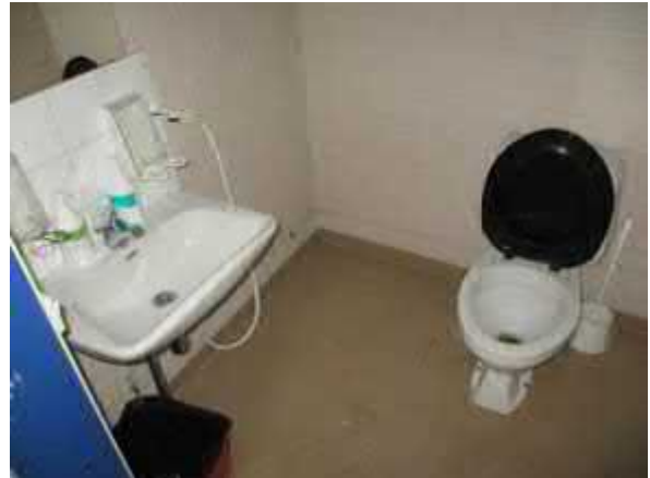
Vesi- ja viemärikalustusta
