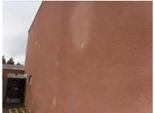
Liikuntahallin julkisivun vaurioita
