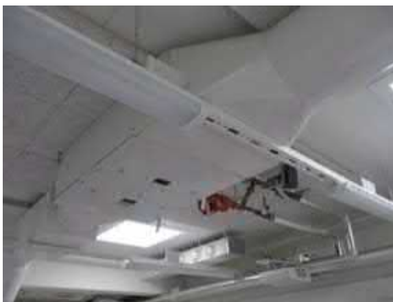
Tuloilmakone käsityöluokan katossa
