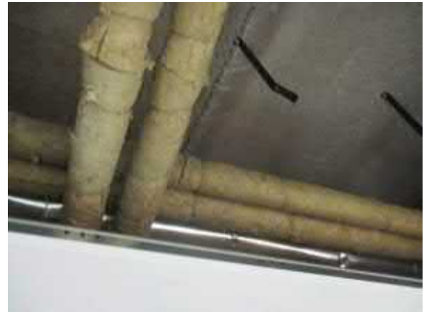
Vesijohtoja alas lasketun käytäväkaton suojassa
