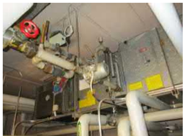
Tuloilmakoneen (TK01) patterin säätöryhmä
