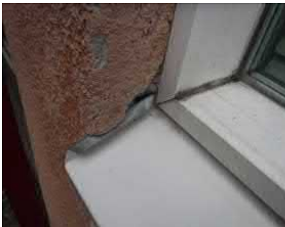
Ikkunan vesipellin liittyminen rappaukseen; paikallinen epätiiviyiskohta
