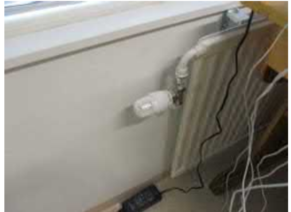
Patteriventtiileitä on osin uusittu 2000-luvulla
