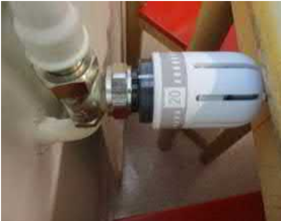
Patteriventtiilit ovat pääosin 1990-luvun alkupuolelta
