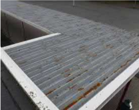
Sisäpihan katosta; profiilipellit ruosteessa
