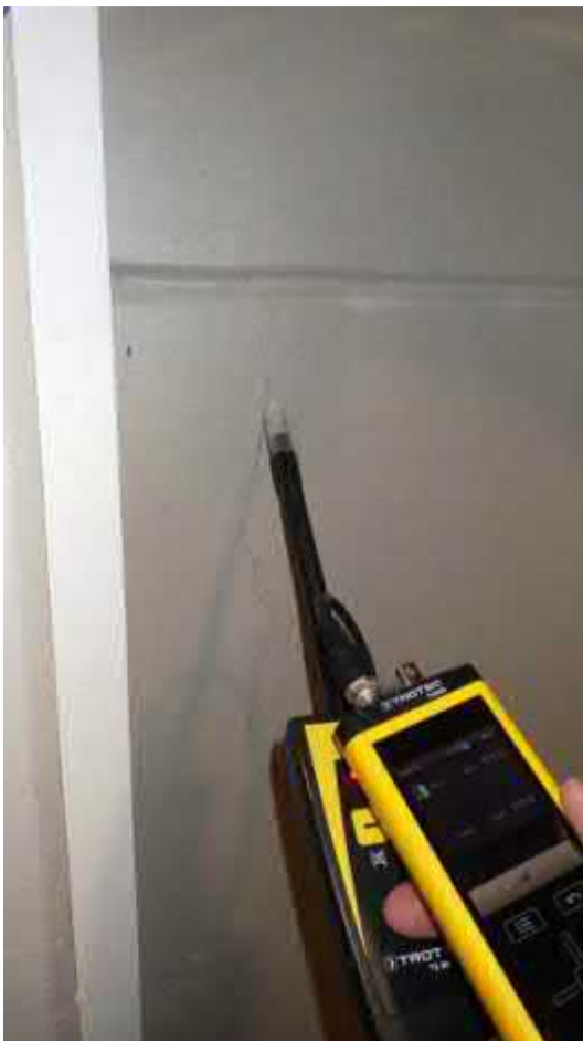
Kuva 21. Ilmavuoto seinän halkeaman kautta.
