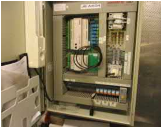
VAK-kaappi yhden IV-konehuoneen seinällä
