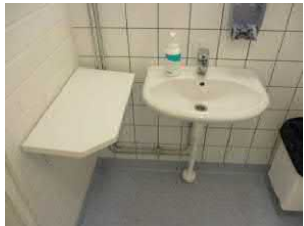
Vesi- ja viemärikalustusta
