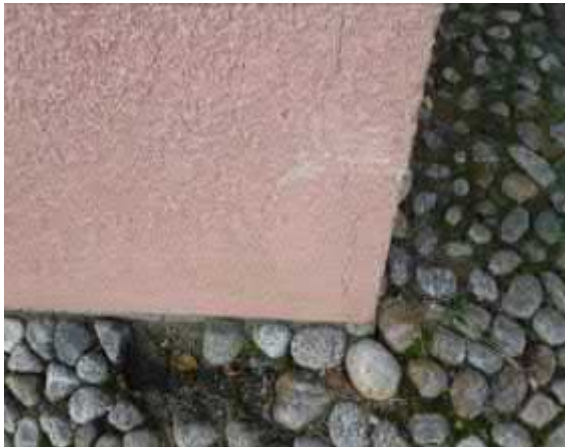
Vaurio rappauksessa rakennuksen ulkonurkalla
