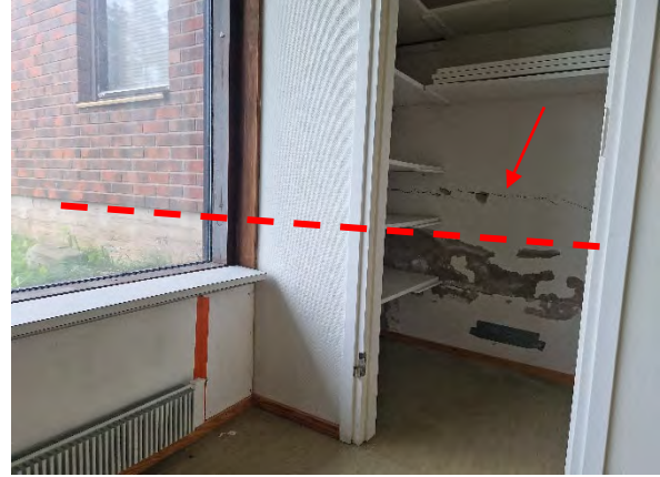
Kuva 104. Toisessa kerroksessa tilan 111 ja huoneistosauunan välisessä osastoivassa seinässä on halkeamia (nuoli) asuinhuoneiston lattiapinnan (katkoviiva) yläpuolella. Kosteuden aiheuttama pinnoitevaurio on kanaalirakenteen kohdalla.
