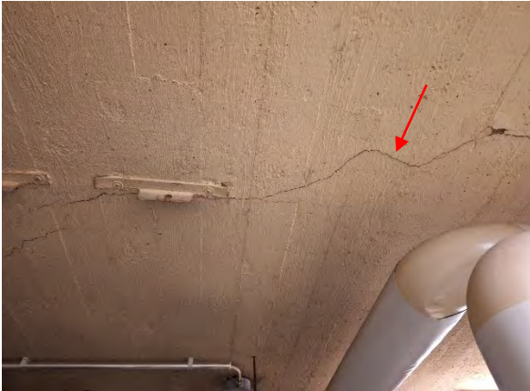
Kuva 113. Välipohjassa on halkeama lämpökeskuksessa.
