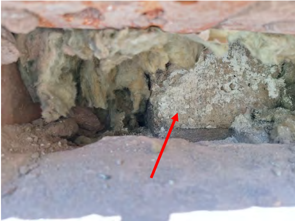
Kuva 86. Pohjalaatta erottuu villan takaa. Betonissa on selkeää kalkkihärmettymistä (nuoli). Kuva rakennuksen ulkonurkasta.
