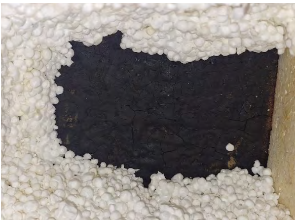
Kuva 34. Rakenteessa on mureneva vedeneristeenä käytetty bitumisively.
