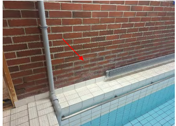
Kuva 110. Seinän alaosassa on todennäköisesti kalkkihärmettä, joka erottuu erityisesti lämmityspatterin kohdalla.
