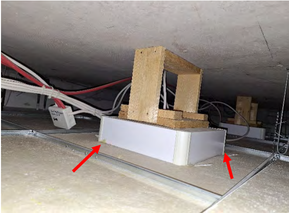
Kuva 180. Akustiikkalevyihin tehtyjen leikkausten kohdalla on näkyvissä mineraalivillaa.
