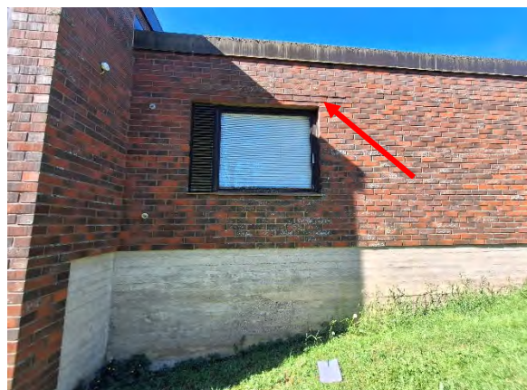
Kuva 44. Ikkunan ylityspalkin saumat irtoilevat.
