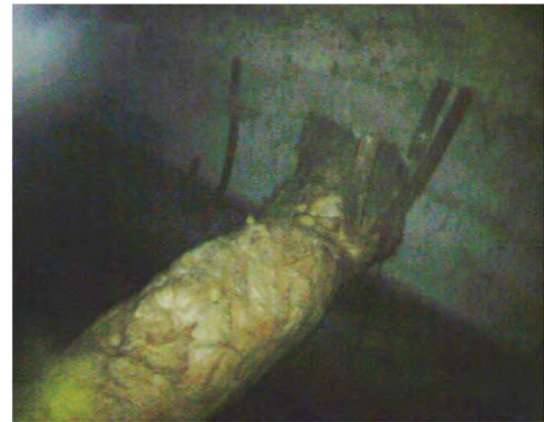
Kuva 157. Kanaalin sisällä on villaeristeisiä putkia.
