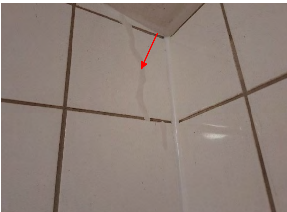
Kuva 111. Märkätilan laatoitus on haljennut ja paikattu.
