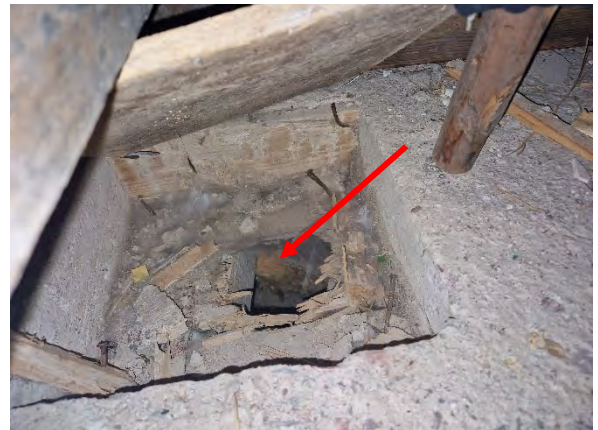
Kuva 116. Kanaalitalan sisäpuolella on ainakin paikallisesti lämmöneristevillaa (nuoli) ja muottilaudoitukset.
