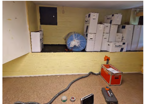
Kuva 124. Betonirakenteisen kanaalitalan savukokeessa havaittiin vuotokohtia vain yläosan aukkojen osalta, SK1, tila 004.
