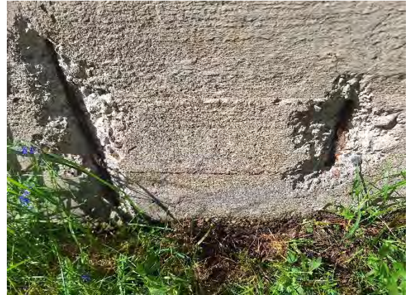
Kuva 48. Sokkeleissa ja maanvastaisissa seinissä on teräskorroosiovaurioita.
