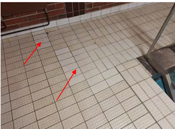
Kuva 12. Uima-allastilan laatoituksia on uusittu paikoin. Uima-allastilan alapohjassa havaittiin kosteuspoikkeama-alueita.
