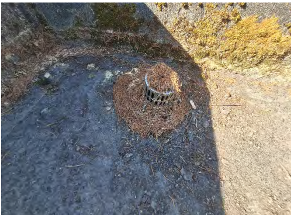
Kuva 166. Kattokaivon ympärille on kertynyt runsaasti vedenpoistoa heikentäviä epäpuhtauksia.
