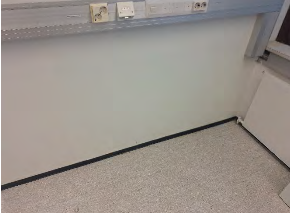
Kuva 97. Ulkoseinän ja alapohjan liittymässä ei havaittu vuotoa normaalissa käyttöolosuhteessa. MAK1.1 tila 120 hammaslääkäri.
