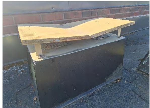
Kuva 173. Huoneiston vesikatolla oleva hormin pelti on taitunut.
