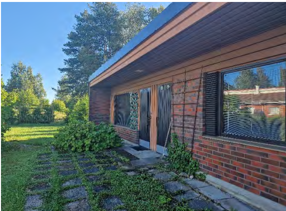
Kuva 194. Asuinhuoneiston edustan laatoituksessa on routanousun aiheuttamia vaurioita.
