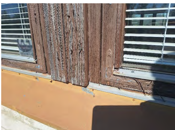
Kuva 45. Ikkunat ovat alkuperäiset ja huonokuntoiset.
