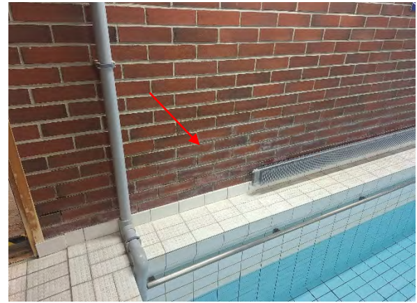
Kuva 144. Seinän toisella puolella on kalkkihärmettä, joka viittaa kosteuden kapillaariseen nousuun tai veden roiskumiseen seinälle ja kuivumiseen lämmityspatterin kohdalta.
