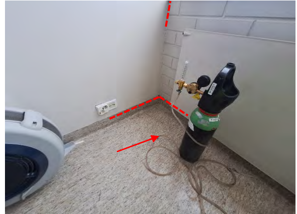
Kuva 37. Alapohjan ja ulkoseinien liittymässä on vähäistä ilmavuotoa. Kaasu syötettiin nuolen osoittamasta kohdasta. MAK5 tila 023 kerhuhuone, 1. krs.
