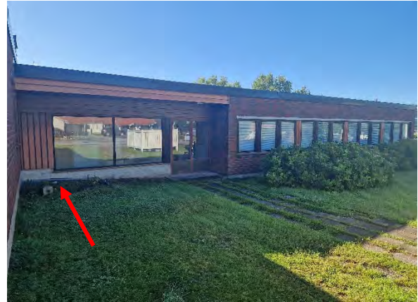
Kuva 193. Maanpinta on tasainen ja yleisesti lähellä lattiapintaa. Nuolen kohdalla maanpinta on lattiapintaa korkeammalla.
