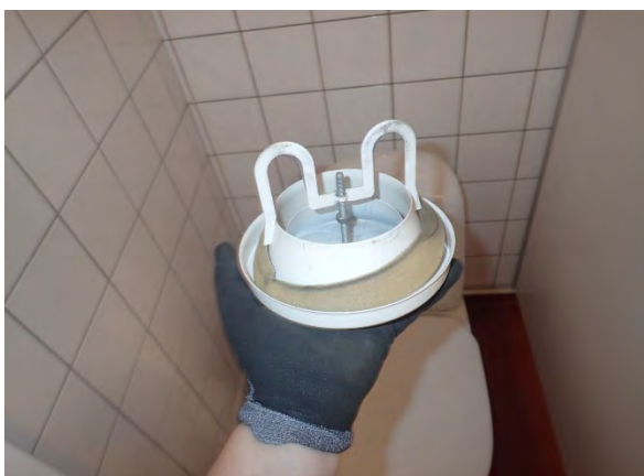
Kuva 202. Poistoilmapäätelaitteen säätö oli lukitsematta.
