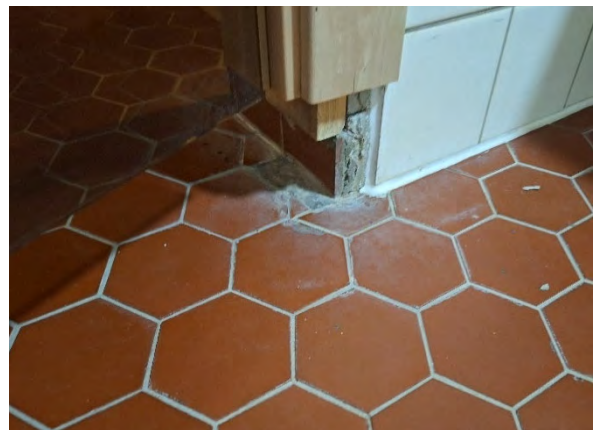
Kuva 112. Saunan ovenkarmin alta puuttuu laatta. Vedeneristettä ei ole.
