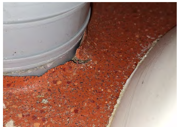
Kuva 13. Muovimatto on vaurioitunut WC-istuimen viemäriiliittymän kohdalta vanhan nuorisotilan 004 wc-tilassa.
