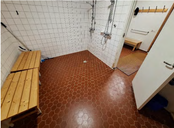
Kuva 8. Miestenpuolen mökkätila on todennäköisesti alkuperäinen. Lattiasa havaittiin selkeitä kosteuspoikkeama-alueita myös vähemmän kosteusrasitetuilla alueilla.
