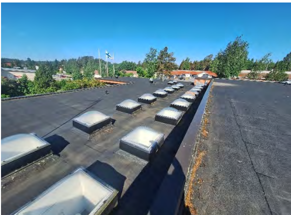
Kuva 172. Rakennuksessa on useita kattoikkunoita. Yläpohjan tarkastusluukkuja ei ole.
