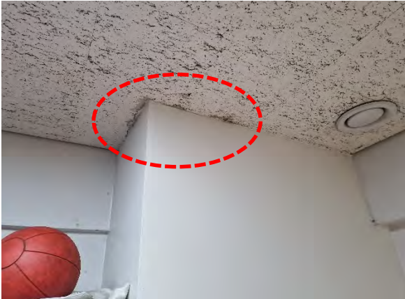
Kuva 119. Kattoon on liimattu Sordino-tyyppisiä akustiikkalevyjä. Tilan 137 hormikotelon kohdalla on vesivuotojälkiä.
