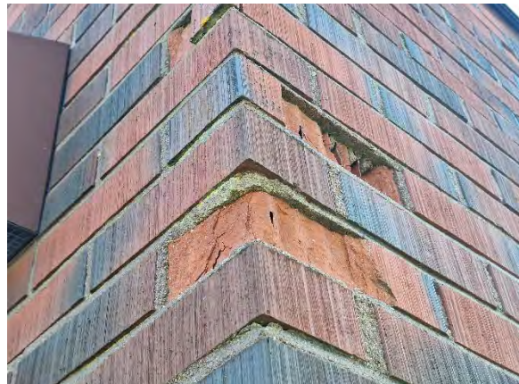
Kuva 42. Vastaavia vaurioita on eri puolilla rakennusta.
