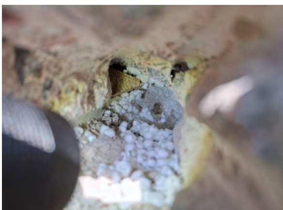
Kuva 59. Rakenteen sisällä oli puuta, jota on todennäköisesti käytetty ikkunan kiinnityspisteen kohdalla.
