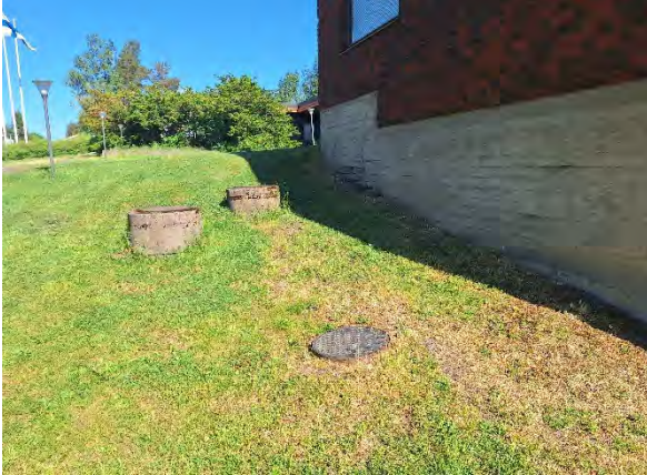
Kuva 188. Rakennuksen vieressä on kolme viemäreiden tarkastuskaivoa.
