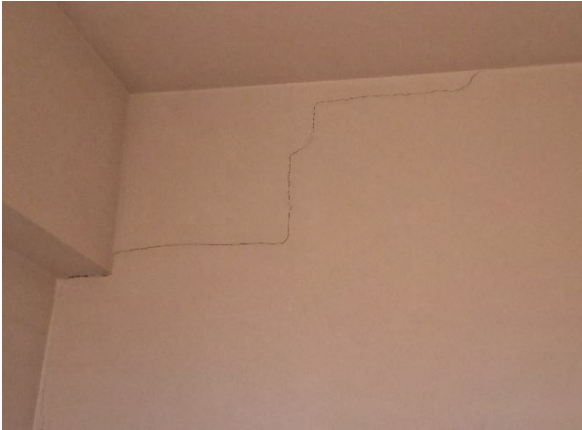
Kuva 107. Halkeama WC:n seinässä.
