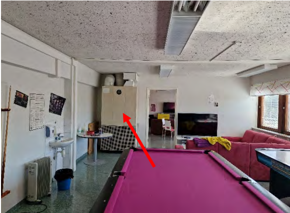
Kuva 204. Ryhmähuoneessa 152 on tilakohtainen TK04-ilmanvaihtokone.
