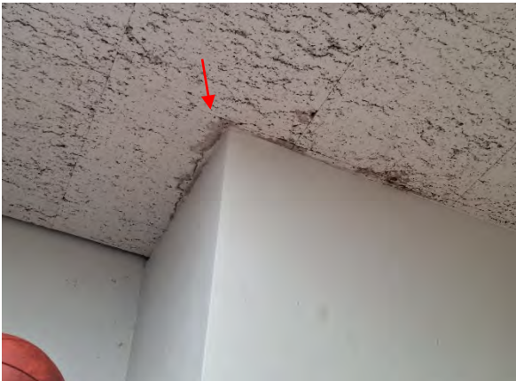
Kuva 176. Sisäkatoissa on vuotojälkiä koteloinnin kohdalla.
