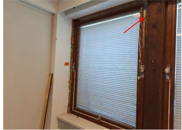
Kuva 96. Ikkunaa oli tiivistetty teippaamalla sisäpuolelta (nuoli). Rakenneavauskohta vasemmalla.
