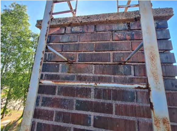
Kuva 174. Piipun yläosan muuraussaumat ovat vaurioituneet todennäköisesti pakkasrapauman seurauksena.
