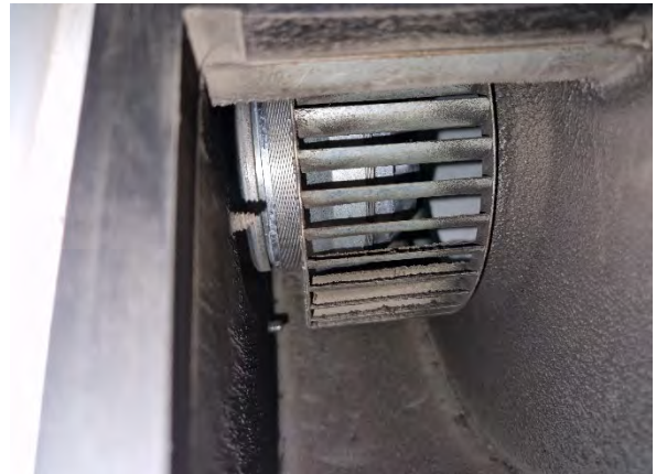
Kuva 199. TK10 tuloilmapuhaltimessa oli hiukan likaa.
