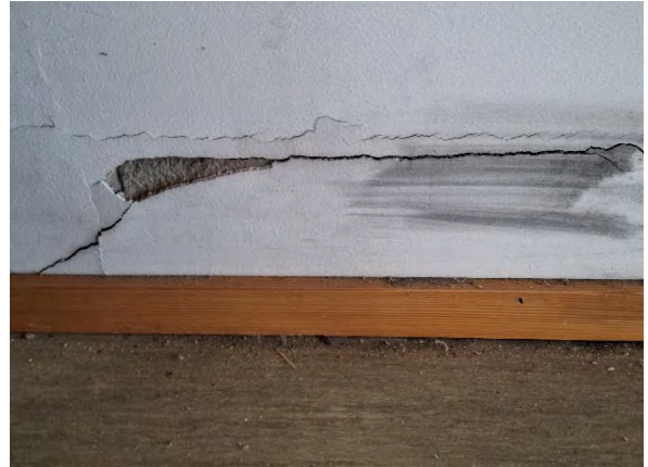
Kuva 108. Tiilirakenteisen väliseinän tasoitekerrokset ovat irronneet seinän alaosasta.
