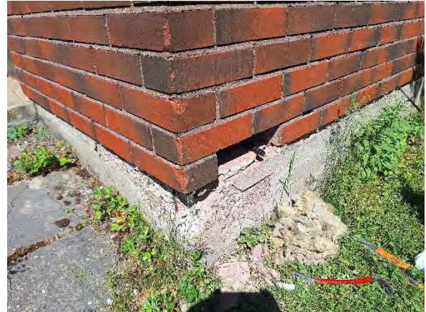
Kuva 87. Avaus tehtiin voimakkaasti vaurioituneen sokkelin yläpuolelle.
