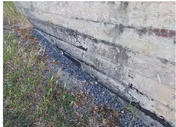
Kuva 195. Perusmuurin ulkopuolella on kermiä.
