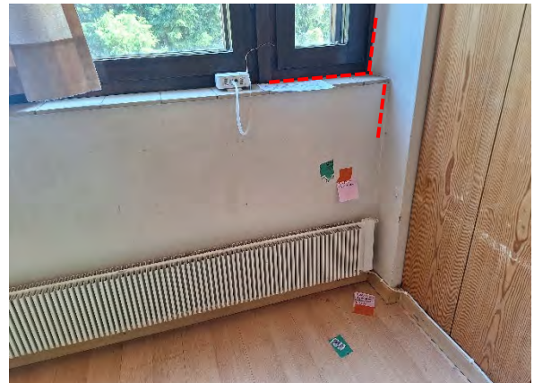
Kuva 100. Ikkunaliittymissä ja pilariliittymässä, on vähäistä ilmvuotoa normaalissa käyttöolosuhteessa. MAK3 tila 136 sali.
