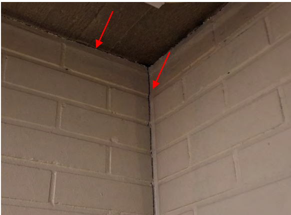
Kuva 105. Ensimmäisessä kerroksessa lämpökeskuksen väliseinien ja välipohjan liittymät eivät ole tiiviitä.
