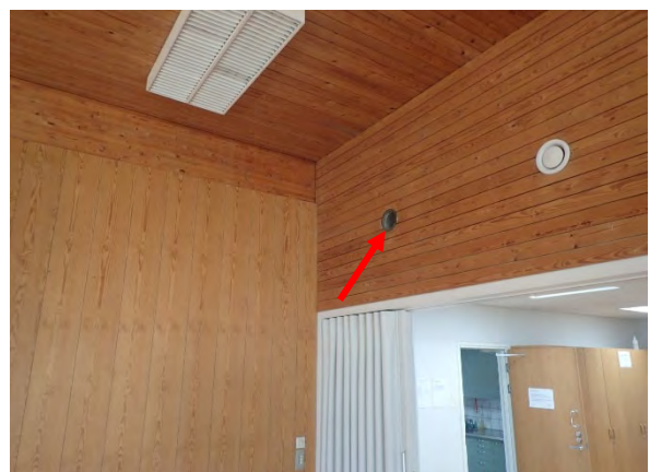
Kuva 203. Juhlasalitilan yhden poistoilmapäätelaitteen säätölautanen puuttui.
