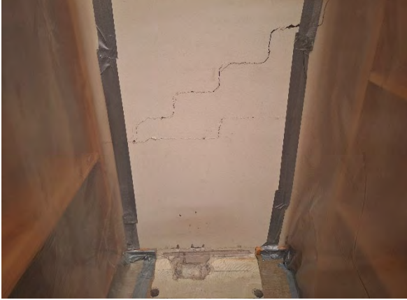
Kuva 103. Ensimmäisessä kerroksessa varaston ja teknisen tilan välisessä osastoivassa seinässä on painumaan viittaavia halkeamia.
