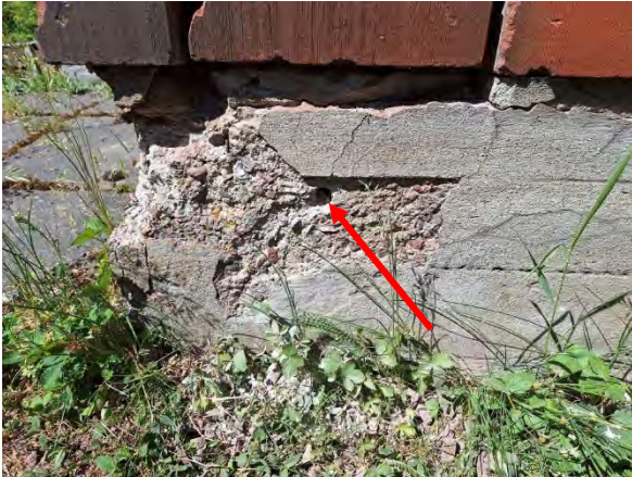
Kuva 89. Sokkeli on voimakkaasti rapautunut rakenneavauskohdassa.
