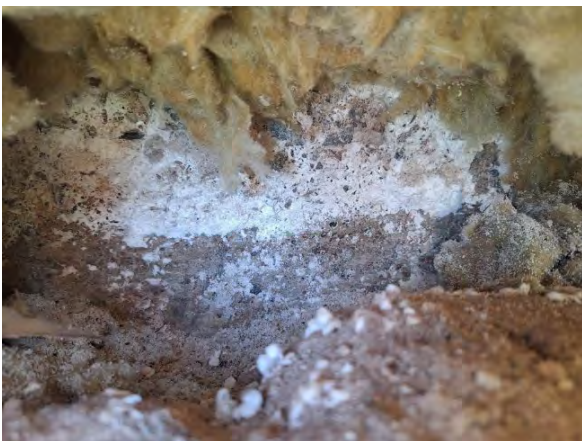
Kuva 82. Mineraalivillan takana on betoni, jossa on voimakasta härmettymistä ja kosteuspoikkeama-alueita. Ulkoverhouksen takana ei ole tuuletusväliä.
