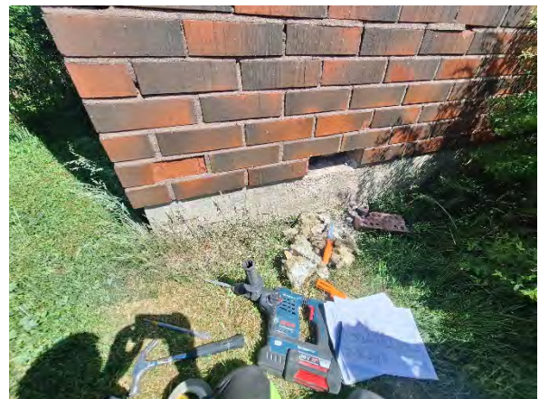
Kuva 83. Avaus tehtiin ulkoseinän alaosaan. Sokkelissa oli rapaamaa ja ulkoseinällä on kasvillisuutta.
