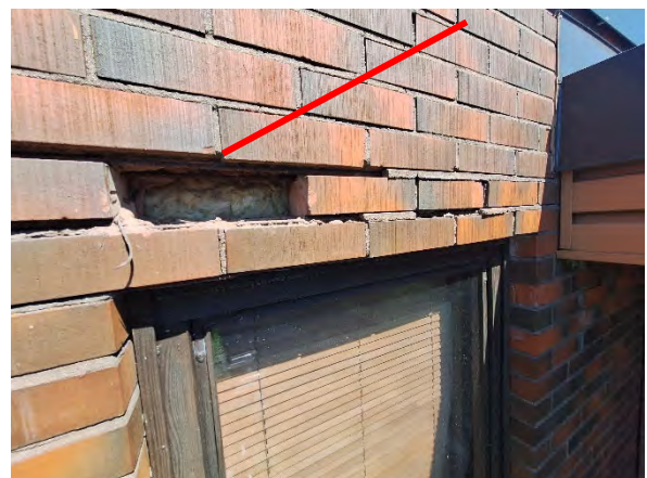
Kuva 80. Avaus tehtiin ikkunan yläpuolelle kohtaan, jossa muuraussaumot olivat voimakkaasti rapautuneet. Palkin yläpuolisessa seinässä vinohalkeamaa.
