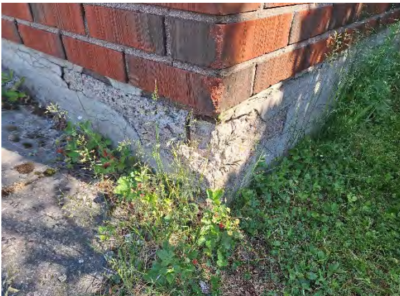
Kuva 49. Merkittävä rapauma- ja teräskorroosiovaurio sokkelissa.
