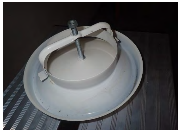
Kuva 201. Tuloilmapäätelaitteen säätö oli lukitsematta.
