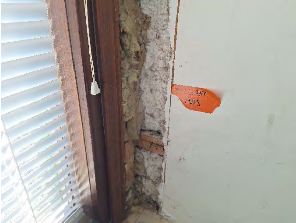
Kuva 91. Rakenneavaus IKK1. Ikkunan ja ulkoseinän välissä on ~50 mm mineraalivillaa, lyhyet apukarmit ja paikoin ilmansulkupaperinpalasia.
