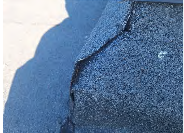
Kuva 169. Bitumikermin limitykset ovat paikoin auki.
