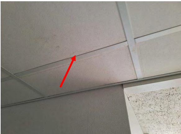
Kuva 182. Alakattojen akustiikkalevytyksessä on vanhoja vuotojälkiä.
