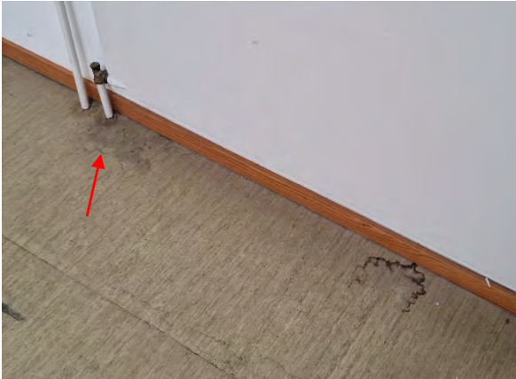
Kuva 14. Lämmityspatteri on mahdollisesti vuotanut lattialle tilassa 134 varasto. Lattiassa on myös toinen kosteusjälki, jonka aiheuttaja ei ole tiedossa.
