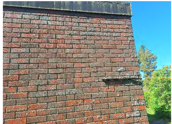
Kuva 50. Tiiliverhouksessa on jäkälää. Vesi on valunut pellitykseltä ulkoseinälle.
