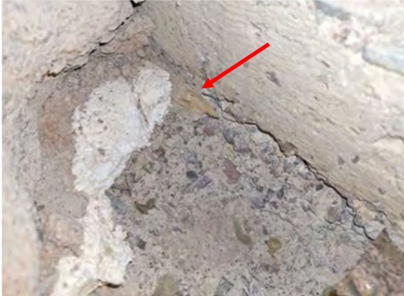
Kuva 129. Ulkoseinän vierustalla lattiarakenteessa on rakennusaikaisen muotin puukappale.
