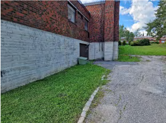
Kuva 192. Maanpinta on tasainen rakennuksen vierustalla. Nurmikkoa ei ole erotettu sepelikaistalla ulkoseinästä.
