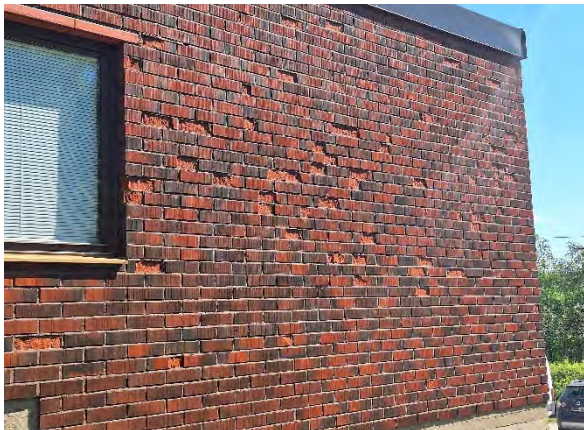
Kuva 41. Tiiliverhouksessa on merkittäviä, todennäköisesti pakkasrapauman aiheuttamia vaurioita.
