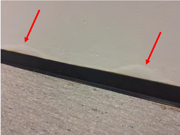
Kuva 84. Seinässä johon US 8 rakenneavaus tehtiin, on kapillaarisen kosteuden aiheuttamia pinnoitevaurioita seinän sisäpuolella. Kosteus on aiheuttanut vaurioita 100...400 mm korkeudelle lattiapinnasta mitattuna.
