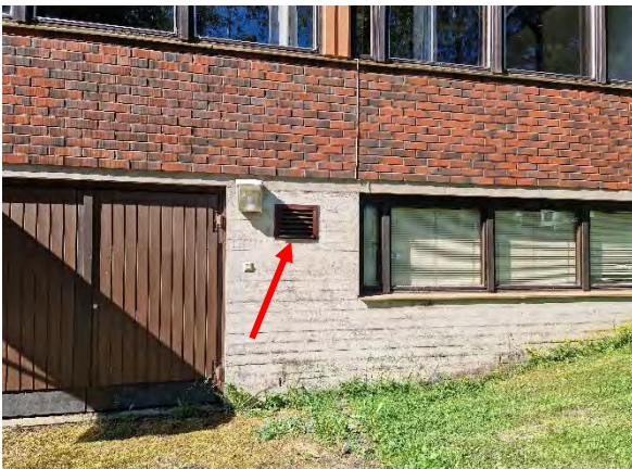
Kuva 196. Tuloilmanotto on sijoitettu talon seinustalle.
