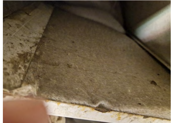
Kuva 211. TK09-poistoilmasuodatin on likainen.
