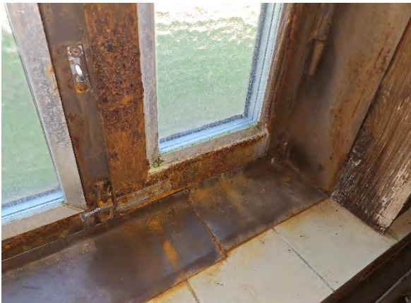
Kuva 55. Uima-allastilan ikkunassa on korroosiovaurioita.
