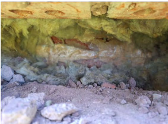
Kuva 76. Lämmöneristeen sisäpuolella on huonokuntoinen muovikalvo.
