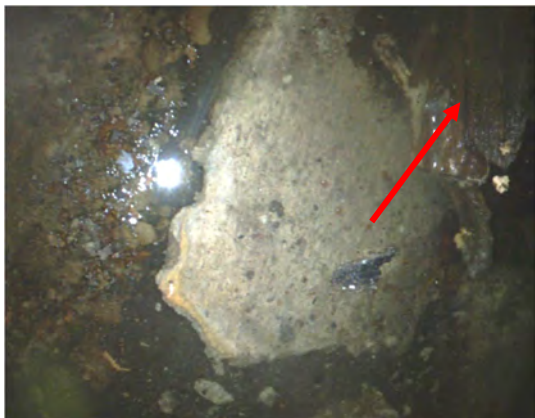
Kuva 158. Kanaalissa oleva maaperä on havaintojen perusteella arvioituna märkää. Lisäksi kanaalillassa on lahoamistilassa olevia puuosia.
