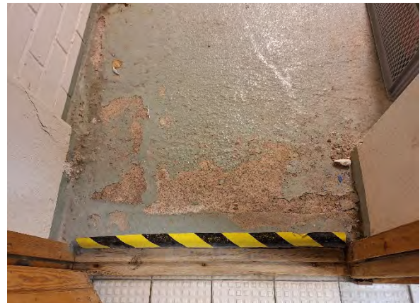
Kuva 11. Uima-allashuoneen ja nuorisotilan välisessä tilassa 005 havaittiin kosteuspoikkeama-alueita ja laajaa pinnon irtoilua alapohjassa.
