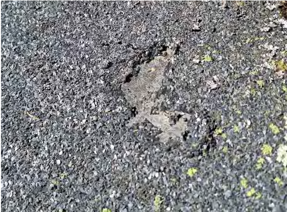
Kuva 168. Bitumikermissä on yksittäisiä vaurioita.
