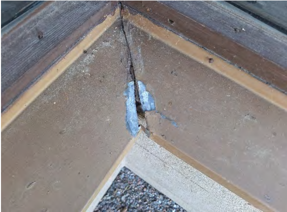
Kuva 53. Ikkunapellitykset ovat osin epätiivitä.
