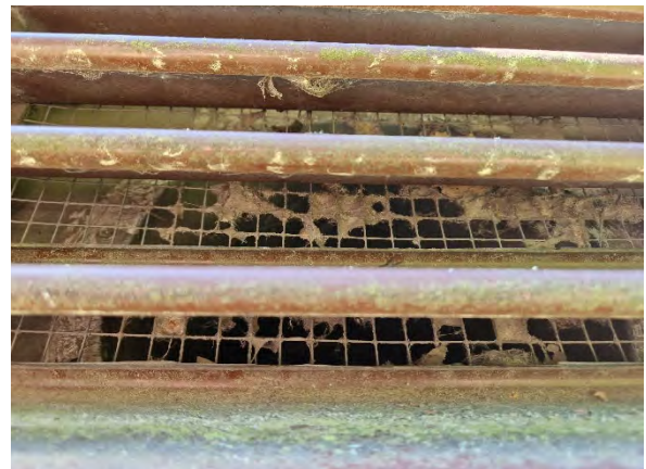
Kuva 197. Tuloilmanottoritilä oli osittain lian ja lehtien peittämä.
