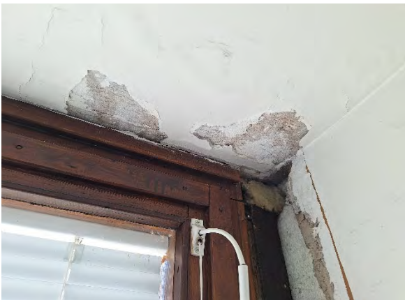
Kuva 93. Rakenneavauskohdan yläpuolella oli selkeitä viitteitä kosteusvauriosta.
