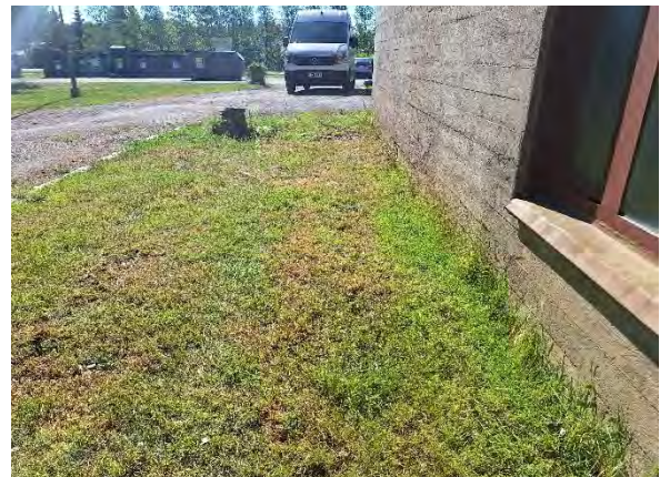
Kuva 191. Maanpinta on tasainen rakennuksen vierustalla. Nurmikkoa ei ole erotettu sepelikaistalla ulkoseinästä.
