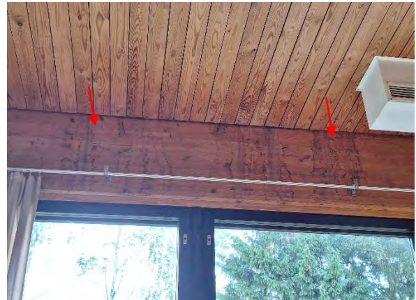
Kuva 177. Liimapuupalkissa on merkittäviä vuotojälkiä.
