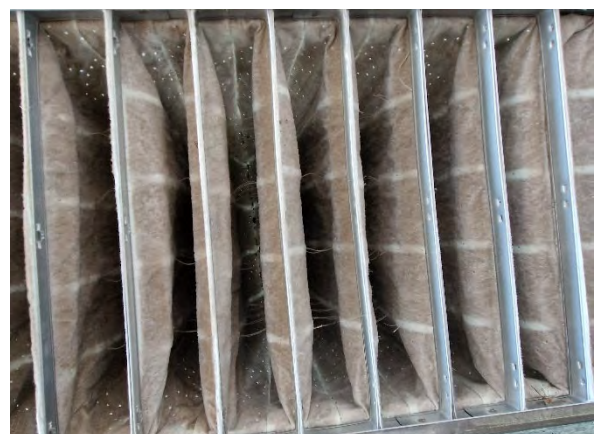
Kuva 209. TK04-poistoilmasuodattimissa havaittiin jonkin verran likaa.
