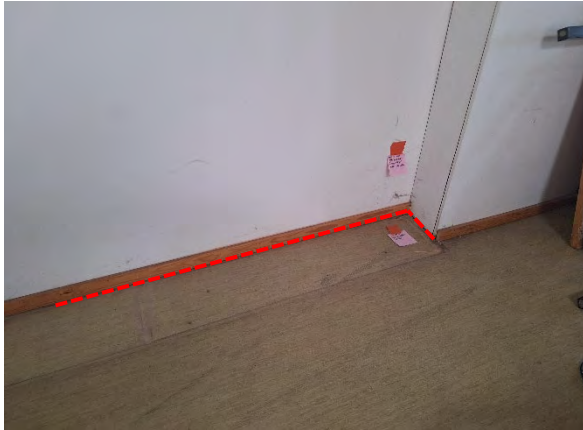
Kuva 36. Huoneistoon rajautuvan osastoivan seinän ja alapohjan liittymässä on merkittävää ilmavuotoa. MAK2 tila 135 kirjasto, 2. krs.
