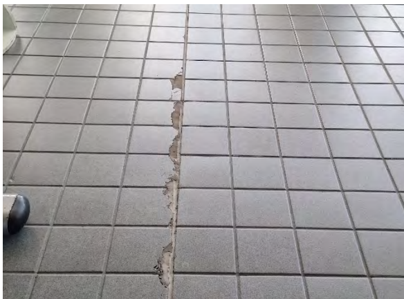
Kuva 6. Kuntosalissa on klinkkerilaatoitus, joka on vaurioitunut todennäköisesti joko tilojen käytön yhteydessä tai se voi olla rakenteiden liikkeistä johtuvaa.
