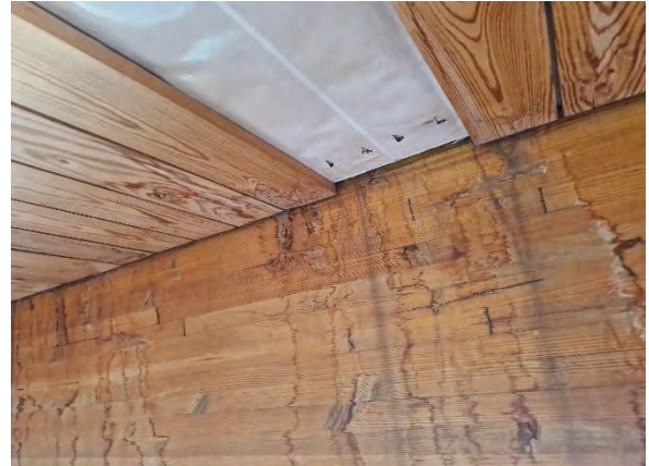
Kuva 185. Rakenneavauksen kohdalla olevan liimapuupal- kin pinnassa on runsasta vuotojälkeä.
