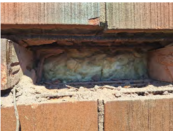
Kuva 79. Mineraalivillan ja ulkoverhouksen välissä ei ole tuuletusväliä.
