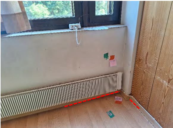
Kuva 123. Välipohjan ja ulkoseinän liittymässä sekä välipohjan ja väliseinän liittymässä on ilmavuotoa. MAK4 tila 136 sali.
