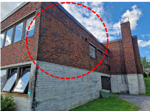
Kuva 51. Tiilimuurauksen pinnalla on vedenvalumajälkiä.
