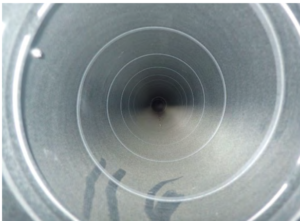
Kuva 200. Ilmanvaihtokanavat ovat puhdistuksen tarpeessa.
