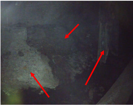
Kuva 148. Lahoamistilassa olevaa muottilaudoitusta. Kanaalin pohjalla on betonia ja ilmeisesti kalliopinta betonin seinärakenteen vierellä.
