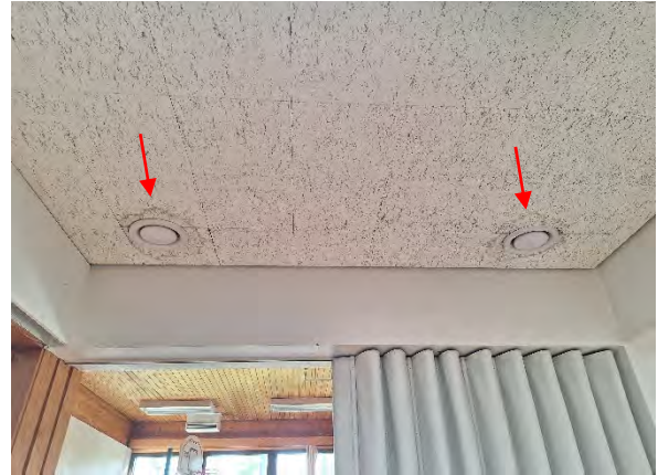
Kuva 175. Poistoilmaventtiilien ympärillä on kosteuden aiheuttamia jälkiä.
