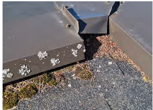
Kuva 167. Katolla on havuja ja sammaloitumista, jotka hidastavat bitumikermin kuivumista.
