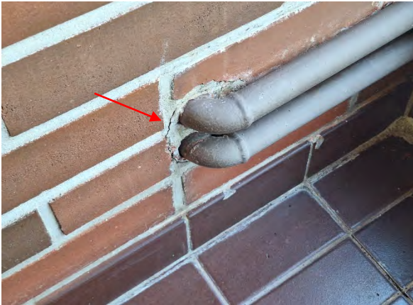
Kuva 109. Putkiläpiviennit eivät ole tiiviitä.
