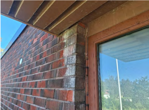
Kuva 47. Katos on vuotanut seinälle oviliittymän kohdalta.
