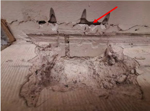
Kuva 140. Seinän alaosan tasoitekerrokset ovat vaurioituneet.
