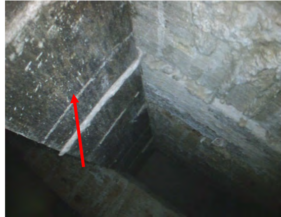
Kuva 147. Muottilaudoituksissa esiintyy mikrobivaurioitumista.
