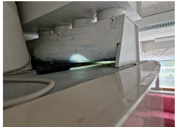
Kuva 207. TK04 iv-koneen poistoilmanvaihto on jaettu palvelemaan tiloja 151 ja 152.
