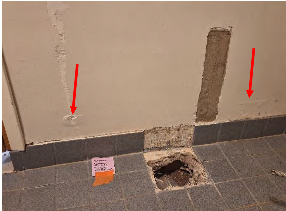
Kuva 138. Seinän alaosan tasoitekerrokset ovat vaurioituneet.
