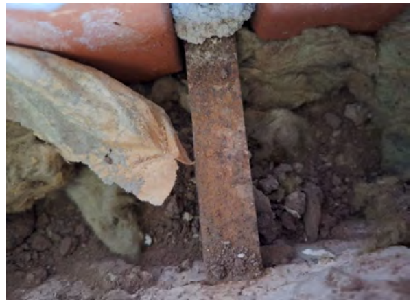
Kuva 77. Muuraussiteessä on korroosiota.
