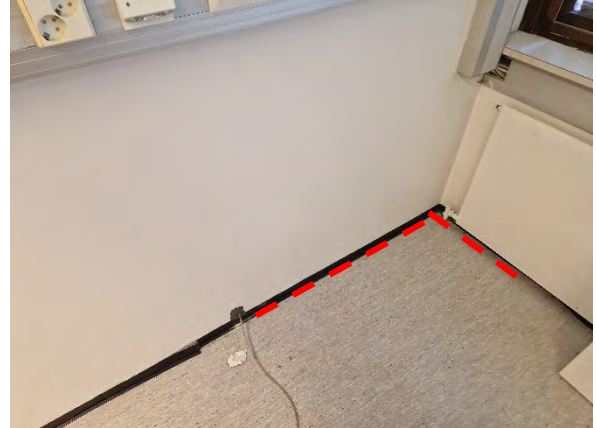
Kuva 98. Ulkoseinän ja alapohjan liittymässä havaittiin suurta vuotoa alipaineistettuna (-10 Pa). MAK 1.2 tila 120 hammaslääkäri.
