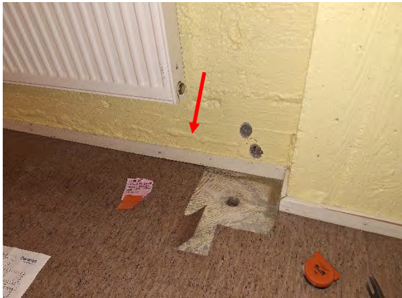
Kuva 143. Seinän alaosassa on kosteuden kapillaariseen nousuun viittaavia vaurioita.
