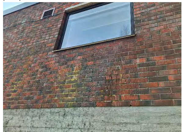
Kuva 52. Seinässä on orgaanisia epäpuhtauksia, jotka hidastavat julkisivun kuivumista.
