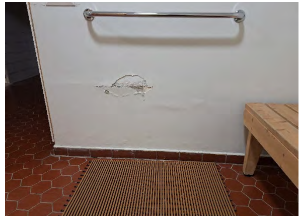
Kuva 106. Kosteuden kapillaariseen nousuun viittaavia vaurioita 1.krs märkätilan väliseinässä.
