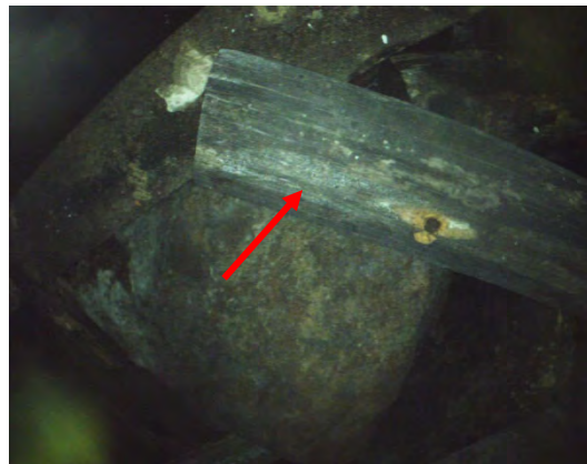
Kuva 159. Kanaalillassa olevat puurakenteet ovat aistinvaraisesti arvioituna mikrobivaurioituneita.
