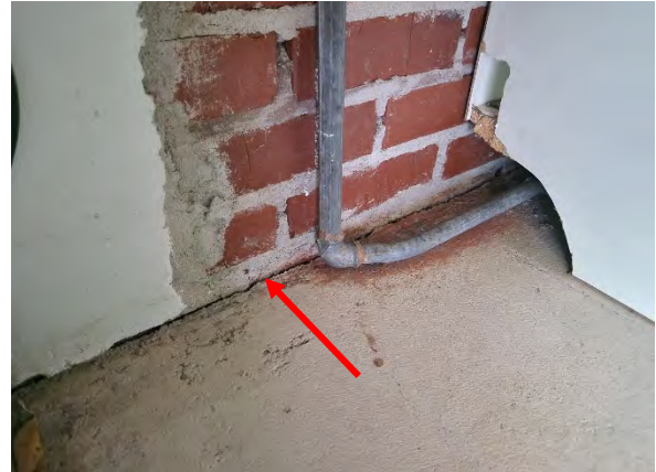
Kuva 15. Asuinhuoneiston pintalaatan ja kirjaston vastaisen väliseinän kohdalla on avoin rako.
