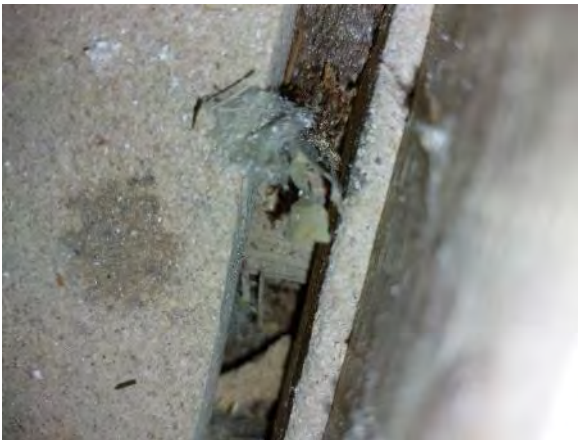
Kuva 269. Rakenneavaus VS3: Alapohjarakenteeseen ulottuva rako havaittiin väliseinän alapuolella.
