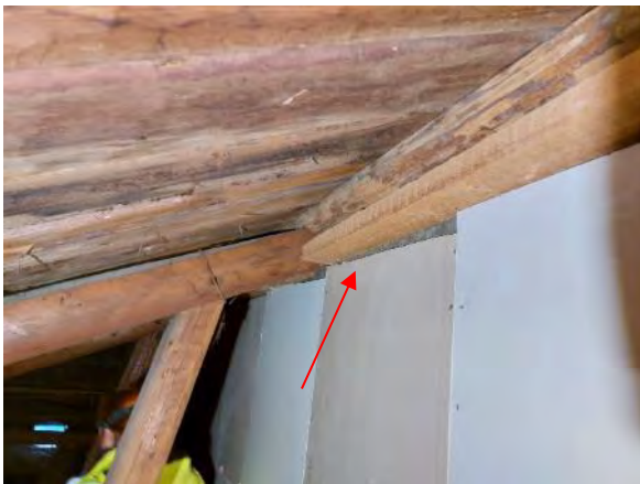
Kuva 292. Rakennuksen toisen kerroksen yläpohjan tuulettuminen on puutteellista.
