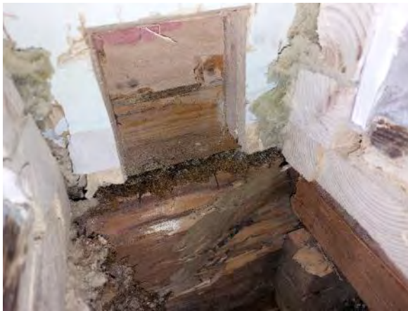
Kuva 115. Rakenneavaus US2. Sisäpuolisen lisälämmöneristeen takana on puukuitulevy, tapetti, vaakalaudoitus sekä tapetoitu pinkopahvikerros ennen hirsipintaa.
