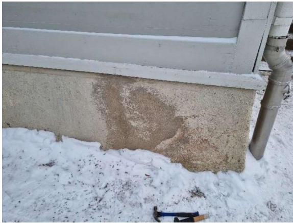
Kuva 36. Rakennuksen 1 asbesti- ja raskasmetallipitoinen sokkelin pinnoite.
