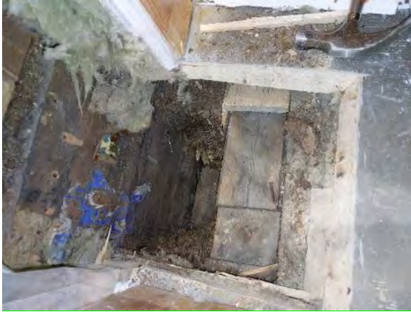
Kuva 179. Ulkoseinän ja alapohjan liitoksien toteutustapa ei ole ilmatiivis.
