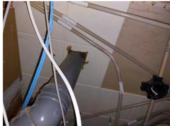
Kuva 209. Sisäkaton yläpuolella on epätiivitä läpivientejä. Alakatossa on nähtävillä vanhoja sisäkattomateriaaleja.
