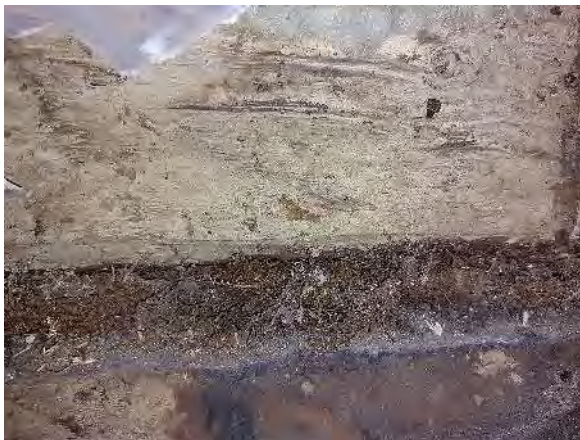
Kuva 172. Rakenneavaus US9: Hirsien sisäpinnalla on havaittavissa hyönteisten aiheuttamia reikiä. Hirsien tilkemateriaalina on sammal.
