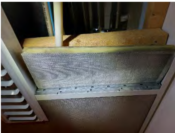
Kuva 359. Mineraalivillarakenteisissa alakattolevytyksissä havaittiin ilmavirtausten aiheuttamia tummentumia.
