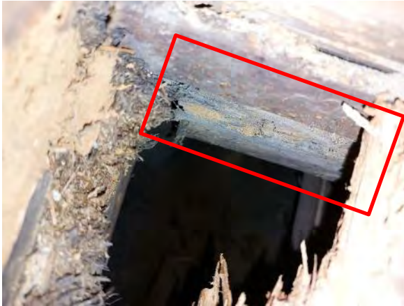
Kuva 249. Rakenneavaus VS2: Väliseinän alaosan hirressä on havaittavissa lahovaurioita alapohjarakenteen aluslaudoituksen tuntumassa.
