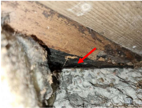
Kuva 26. Sokkelin ja alapuun välinen kermi ei sisällä asbestia.
