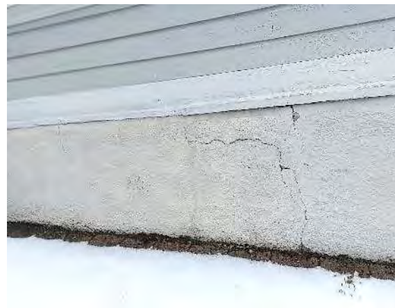
Kuva 93. Sokkelirakenteen pinnalla on paikoin havaittavissa halkeamia.
