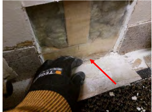
Kuva 123. Rakenneavaus US3. Kipsilevyn takana olevaa höyrynsulkumuovia ei kiinnitetty ollenkaan, jonka vuoksi se on epätiivis.
