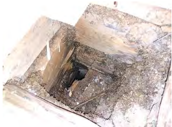
Kuva 29. Rakenneavaus AP 4: Aluslaudoitus on lahovaurioitunut.
