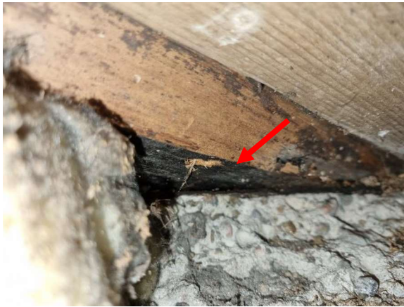
Kuva 32. Rakennuksen 2 sokkelin ja alapuun välinen kermi on tummuttanut alapuun alapintaa.
