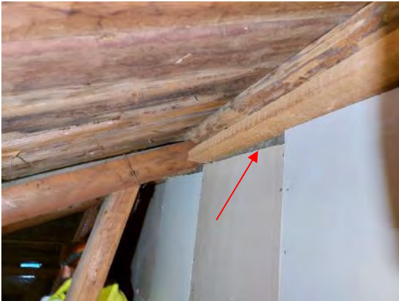
Kuva 298. 2.kerroksen yläpohjarakenteen tuulettuminen on puutteellista vähintään paikoin.
