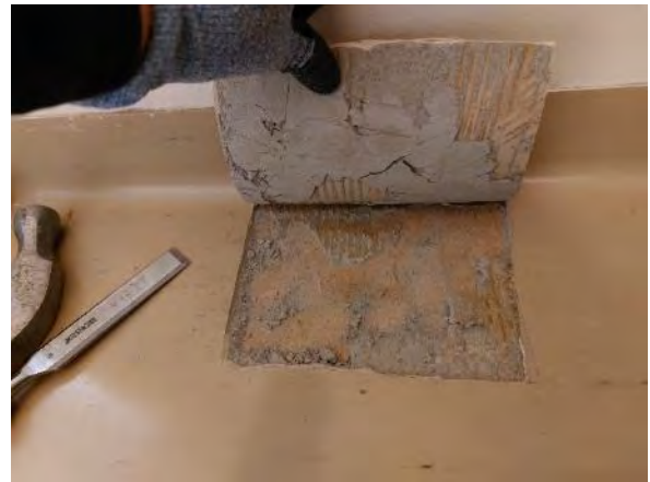
Kuva 213. Rakenneavaus VP1: Muovimaton alapuolella on lastulevy.
