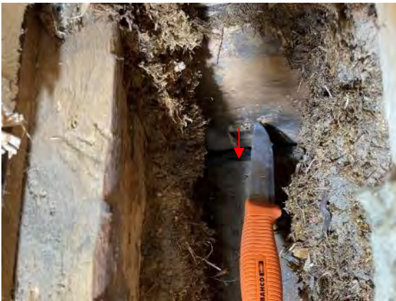
Kuva 169. Rakenneavaus US10: Lahovaurioita havaittiin n.30 cm lattiapinnan tasosta alaspäin.
