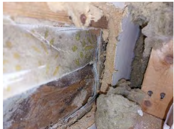
Kuva 164. Rakenneavaus US8. Ulkoseinässä on sisäpuolinen lisälämmöneriste. Puukuitulevyn takana on pinkopahvi ja tapettikerroksia
