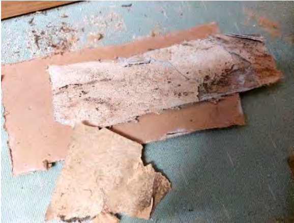
Kuva 165. Rakenneavaus US8. Pinkopahvissa ja tapettikerroksissa on havaittavissa kosteuden aiheuttamia vaurioita.
