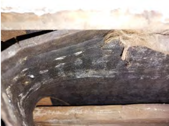
Kuva 112. US1: Vaakalaudoituksen ja julkisivuverhouksen välissä on tervapaperi, jonka PAH-yhdistepitoisuus ylittää vaarallisen jätteen pitoisuusrajan.
