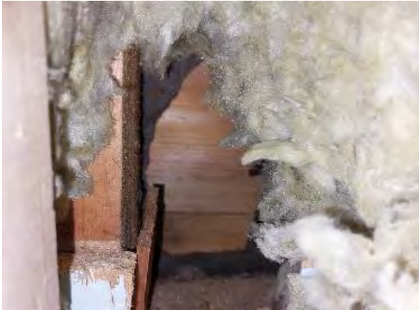
Kuva 126. US3 Rakenneavauksen ulkoverhouksen takana on tervapaperi.
