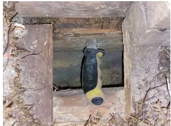
Kuva 118. Ulkoseinän alimman hirren sisäpinnalla oli havaittavissa rakenneavauksesta US2/AP2 lahovauriota. Puukko upposi n. 55 mm syvyyteen hirteen.
