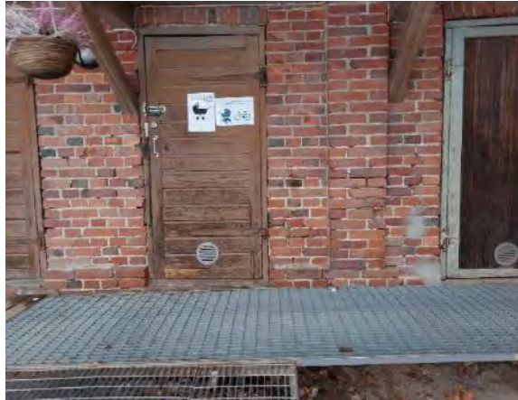
Kuva 194. Rakennuksen 3 julkisivun tiilimuurausta on paikoin korjattu. Ovet ovat pääosin kunnostuksen tarpeessa.
