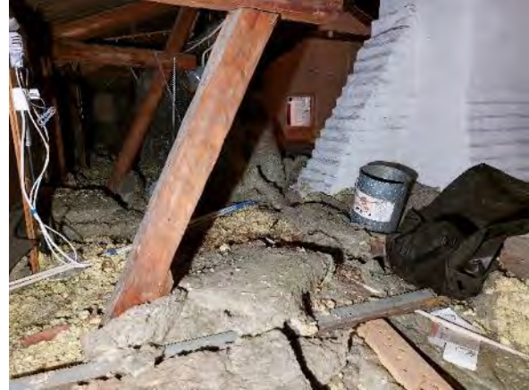
Kuva 295. Yläpohjassa on sinne kuulumatonta rakennusaikaisista materiaaleja.
