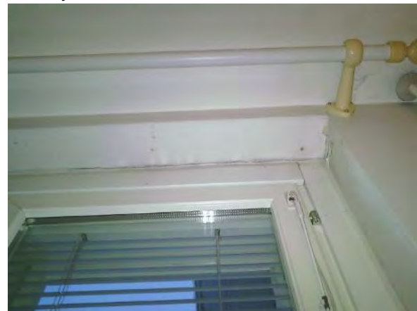
Kuva 183. Valokuva ulkoseinän ja ikkunan liitoksesta. Liitoksen alueella on havaittavissa ilmavuotojälkiä.
