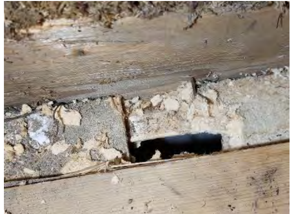
Kuva 309. Rakenneavaus YP3, puukuitulevyn alapuolella on tyhjä tila.
