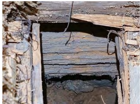
Kuva 109. Alimmissa hirsikerroksissa havaittiin lahoaurioita.
