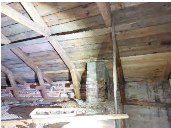
Kuva 355. Aluslaudoitusta on havaintojen perusteella uusittu.
