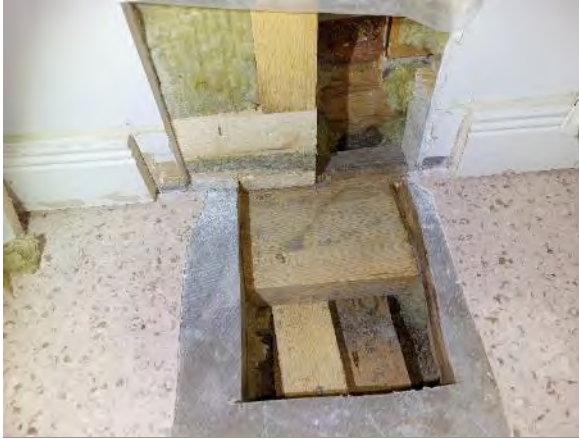
Kuva 149. Ulkoseinän ja alapohjan liitoksien toteutustapa ei ole ilmatiivis.
