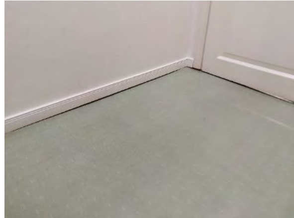
Kuva 257. Väliseinien ja alapohjan liitoksissa havaittiin paikoin rakoja. Kuva verstaasta.
