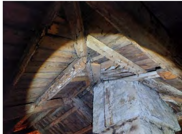
Kuva 330. Savuhormien ympärillä havaittiin kosteuden aiheuttamia vaurioita läpiviennin yhteydessä.
