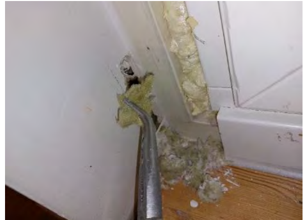
Rakenneavaus IKK3: Uusitun ikkunarakenteen ja vanhan karmin välissä on tilkkeenä uretaanivaahdotus. Vanhan karmin ja ulkoseinän liitoksessa on eristeenä mineraalivillaeriste.
