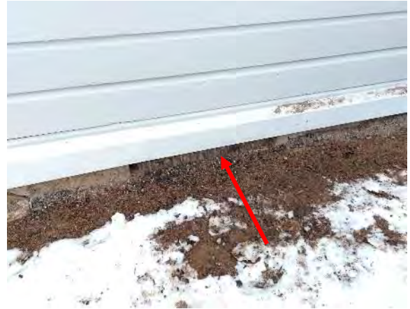
Kuva 8. Rakennuksen 1 lounaan puoleisessa siivessä havaittu tarkastusluukku on pääosin maanpinnan alapuolella.
