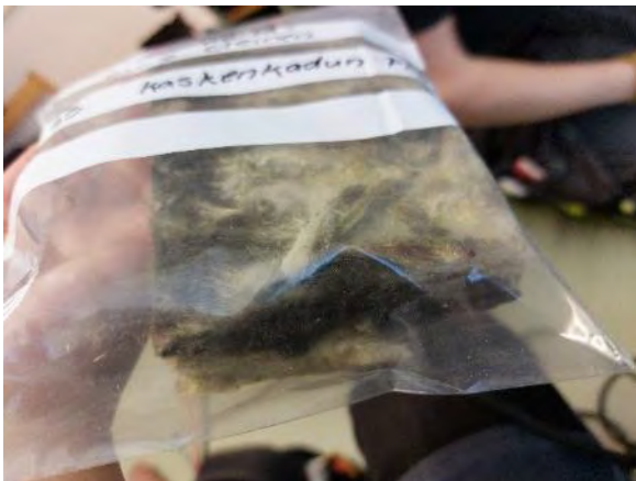
Kuva 176. Rakenneavaus US11: Mineraalivillaeristeessä on havaittavissa tummentumia.
