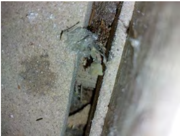
Kuva 261. Rakenneavaus VS3: Alapohjarakenteeseen ulottuva rako havaittiin väliseinän alapuolella.
