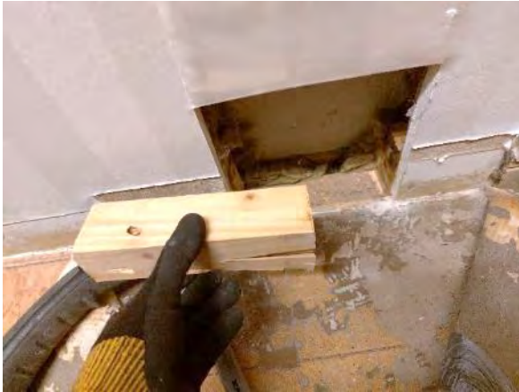
Kuva 106. US1: Sisäpuolinen lisäkoolauksen alaojhauspuu on hyväkuntoinen, eikä siinä havaittu kosteuden aiheuttamia jälkiä.
