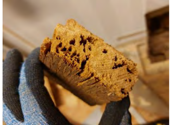
Kuva 16. Tuulettuvan alapohjan aluslaudoituksissa on havaittavissa lahovauriota ja hyönteistuhoja.
