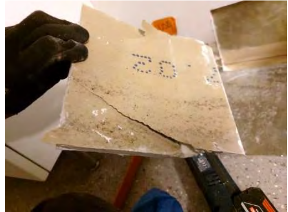
Kuva 114. Rakenneavaus US2. Kipsilevyn takapinnalla havaittiin mikrobikasvustoon viittaavia jälkiä.
