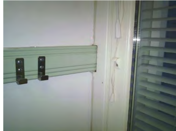
Kuva 181. Ilmavuotoa havaittiin lämpökameralla ulkoseinän ja ikkunan liitoksesta.
