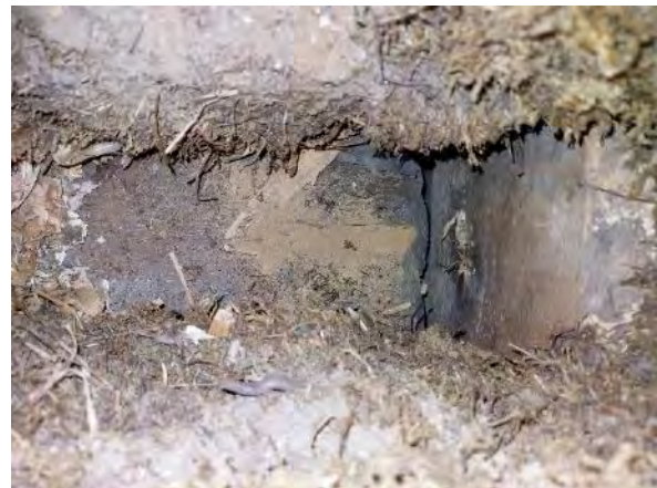
Kuva 68. Rakenneavaus AP9: Eristeenä on mineraalivillan ja turpeen lisäksi hiekkaa ja sammalta. Aluslaudoitus on lahovaurioitunut ja pölyävä.
