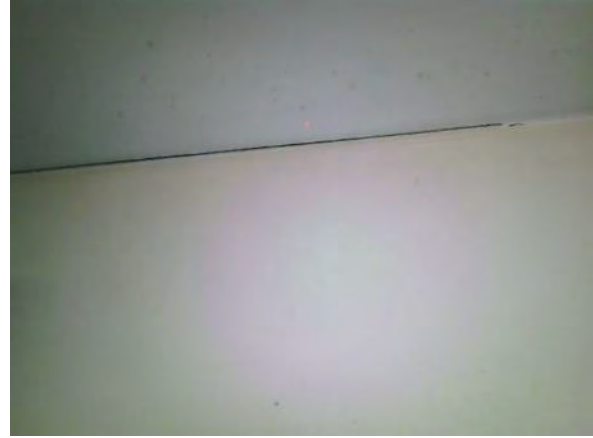
Kuva 222. Yleiskuva välipohjan ja ulkoseinän epätasaisista liitoskohdasta.
