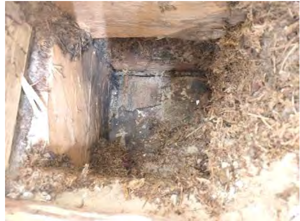
Kuva 27. Rakenneavaus AP 4: Alapohjarakenteen lisälämmöneristeinä on käytetty mineraalivillaa. Rakenteen alkuperäisenä lämmöneristeinä on käytetty hiekkaa ja sammalta, jotka sisältävät luontaisesti mikrobeja.
