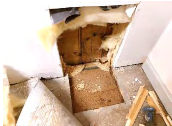
Kuva 199. Rakenneavaus US12: Rakenteessa ilmansulkuna on käytetty tervapaperia.
