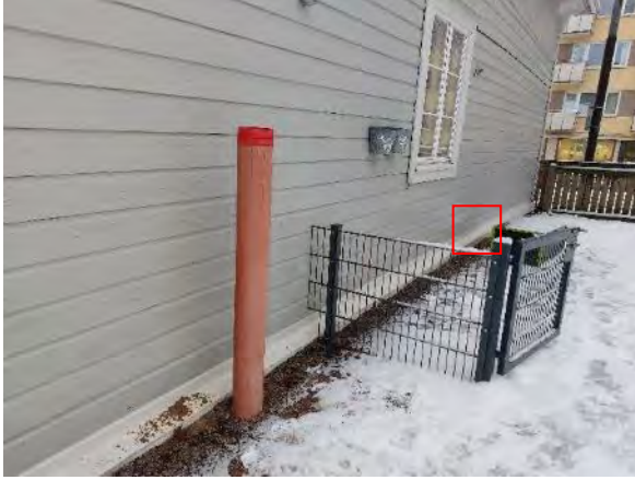
Kuva 119. Ulkoseinä on kiinni maanpinnassa luoteissii- ven päädyn alueella. Ulkoseinän alaosa on pellitetty. Pellitystä avattiin kuvaan merkityltä kohdalta.
