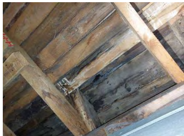
Kuva 287. Laajennusosan ja alkuperäisen vesikattorakenteen liitos. Aluslaudoituksessa havaittiin lahovaurioita.
