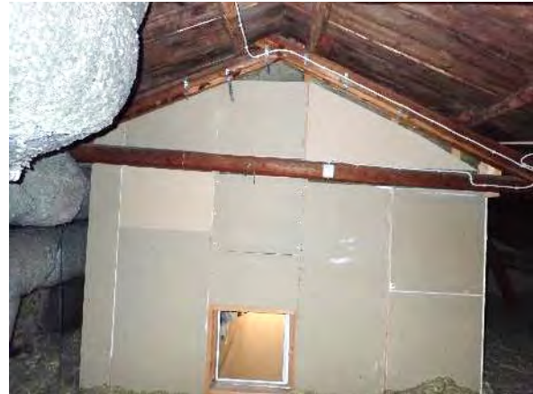
Kuva 299. Yleiskuva 2.kerroksen ullakotilaan rajautuvista ulkoseinästä ullakotilan puolelta kuvattuna. Kuvassa on havaittavissa tuulensuojakipsilevytyks.
