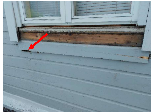
Kuva 40. Vaakalaudan alareunan kitti ei sisällä asbestia, mutta sisältää lyijyä yli raja-arvon.
