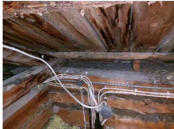
Kuva 291. Yleiskuva yläpohjasta luoteissiivestä. Räystäällä ei havaittu tuulettumisen mahdollistavia rakoja.
