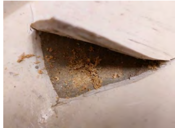
Kuva 70. Rakenneavaus AP 9: Pesuhuoneen muovimaton alapuolella ei ole käytetty vedeneristettä. Muovimaton alla on tasoite sekä puukuitulevy.
