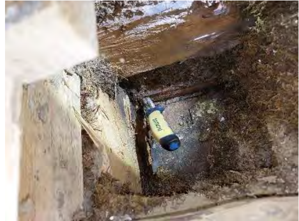
Kuva 250. Rakenneavauksen kohdassa VS2 hirsirakenne on alaosaan lahovaurioitunut.
