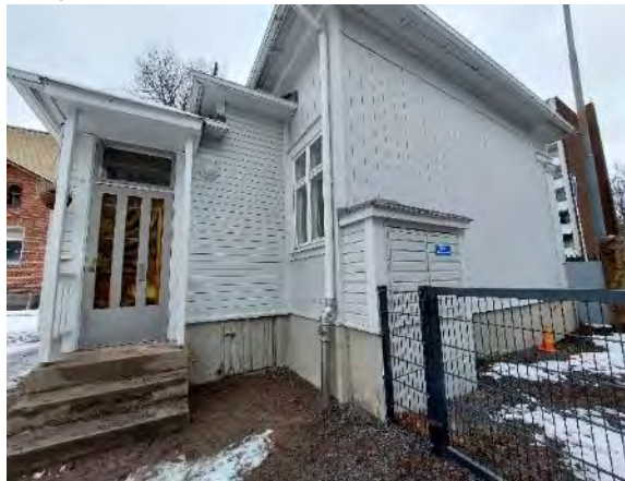
Kuva 160. Rakennuksessa 1 on havaittavissa julkisivun puuverhoilussa paikoin paikkakohtia.
