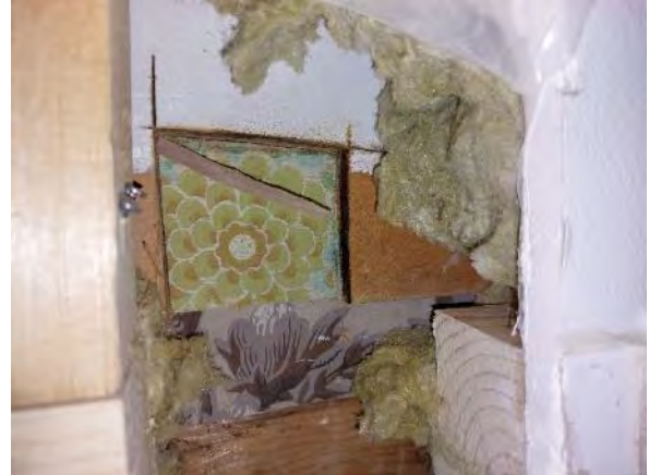
Kuva 135. Rakenneavaus US5. Sisäverhouksen takana on mineraalivillaeriste sekä vanha kovalevy ja pinkopahvi, jonka pinnalla on useita tapettikerroksia.
