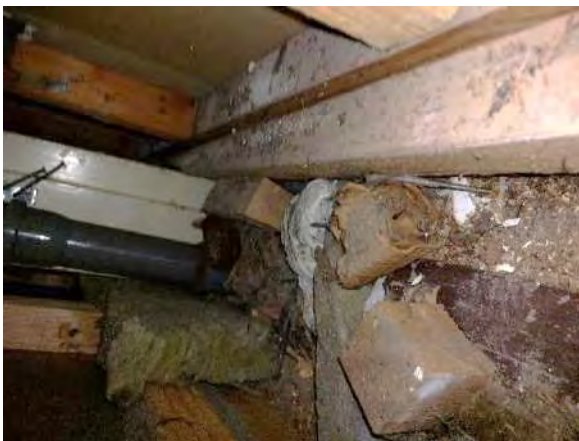
Kuva 265. Rakenneavaus VS4: Väliseinän välin on jätetty roskia.
