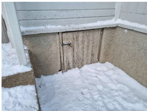
Kuva 1. Asbestipitoinen sokkelin pinnoite
