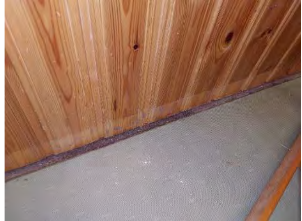
Kuva 268. Väliseinän ja alapohjan liitoksissa havaittiin rakoja. Kuva rakennus 2, monitoimitilan ja pienoiskeittämön välinen väliseinä.
