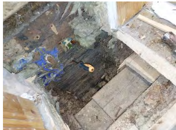
Kuva 173. Rakenneavaus US9: Hirsirungossa havaitut lahovauriot sijoittuvat lattiapinnan alapuolelle.
