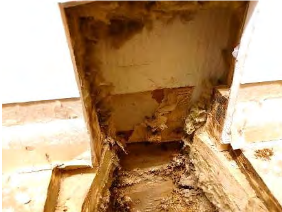
Kuva 39. Ulkoseinän ja alapohjan liitoksissa havaittiin rakoja
