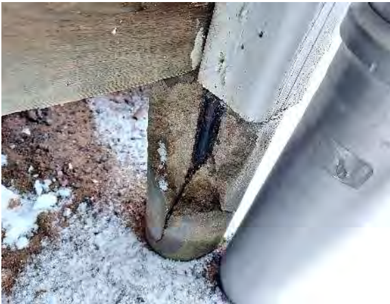
Kuva 91. Kuistin betonirakenteiset pilarit ovat heikkokuntoisia.
