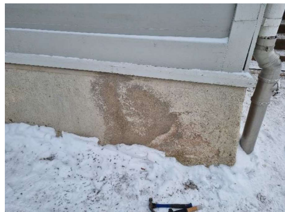
Kuva 2. Asbestipitoinen sokkelin pinnoite.
