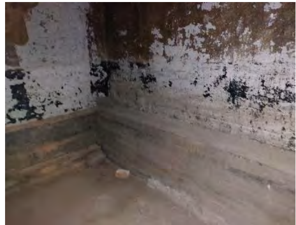
Kuva 197. Kkellarin ulkoseinärakenteen sisäpinnalla on havaittavissa bitumisivelyjämiä. Bitumisivelyn PAH-pitoisuus alittaa vaarallisen jätteen pitoisuusrajan. Seinätasoite ja maali ei sisällä asbestia.
