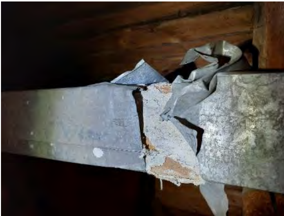
Kuva 296. Yläpohjassa on rikkoutunut asbestipitoinen IV-kanavan kappale.
