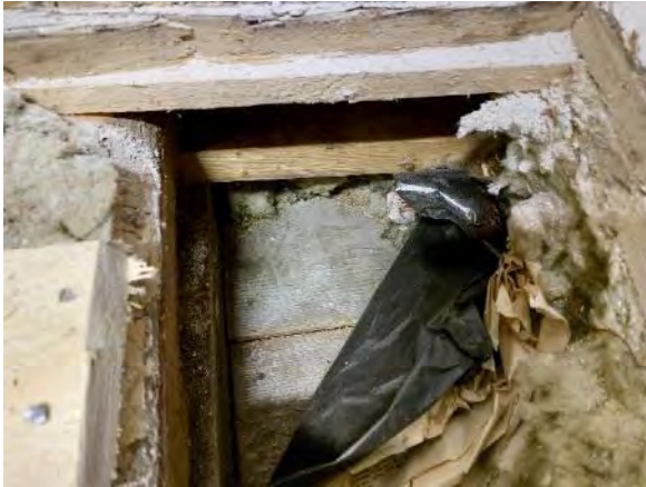
Kuva 32. Rakenneavaus AP 5: Mineraalivillaeristeen sekä sanomalehtien alapuolella on tervapaperi. Aluslaudoitus on rakenneavauskohdalta aistinvaraisesti tarkastelluin osin hyväkuntoisen näköinen.
