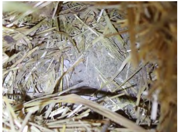
Kuva 342. Rakenneavaus YP5. Yläpohjan alkuperäisenä lämmöneristeenä on käytetty samalta/metsänpohjaa, hiekkaa sekä olkia.
