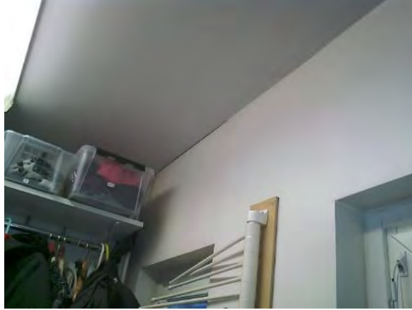
Kuva 221. Ulkoseinän ja välipohjan liitoksessa havaittiin paikoin rakoja.
