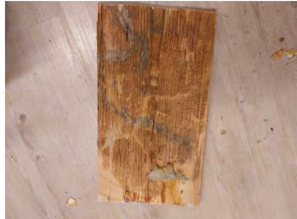
Kuva 66. Lattialankun alapinnalla havaittiin lahovaurioita.
