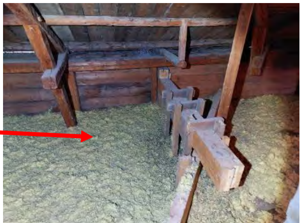
Kuva 281. Yläpohjassa havaittiin lisätuentoja lounaissiivän alueella.
