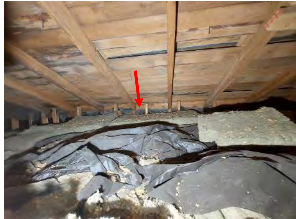
Kuva 285. Laajennuksen rankarakenteisen ulkoseinän tervapaperia oli havaittavissa yläpohjan kautta. Yläpohjassa on sinne kuulumatonta rakennusaikaista materiaaleja.
