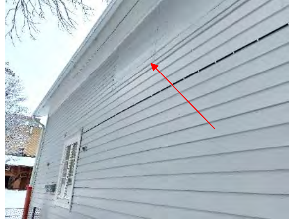
Kuva 90. Rakennuksessa 1 on havaittavissa julkisivun puuverhoilussa paikoin paikkakohtia.
