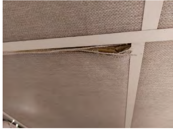
Kuva 358. Paikoin lasikuitukudos on rikkoutunut. Rikkoutuneilla alueilla on havaittavissa mineraalivillarakenne.
