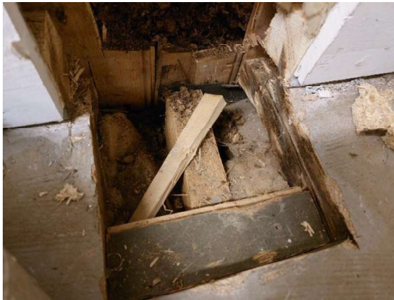
Kuva 38. Rakennuksen 3 neuvotteluhuoneen ponttilaudoituksen raskasmetallipitoinen maali.
