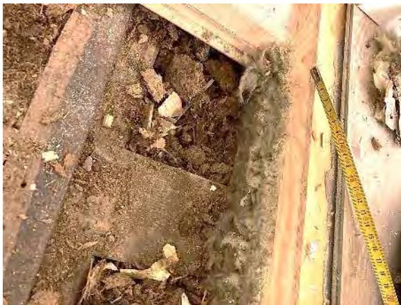
Kuva 67. Rakenneavaus AP9: Mineraalivillakerroksen alapuolella havaittiin turvetta.
