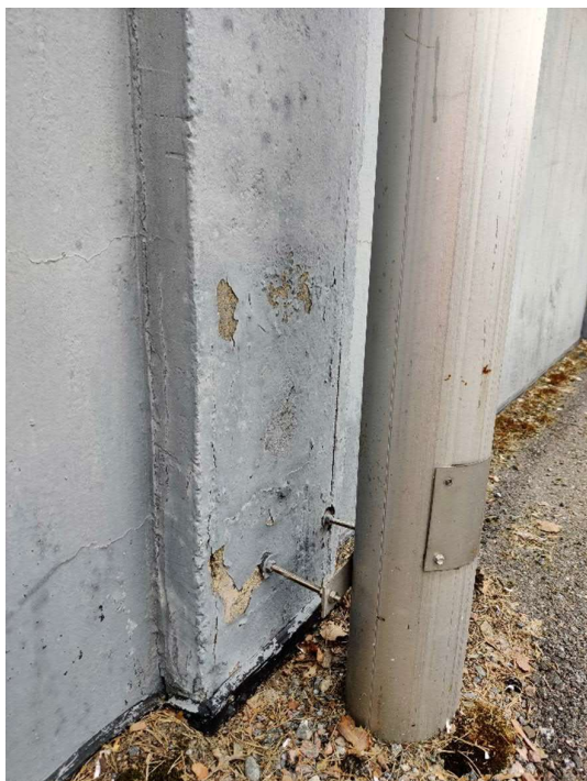
Kuva 41. Sokkelirakenteista havaittiin merkkejä betonin rapautumisesta.
