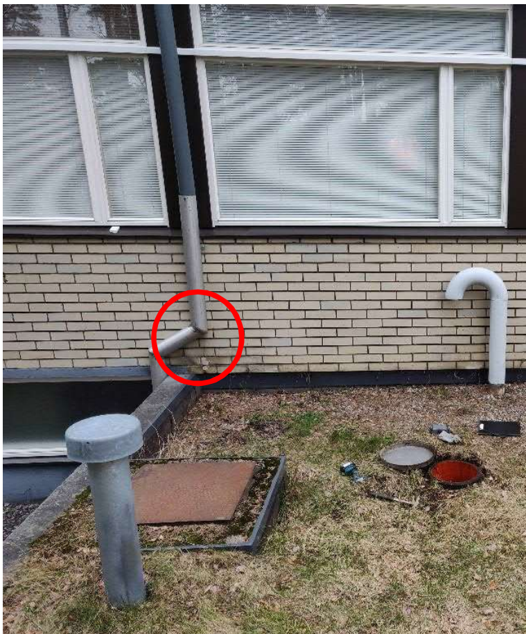
Kuva 17. Rakennuksen lounaissivustalla väestönsuojan kohdalta havaittiin vuotava rännisyöksyputki.
