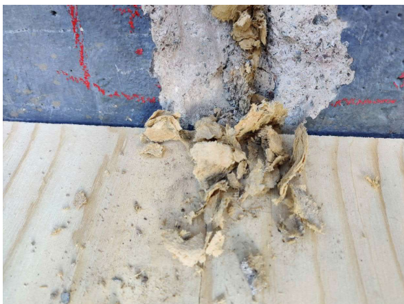
Kuva 80. Pilareiden välisessä liikuntasaumassa oli suunnitelmista poiketen käytetty kovalevyä.
