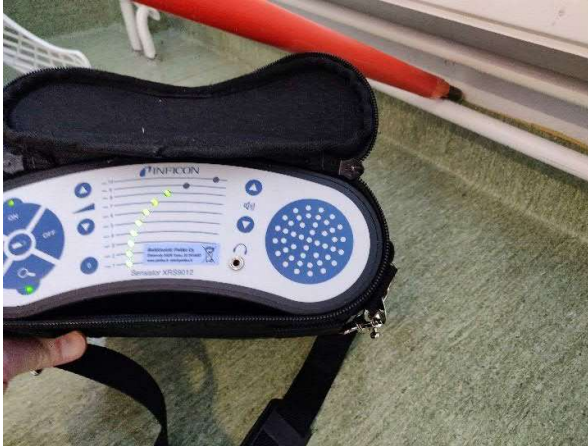
Kuva 73. Merkkiainelaitteistolla havaittiin välipohjan eristeerroksesta ilmayhteyksiä sisätiloihin.
