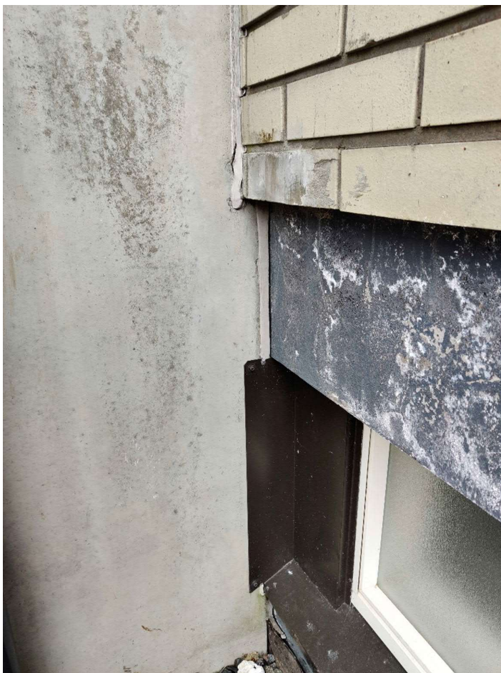
Kuva 162. Rakennusten välinen liikuntasäuma ulkopuolelta. Liikuntasäumaus on auennut.
