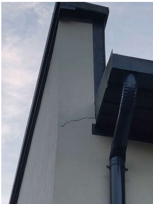
Kuva 174. Julkisivun korotetun osan saumakohtasta havaittiin halkeama. Halkeaman kautta on sadeveden mahdollista kulkeutua rakenteeseen.
