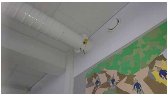
Kuva 203 Luokkatiloissa ilmanjako on toteutettu sekoittavana ilmajakoon hyvin soveltuvilla suutinkanavilla.
