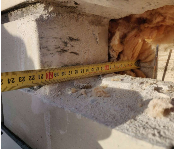
Kuva 96. Julkisivuverhouksen takana ei ole tuuletusrakoa.
