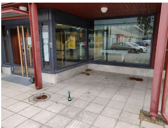
Kuva 132. Salaojan tarkastuskaivoja oli rakennuksen nurkissa.
