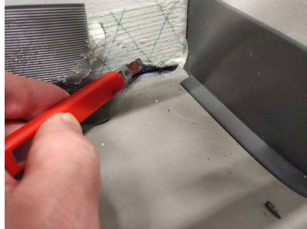
Kuva 74. Myös tiivistyskorjatuissa tiloissa havaittiin ilmayhteyksiä sisätiloihin.
