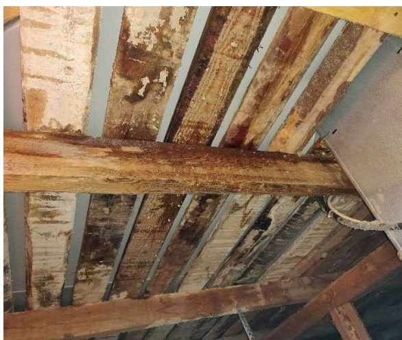
Kuva 114. Vesikatteen alla ei ole aluskatetta. Harvalaudoituksessa oli vesivuotojälkiä huoltoluukkujen ympäristössä.
