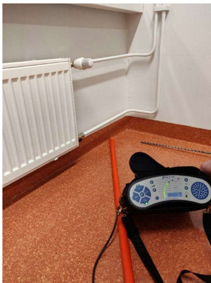
Kuva 172. Ilmavuotoja ulkoseinärakenteen eristetilasta havaittiin alapohjan ja ulkoseinän liittymäkohdasta.
