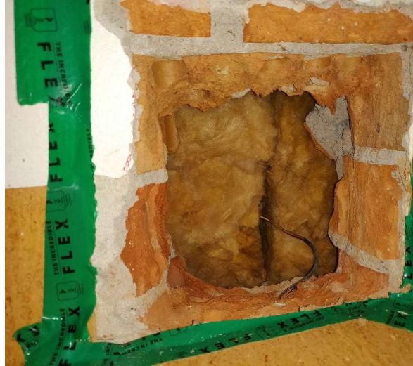
Kuva 97. Ulkoseinän lämmöneristeissä oli rakoja.
