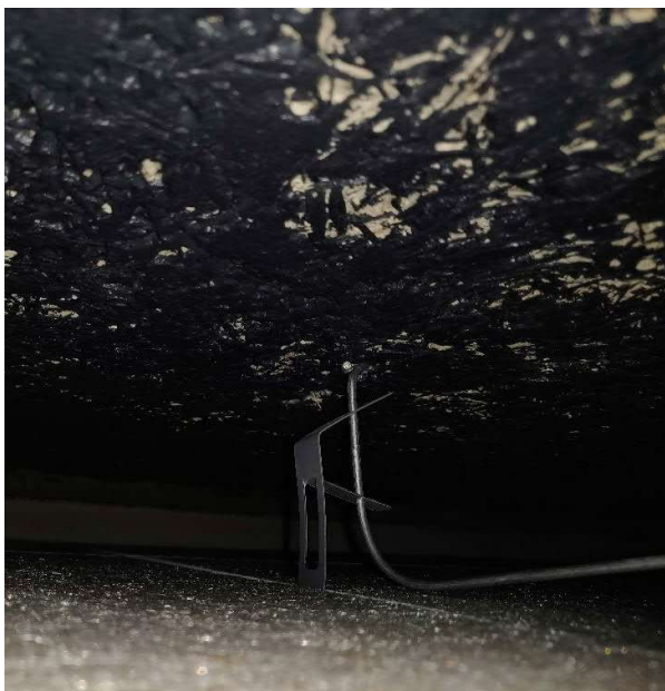
Kuva 119. Alakattojen yläpinnoilta havaittiin pölyä. Lastuvillasementtilevyn jäämiä havaittiin yläpohjan kantavan laatan alapinnasta.
