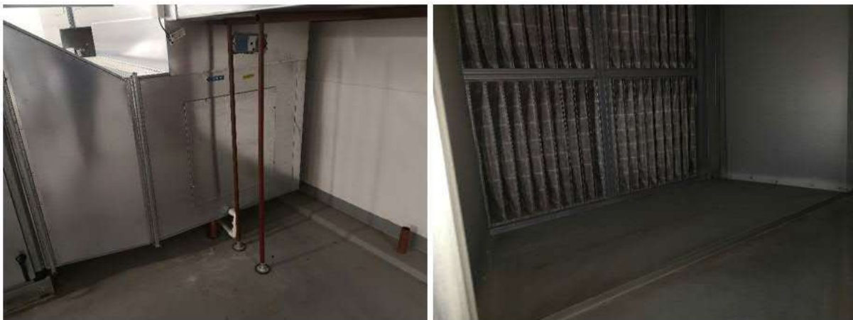
Kuva 202. TK4:n ulkoilma kammion viemäröinti ja tuloilmasuodattimet.
