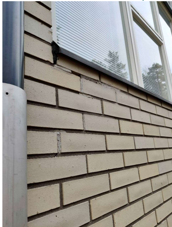
Kuva 99. Julkisivuverhouksesta havaittiin paikallisia rapautumia. Tiilisauvoja oli korjattu.
