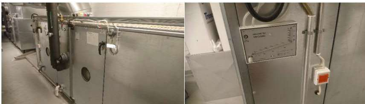
Kuva 201 TK3 on varustettu liuos-LTO:lla. TK3/pf1:n ilmavirtauksen ilmoittama manometri on rikki.
