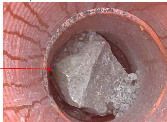
Kuva 14. Luoteisnurkan salaojakaivon pohjalta havaittiin suuri kivi.
