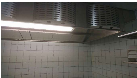
Kuva 206 Ruokalan ilmanvaihtolaite todettiin aistinvaraisesti pinnoilta puhtaaksi.
