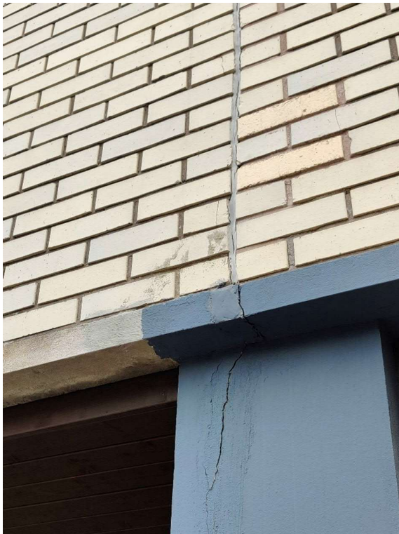
Kuva 98. Leukapalkissa on halkeama liikuntasauaman kohalla.
