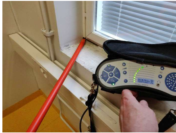
Kuva 176. Ikkunakarmien nurkka-alueilta havaittiin pistemäisiä vuotokohtia ulkoseinärakenteen eristetilasta sisäilmaan.
