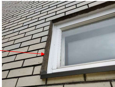
Kuva 104. Ikkunan pellitys vuotaa.
