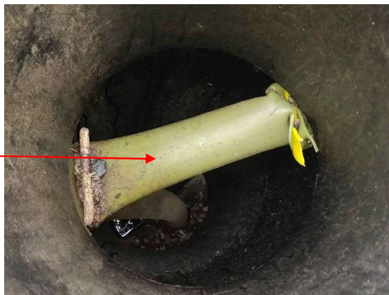
Kuva 21. Sadevesikaivon rassiputki on rikkoutunut.
