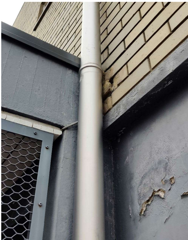
Kuva 102. Julkisivun tiiliverhouksessa ja alemman osan betonisessa julkisivussa havaittiin rakennuksen etelänurkalla kosteuden aiheuttamia vaurioita.
