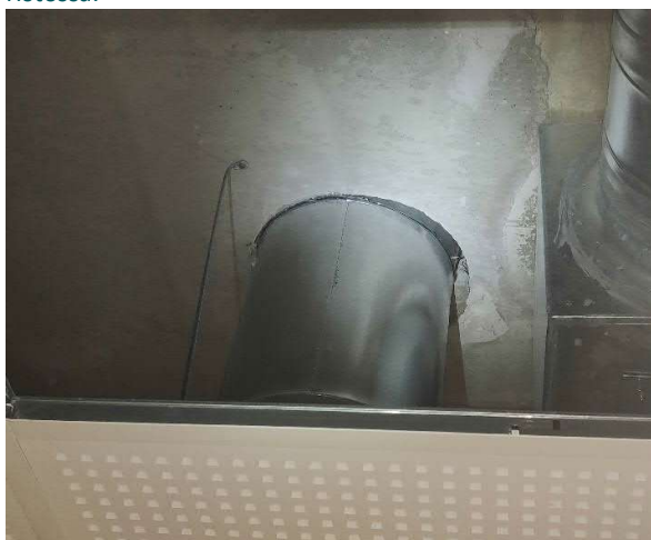
Kuva 116. Yläpohjarakenteen läpi kulkevien IV-kanavien läpivientien kautta havaittiin ilmavuotoa sisätiloihin.
