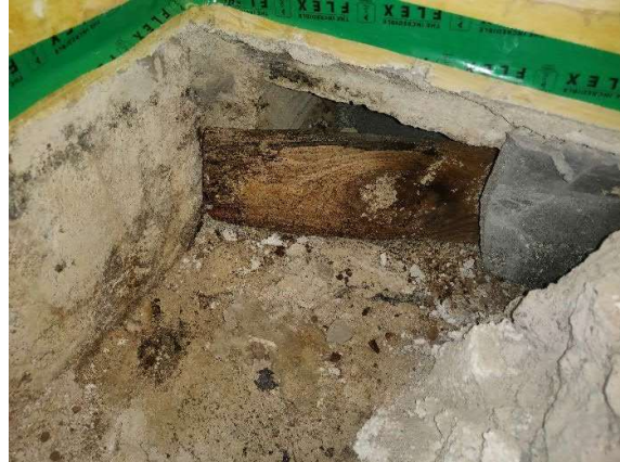
Kuva 46. Alapohjan eristetilasta havaittiin orgaanista materiaalia (mm. muottilautoja).
