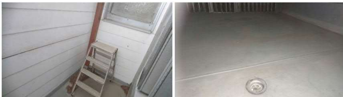
Kuva 200. Ulkoilmakammion kulmissa havaittiin orgaanisia epäpuhtauksia, mutta suunnitelmien mukaista kuivakaivoa ei kuvauksessa havaittu. Suodattimia edeltävä koneen osa oli sen sijaan viemäroity.
