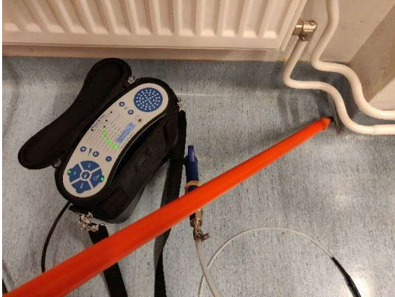
Kuva 45. Pintalaatan ja seinärakenteiden liittymäkohdista havaittiin ilmavuotoreittejä. Muovimatosta havaittiin repeytymiä johtuen pintalaatan painumisesta.
