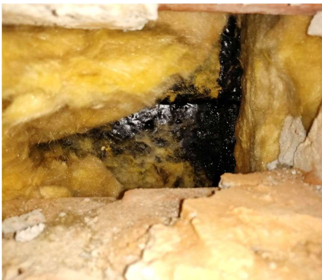
Kuva 39. Ulkoseinärakenteen sisäpuolisen pikisivelyn pinnassa havaittiin vesipisarointia.
