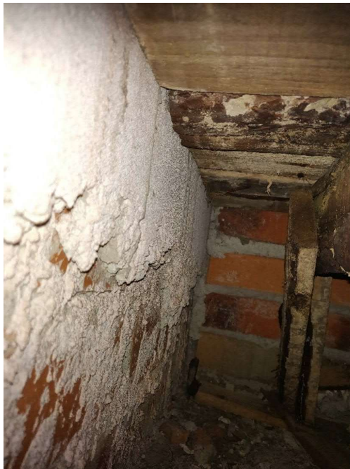
Kuva 101. Ulkoseinärakenteen sisäpuolinen rappaus ei jatku välipohjarakenteen / alapohjarakenteen alaosaan asti. Ulkoseinän eristekerroksesta on ilmayhteys sisäilmaan rappaamattoman pinnan kautta.
