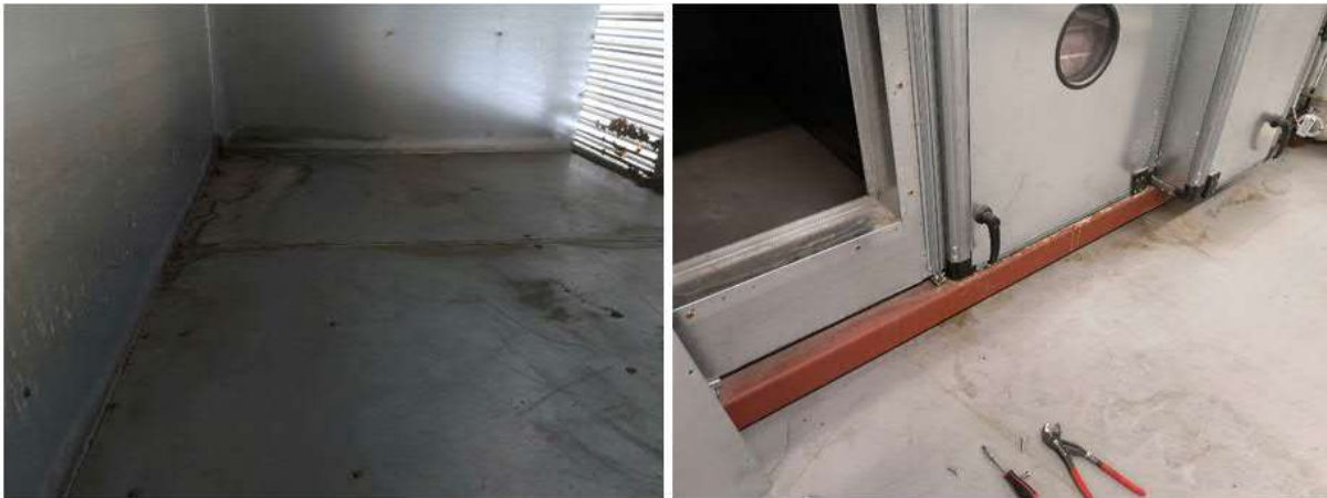
Kuva 198. TK2:n tuloilmakammio todettiin kohtuullisen puhtaaksi, ainoastaan säleikössä havaittiin pieniä määriä lehtiä. TK2:n viemärointi puutteellista, jonka takia koneeseen päätynyt vesi valuu koneen rungon lävitse.
