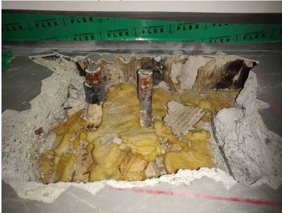
Kuva 75. Välipohjarakenteen pintalaatan valunerotuskaista on laajalti mikrobivaurioitunut. Rakenteissa sijaitsevien lämpölinjojen eristeet sisältävät asbestia.
