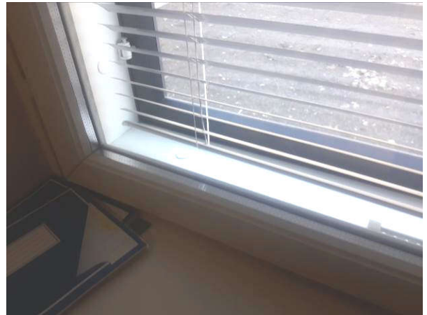
Ikkunan sisäpuutteessa on lämpölaselementti
