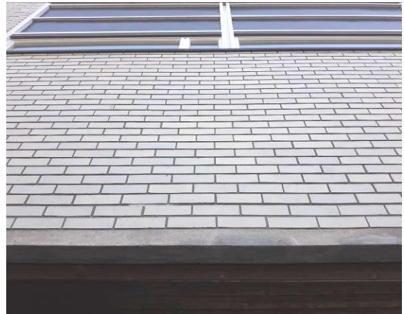
Tiilimuuraus kannatellaan aukkojen kohdalla ns. leukapalkilla, jossa havaittiin rapautumista
