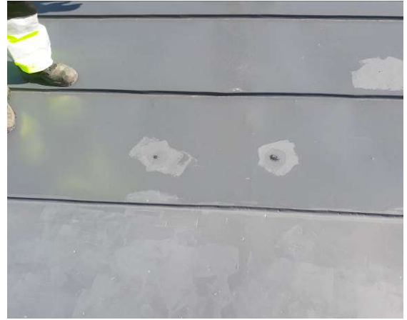
Paikattuja reikiä ja paikkamaalausta
