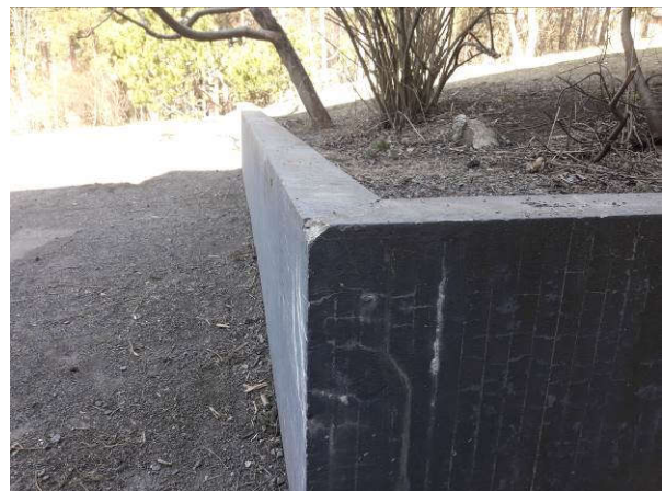
Tukimuurissa näkyviä vaurioita
