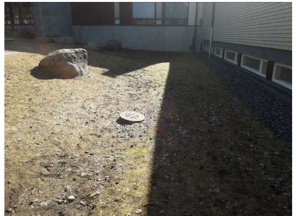
Sadevesikaivon kansi ympäröivää maanpintaa korkeammalla
