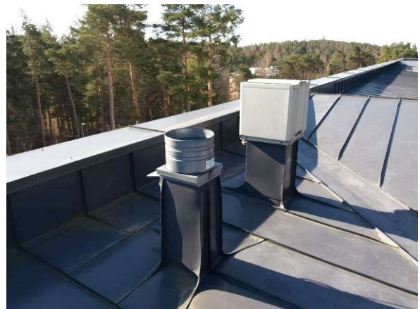
Vesikatolla sijaitsevia huippuimureita.
