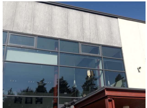
Julkisivulevyissä pystyhalkeamia; halkeamisen syy selvítettävä ja haljenneet levyt tulee uusia
