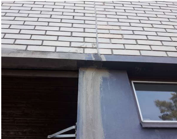
Vaurio/halkeama, jota on korjattu
