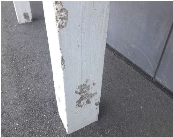
Mekaanisesta rasituksesta tulleita kolhuja betonipilareissa
