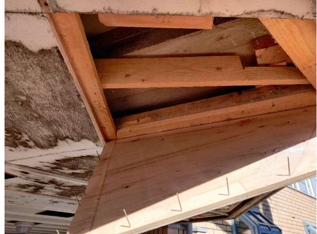
Kuva 46. Eteläsivustan parvekkeen alapuolella olevaa vanerointia avattiin. Vanerin pinnoite on monin paikoin irronnut.
