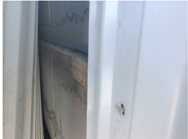
Kuva 32. IV-konehuoneen tuulensuojalevyistä havaittiin kosteusjälkiä.
