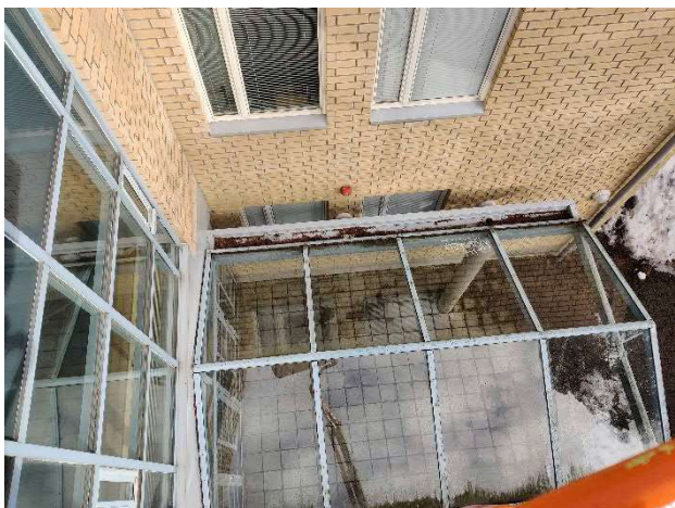
Kuva 55. Itäisen sivustan sisäänkäynnin lasirakenteisen katoksen metalliosista havaittiin ruostevaurioita.
