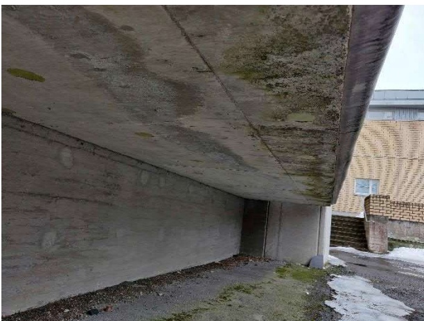
Kuva 51. Lastauslaiturin ulokkeen betoniin kohdistuu huomattavaa kosteusrasitusta.
