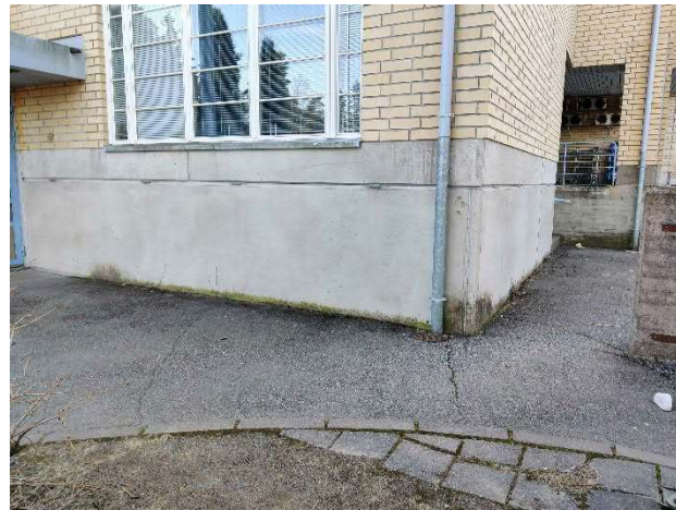
Kuva 10. Kuva pohjoissivustalta keittiön lastauslaiturin vierestä. Sokkelielementin alaosissa jälkiä kosteusrasituksesta.
