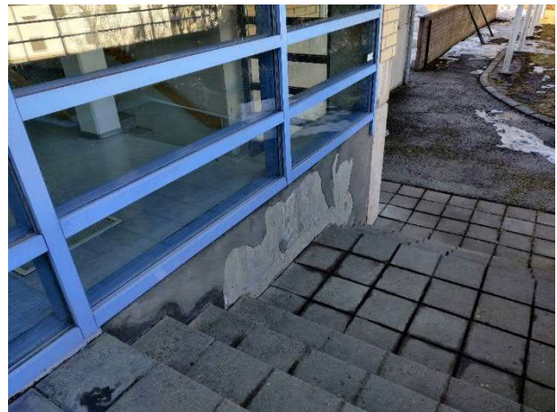
Kuva 12. Kuvassa ruokasalin ikkunaseinärakenteen sokkeli. Pintakerrokseen on tehty paikkakorjauksia laastilla.
