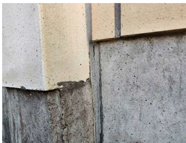
Kuva 40. Julkisivun saumat olivat pääosin alkupeiräisiä. Alkuperäisistä saumoista havaittiin rakoilua ja repeytymiä sekä ikääntymisestä johtuvan kovettumisen aiheuttamaa pinnan halkeilua
