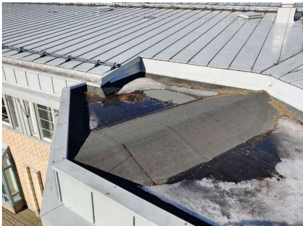
Kuva 53. Eteläpuoleisen sisäänkäynnin katoksen sadevedenpoistossa havaittiin puutteita.
