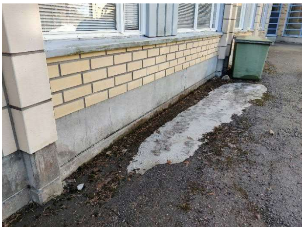
Kuva 3. Sokkelielementti itäisivustalla. Elementin pinnassa kosteusjälkiä/sammalta. Sokkelin korkeus maanpinnan yläpuolella matala.
