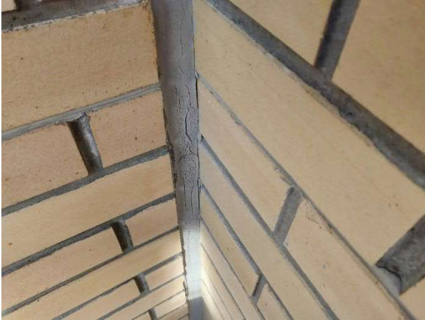
Kuva 41. Julkisivuelementtien sisäkulman sauma itäsisivulla. Saumaus on halkeillut.
