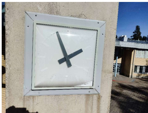
Kuva 58. Eteläsivustan kellon muovikupu on rikkoutunut.
