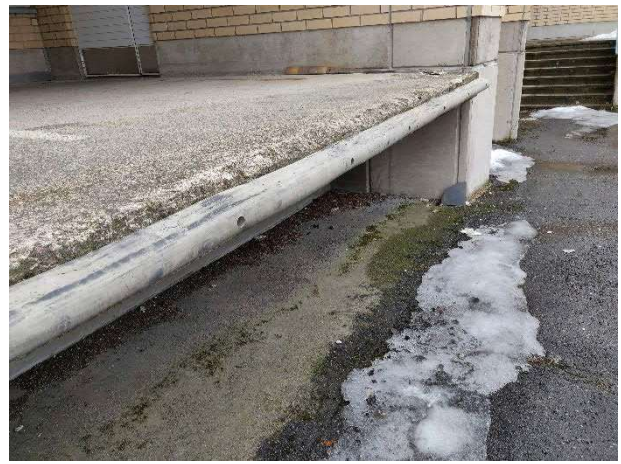
Kuva 50. Lastauslaiturin ulokerakenteesta havaittiin betonipinnan kulumista ja rapautumista.
