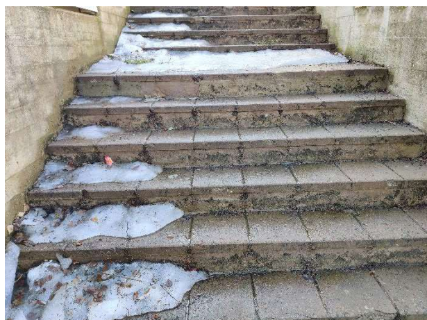
Kuva 64. Kaakkoissivustalla sijaitsevat rappuset. Yksittäisiä betonilaattoja on hajonnut.
