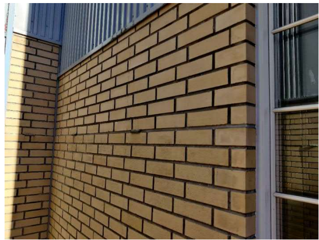
Kuva 20. Värimuutoksia / kosteusjälkiä elementissä.
