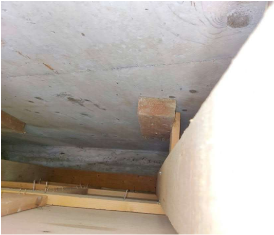
Kuva 47. Parvekelaatan alaosa ei havaittu silmämääräisesti poikkeavaa.
