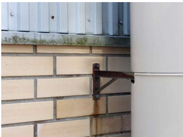
Kuva 59. Julkisivussa olevissa metallisista kiinnikkeistä havaittiin monin paikoin ruostevaurioita.
