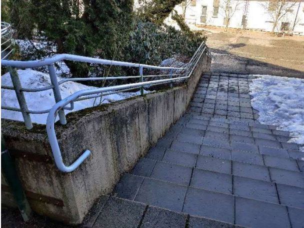
Kuva 65. Pohjoissivustan pääsisäänkäynnin yhteydessä sijaitsevat rappuset. Kaiteissa on sammalkasvustoa ja betonin pinnan rapautumaa.
