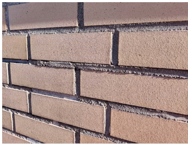
Kuva 36. Länsisivustan ulokerakenteen tiililaattojen saumat olivat rapautuneita.
