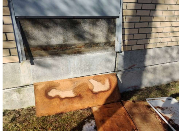
Kuva 30. Musiikkiluokan vastaisella seinällä sijaitsevan koristepellityksen taustalla olevat kovalevyt olivat vesimärkiä. Myös seinärakenne ja seinään upotetut painekyllästety puut olivat märkiä.
