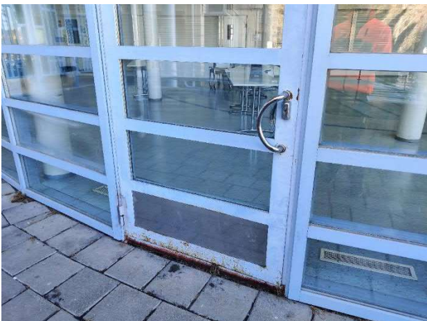
Kuva 33. Ruokalan ikkunaseinärakenteessa havaittiin yksittäinen vaurioitunut lasielementti. Yksi peitelista puutui lasien välistä. Ulko-oven alaosassa havaittiin ruostetta.
