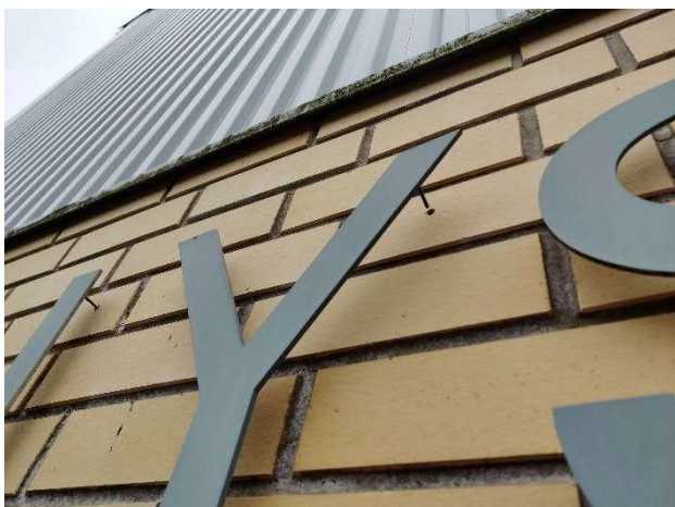
Kuva 57. Länsisivustan julkisivuun kiinnitettyjen kirjainten kannakkeita oli irronnut.
