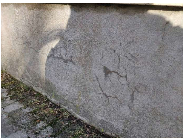
Kuva 63. Kaakkoissivustan pihamuurin perustuksista havaittiin pinnan halkeilua.
