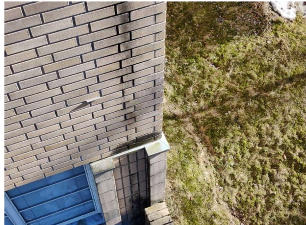
Kuva 26. Talonmiehen asunnon kulmassa vettä on valunut kattorakenteen kautta julkisivuille.
