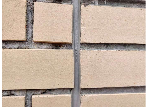
Kuva 42. Julkisivun saumaus kahden kuorielementin välissä. Saumauksessa havaittiin halkeilua.
