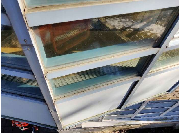
Kuva 23. Talonmiehen asunnon yläpuolella sijaitsevan ulokelasirakenteen saumat olivat alkuperäisiä. Saumuksissa oli epätiveyttä.
