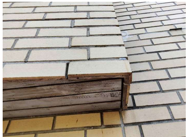
Kuva 34. Länsisivustalla sijaitseva ulokerakenne on ohut betonielementtirakenne, joka on saumattu paikan päällä. Rakenne on kiinnitetty rst-kannakkein puurunkoon.
