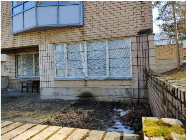
Kuva 25. Entisen talonmiehen asunnon kohdalla havaittiin useita kosteusjälkiä julkisivusta.
