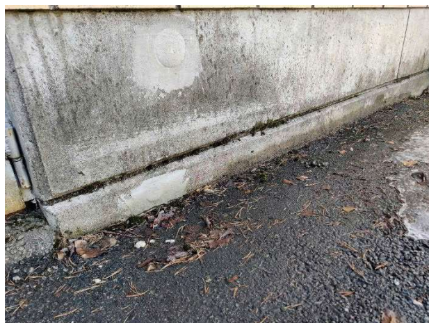
Kuva 4. Kuva rakennuksen itäisivustalta. Sokkelielementin ja ulkoseinäelementin saumassa sammalta ja kosteusjälkiä. Sokkelin korkeus maanpinnan yläpuolella matala.
