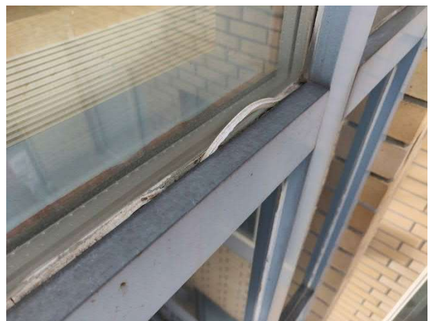
Kuva 22. Itäisivustan käytävän metalli-ikkunan saumauksissa havaittiin puutteita.
