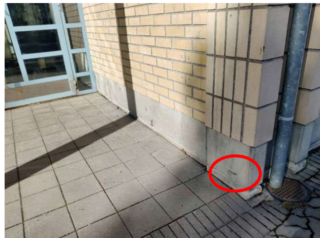
Kuva 28. Yksittäinen raudoitteen korroosiovaurio eteläisivustalla.
