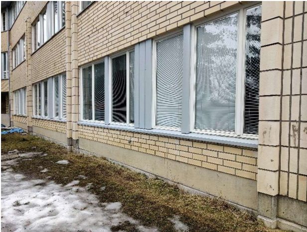
Kuva 7. Kuva rakennuksen pohjoissivulta pääsisäänkäynnin vierestä. Sokkelin korkeusasema maanpintaan nähden erittäin matala.
