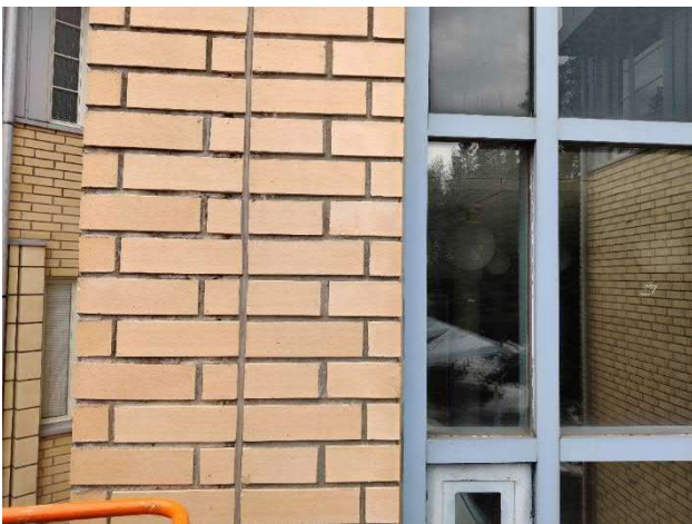
Kuva 19. Kosteusjälkiä itäisivustalla kuorielementissä.
