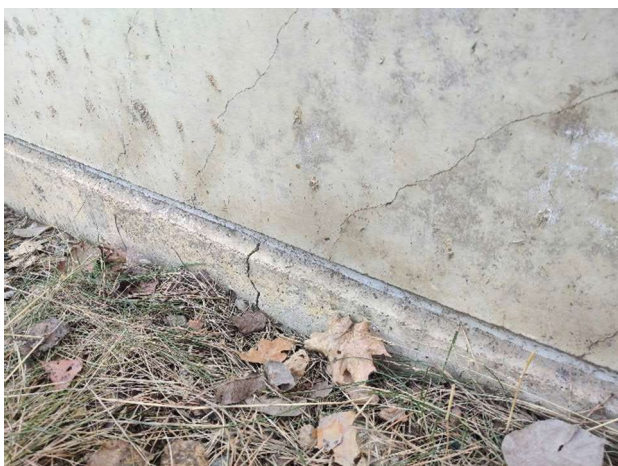
Kuva 5. Kuva rakennuksen lounaissivulta. Sokkelielementissä paikallinen halkeama. Elastinen saumamassaus on alkuperäistä ja siinä havaittiin ikääntymisen aiheuttama säröilyä.
