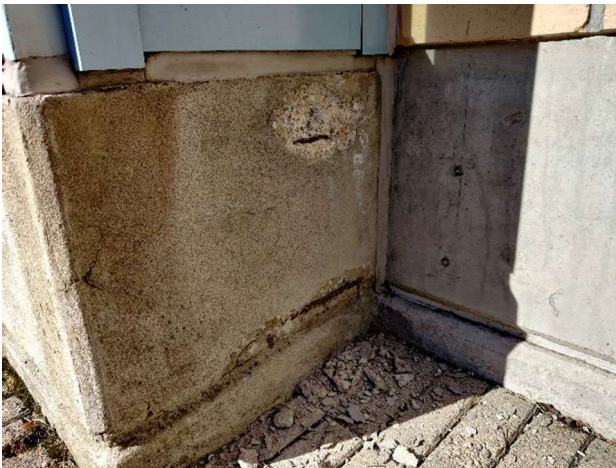
Kuva 9. Kuvassa auditorion ulokerakenteiden sokkeli. Paikallavaletussa rakenteessa havaittiin voimakasta rapautuneisuutta ja terästen ruostumista.
