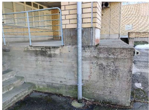
Kuva 52. Kosteuden aiheuttamaa värjäytymää ja sammaloitumista lastauslaiturin rakenteissa.
