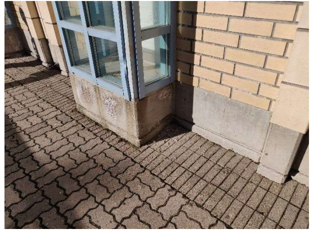
Kuva 8. Eteläisivustalla auditorion kohdalla sijaitsevien ulokerakenteiden sokkelit olivat heikkokuntoisia.
