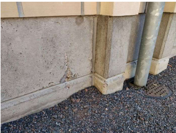
Kuva 27. Yksittäinen vauriokohta betonissa rakennuksen lounaissivustalla. Ulkoseinärakenteen alaosa on lähellä maanpinnan tasoa.
