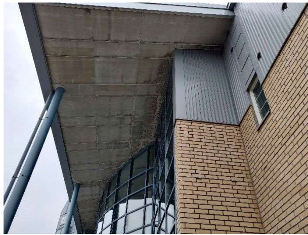
Kuva 54. Pohjoisen pääsisäänkäynnin / ruokalan edustalla sijaitsevan katoksen vanerointien pinnoitteet ovat irronneet.
