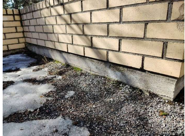
Kuva 66. Lounaissivustan pihamuurin betonisesta sokkelista havaittiin rapautumaa.
