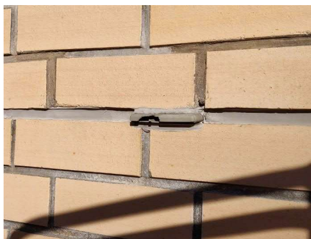
Kuva 38. Julkisivun tuuletus tapahtuu tuuletuskoteloiden kautta. Yksittäisiä kotelointeja oli rikkoutunut.
