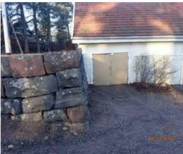
Pihan kivimuurin päältä on putoamisvaara.
