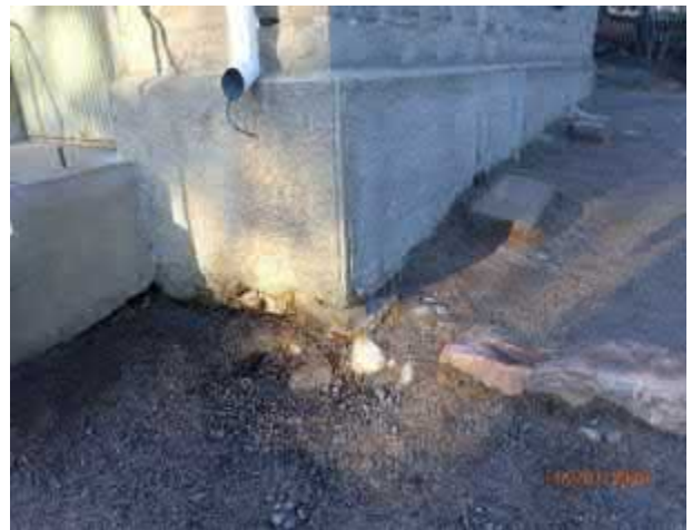
Kattovedet kastelevat osittain sokkelirakennetta.
