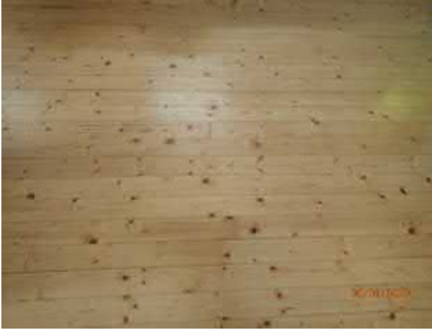
Luokkahuoneen lattia on tyydyttävän kuntoinen.
