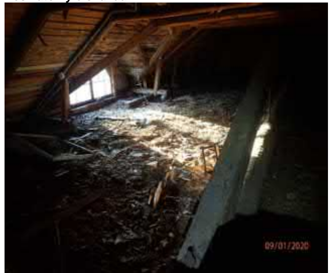
Ullakon lattialla on olkia ja sahanpurua tms.
