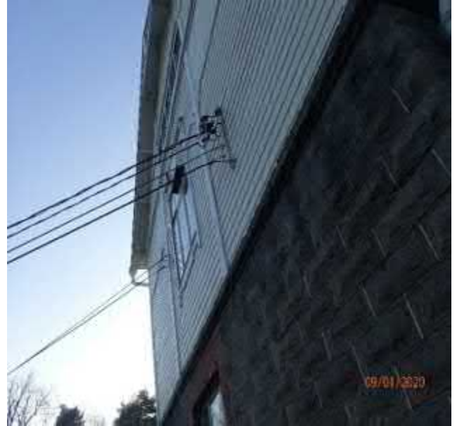
Lautaverhoilu on ulkoisesti tyydyttävän kuntoinen.
