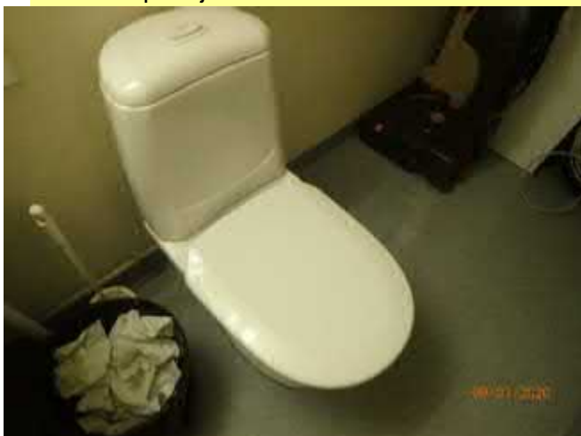
Saniteettitilat ovat välttävässä kunnossa.
