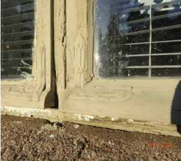
Ikkunanmaali hilseilee useissa paikoissa.
