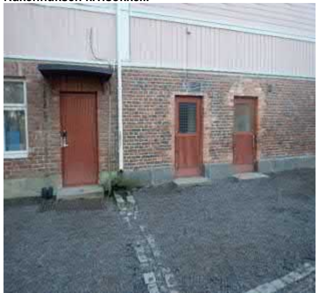
Kattovedet kastelevat osittain sokkelirakennetta.
