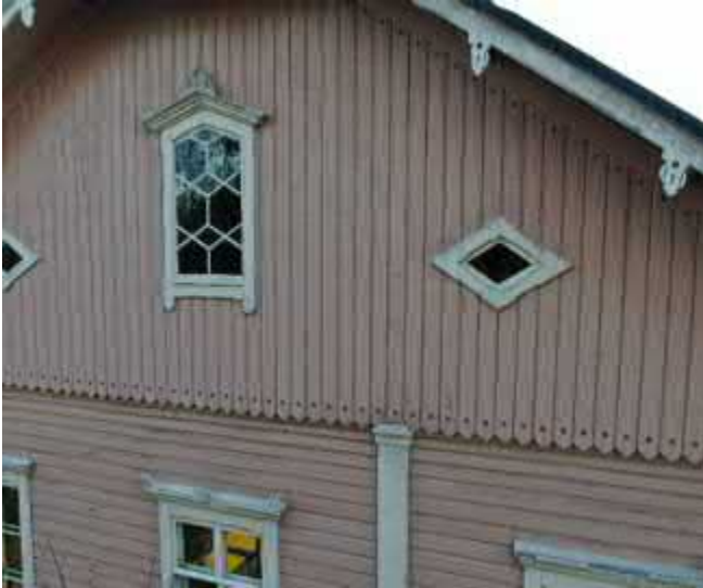
Ulkolaudoitus on tyydyttävässä kunnossa.
