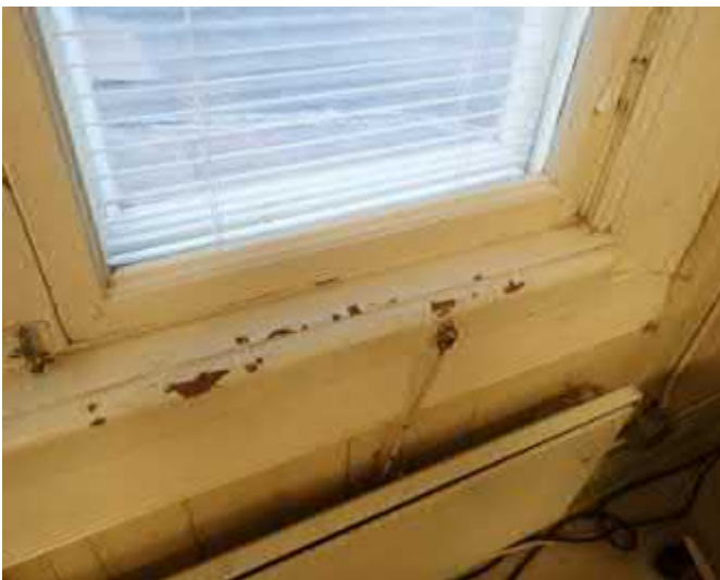
Ikkunanmaali hilseilee useissa paikoissa.
