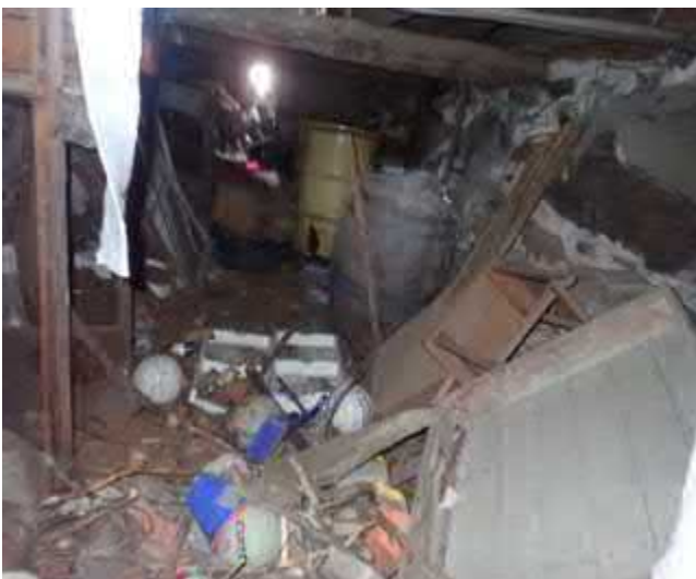
Alapohjassa on jonkin verran romutavaraa.
