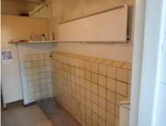
Saniteetitilat ovat välttävässä kunnossa.
