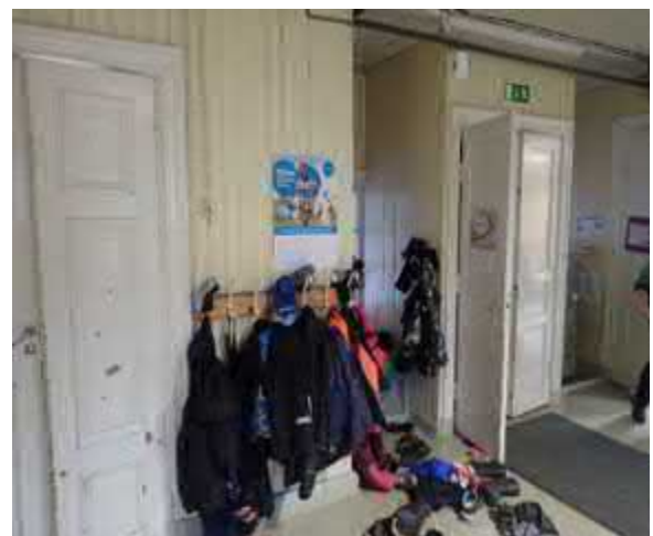
Luokkahuoneet ovat ulkoisesti välttävässä kunnossa.
