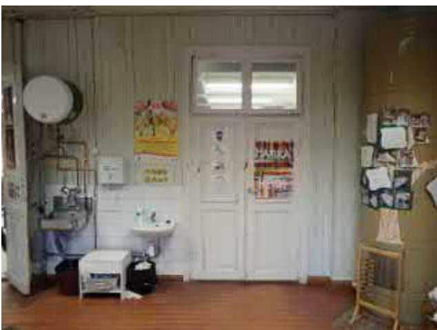
Eteisaulan pinnat ovat kuluneita.
