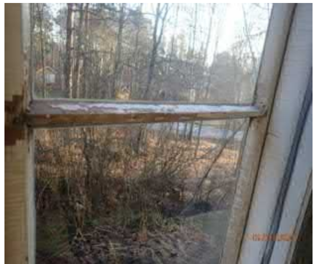
Ikkunanmaali hilseilee useissa paikoissa.
