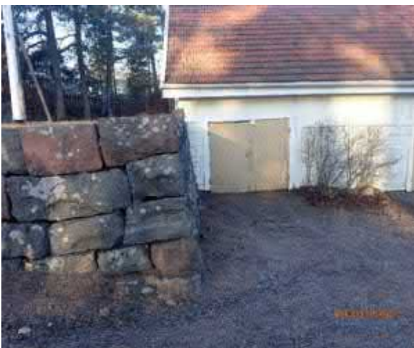
Pihan kivimuurin päältä on putoamisvaara.
