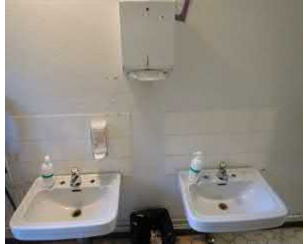
Saniteetitilat ovat välttävässä kunnossa.
