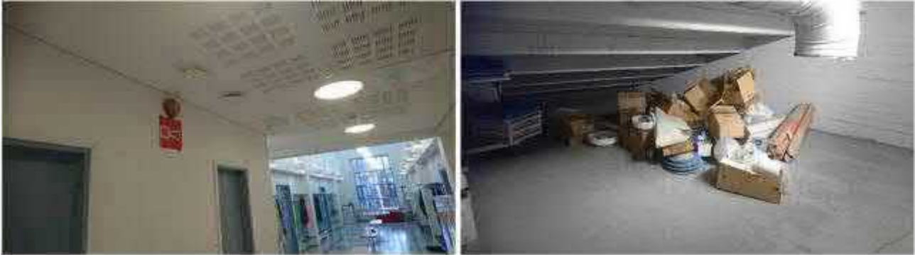
Kuva 197 Wc-tilojen poistojen tarvitsema korvausilma johdetaan korvausilmakanavien kautta. Auditorion alla sijaitsevaa siirtoilmatilaa käytetään varastona.
