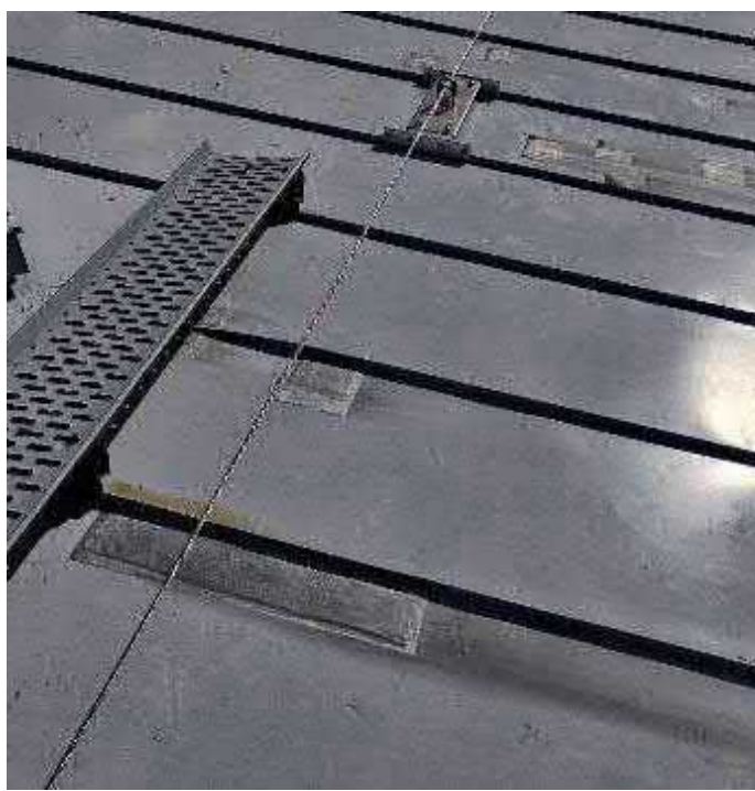
Kuva 155. Alkuperäisten peltikatteiden pinnoilta havaittiin pinnoitteen rikkoutuneen useasta kohdasta.
