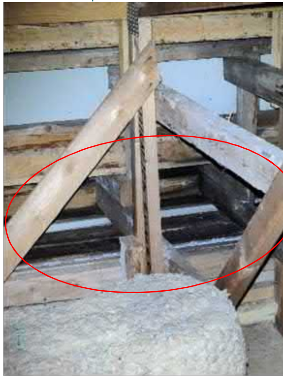
Kuva 163. Piilokourujärjestelmän rakenteista havaittiin vaurioita useassa paikassa. Kuva liikuntasalin ja ruokalan yläpuolelta.
