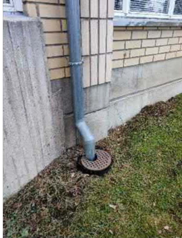
Kuva 19. Sadevedet oli ohjattu suoraan sadevesijärjestelmään.
