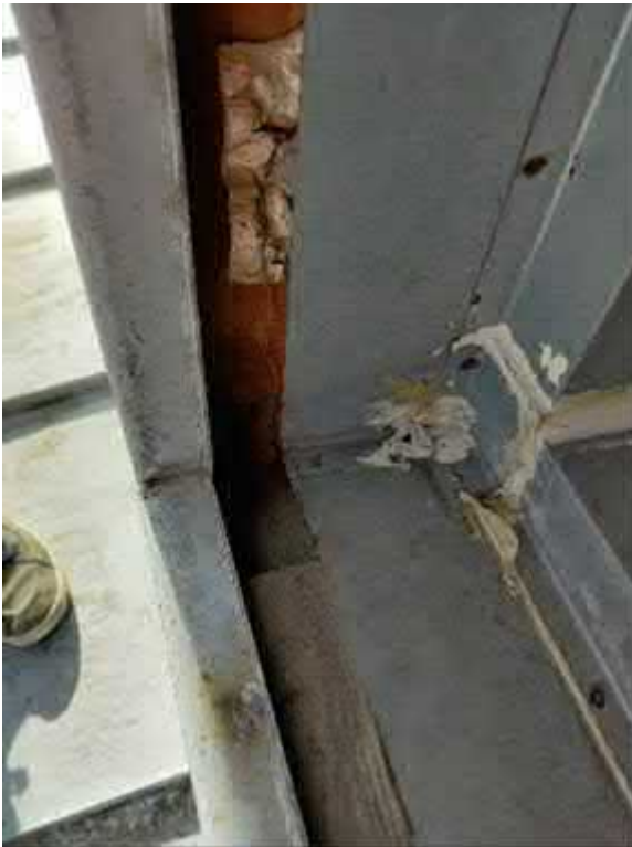
Kuva 160. Liikuntasalin IV-konehuoneen tuloilmäsäleikköjen ja seinän liitoskohdasta havaittiin epätiiveyksiä, joiden kautta vesi pääsee rakenteisiin.
