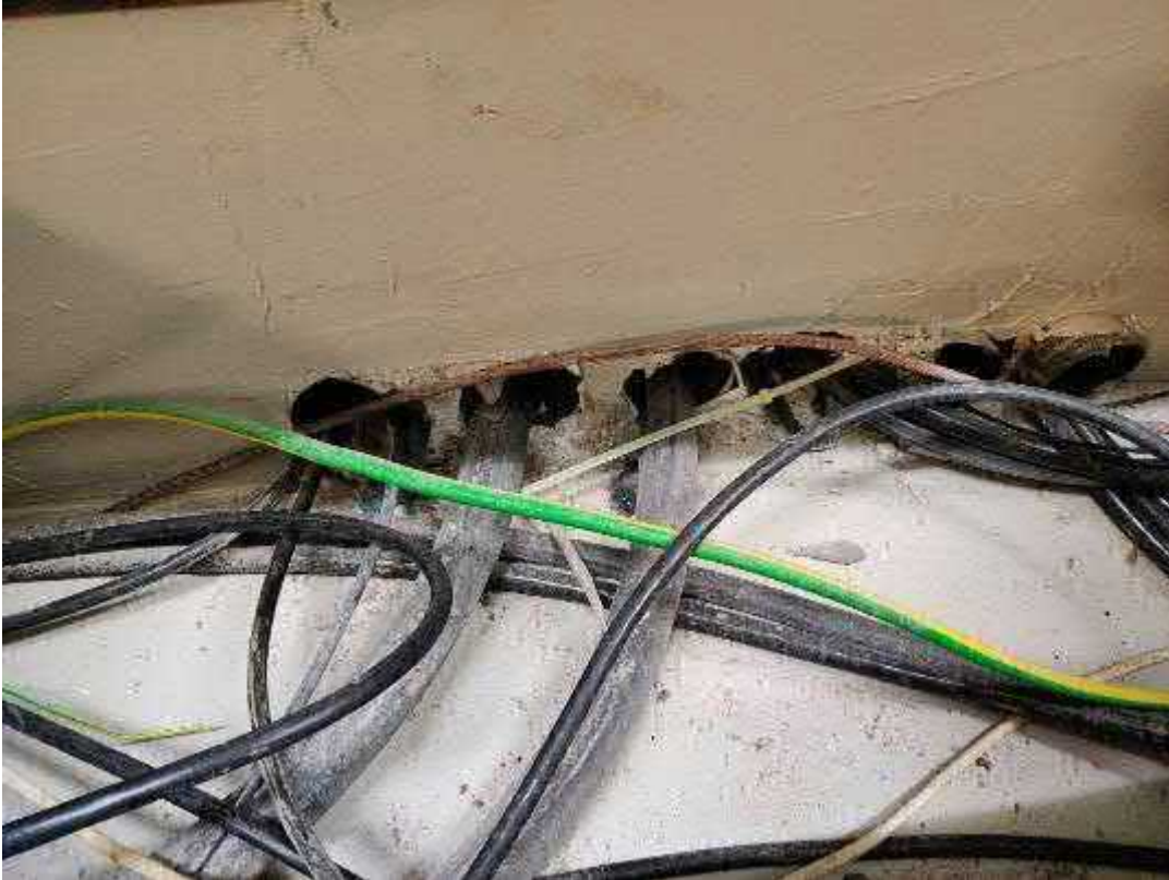
Kuva 64. Sähkökeskuksen alapuolelta havaittiin epätiivitä kaapeliläpivientejä. Tilassa havaittiin mikrobiperäistä hajua.
