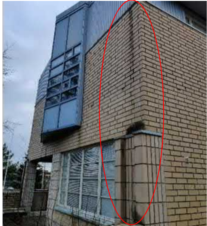
Kuva 112. Kosteuden aiheuttamia tummentumia rakennuksen luoteissivustalla kerhuhuoneen ja asunnon kohdalla.
