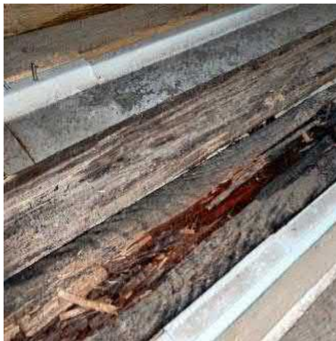
Kuva 169. Piilokourujärjestelmän sisäpuolisissa koolauksissa havaittiin lahovaurioita liikuntasalin yläpuolella.
