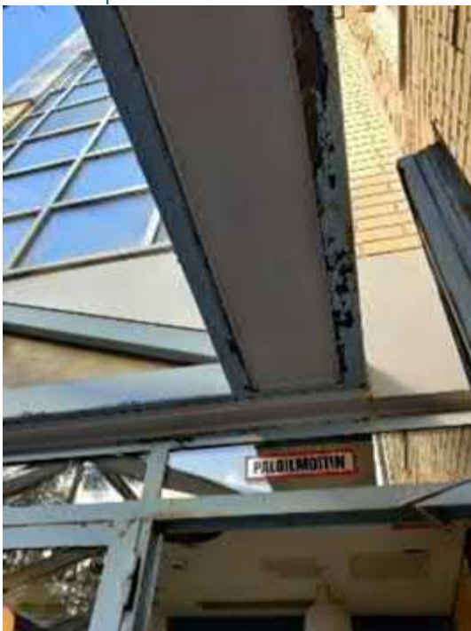
Kuva 142. Itäisen sisäänkäynnin katoksesta havaittiin ruostetta.
