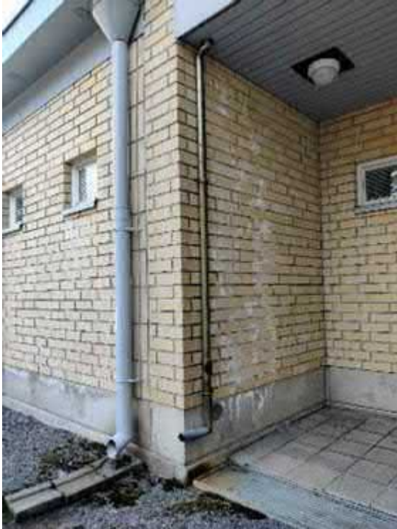
Kuva 165. Liikuntasalin sisäänkäynnin katoksen sadeve- sisyöksy vuotaa.
