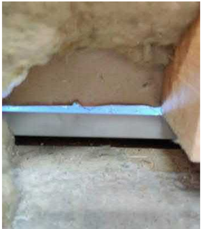
Kuva 130. Kotelarakenteiden tuulensuojalevyn ja ulkopuolisen ikkunapellityksen välissä on rako, josta vesi kulkeutuu sateen ja tuulen vaikutuksesta rakenteisiin. Tuulensuojalevyn alaosasta havaittiin kosteuden aiheuttamia jälkiä.
