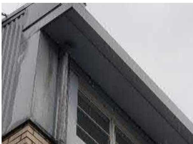
Kuva 171. Vuotava kouru rakennuksen itäsivulla.
