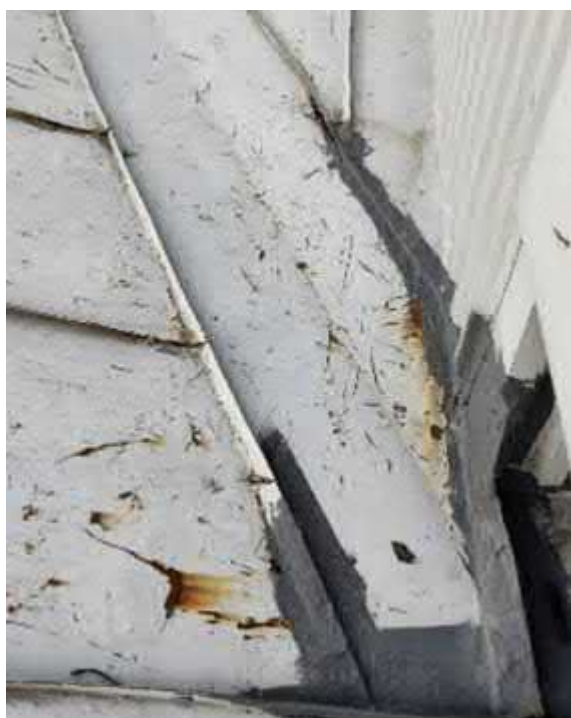
Kuva 154. Alkuperäistä vesikatteen saumakohtia ja liitoksia oli paikattu.
