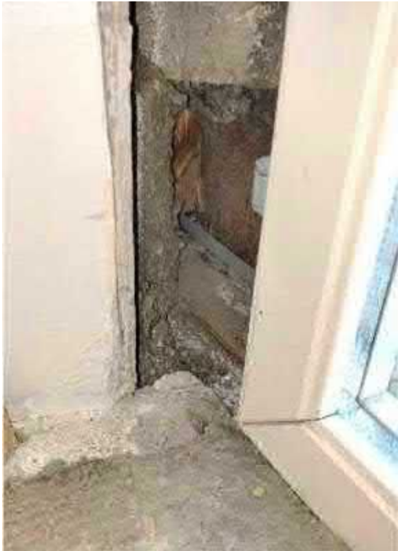
Kuva 131. Pohjoissivustalla kaarevien ulokkeiden reunoilla oli koteloitu rakenne. Rakenteessa ei havaittu höyrynsulkukerrosta. Rakenteen eristekerrokset, tuulensuojalevy ja rakenteessa sijaitsevat puut ovat vaurioituneita.
