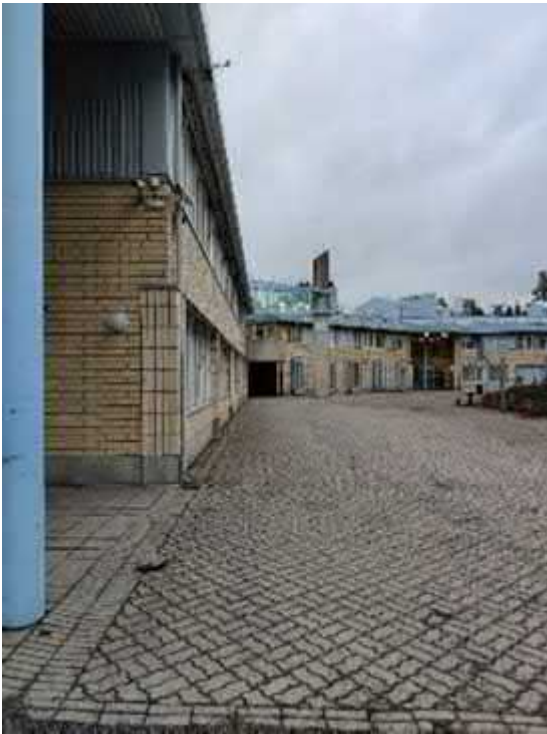
Kuva 4. Eteläisen ylärinteen puolella sijaitseva sisäpiha on kivetetty. Kivetyksen pinta kallisti loivasti rakennukselta pois päin. Kallistuksissa on paikoittain puutteita.
