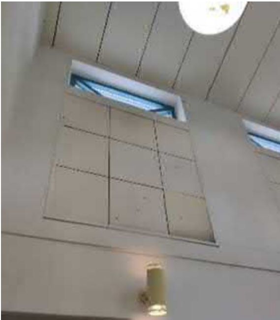
Kuva 177. Lounaissivustan käytävän seinään kiinnitetyistä akustiikkalevytyksistä havaittiin tummentumia.
