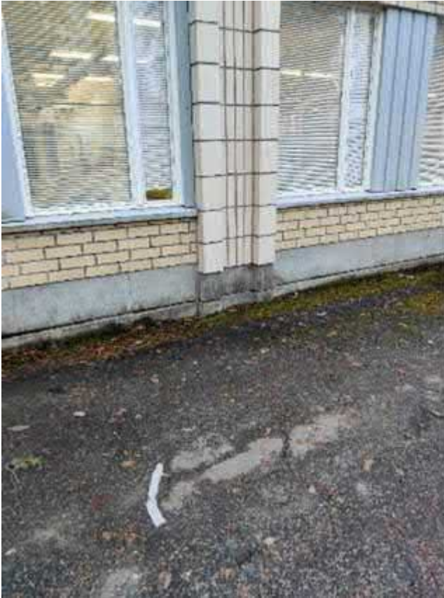
Kuva 45. Itäseinustalla sokkeli-elementtiin kohdistuu kosteusrasitusta.
