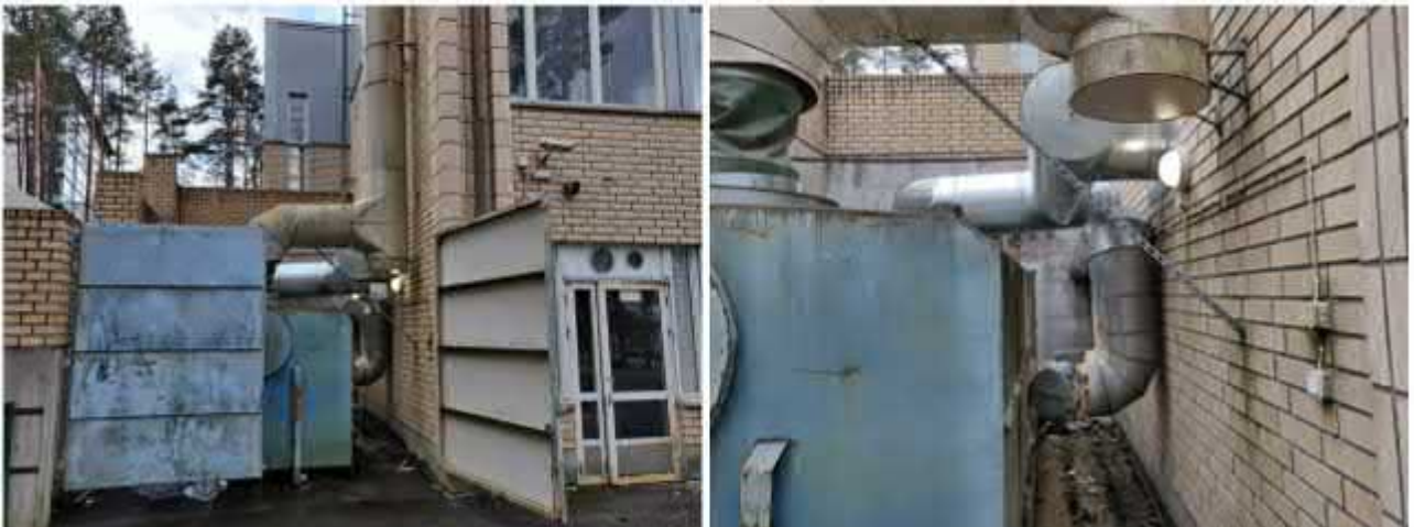
Kuva 189 Ulkoilmasäleikön kanssa samassa syvennyksessä sijaitsevan purukontin ja purunpoistokanaviston liitos on epätiivis
