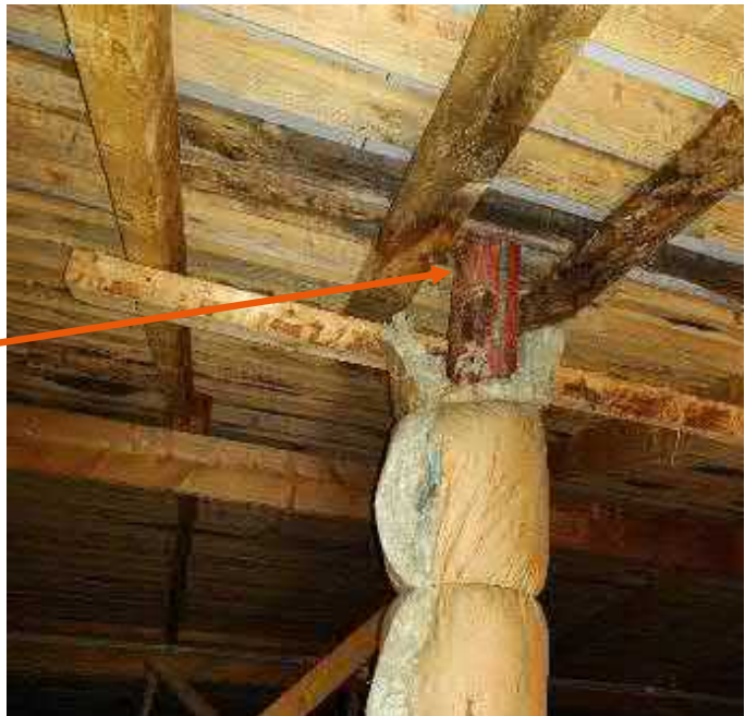
Kuva 159. Vesivuodot olivat vaurioittaneet viemärin tuuletusputkea ja ympäröiviä ruodelaudoituksia.
