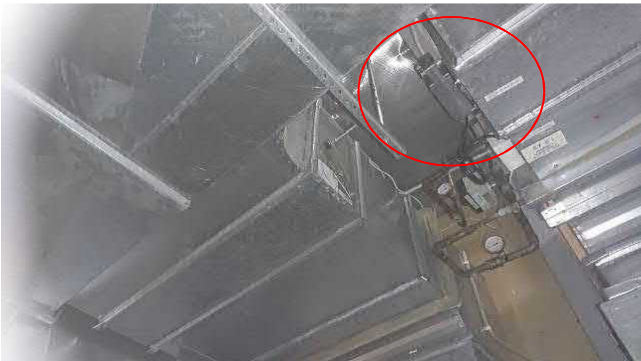
Kuva 190 TK6:n ruokailan tuloilmakanavassa on moottoripelti 6.5.3, jonka toiminnasta ei ole selvyyttä.
