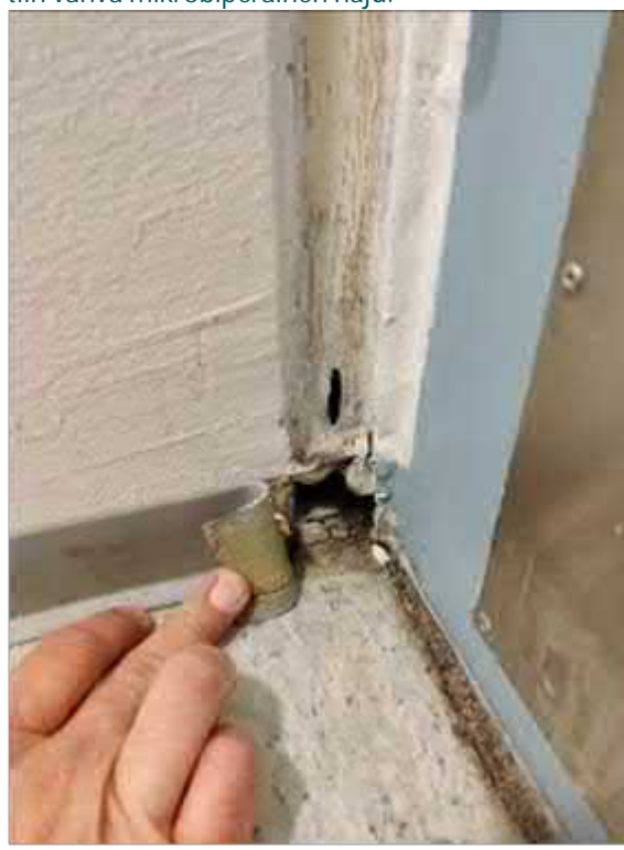
Kuva 98. Liikuntasauva oli epätiivis seinän ja välipohjan liittymäkohdasta.
