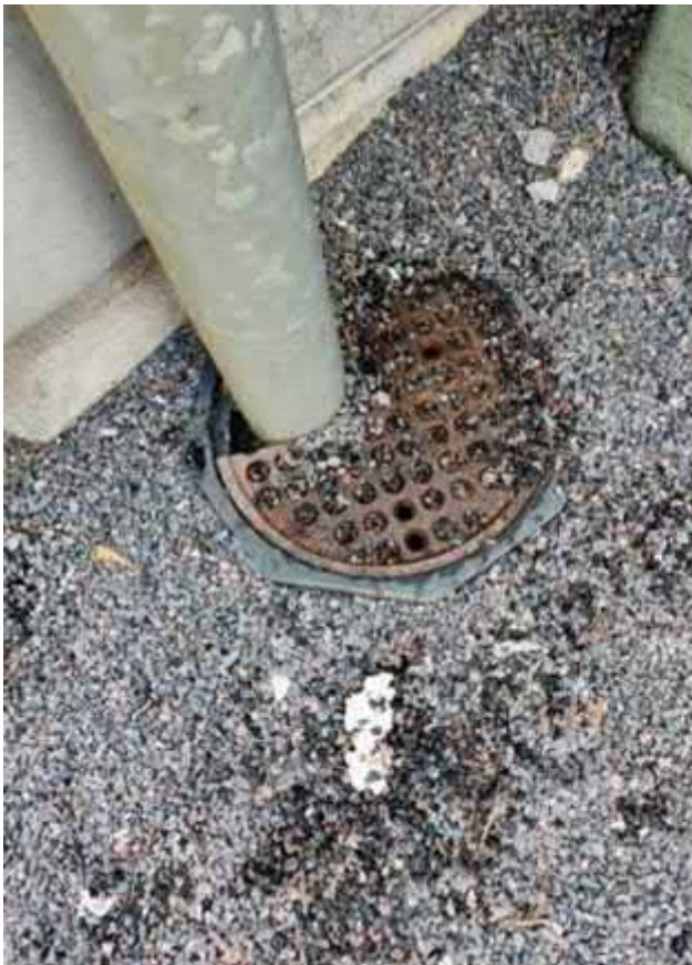
Kuva 20. Rakennuksen lounaissivustan sisäänkäynnin kohdalla on tukkeutunut sadevesikaivo.
