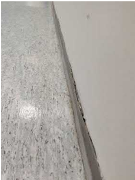
Kuva 69. Kantavan väliseinärakenteen alaosaan muovinen jalkalista on irronnut ja liima muovisen jalkalistan taustalla on vaurioitunut.
