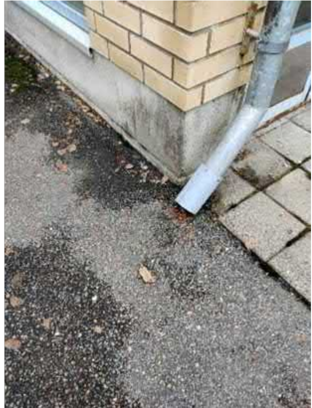
Kuva 23. Itäsivustan sisäänkäynnin vierustan sokkelista havaittiin kosteuden aiheuttamia jälkiä. Asfaltista havaittiin merkkejä veden lammikoitumisesta.
