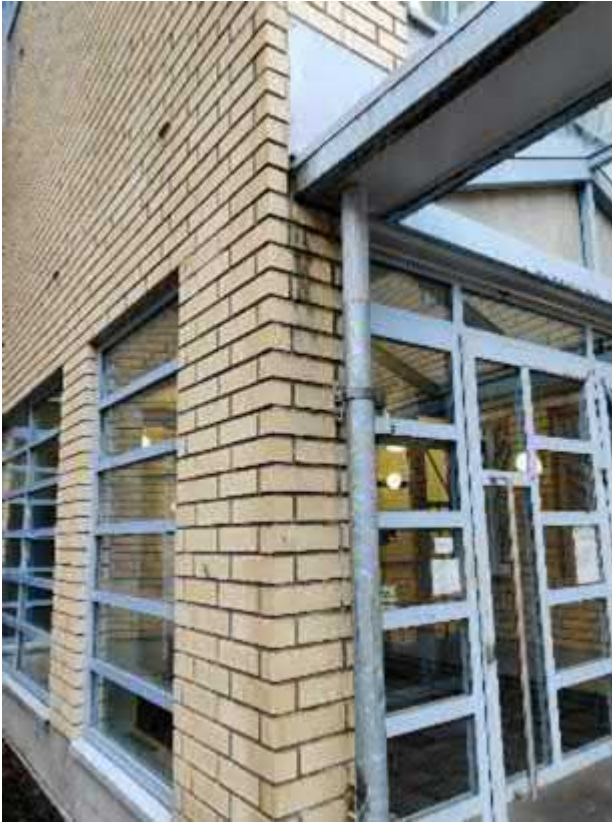
Kuva 22. Rakennuksen itäseinustan katokselta johdetut vedet ajautuvat sisäänkäynnin vierustalle.
