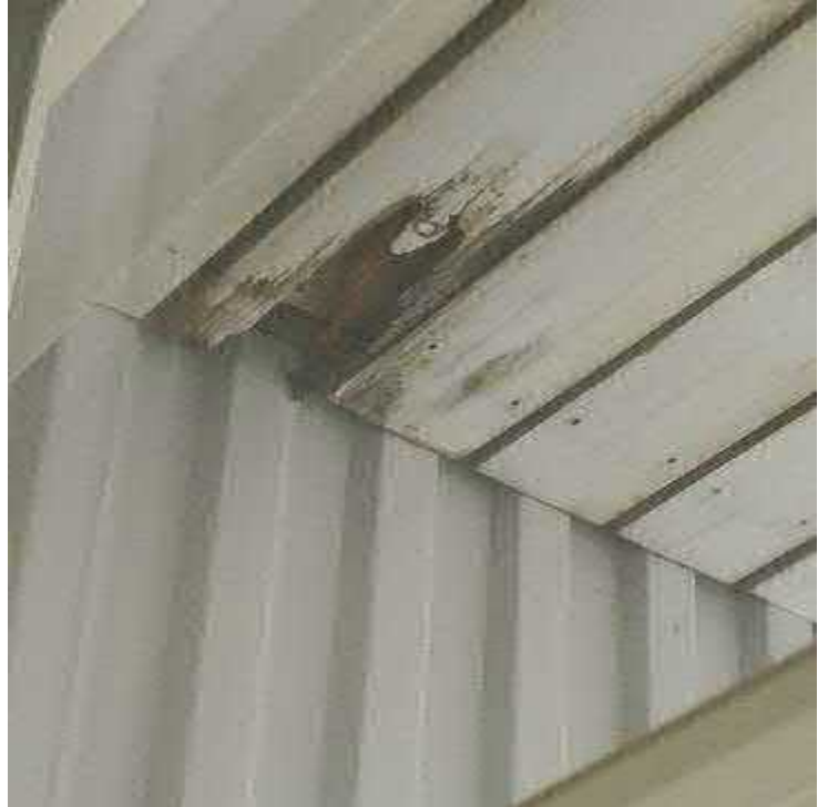
Kuva 137. Rakennuksen lounaissivustan sisäänkäynnin kohdalla katoksen alapuolisista laudoituksista havaittiin lahovaurioita.
