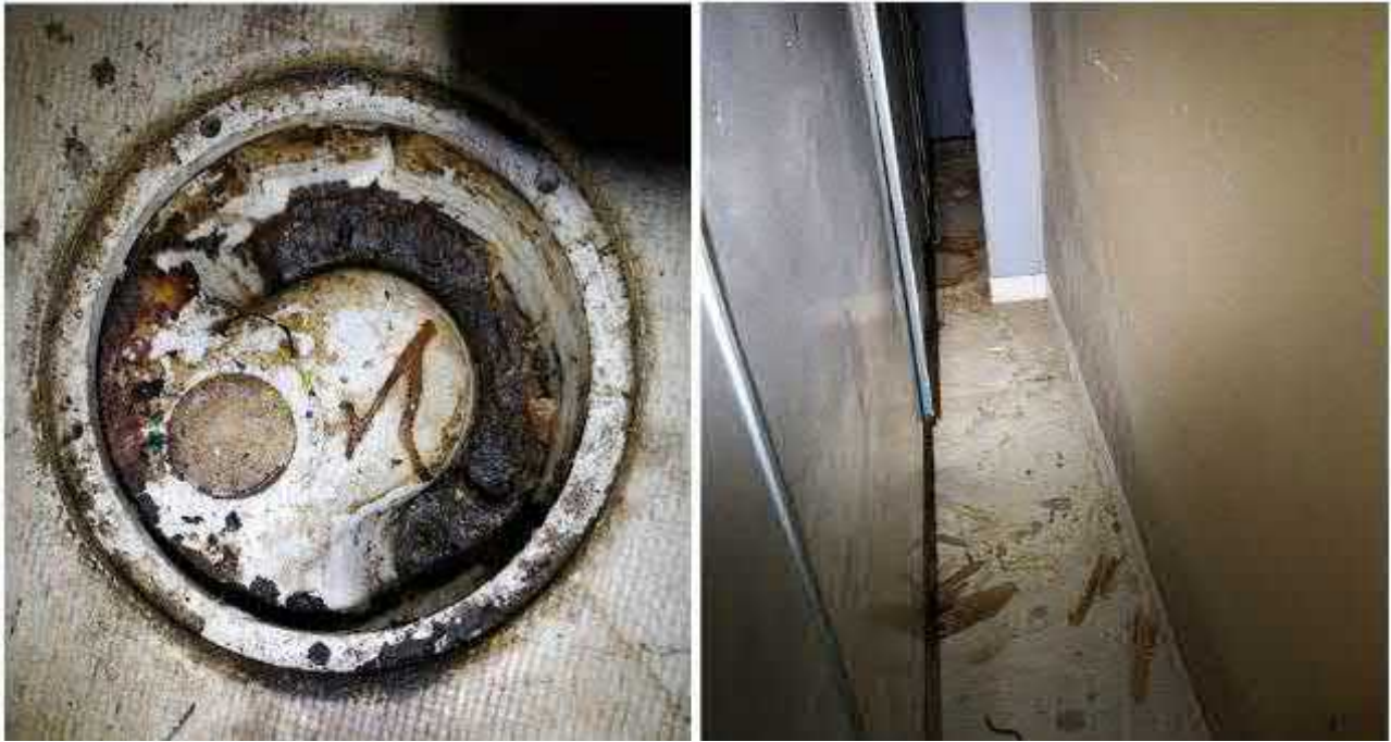
Kuva 185 TK2:n takainen seinärakenne vaikuttaa silmämääräisesti arvioituna mikrobivaurioituneelta. Kaikki ilmanvaihtokonehuoneen lattiakaivot olivat tukkeutuneita.
