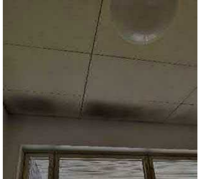
Kuva 176. Lounaispään käytävän sisäkattolevytyksistä havaittiin tummentumia.
