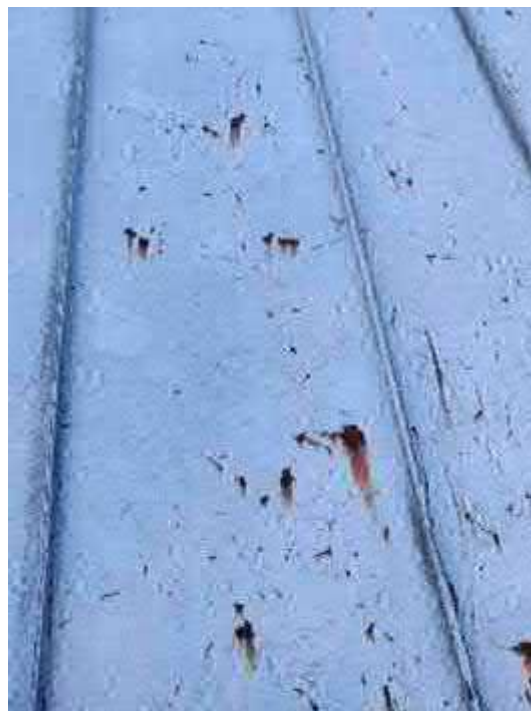
Kuva 153. Alkuperäisten peltikatteiden pinnoilta havaittiin pinnoitteen rikkoutuneen useasta kohdasta.
