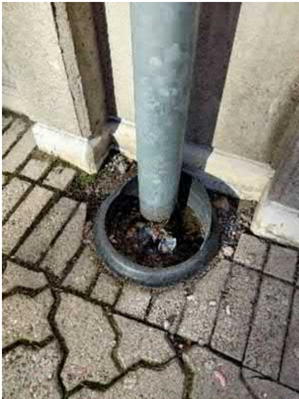
Kuva 24. Osa sadevesikaivojen roskasihdeistä oli täynnä mm. kasvillisuutta ja roskaa.
