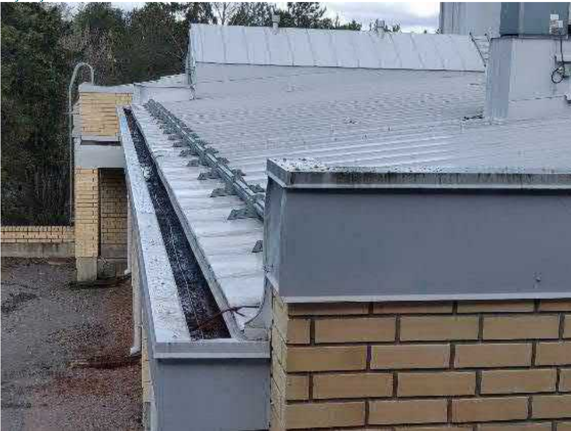
Kuva 167. Piilokourujärjestelmä rakennuksen lounaissivustalla.
