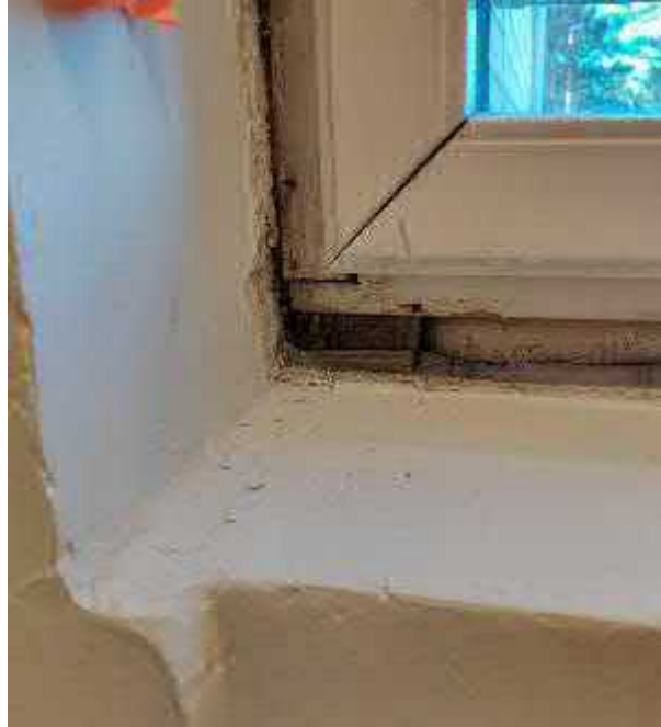
Kuva 128. Asennuskiilat oli jätetty rakenteeseen. Kiiloista havaittiin pehmentymää ja mikrobivaurioita.
