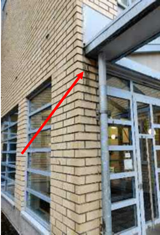
Kuva 136. Itäpuolen sisäänkäynnin katoksen vedenpoistossa havaittiin puutteita. Seinässä on kosteuden aiheuttamia jälkiä.
