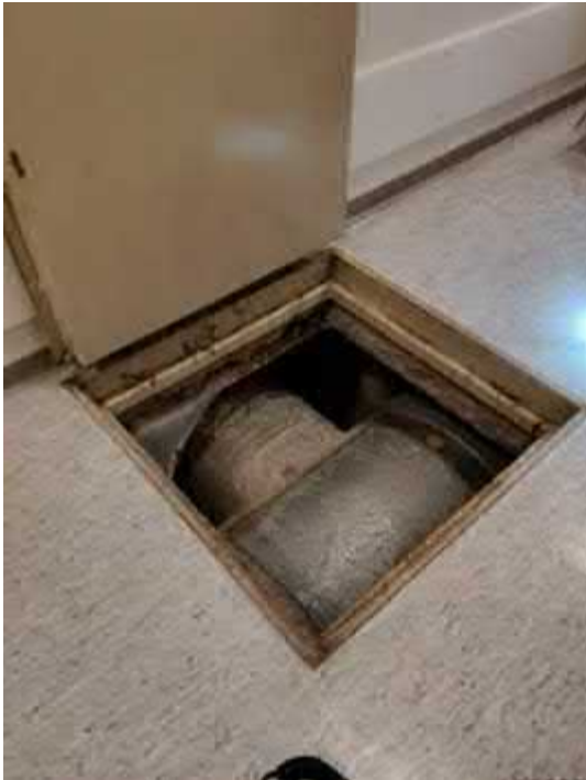
Kuva 60. Alapohjakanaalin tarkastusluukku. Luukku ei ole ilmatiivis.
