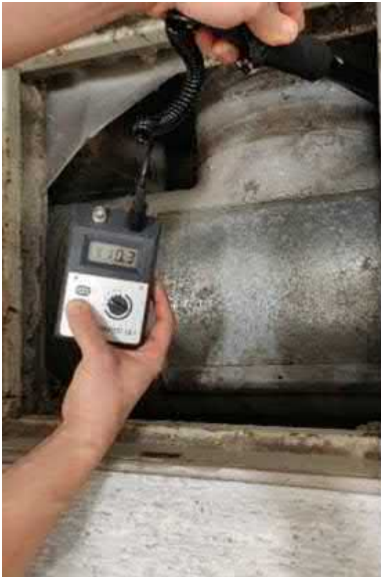
Kuva 62. Pintakosteudenkartoituksessa havaittiin kohonneita lukemia alapohjakanaalin pohjalta ja seinämiltä.
