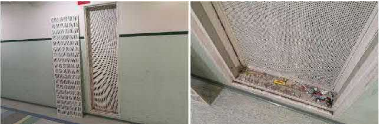
Kuva 195 Käytävien syrjäyttävään ilmanjakoon tarkoitettujen päätelaitteiden puhtaus havaittiin puutteelliseksi.
