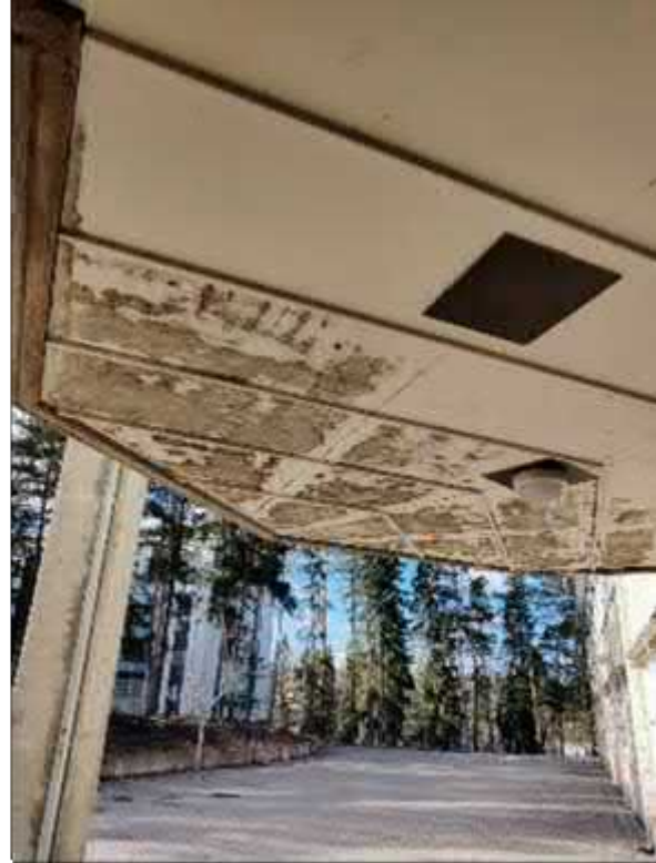
Kuva 141. Eteläpuolen sisäänkäynnin vanerointien pinnoitteet olivat irtoilleet.
