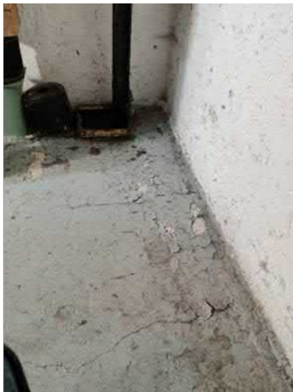
Kuva 92. Maalipinta oli monin paikoin irtoillut kuilun alapohjarakenteen pinnasta.
