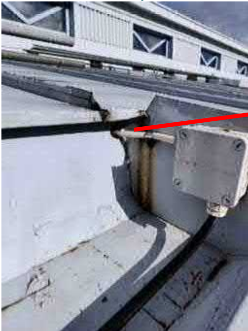
Kuva 138. Lounaissivustan sisäänkäynnin piilokourujärjestelmän lämmityskaapelin läpivienti on tiivistämättä.
