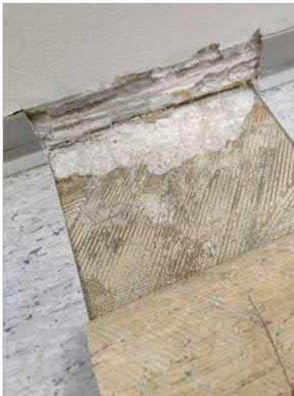
Kuva 173. Kosteus on noussut alapohjarakenteisiin perustusrakenteilta kapillaarisesti ja vaurioittanut tasoitteita ja mattojen liimoja. Myös muovisten jalkalistojen taustat ovat monin paikoin vaurioituneita.
