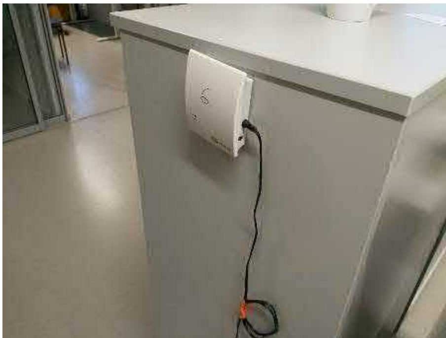
Esimerkkikuva. Sisäilman hiilidioksidipitoisuusmittaus (FCG Oy).
