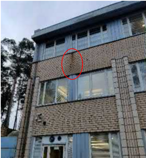
Kuva 107. Teknisen työn tilojen edustalla vuotava sadevesikouru on aiheuttanut kosteusrasitusta rakennuksen julkisivuun.
