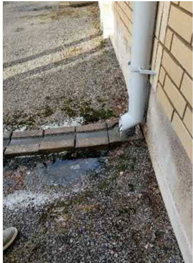
Kuva 21. Liikuntasalin pukuhuonetilojen edustalla sadevedet ohjautuvat rakennuksen vierustalle. Betoniset sadevesikourut ovat epätiivittä.
