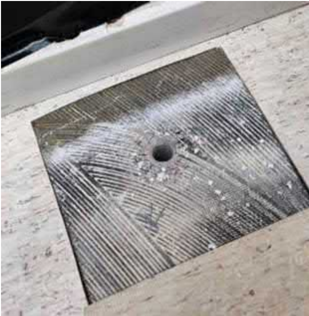
Kuva 54. Kosteus siirtyy kapillaarisesti alapohjarakenteisiin ja vaurioittaa päällystemateriaaleja. Kuvassa reuna-alueen tumma alue on märkä. Muut alueet kosteita.
