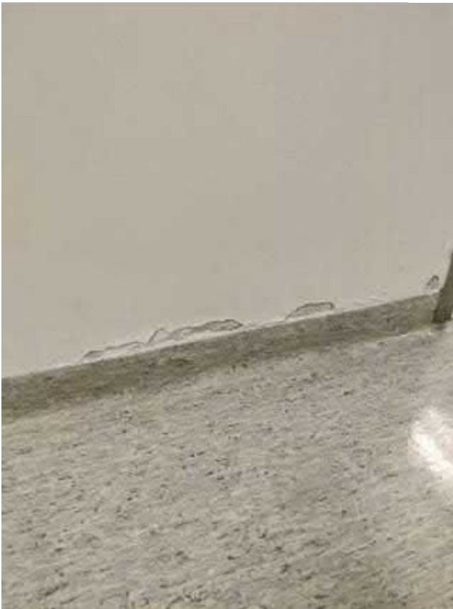
Kuva 182. Märkätilojen vastaisten seinien alaosista ja ympäröivistä alapohjarakenteista havaittiin kosteuden aiheuttamia vaurioita.
