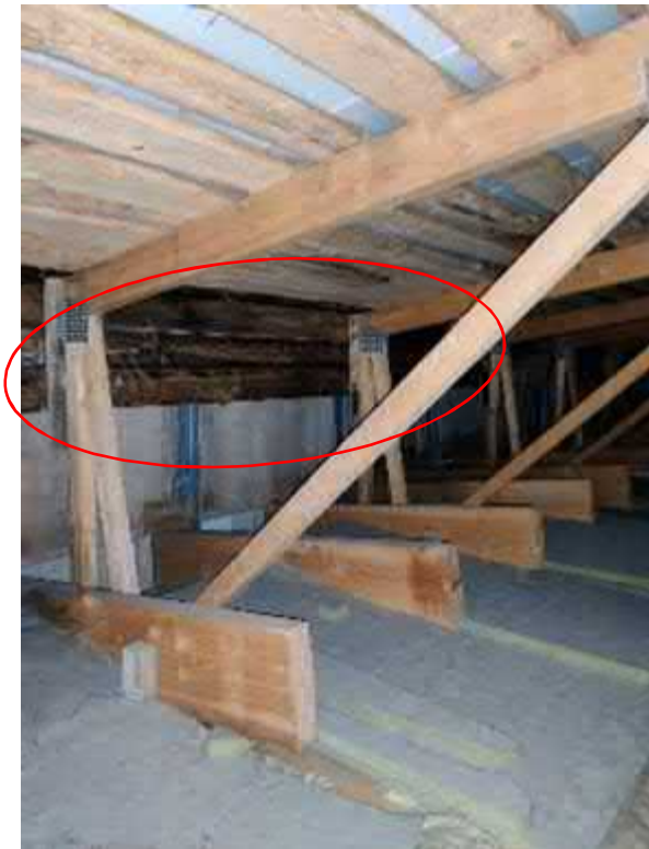
Kuva 162. Lounaiskulman sisäänkäynnin kohdalla räystääslaudoista havaittiin vaurioita (tummentumat).
