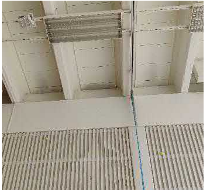
Kuva 178. Liikuntasalin akustiikkalevytyksistä havaittiin tummentumia. Seinän ja katon liitoskohdasta havaittiin myös kosteusjälki.
