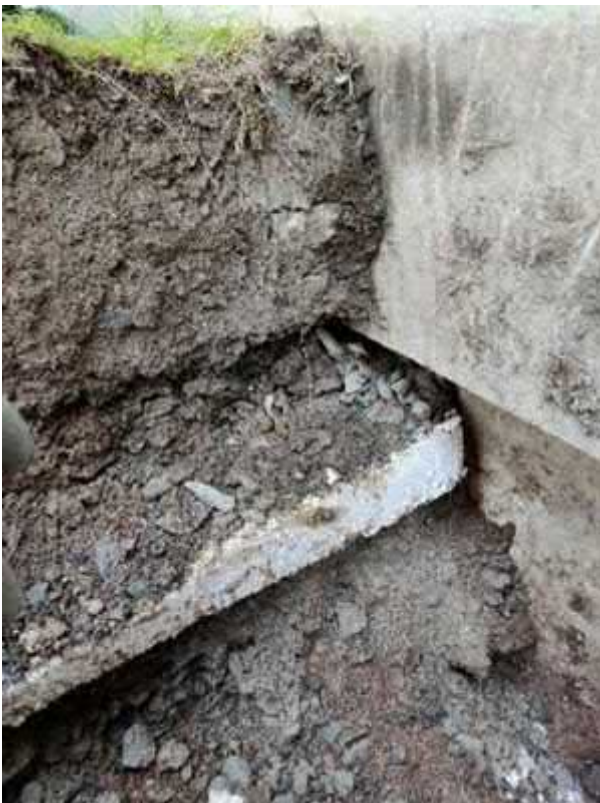
Kuva 47. Sokkeli-elementti on asennettu routaeristyksen yläpuolelle. Routaeristys on asennettu perusmuurin EPS-eristettä vasten. Routaeristeen kallistuksissa oli puutteita.
