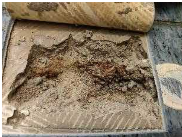
Kuva 96. Liikuntasaumassa on käytetty kovalevyä. Kovalevy oli aistinvaraisesti vaurioitunut ja rakenteesta havaittiin vahva mikrobiperäinen haju.
