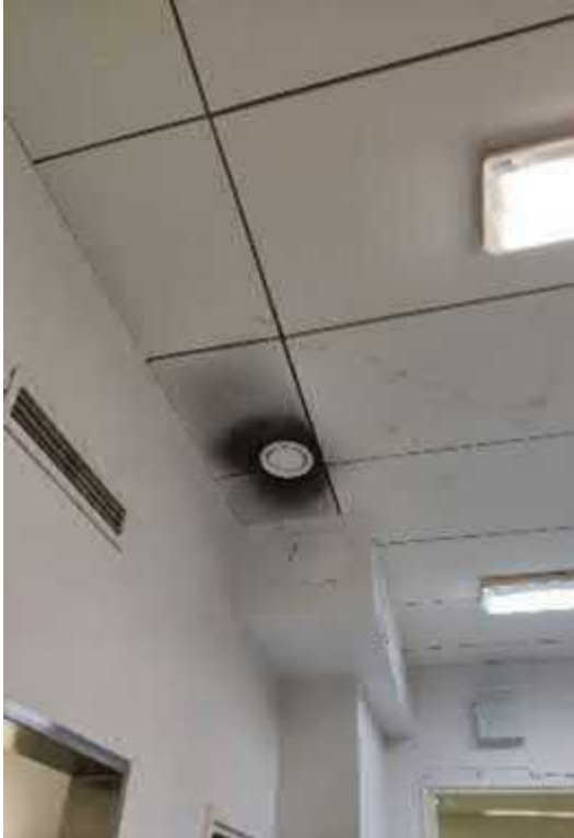
Kuva 179. Pukuhuonetilojen akustiikkalevyjen ympärökset olivat mustuneet ilmavirtausten vaikutuksesta.
