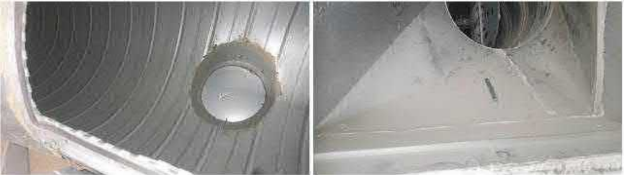
Kuva 193 Tuloilmakanavan (vas. kuva) pinnat todettiin puhtaiksi ja öljyttömiksi. Poistoilmapäätelaitteen pinnat havaittiin pistokokeessa selkeästi pölyntyneiksi.
