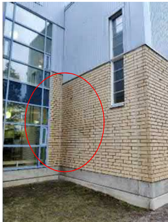
Kuva 110. Korkeissa julkisivuissa ei ole räystäitä ja ikkunasyvennyksissä tuulen ja sateen yhteisvaikutus aiheuttaa kosteusrasitusta julkisivuelementteihin.
