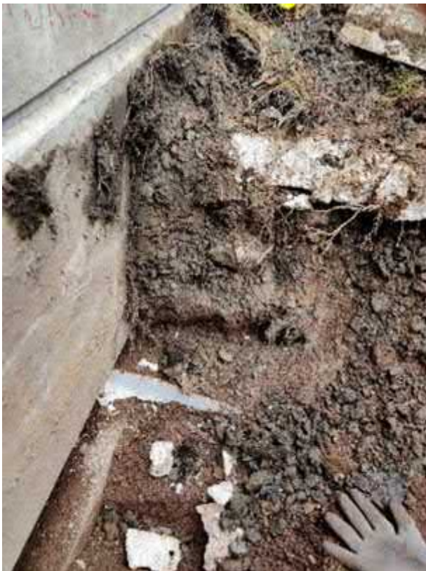
Kuva 9. Koekuoppa KK3. Rakennuksen vierustäyttö on hienojakoista maa-ainesta. Joukossa on vähäisiä määriä soraa. Routaeristeiden kallistuksissa on puutteita.
