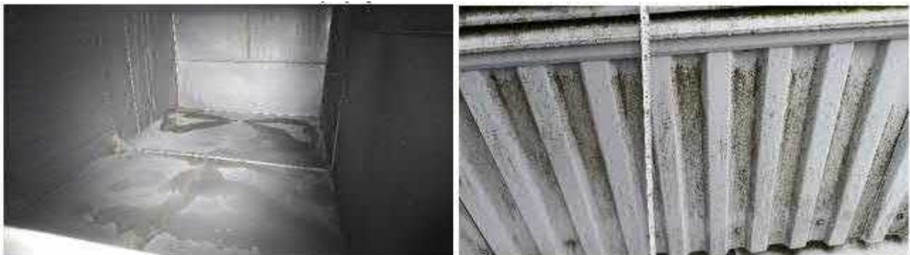
Kuva 183 Koneen tuloilmakammiossa oli pieniä määriä orgaanista ainesta ja selkeitä lammikoitumisjälkiä. Koneilla TK1, TK3 ja TK5 on yhteinen ulkoilmasäleikkö, jonka alareunan korkeus kattopinnasta noin 64 cm.
