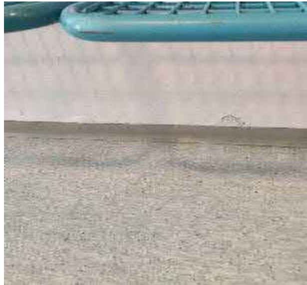
Kuva 90. Itäisivustan portaikon seinämärakenteen alaosasta havaittiin maalipinnan kupruilua.
