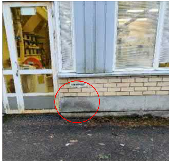
Kuva 108. Kosteuden aiheuttamia jälkiä julkisivuelementin alaosassa teknisen työn edustalla.
