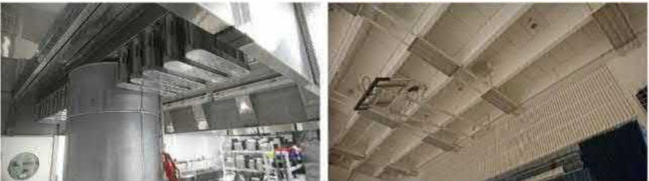
Kuva 196 Keittiön kohdepoistot todettiin puhtaiksi ja pinnoiltaan rasvattomiksi. Liikuntasalin katon akustiikkalevyissä havaittiin tummentumia, jotka voivat johtua välipohjarakenteen kosteudesta tai ilmapuodoista välipohjarakenteen lävitse.
