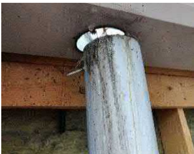
Kuva 170. Sadevesisyöksy oli irronnut piilokourun kiinnityksestä ja vesi oli kastellut rakenteita itäseinustalla.
