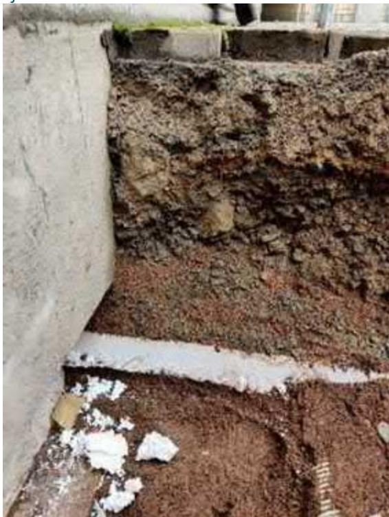
Kuva 16. Koekuoppa KK2 rakennuksen yläpihalla. Sala- ojaputki sijaitsee hienojakoisen maa-aineksen jou- kossa. Salaojan korkeusasema on virheellisesti antura- pinnan yläpuolella.
