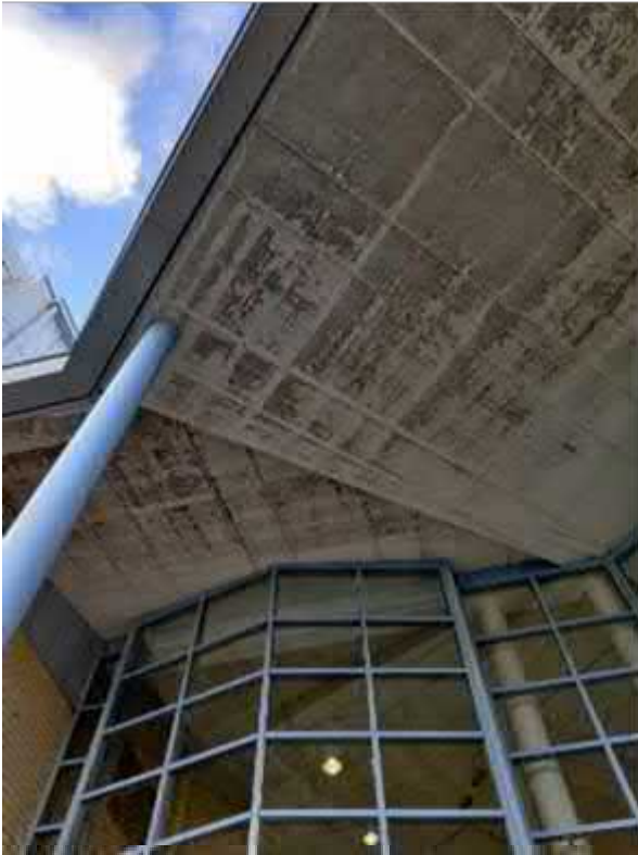
Kuva 140. Pääsisäänkäynnin ja ruokalan edustalla sijaitsevan katoksen alapuolisten vanerointien pinnoitteet olivat monin paikoin irtoilleet.
