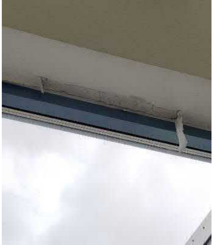
Kuva 122. Käytävän 3105 päädyssä sijaitsevan metallisen ikkunan yläosan maalikerrokset olivat irtoilleet.
