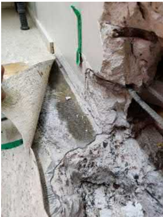
Kuva 31. Perustuksilta nousee kapillaarisesta kosteutta liittyviin rakenteisiin. Kuva on länsipäädyn asunnosta osastoivan väliseinän rakenneavauksen kohdalta.
