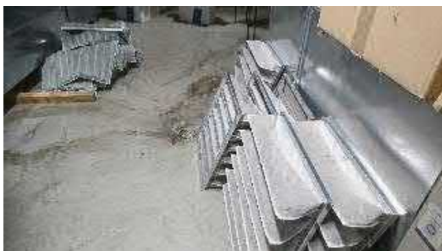
Kuva 184 B1-osan IV-konehuoneessa käytettyjä suodattimia.
