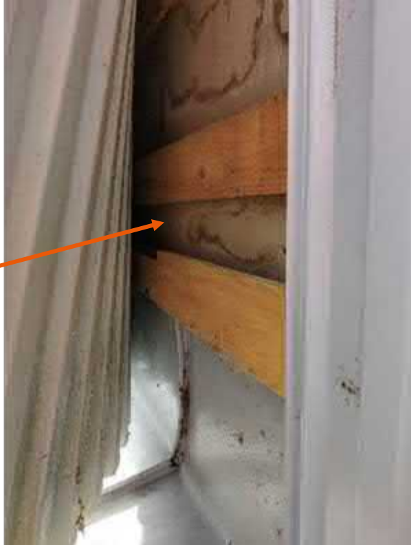
Kuva 157. Seinämän pellitysten taustalta havaittiin vuotojälkiä kipsilevyn pinnassa. Aiheuttajaksi epäiltiin ylempänä vesikatolla sijaitsevaa IV-konehuoneen tuloilmasäleikön liitosta seinärakenteeseen.
