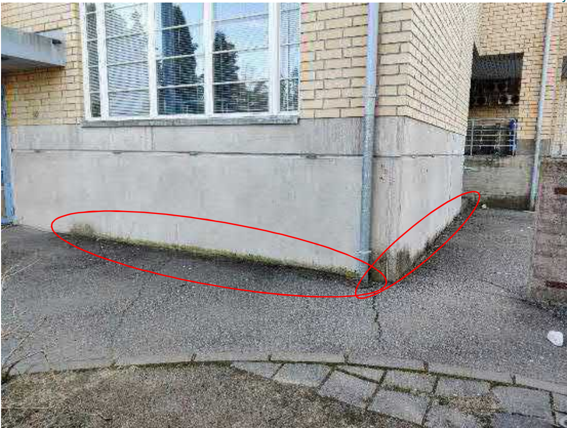
Kuva 6. Lastauslaiturin vieressä rakennuksen maanpinnan kallistukset olivat puutteelliset. Asfaltin pinnalta sokkelin vierestä havaittiin merkkejä veden lammikoitumisesta.
