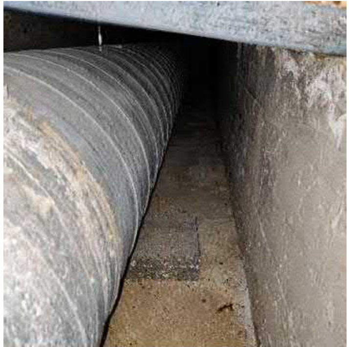
Kuva 61. Kanaalin pohjasta ja seinämiltä havaittiin kosteuden aiheuttamia jälkiä.
