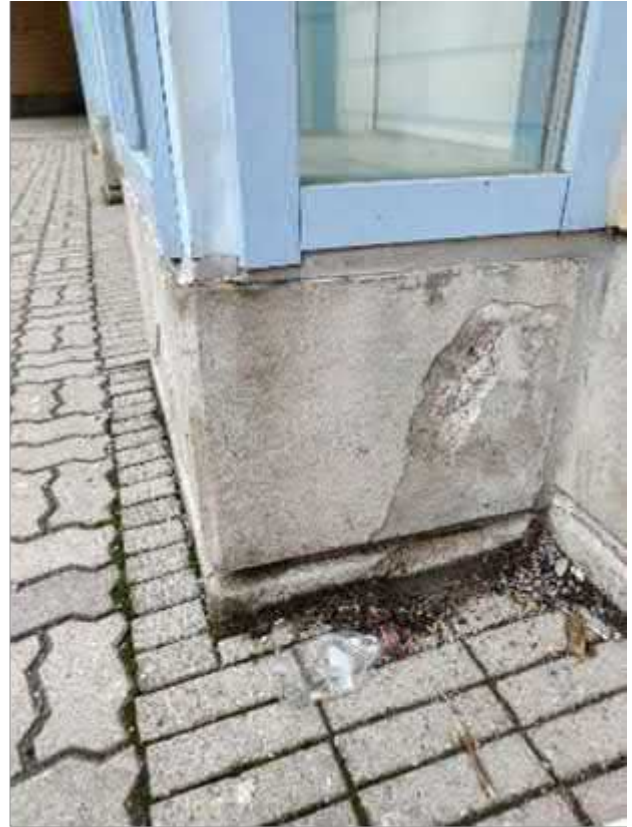
Kuva 46. Auditorion kohdalla maanvastaisen seinärakenteen ulokkeiden kohdalla sokkelirakenteista havaittiin rapautumia.
