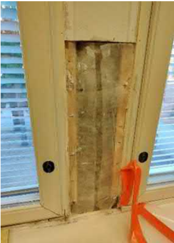
Kuva 129. Pohjoissivustalla ikkunoiden välisten levytysten sisäpuolinen höyrynsulku on epätiivis. Eristeissä on mikrobivaurioita.
