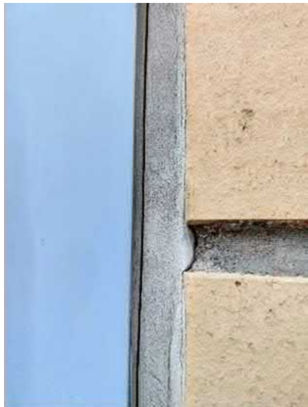
Kuva 114. Alkuperäisistä elementtisaumauksista havaittiin ikääntymisen aiheuttamaa massauksen pinnan halkeilua. Saumaus on irronnut ikkunarakenteesta rakennuksen lounaissivustan ikkunasyvennyksessä.
