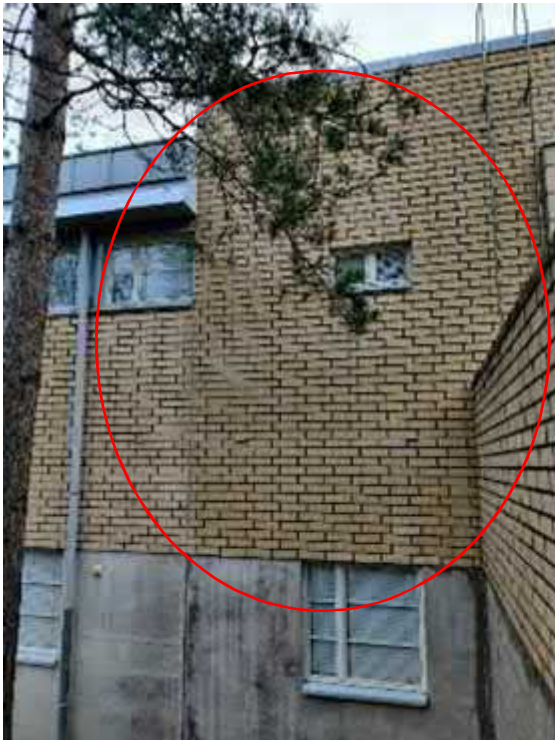
Kuva 111. Rakennuksen lounaissivustalla keittiöhenkilökunnan taukotilojen kohdalla on kosteuden aiheuttamia tummentumia julkisivuelementissä.
