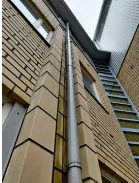
Kuva 166. Itäisivustalla vuotava sadevesisyöksy.
