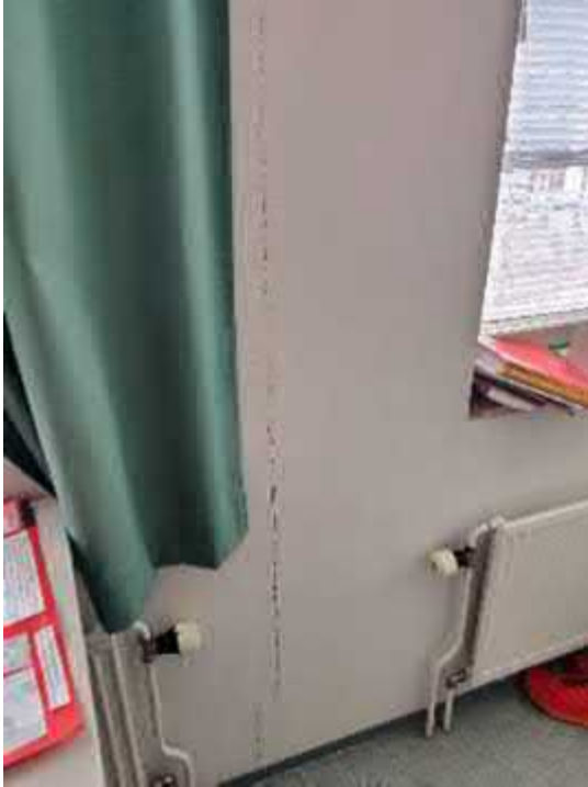
Kuva 119. Halkeama ulkoseinän sisäkuoressa. Merkkiainekokeiden yhteydessä havaittiin ilmapuotoja rakenteen eristekerroksesta sisätiloihin halkeamien kautta.
