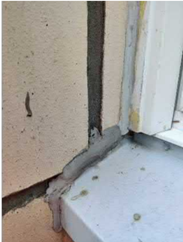
Kuva 124. Ulkupuolisten pellitysten kittaukset olivat alkuperäisiä ja niissä näkyi ikääntymisen aiheuttamaa halkeilua. Kittauksissa havaittiin epätiivyyksiä, joista sadeveden on mahdollista kulkeutua rakenteisiin.
