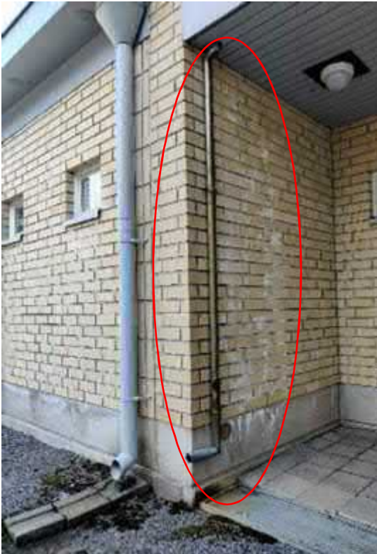
Kuva 115. Liikuntasalin pukuhuoneiden sisäänkäynnin kohdalta havaittiin voimakasta kosteusrasitusta ulkoseinärakenteessa, joka on aiheutunut vuotavasta sadevesiyöksystä.
