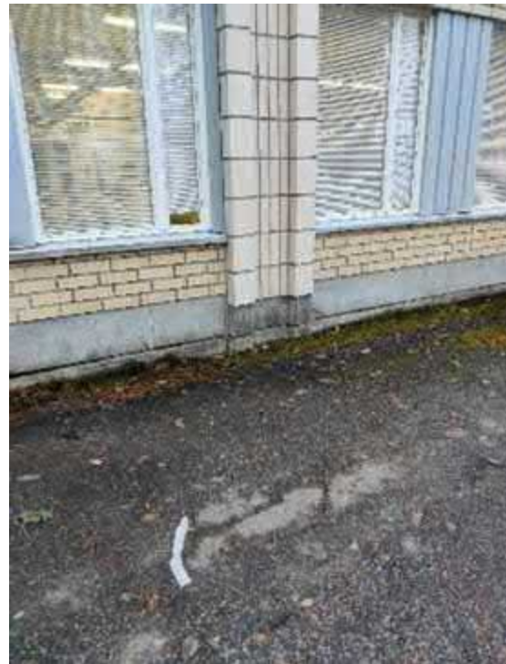
Kuva 8. Itäisellä sivustalla teknisentyön tilojen edusta on asfaloitu. Asfaltti on painunut ja vierustalta havaittiin merkkejä veden lammikoitumisesta.
