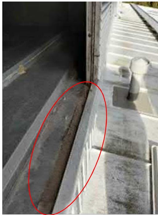
Kuva 118. IV-konehuoneen kosteusvaurioiden aiheuttajaksi havaittiin puutteellisesti toteutettu liitos tuloilmasäleikön ja ulkoseinän saumakohdassa.
