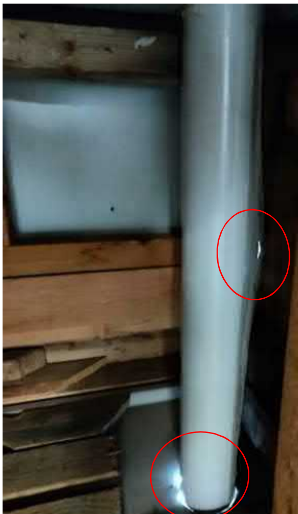
Kuva 164. Piilokourujärjestelmään liitetyissä sadevesisyyöksyissä havaittiin epätiivitä kohtia välikatolta tehtyjen tarkastusten yhteydessä. Kuvassa sadevesisyyöksyn liitos on auennut ja alapuolinen pellityksen sekä sadevesisyyöksyn liitos on epätiivis.
