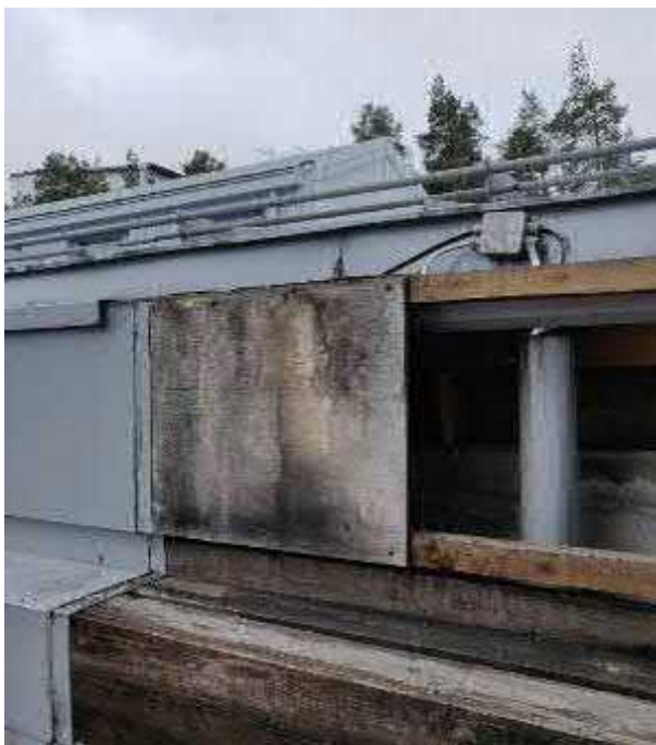
Kuva 168. Piilokourujen rakenteissa havaittiin laajoja vaurioita. Kuva itäsivustalta.
