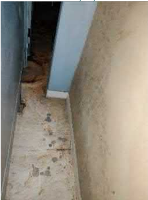
Kuva 117. Liikuntasalin yläpuolisen IV-konehuoneen seinästä havaittiin kosteusvauriojälkiä.
