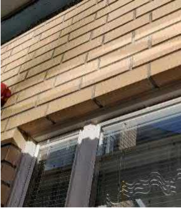
Kuva 127. Ikkunoiden ulkopuolelta havaittiin kosteuden aiheuttamia jälkiä tiililaatan ja ikkunan rajakohdassa.
