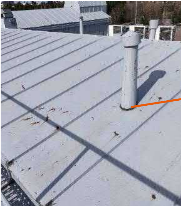
Kuva 158. Viemärin tuuletusputken ja vesikaton liitoksen havaittiin vuotaneen.
