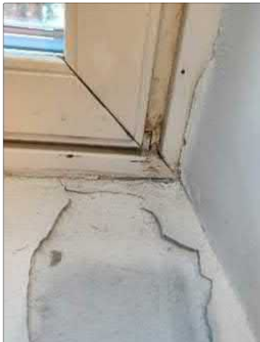
Kuva 126. Kosteuden aiheuttamia jälkiä ikkunan listoituksissa sisäpuutteessa ja ikkunasyvennyksen maali- ja tasoitepinnoissa.
