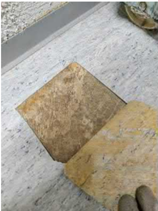
Kuva 172. Muovimaton alapinnasta havaittiin monin paikoin vaurioita.
