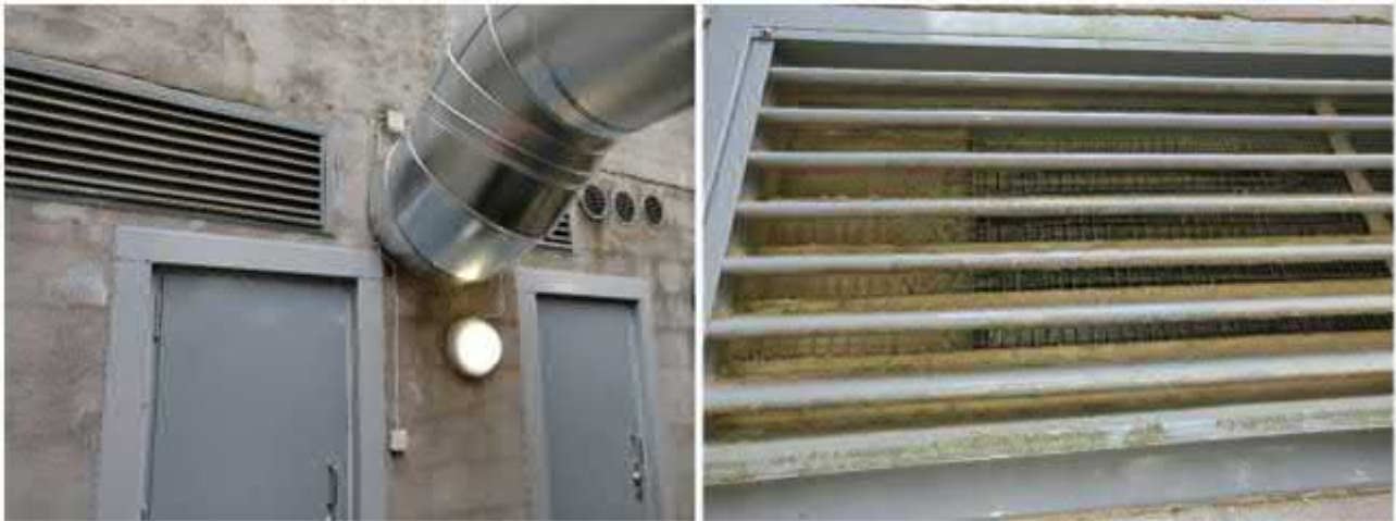
Kuva 188 työtilojen tuloilmakoneen ulkoilmasäleikkö.
