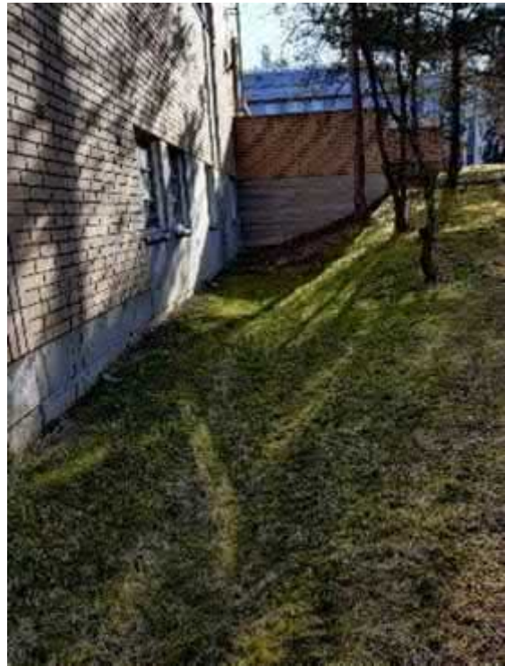
Kuva 5. Lounaissivustalla sosiaalityötilojen ja asuinhuoneiston kohdalla maanpinta viettää rakennusta kohti. Rakennuksen vieressä on matala niskaoja.
