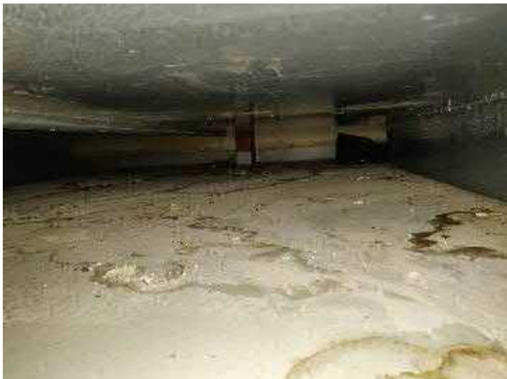
Kuva 83. Liikuntasalin yläpuolisen IV-konehuoneen lattioilta havaittiin useita kosteuden aiheuttamia jälkiä. Muovimattojen saumat olivat monin paikoin ratkeilleet ja epätiivitä.
