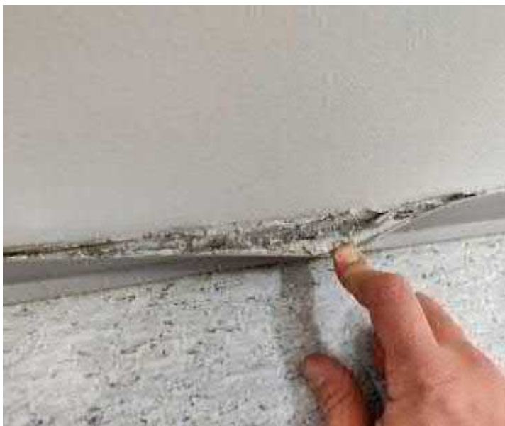
Kuva 39. Maanvastaisten seinien alaosassa sijaitsevan muovisen jalkalistan taustalta havaittiin vaurioita muovimatton kiinnitysmassassa ja seinän tasoitekerroksessa.
