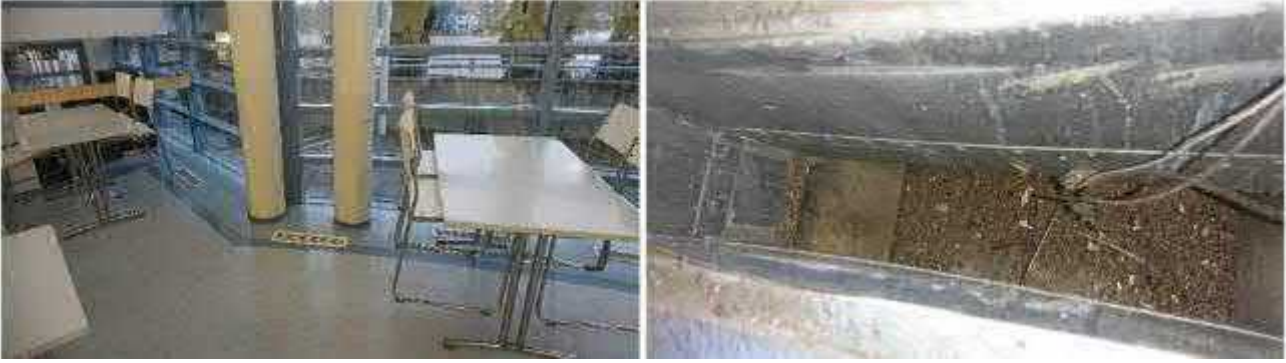
Kuva 194 Ruokailutilojen ikkunaseinälle puhalletaan ilmaa kierrätysilmakoneen (kok-9) avulla. Lattialla sijaitsevat päätelaitteet todettiin erittäin likaisiksi. Osassa päätelaitteista havaittiin myös avoimia mineraalivillapintoja.
