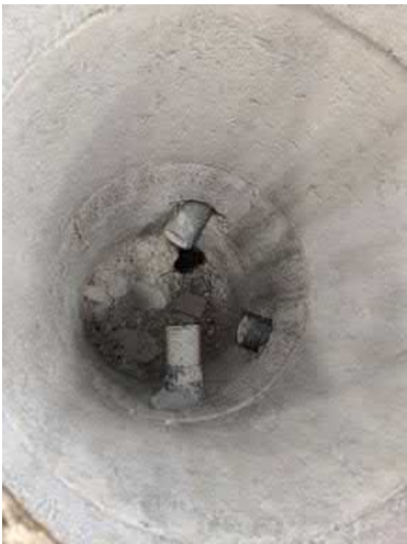
Kuva 12. Sisäpuolisten salaojien tarkastuskaivo rakennuksen länsipäädyssä sisäänkäynnin edustalla. Kaivon pohjalta havaittiin kuollut rotta.
