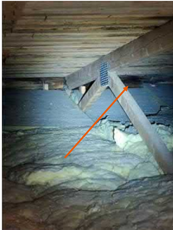
Kuva 161. Räystäiden kautta tapahtuva yläpohjan tuulettuminen oli muutamissa paikoissa estynyt. Räystäään laudoituksista havaittiin monin paikoin vauriota.
