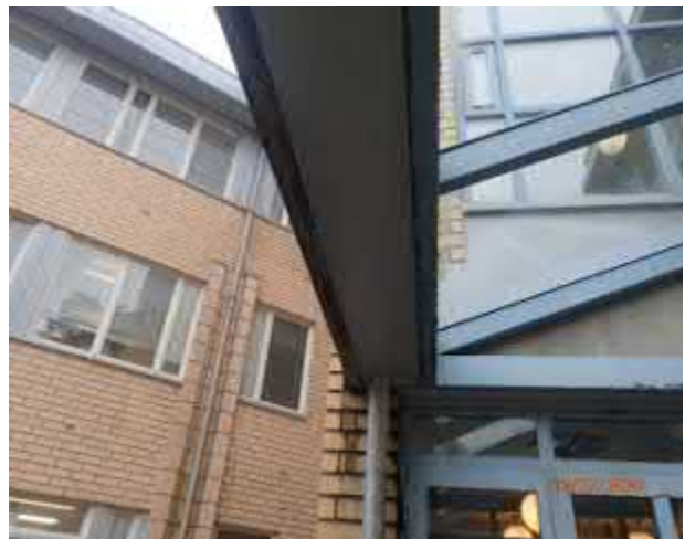
Idän puoleisen sisäänkäyntikatoksen maali on välttävissä kunnossa.
