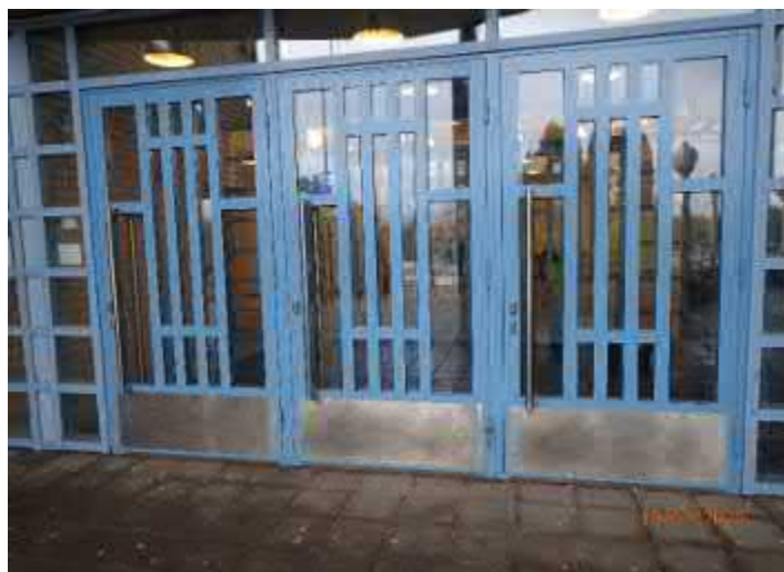
Ulko-ovet ovat tyydyttävässä kunnossa.
