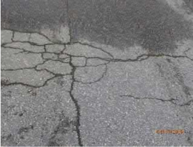
Asfaltti on paikoin halkeillutta.
