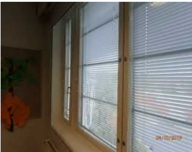
Luokassa 3D on kertoman mukaan vettä tullut ikkunoiden karmin ja seinän välistä.
