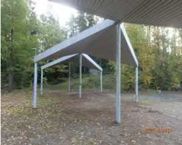
Polkupyöräkatoksen pilarit ovat monessa kohdassa ruosteessa.
