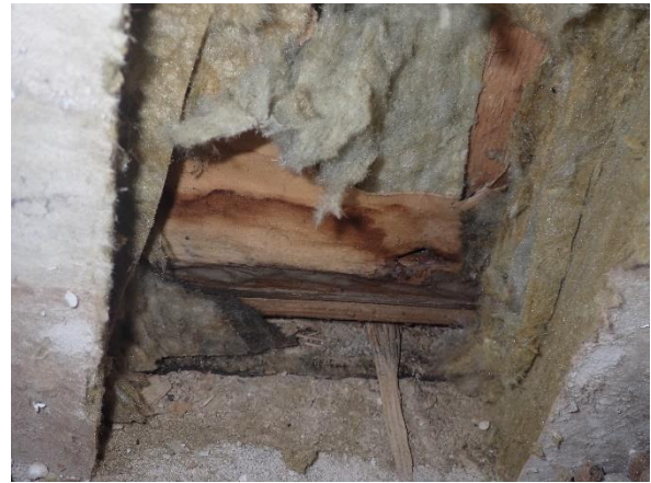
Kuva 80. Rakenneavaus US 4: Ilmansulkupaperin pinnalla havaittiin aistinvaraisesti kosteuden aiheuttamia muutoksia.
