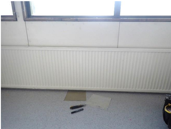
Kuva 44. Rakennuksen A-osassa on väestönsuojaan rajautuva välipohjarakenne. Avaus tehtiin Tiitiäisten keittiöön/pienryhmätilaan.
