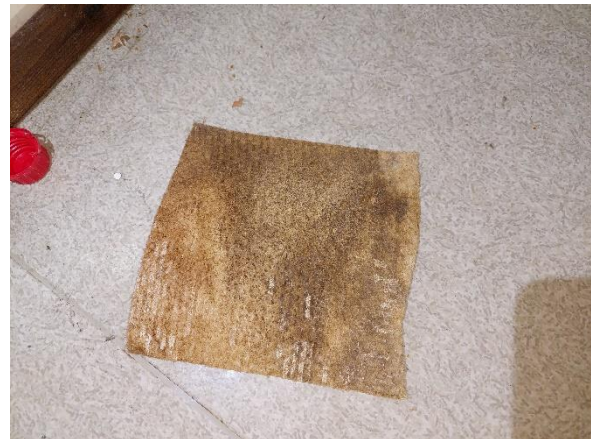
Kuva 29. Viiltokosteusmittauspisteissä VM1 (kuvassa), VM3 ja VM5 lattiapäällysteessä oli juuttipohjainen muovimatto. Paikoin juuttipohjassa havaittiin todennäköisesti kosteuden aiheuttamia värinmuutoksia.
