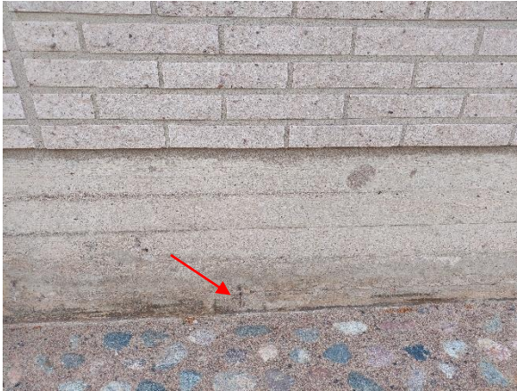
Kuva 49. Sokkelirakenteessa oli paikoin teräskorroosio- vaurioita. Perusmuurilevytyksiä ei havaittu sokkeli- rakenteen juurella.
