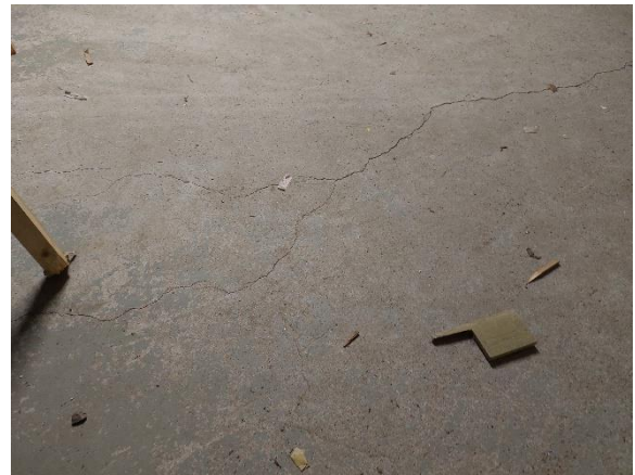
Kuva 6. Väestönsuojan alapohjarakenteen pinnoitteena oleva maali on kulunut. Alapohjarakenteessa havaittiin halkeamia.
