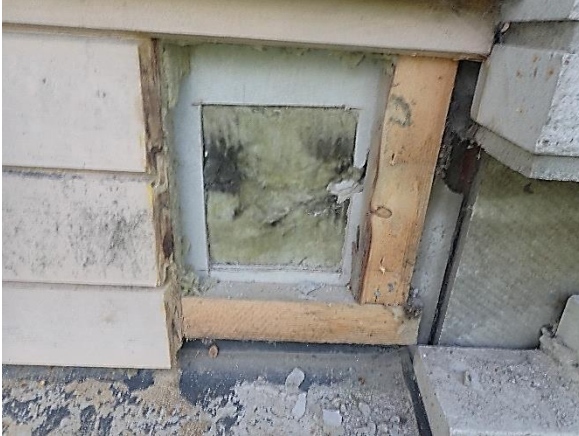
Kuva 83. Rakenneavaus US 5 vastaa puuverhoillun julkisivun osalta toteutustavaltaan rakenneavauksia US 1 ja US 2. Mineraalivillaeristeessä tuulensuojalevynä olevan kuitusementtilevyn takana havaittiin tummentumia.
