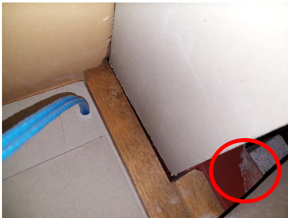
Kuva 114. Alaslaskun yläpuolella tuulikaapissa A- ja B-osien liitoksessa havaittiin teräsrakenteen pinnalla vuotojälkiä, jotka ovat todennäköisesti peräisin vesikaton vuodoista.
