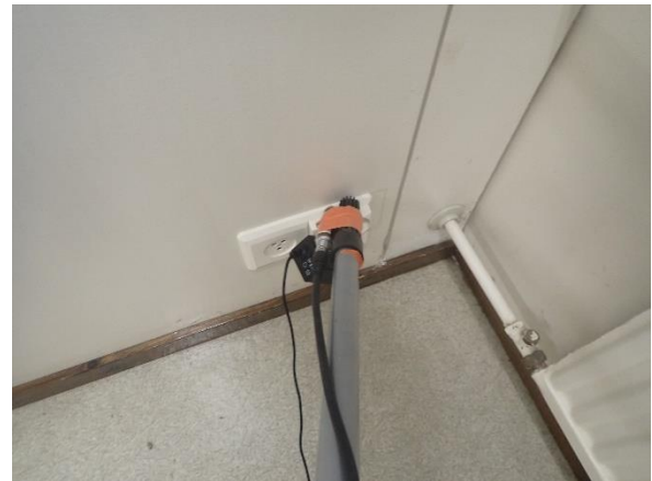
Kuva 36. MAK4, pistemäistä ilmavuotoa havaittiin väliseinän pistorasiasta.
