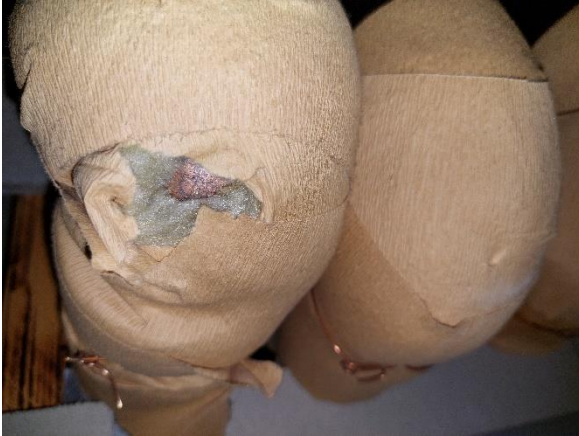
Kuva 118. Putkien mutkat on eristetty mineraalivillaeristeillä, jotka on päällystetty rakennuspaperilla.
