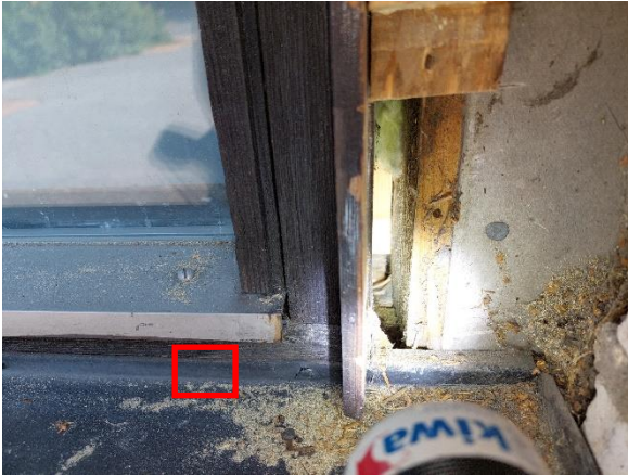
Kuva 67. Rakenneavaus US 1. Liitostapa on epätiivis.
