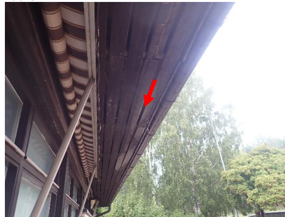
Kuva 136. Vesikatolla olevista rei'istä sadevedet ohjautuvat monin paikoin aluskatteen pinnalle. Sadevedet vuotavat räystäältä maahan.
