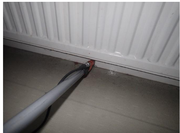
Kuva 96. MAK3: Laaja-alaista ilmvuotoa havaittiin alapohjan ja ulkoseinän liitoksessa.
