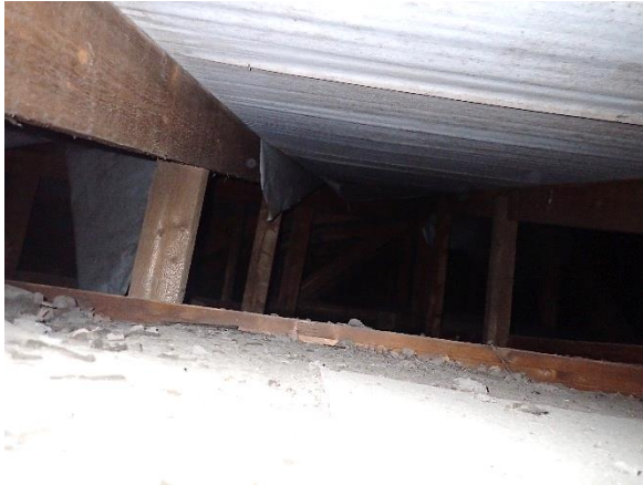
Kuva 127. Rakenneavaus YP 2: Aluskate on asennettu kireälle, joka altistaa vuotojen syntymisen aluskatteen kiinnityskohtiin.
