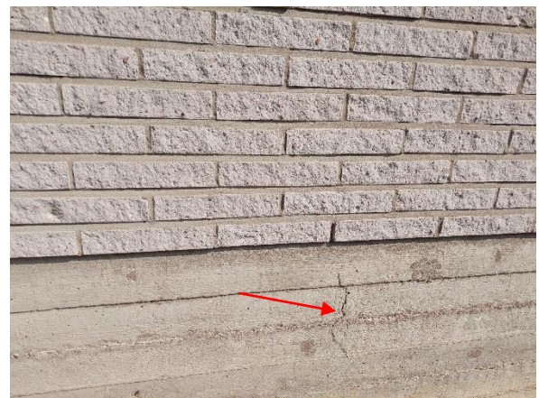
Kuva 48. Sokkelirakenteen pintabetonissa havaittiin paikoin halkeamia, jotka voivat viitata teräskorroosiovaurioon.
