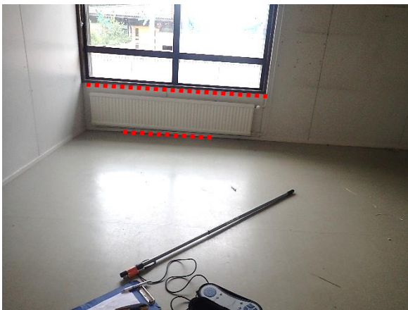
Kuva 95. Merkkiainekoe MAK3 tehtiin ulkoseinärakenteeseen rakennuksen C-osassa Veitikoiden ryhmähuoneessa ilmvuotoa havaittiin kuvaan merkityissä kohdissa.
