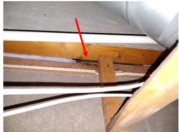
Kuva 123. Palkin ja yläpohjan liitoksen havaittiin aistinvaraisesti olevan epätiivis.
