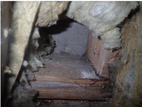
Kuva 81. Rakenneavaus US 4: Alaohjauspuun alapinnalta otettiin materiaalinäyte mikrobianalyyysiin. Näytteen suoraviljelyssä havaittiin heikko viite mikrobivauriosta.
