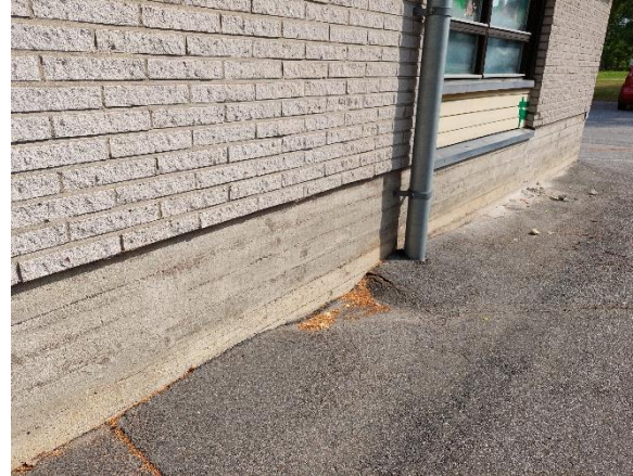
Kuva 132. Paikoin sokkelin vierustalla havaittiin painanteita, joihin voi kertyä vettä.
