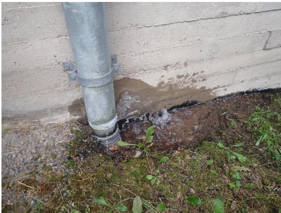
Kuva 51. Tukkeutunut sadevesijärjestelmä aiheuttaa sokkelirakenteelle paikoin ylimääräistä kosteusrasi- tusta. Paikoin sokkelinvierustalla havaittiin pikisivelyä.
