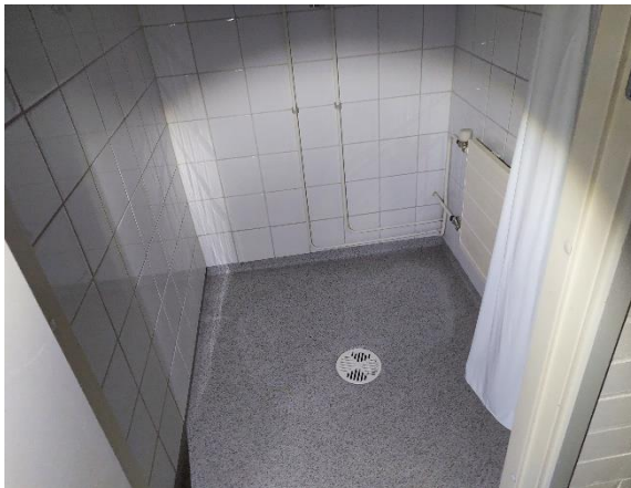
Kuva 102. Yksittäisen uusitun märkätilan seinäpäällysteenä on keraaminen laatoitus. suihkusekoittajan putket kiinnikkeineen on asennettu alakautta suihkun roiskevesialueelle.
