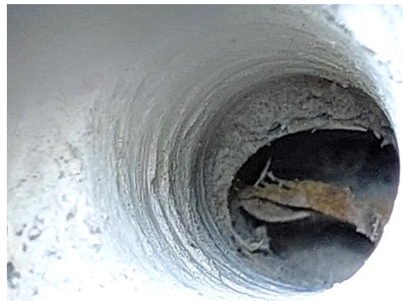
Kuva 22. Rakenneavaus AP 3: Pohjalaattaan poratussa tarkastusreijässä on havaittavissa valunut jäänyt rakennusaikainen puunkappale.
