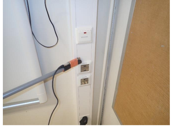
Kuva 38. Vähäistä ilmavuotoa havaittiin sähkökoteloinnin alueelta.
