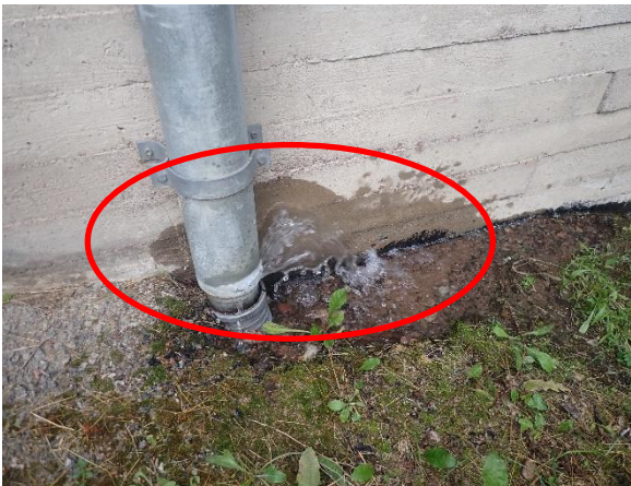
Kuva 135. Sadevesijärjestelmät ovat havaintojen perusteella tukkeutuneita. Liitoskohdat kastelevat sokkelirakenteita paikallisesti.
