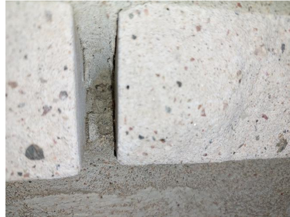
Kuva 50. Ulkoseinän tuuletusraoiksi tarkoitetut aukot tuuletusaukkojen saumoissa ovat pääosin um- messa, joka estää ulkoseinän tuulettumisen.
