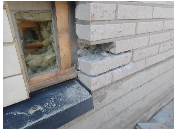
Kuva 70. Rakenneavaus US 2: Rakenne vastasi toteutustavaltaan rakenneavausta US 1. Tiiliverhouksen takana oleva ilmaväli oli avauskohdassa laastipurseiden täyttämä. Ilmansulun sisä- ja ulkopinnoilta otettujen materiaalinäytteiden suoraviljelyssä ei havaittu viitteitä mikrobivauriosta.
