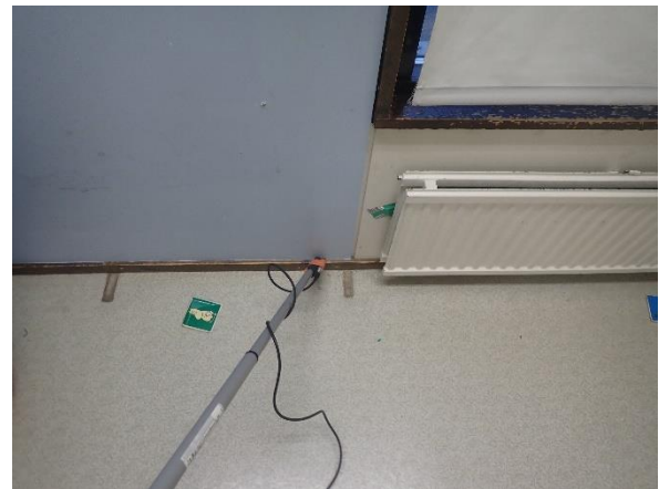
Kuva 34. MAK1: Alapohjarakenteesta havaittiin laaja-alaista ilmavuotoa ulkoseinän ja alapohjan liitoksesta.
