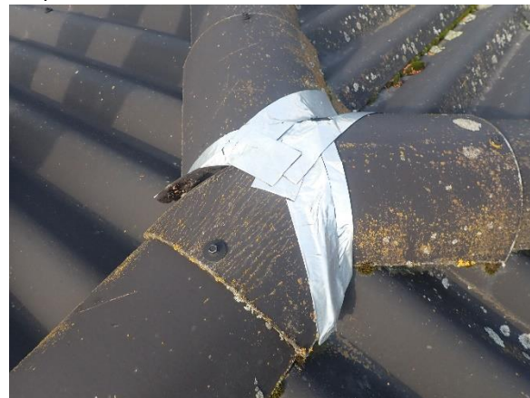
Kuva 111. Vesikatetta on paikoin korjattu bitumiteipein.
