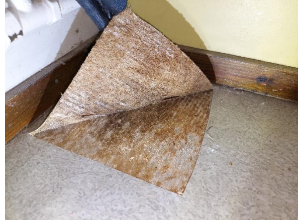
Kuva 18. Rakenneavaus AP 3: Alapohjarakenteen päällysteenä on todennäköisesti alkuperäinen juuttipohjainen muovimatto. Muovimaton alapinnalla havaittiin kosteuden aiheuttamia värimuutoksia.
