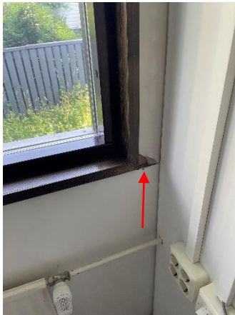
Kuva 57. Ulkoseinien asbestipitoisissa sisäverhouslevyissä havaittiin paikoin lohkeamia.
