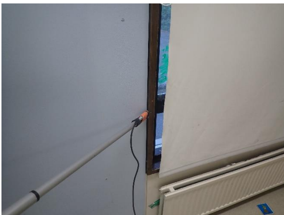
Kuva 91. MAK 2: Laaja-alaista ilmavuotoa havaittiin ikkunaliitoksesta.
