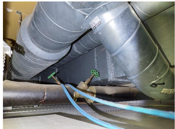
Kuva 117. Käytävötilöjen alaslaskutilaan on asennettu talotekniikkaa.
