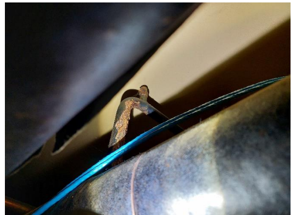
Kuva 115. Vuotokohdassa alaslaskussa olevassa putkessa havaittiin korroosiovauriota.
