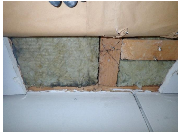
Kuva 126. Rakenneavaus YP 2: Mineraalivillaeristeen reunassa havaittiin tummentumaa, joka viittaa rakenteen ilmavuotoon.
