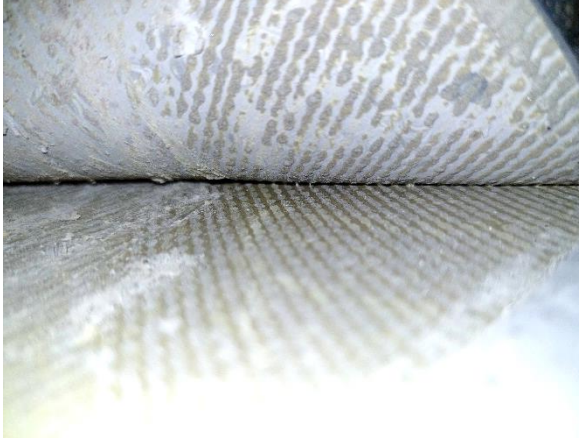
Kuva 30. Viiltokosteusmittauskohta VM4 Tiitiäisten lepuhuoneessa. Muovimaton alapinnalla havaittiin lievä kemiallinen haju sekä lievästi venyvää mattoliimaa.
