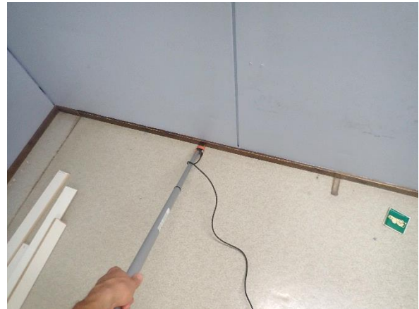
Kuva 90. MAK2: Laaja-alaista ilmavuotoa havaittiin ulkoseinän ja alapohjan liitoksesta.
