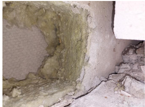
Kuva 64. Rakenneavaus US 1: Tiilimuurauksen takana havaittiin ilmarako. Muilta osin rakenne koostuu kuitusementtilevystä (asbestipitoinen), mineraalivillaeristeestä ja puurungosta, ilmansulkupaperista, mineraalivillaeristeestä ja sisäverhouslevynä olevasta kuitusementtilevystä.
