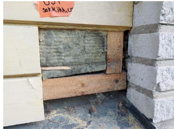
Kuva 60. US 1: Puuverhoilun takana ei havaittu tuuletusväliä.
