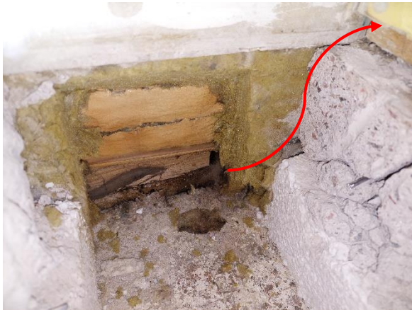
Kuva 85. Ulkoseinärakenteen ja alapohjan toteutustapa on epätiivis.
