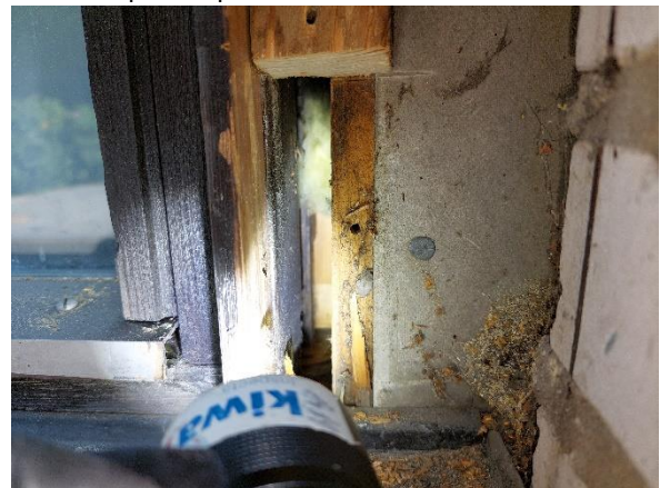
Kuva 88. Ulkoseinien ikkunarakenteiden liitostapa on avauksista tehtyjen havaintojen perusteella epätiivis.
