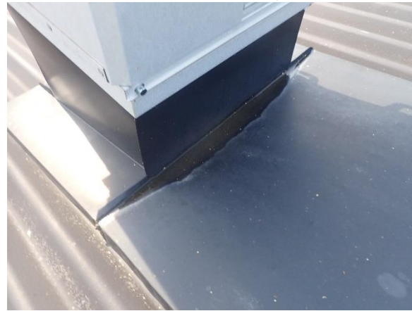
Kuva 109. Huippuimureiden kaulusten juurella havaittiin paikoin vettä. Taustakallistuksia ei ole.
