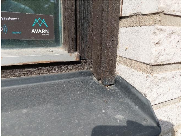
Kuva 55. Ikkunapellitykset on kiinnitetty tiivisteettömällä nauhoilla. Ikkunapellityksen ylösnostot ovat niukkoja ja pellityksen yläreuna on tiivistämätön.
