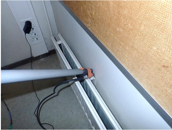
Kuva 39. Pistemäistä ilmavuotoa havaittiin lämmityspatterin kiinnikkeistä.
