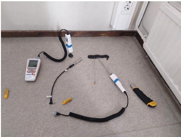
Kuva 28. Muovimaton alapinnan kosteutta mitattiin viiltokosteusmittausmenetelmällä. Kuvassa viiltokosteusmittaus VM5, A-osassa Symppinkset ryhmähuoneessa.
