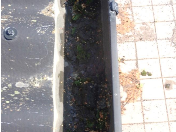
Kuva 112. Vesikouruissa havaittiin monin paikoin roskaa, joka heikentää veden virtausta ja voi aiheuttaa korroosiovaurioita vesikouruihin.
