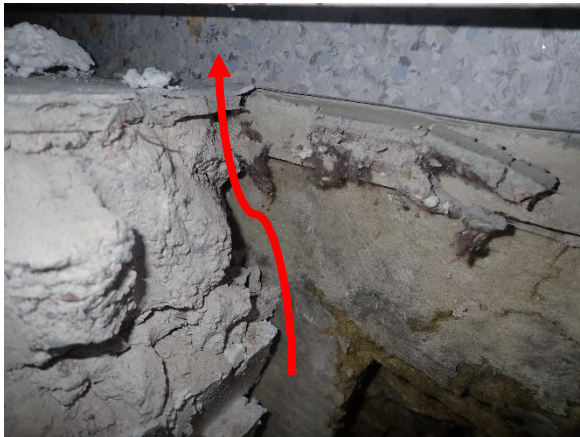
Kuva 46. Pintalaatan ja ulkoseinän liitos ei ole tiivis.
