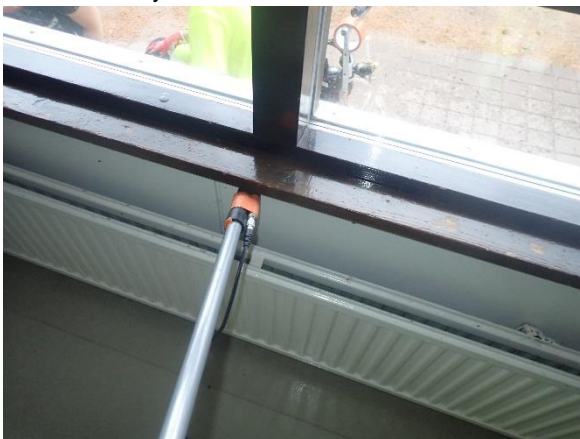
Kuva 97. MAK3: Laaja-alaista ilmvuotoa havaittiin ikkunaliitoksessa.
