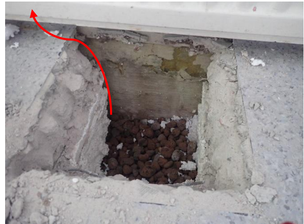
Kuva 86. Välipohjarakenteen ja ulkoseinän liitoksen toteutustapa on epätiivis.
