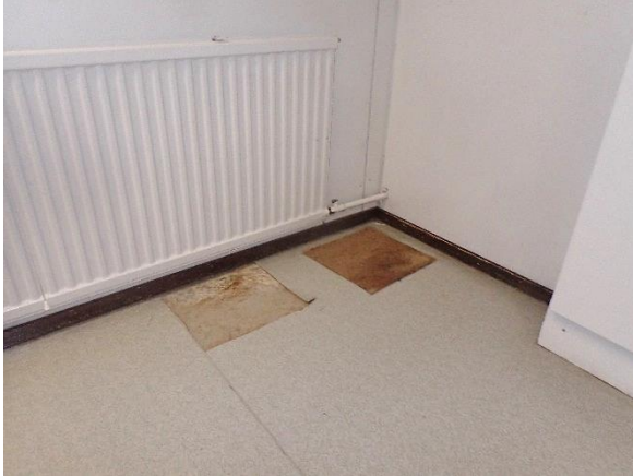
Kuva 23. Rakenneavaus AP 4: Rakenneavaus tehtiin A-osan lepohuoneeseen. Muovimaton alapinnalla havaittiin värimuutoksia.
