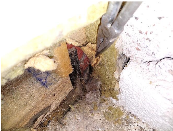
Kuva 75. Rakenneavaus US 3: Rakennuksen sisäpuolella havaittiin teräspilarin pinnalla ruostetta. Teräspilarin kohdalla lämmöneristeen vahvuus on 50 mm. Teräspilarin pinnalla olevassa ilmansulkupaperissa havaittiin kosteuden aiheuttamia jälkiä.
