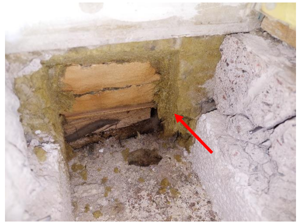
Kuva 76. Rakenneavaus US 3: Sisäverhouslevy päättyy pintabetonin yläpinnan tasolle. Alaohjauspuun korkeusasema on 195 mm lattiapinnan tason alapuolella. Alaohjauspuun alapuolella on bitumihuopakaista, joka ei materiaalinäytteestä tehdyn analyysin perusteella sisällä asbestia. Kuvaan merkityssä ilmansulun sisäpuolisessa mineraalivillaeristeen suoraviljelyssä havaittiin heikko viite mikrobivauriosta.
