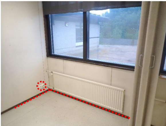
Kuva 35. B-osan alapohjarakenteeseen tehtiin merkkiainekoe MAK4, kahvihuoneen alapohjarakenteeseen. Laaja-alaista ilmavuotoa havaittiin alapohjan ja ulkoseinän liitoksesta, alapohjarakenteen ja väliseinän liitoksista. Pistemäistä ilmavuotoa havaittiin pistorasiasta. Merkkiaineikaasua levisi väliseinärakenteeseen todennäköisesti ulkoseinän kautta.
