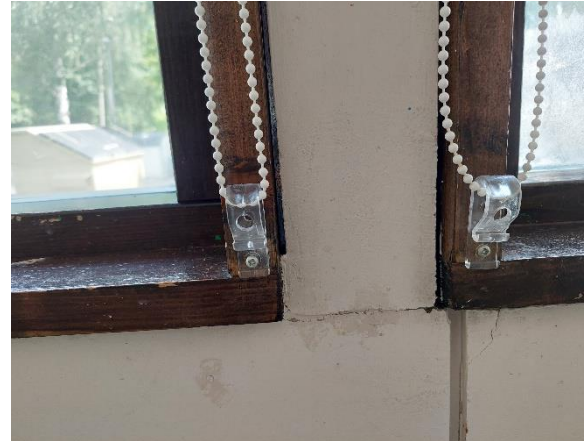
Kuva 58. Paikoin ulkoseinien sisäverhouslevyissä havaittiin halkeamia.
