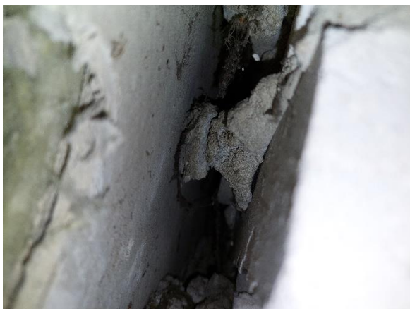
Kuva 65. Rakenneavaus US 1: Tiilimuurauksen takana olevassa ilmaraoissa havaittiin paikoin laastipurseita, jotka voivat heikentää rakenteen tuulettumista.
