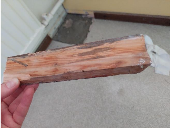
Kuva 19. Rakenneavaus AP 3: Ulkoseinää ja väliseinää vasten olevien jalkalistojen takana oli havaittavissa kosteuden aiheuttamia jälkiä, joka viittaa runsaaseen siivousvesien käyttöön.
