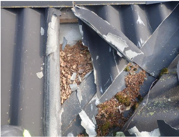
Kuva 108. Vesikatteessa oli havaittavissa monin paikoin rikkiäistä kuitusementtikatetta.
