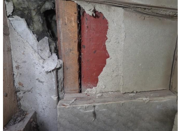
Kuva 84. Rakenneavaus US 5: Teräspilarin ulkopinnalla ei havaittu lämmöneristettä. Toteutustapa vastaa rakenneavauksesta US 3 havaittua rakennetta.
