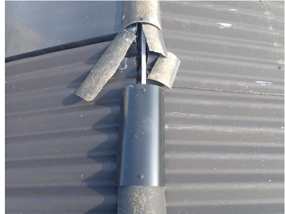
Kuva 107. Paikoin vesikatteessa havaittiin rikkoutumia ja paikoin katetta on korjattu peltilevyin.
