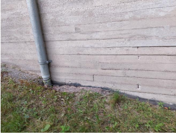
Kuva 131. Sokkelin vierusta on paikoin ruohottunut. Paikoin sokkelirakenteen vierustalla havaittiin bitumisivelyä.
