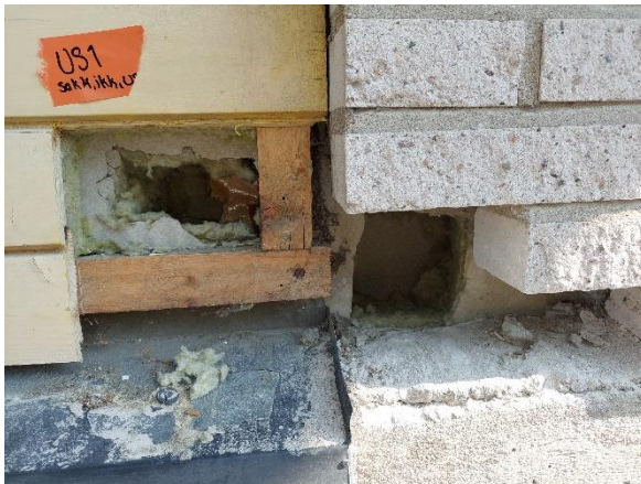
Kuva 63. Rakenneavauksesta US 1 tarkastettiin myös tiiliverhoillun ulkoseinän toteutustapa. Ilmansulun sisä- ja ulkopinnoilta otettujen materiaalinäytteiden suoraviljelyssä ei havaittu viitteitä mikrobivauriosta.
