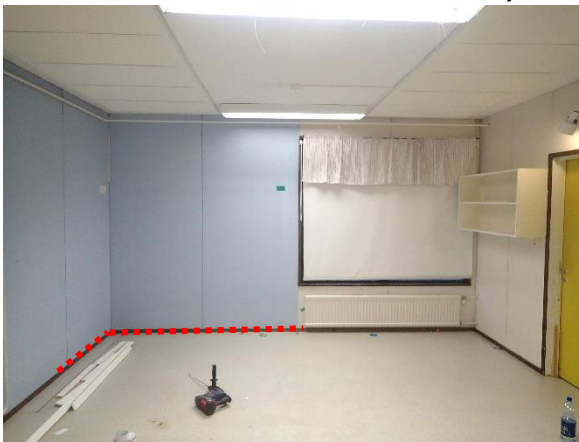
Kuva 33. Merkkiainekokeissa MAK1 rakennuksen C-osassa Menninkäisten ryhmähuoneessa havaittiin alapohjarakenteen ilmavuotokohtia, jotka on merkitty kuvan.
