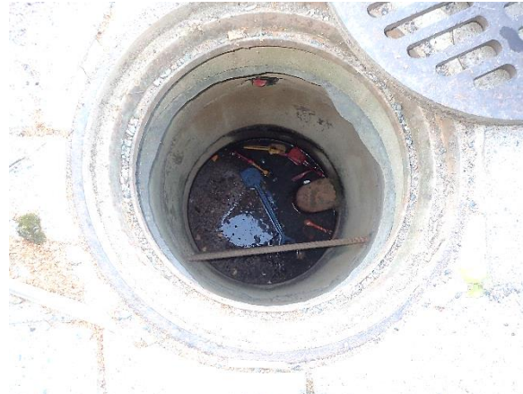
Kuva 130. Piha-alueen sadevesikaivoissa havaittiin hiekkaa ja leluja, jotka voivat aiheuttaa järjestelmään tukoksia.
