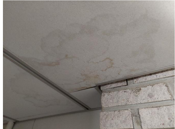
Kuva 113. Sisäkattopinnalla oli havaittavissa kuivuneita vuotojälkiä A- ja B-osien liitoksessa tuulikaapissa.
