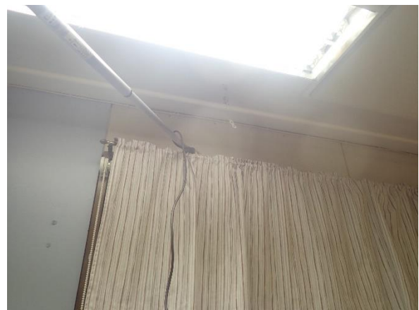
Kuva 92. MAK2: Myös ikkunan yläosan liitoksessa havaittiin ilmavuotoa.
