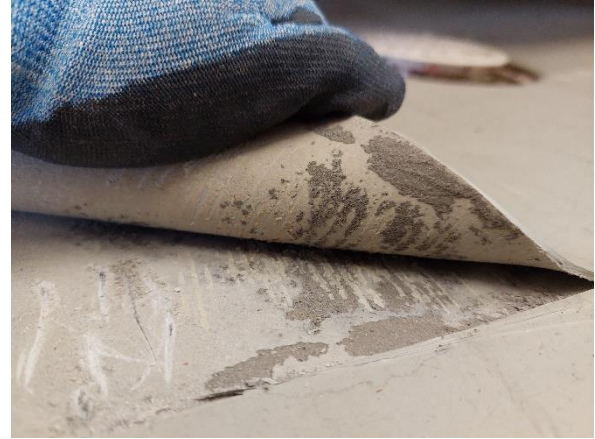
Kuva 31. Viiltokosteusmittauspisteessä VM2 muovimaton alapinnalla havaittiin kemiallista hajua.
