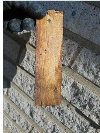
Kuva 68. Ikkunan piililaudoituksissa havaittiin kosteuden aiheuttamia värimuutoksia.
