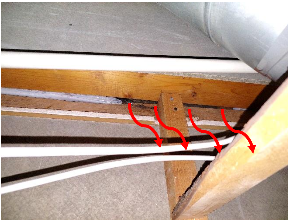
Kuva 128. Epätiiveyttä havaittiin yläpohjaliitoksessa käytävällä, rakennuksen A-osassa.
