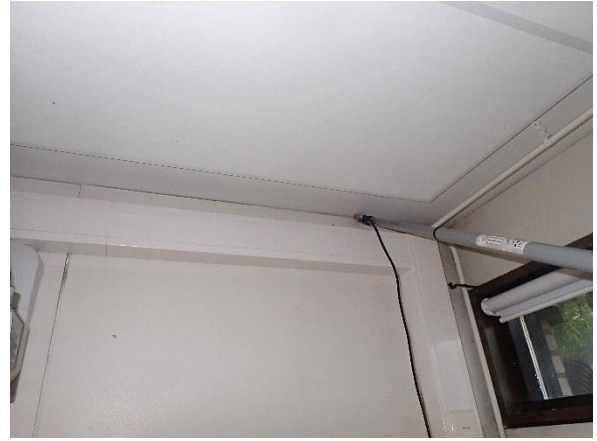
Kuva 40. Vähäistä ilmavuotoa havaittiin yläpohjan ja ulkoseinän liitoksesta.
