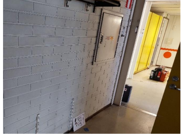
Kuva 14. Eteistilojen alueella havaittiin liikuntasauvoja alapohjarakenteessa.
