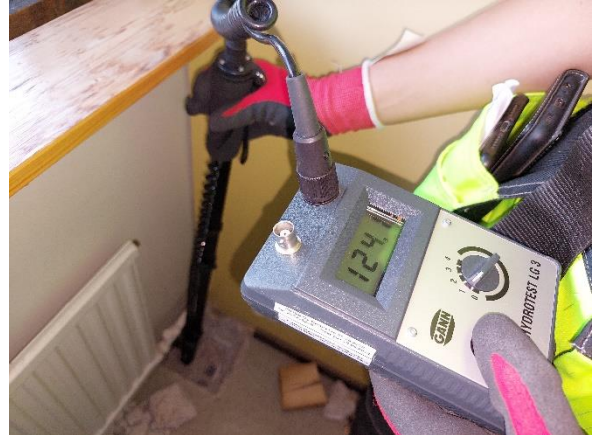
Kuva 20. Rakenneavaus AP 3. Pohjalaatan pinnalla havaittiin kohonneita pintakosteuslukemia.
