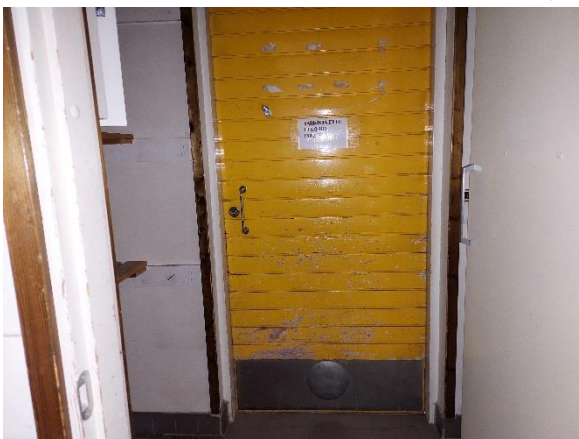
Kuva 53. Puuverhoiltujen ovien maalipinnoissa havait- tiin käytöstä aiheutunutta kulumaa.
