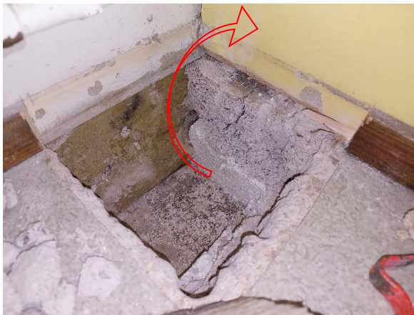
Kuva 32. Pintalaatassa havaittiin kuivumiskutistumaa kantavan väliseinärakenteen liitoksessa, jonka kautta ilmavirtaukset sisäilmaan ovat mahdollisia, kuten nuoli kuvassa.
