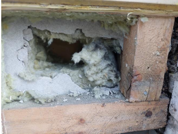
Kuva 61. Rakenteessa on tuulensuojalevynä asbestipitoinen kuitusementtilevy. Runkoa vasten olevassa mineraalivillaeristeessä havaittiin tummentumia.
