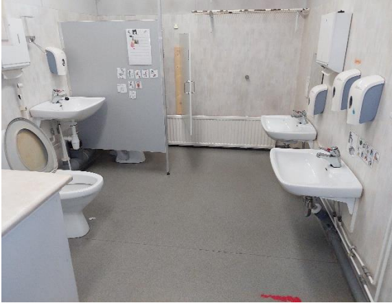
Kuva 13. Rakennuksen C-osassa (ryhmä: Veitikat) oli yksittäisen märkätilan lattiapäällyste uusittu. Uusiminen on todennäköisesti tehty alueelle tehtyjen tilamuutosten yhteydessä.
