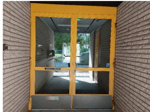
Kuva 52. Ovien kunto on kokonaisuudessaan kohta- lainen, mutta ne eivät täytä nykyisille ulko-oville ase- tettuja lämpöteknisiä vaatimuksia.
