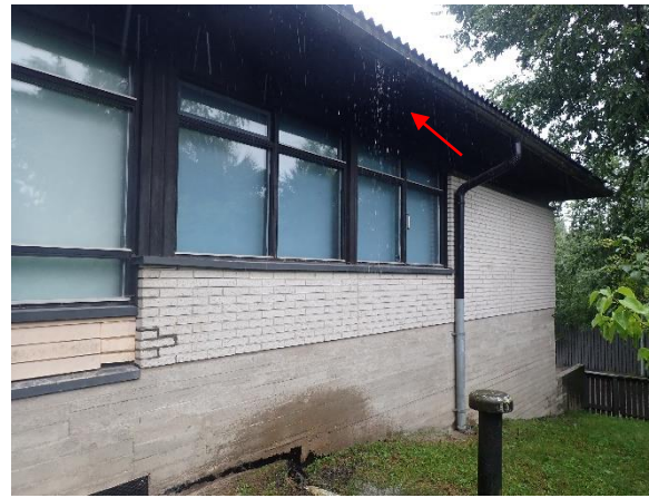
Kuva 134. Sadevedet ohjautuvat vesikatolta syöksytorvin suoraan sadevesijärjestelmään. Rännit vuotavat monin paikoin todennäköisesti sadevesijärjestelmän ja vesikourujen tukkeutumien vuoksi.
