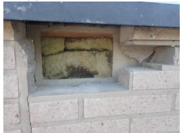
Kuva 72. Rakenneavaus US 3: Ikkunan alapuolisissa mineraalivilla-eristeissä havaittiin tummentumia.
