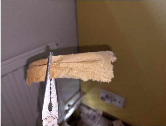
Kuva 77. Rakenneavaus US 3: Ilmansulkupaperin pinnalla havaittiin aistinvaraisesti kosteuden aiheuttamia muutoksia.
