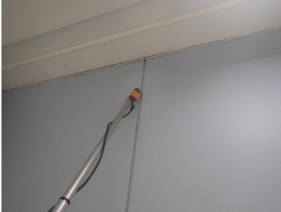
Kuva 93. MAK2: Vähäistä ilmvuotoa havaittiin ulkoseinän ja yläpohjan liitoksesta.
