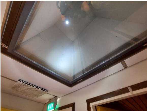
Kuva 120. Sisätiloissa havaittiin vanhoja kattoikkunoita, jotka on ummistettu todennäköisesti edellisen vesikattoremontin yhteydessä.
