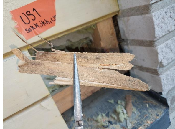
Kuva 62. US 1: Rakenteen pystyrungossa havaittiin tummentumia. Rungosta otetun materiaalinäytteen suoraviljelyssä ei havaittu viitteitä mikrobivauriosta.
