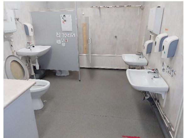
Kuva 103. Myös uusittujen märkätilojen seinäpäällysteenä havaittiin muovitapetointia.
