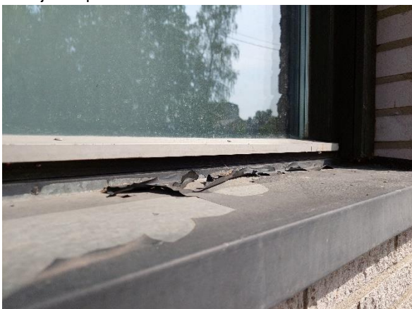
Kuva 54. Ikkunapellityksien maalipinta on lehteillyt paikoin irti.
