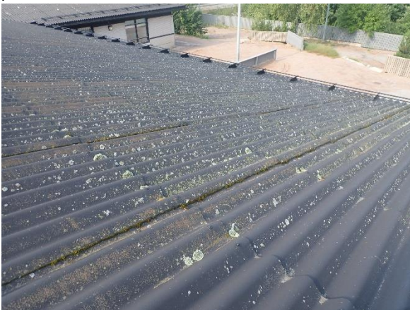
Kuva 110. Vesikatteen pinnalla havaittiin monin paikoin sammalta.
