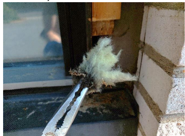
Kuva 66. Rakenneavaus US 1: Ikkunaliitoksessa olleessa mineraalivillatilkkeessä havaittiin tummentumia.
