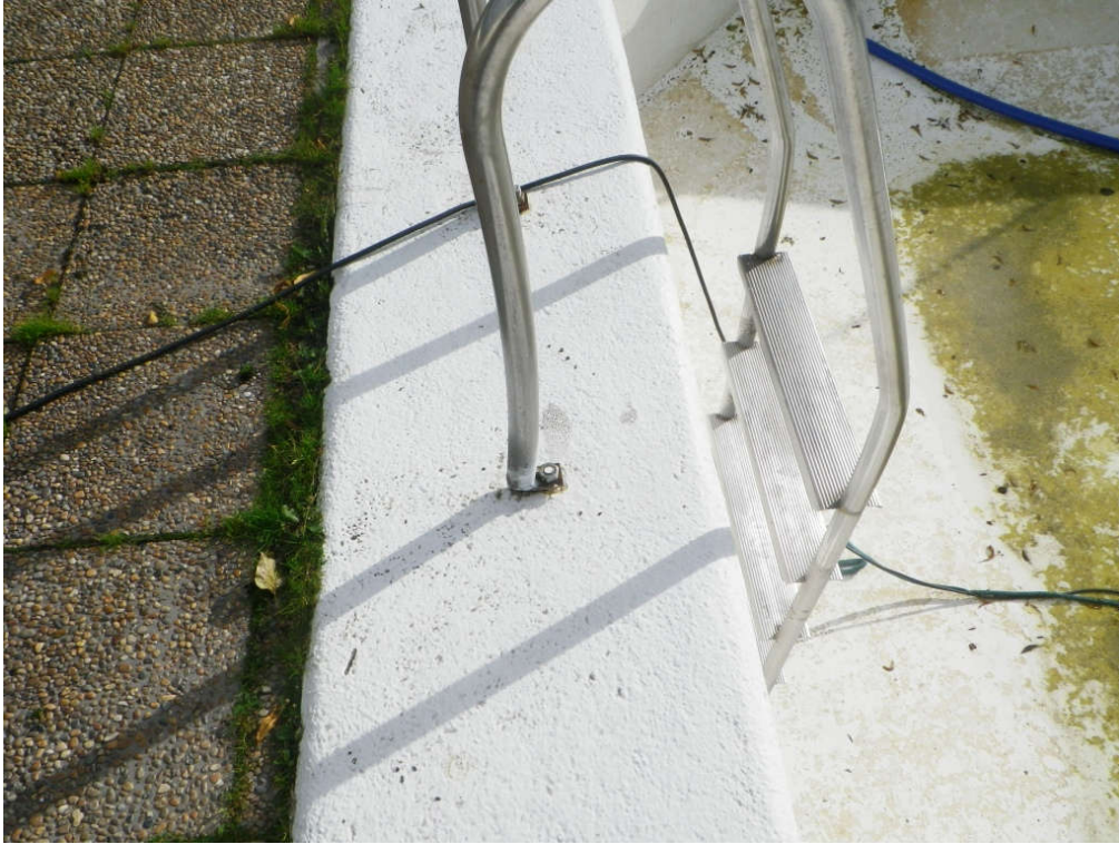
Kuva 17. Portaikkojen putkiaineines on alamittaista / kiinnityspisteitä on liian harvassa
