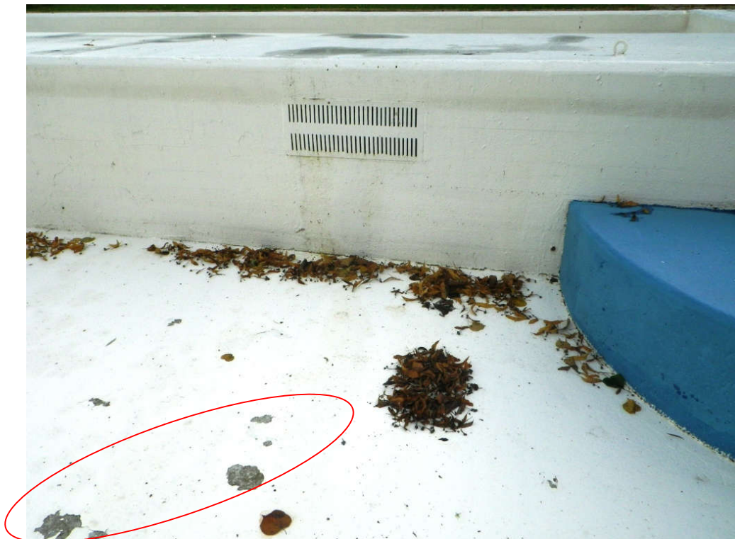
Kuva 14. Vaurioita altaan pohjan pinnoitteissa
