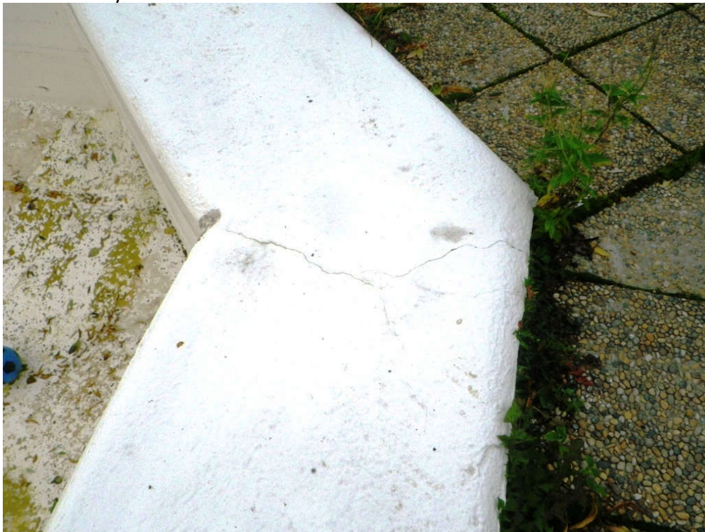
Kuva 10. Halkeamavaurio altaisen reunavalun yläpinnassa. Käytettävien piirustusten mukaan altaiden reunaan on tehty korotusvalu myöhemmässä vaiheessa
