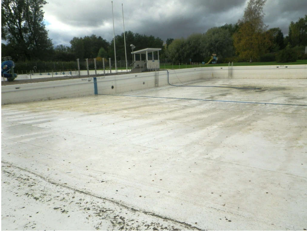
Kuva 3. Ison altaan toinen puolikas on luiskattu rakennusten lähetyviltä. Letkun päässä on pohjakaivo, johon pohjavesi padottaa
