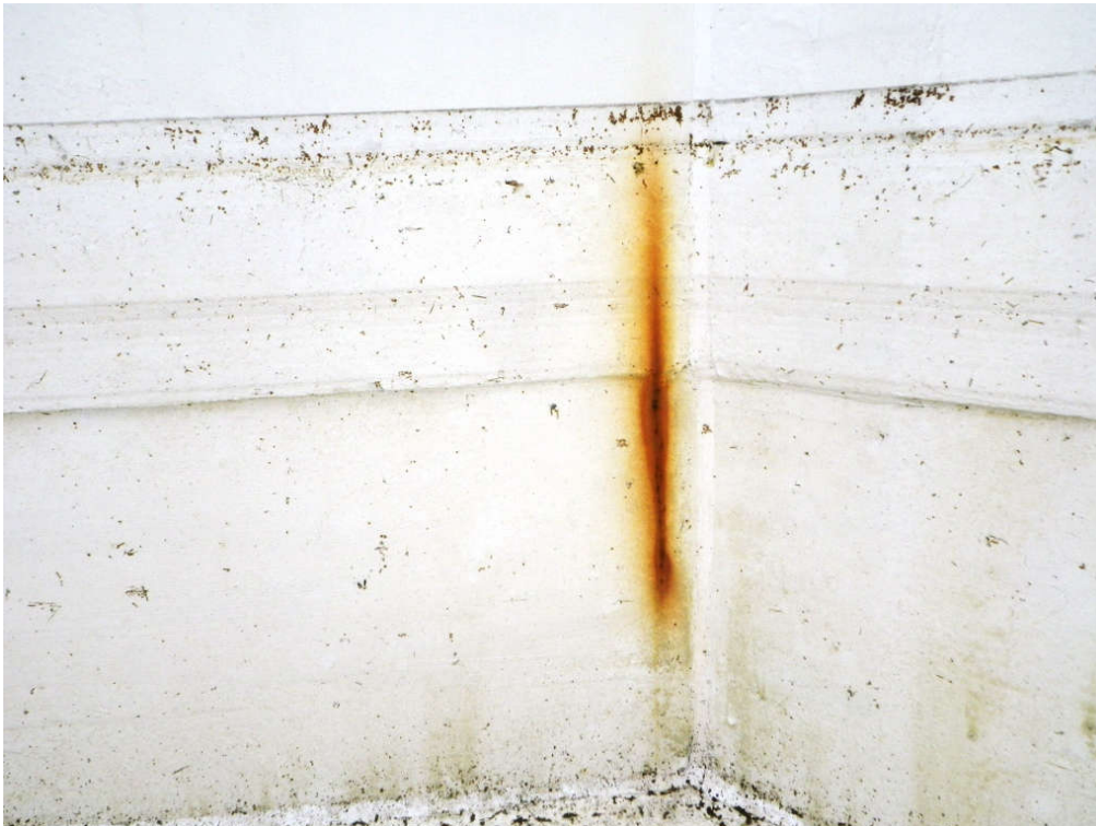
Kuva 8. Teräskorroosioaurio altaan nurkassa: ruosteinen vesi on valunut pintaa pitkin
