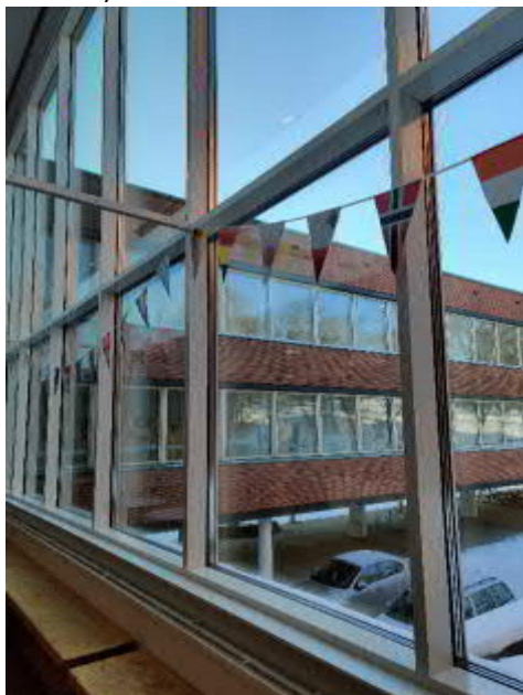
Kuva 6.2.10. Aulatilán ikkunat on uusittu lähiaikoina.
