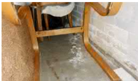
Kuva 5.1.4. Paikallista pinnoitteen kosteusvaurioitumista lattiassa ja perusmuurin sisäpinnassa.
