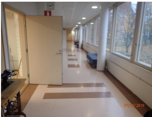
Käytävät ovat tyydyttävässä kunnossa.
