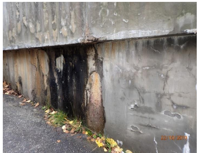
Pihakannen perustus on huonossa kunnossa.
