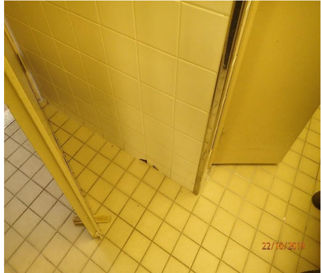
Seinän alaosassa on reikä.
