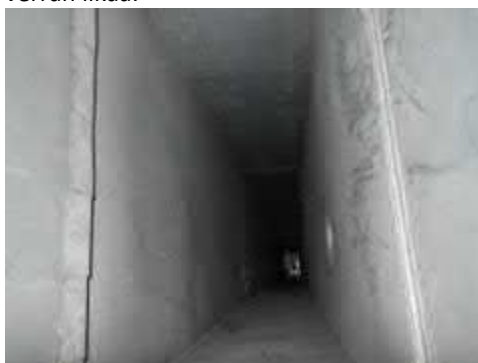
Kuva 7.1.14. Tuloilmarunkokanavistossa oli myös pölyä.
