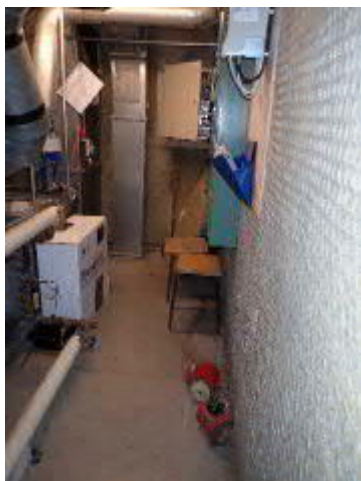
Kuva 7.1.1. Konehuoneen 002 seinillä on kanaverkon takana paljasta mineraalivillaa.
