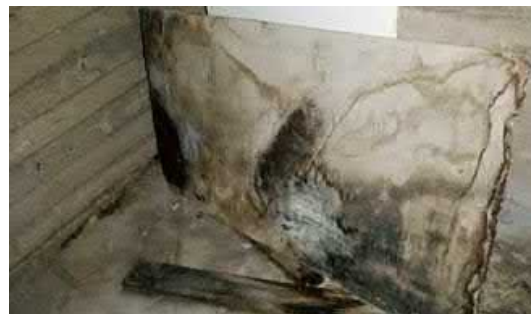
Kuva 5.1.7. Pohjakuvaan merkitsemättömässä tilassa oli kosteusvaurioitunutta puutavaraa.
