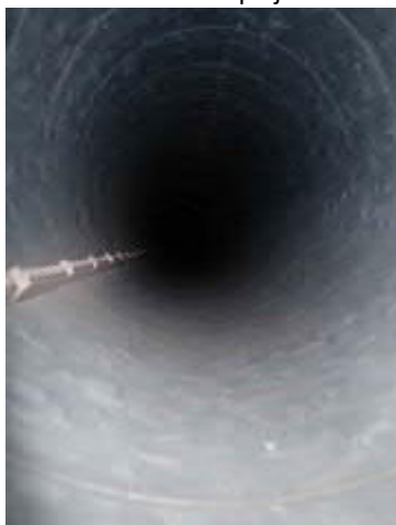
Kuva 7.1.3. Tuloilmakanavistossakaan (tila 007) ei ollut merkittävästi pölyä.
