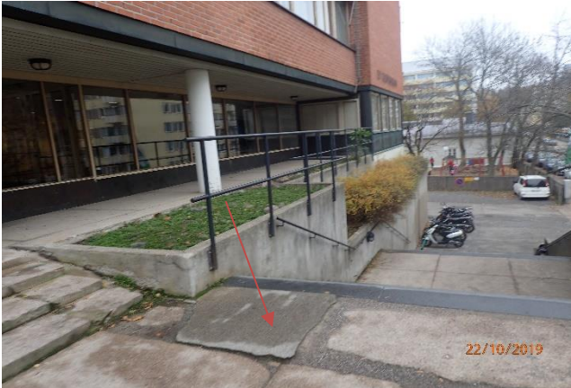
Portaiden yläosassa kompastumisvaara.
