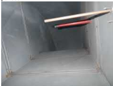
Kuva 7.1.18. Tuloilmarunkokanavistossa ei ollut merkittävästi likaa
