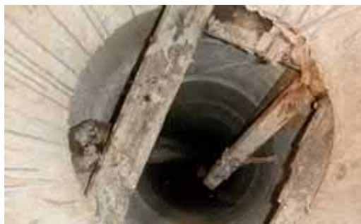
Kuva 6.1.11. Salaojien tarkastuskaivoissa vaurioitunutta puutavaraa.
