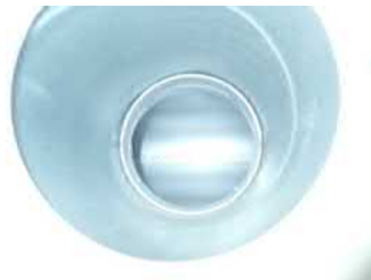
Kuva 7.1.21. Tuloilmakanavistossa (tila 141) ei ollut merkittävästi pölyä.
