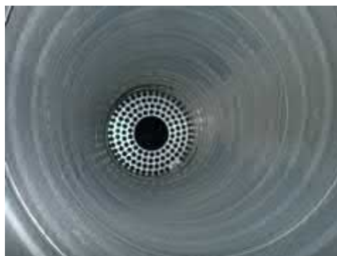
Kuva 7.1.15 Tuloilmakanavistossa (tila 311) ei ollut merkittävästi pölyä.
