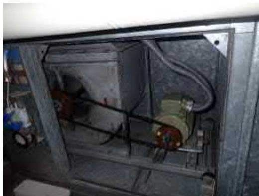
Kuva 7.1.2. Tuloilmakone TK1 oli melko puhdas.
