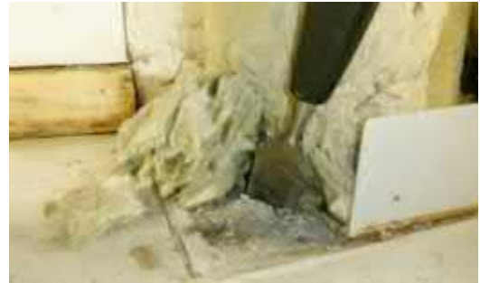
Kuva 6.6.7. Putkiläpivienti kanaaliin on epätiivis.
