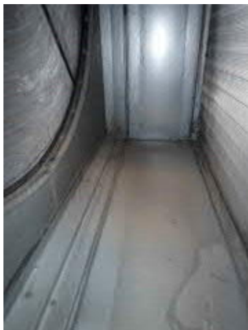
Kuva 7.1.16. Tuloilmakone TK6 oli sisältä puhdas.
