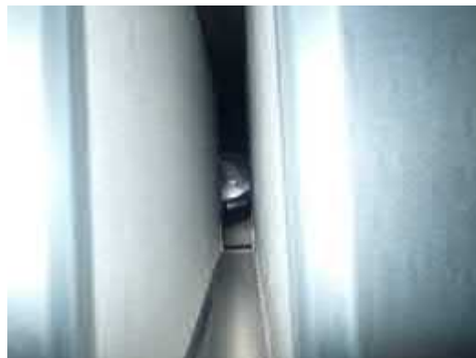
Kuva 7.1.17. Koneessa oli mineraalikuiduttomat ääniloukut.
