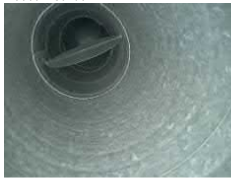
Kuva 7.1.19 Tuloilmakanavistossa (tila 319) ei ollut merkittävästi pölyä.
