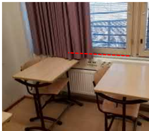
Kuva 6.2.4. Ilmavuotoa luokassa 304 ikkunaliittymistä.
