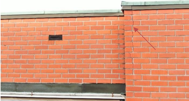
Tiilijulkisivussa on halkeama.
