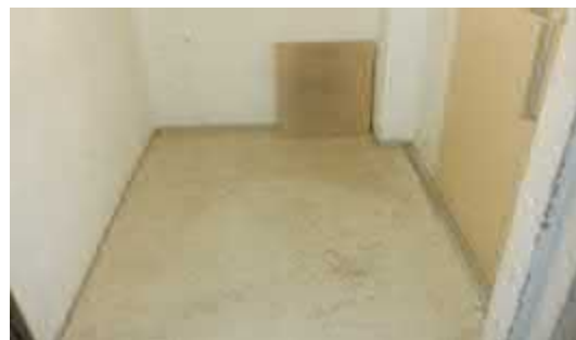
Kuva 5.2.3. Kellarin lattian ja seinien maalipinnoitteet paikoin kuluneita.
