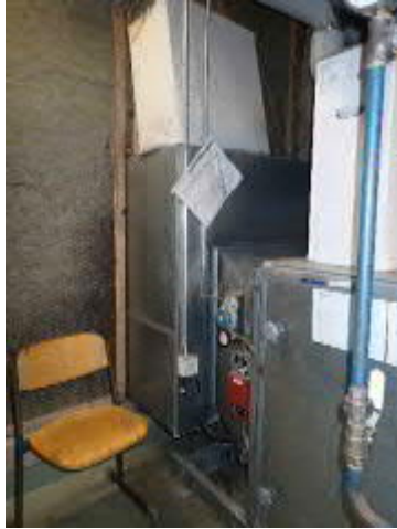
Kuva 7.1.4. Konehuoneen 301 seinillä on kanaverkon takana paljasta mineraalivillaa.
