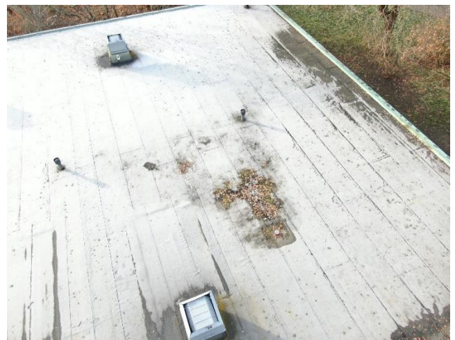
Puiden lehtiä on kattokaivojen ympärillä.
