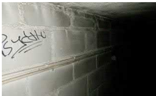
Kuva 6.6.12. Ilmavuotojälkiä sisäverhousmuurauksen takan olevasta eristetilasta.
