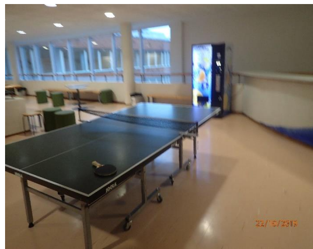
Aulatilat ovat tyydyttävässä kunnossa.
