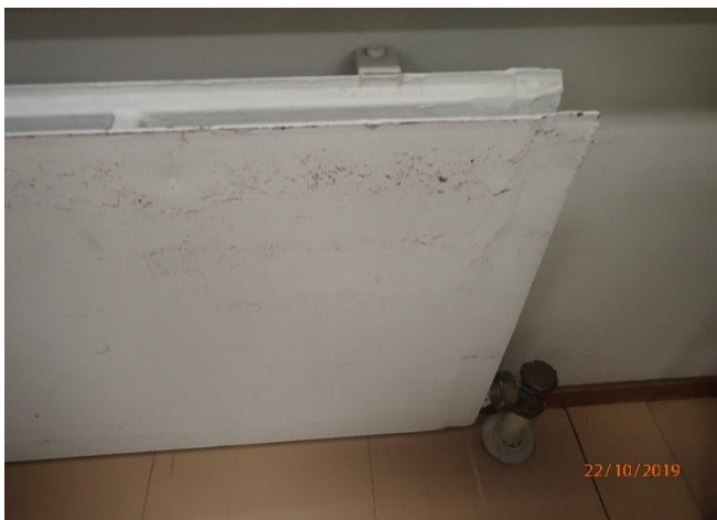
Lämmityspatterit ovat välttävässä kunnossa.
