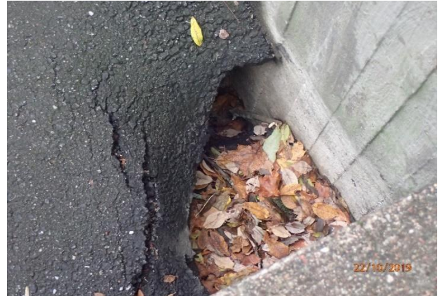
Rakennuksen itäpuolella on veden aiheuttamaa maan eroosiota.
