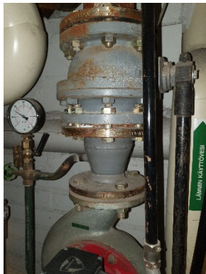
Kuva 4.4.3. Lämmönjakuhuoneen putken laippaliitos saattaa sisältää asbestia.
