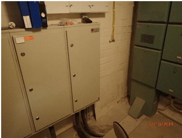
Sähköpääkeskus on osin uudistettu.
