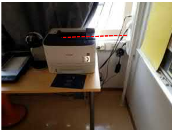
Kuva 6.2.3. Ilmavuotoa luokassa 228 ikkunaliittymistä ja lattia-rajasta.
