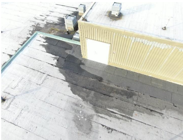
Vesikatolla saattaa esiintyä lämpövuotoa.
