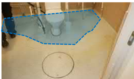
Kuva 5.3.6. Kosteuspoikkeama-alue inva-WC:n lattian märkätalamuovimatossa. Poikkeama-arvot 100-110, vertailuarvot 50-60.
