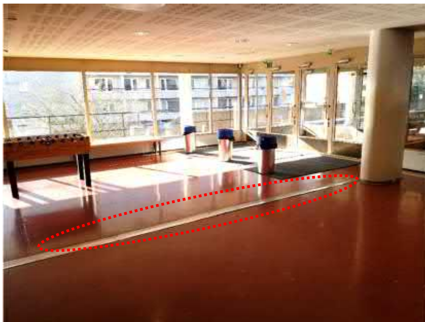
Kuva 6.6.15. Putkitunnelista on merkittävää ilmavuotoa liikuntasaumasta sisääntuloaulaan.
