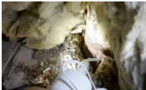
Kuva 6.6.8. Merkkisavulla tarkastellen putkikanaali oli alipaineinen luokkatilan suuntaan.
