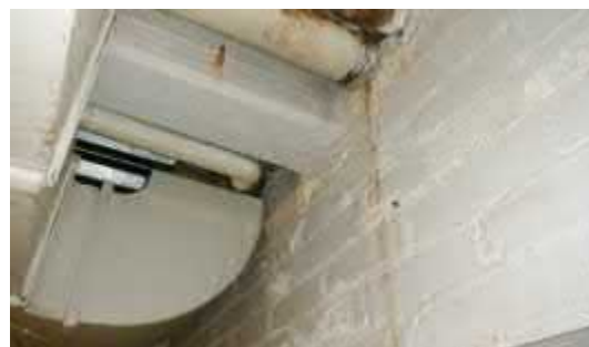
Kuva 5.1.5. Kosteusvauriojäljet rajautuvat perusmuurissa sijaitsevien putkiläpivientien alueelle.
