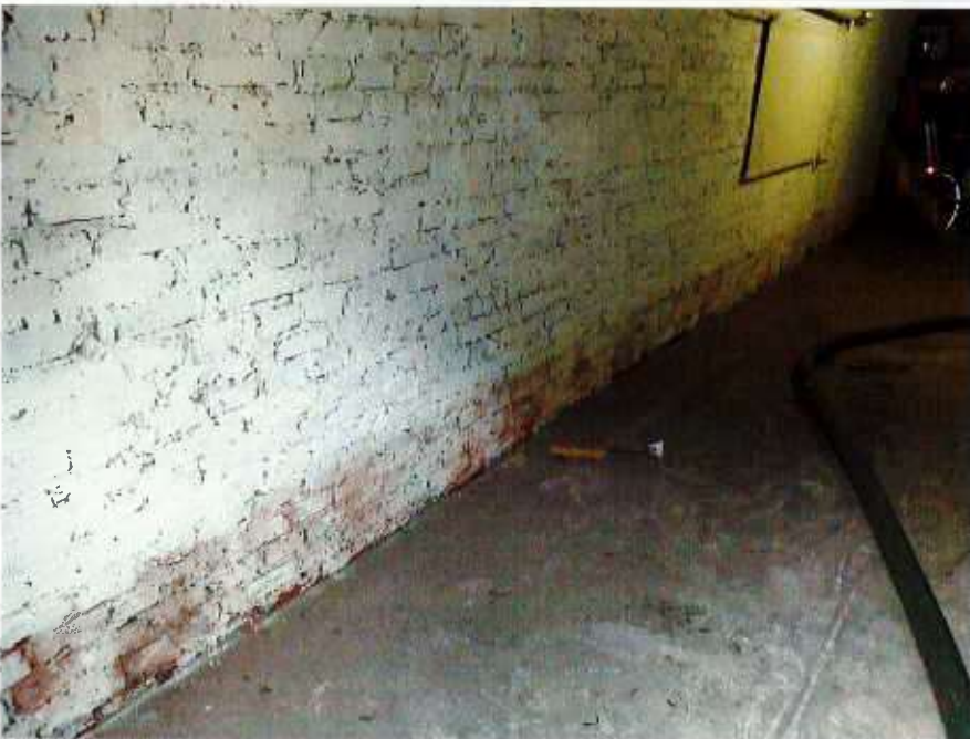
Autotalli. Lattiassa ja seinien alaosissa kosteutta.
