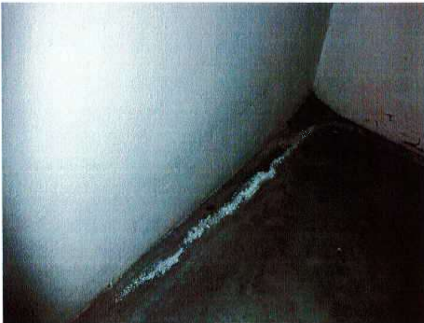
E – Porraskäytävä. Suoloja lattiassa.
