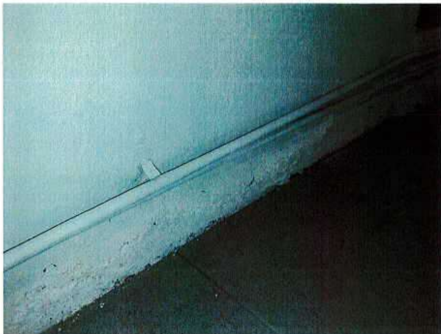
Huoneisto. Huone1. Kosteusvaurioita seinän alaosassa.
