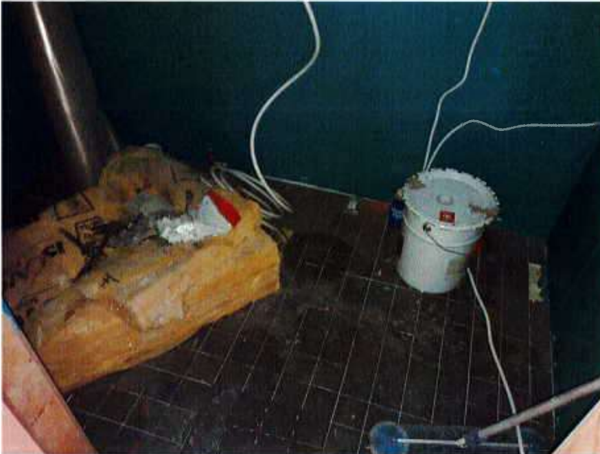
Wc. Lattia ja seinien alaosat kosteat.
