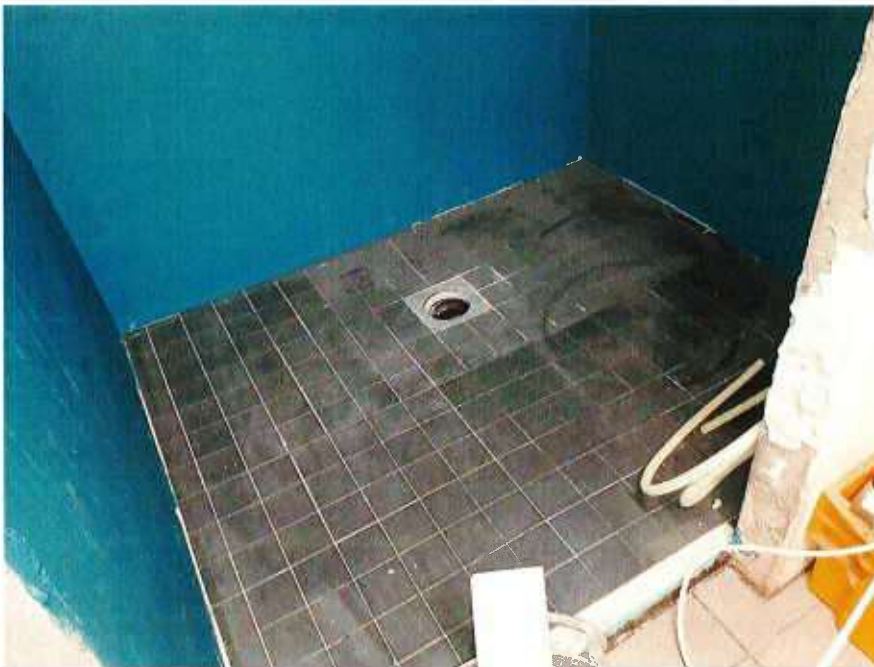
Pesuhuone. Lattia ja seinien alaosat kosteat.
