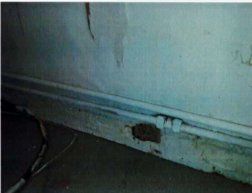
Huoneisto. Huone1. Kosteusvaurioita seinän alaosassa.
