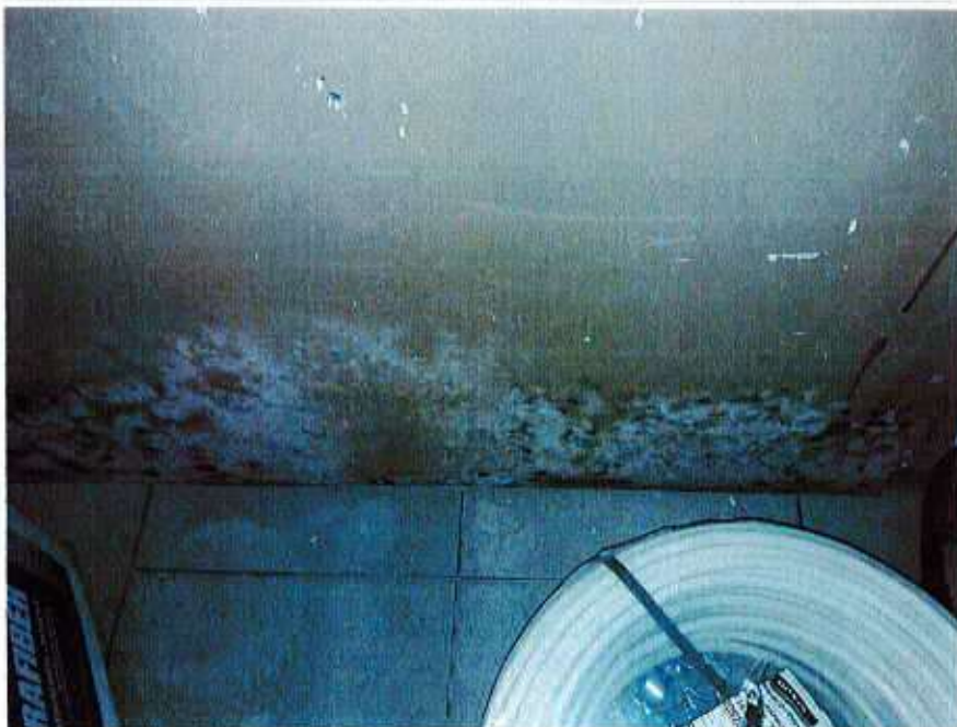
Huoneisto. Kosteusvaurioita kipsilevyseinän aliosassa.
