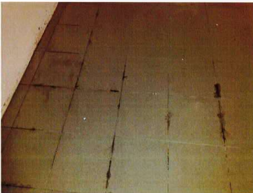
Huoneisto. Kosteusjälkiä lattiassa.
