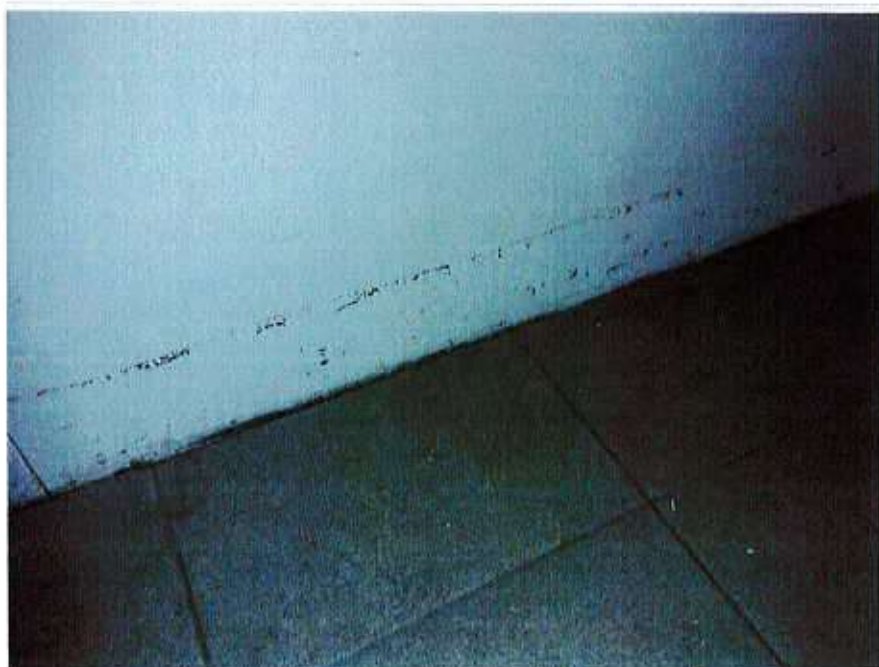
Huoneisto. Huone2 Kosteusjälki seinän alaosassa.
