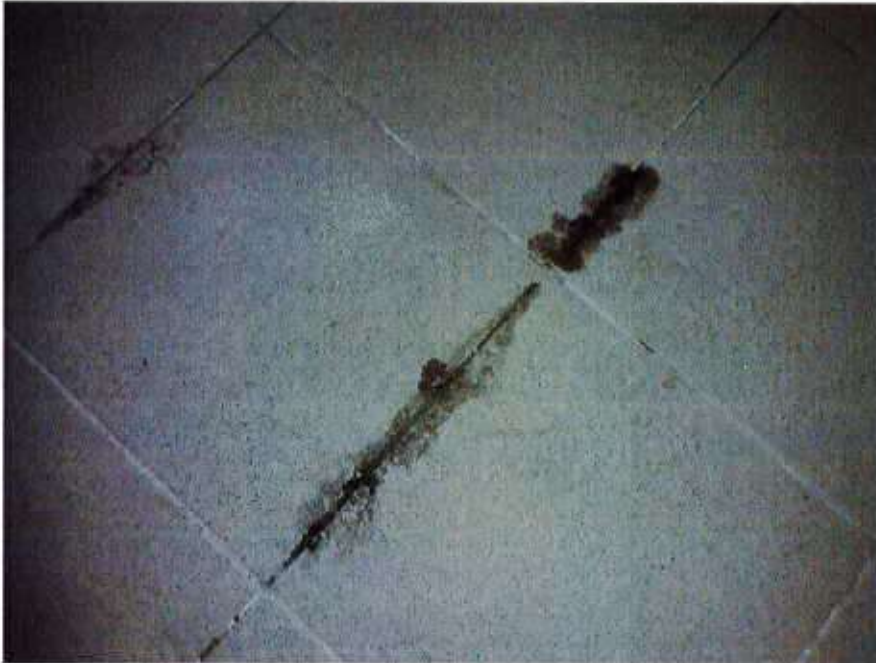
Huoneisto. Kosteusjälkiä lattiassa.
