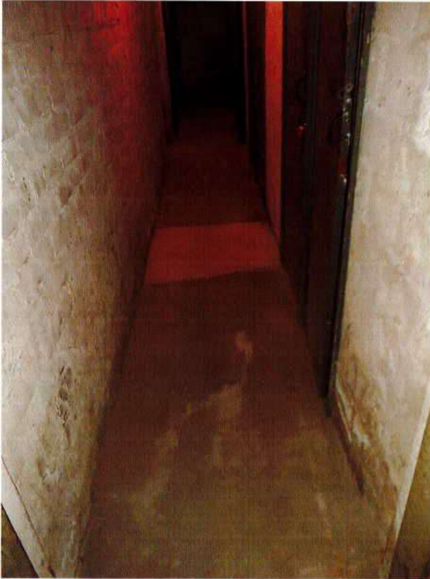
Varastot. Kosteusjälkiä ja kosteutta lattiassa.
