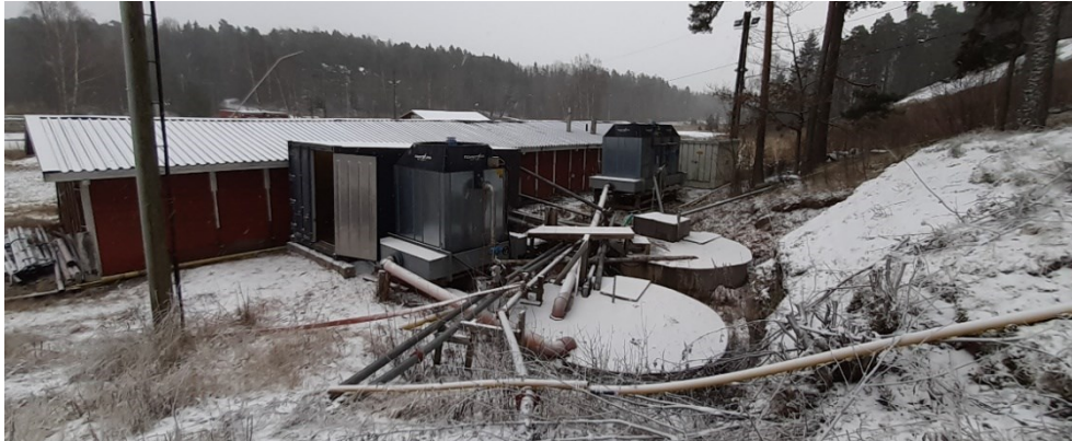
Kuva. Valokuva nykyisestä lumetustekniikasta; kaksi kaivoa (kylmä ja lämmin), pumppamokontti ja lauhdittimet 2 kpl sekä vesiputket. Harmaa kontti (sähköpääkeskus) kuvassa taka-alalla on tarkoitus yhteisurakassa uusia ja sähköpääkeskustila siirretään uuteen huoltorakennukseen.
