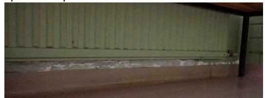
Kuva 4.2.4. Kosteusrasituksen aiheuttamia jälkiä pukuhuoneen P11 maanvastaisessa seinässä, jossa havaittiin myös kosteuseroja.
