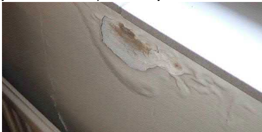
Kuva 4.2.5. Kosteusrasitusjälkiä ruokasalin ulkoseinässä ikkunan alla.
