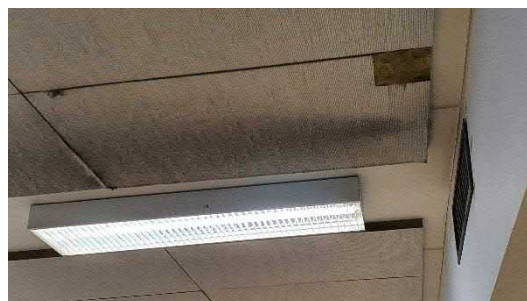
Kuva 4.4.5. Reunoiltaan pinnoittamattomat ja pinnoiltaan osin rikkoontuneet akustiikkalevyt ovat värjäytyneet tuloilmasuihkuun vaikutuksesta.
