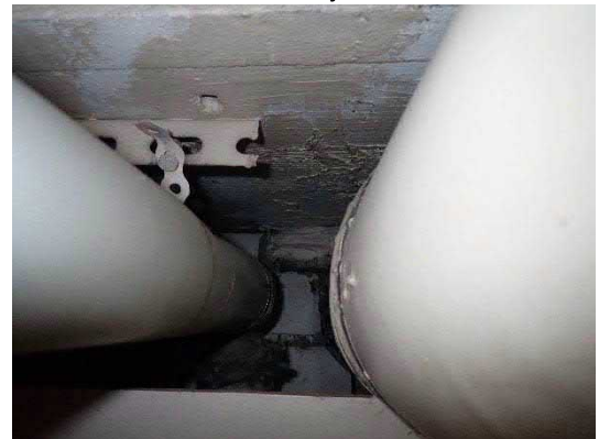
Kuva 4.3.47. Putkiläpivientien kohdalla oli merkittävä ilmapuoto kohta putkitunneliin.
