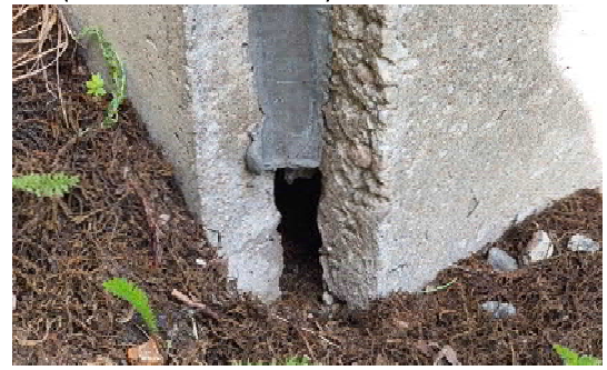
Kuva 4.1.4. Sokkeliementtien sauma ei eteläseinustalla ulottunut koko elementin matkalle.
