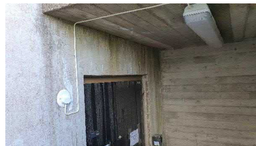
Kuva 4.1.10. Vettä on vuotanut katoksen ja seinän välistä liikuntasalin ovelle.
