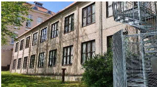
Kuva 4.1.1 Etelän puolella maanpinta viettää kohti rakennusta, jonka ulkoseinäelementtien tuuletusaukot ovat osin maanpinnan tasolla.
