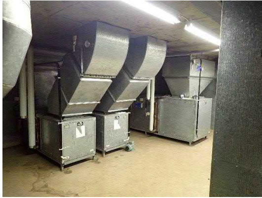
Kuva 4.5.2. Tuloilmakoneet TK-3, TK-2 ja TK-4 ulakon IV-konehuoneessa.
