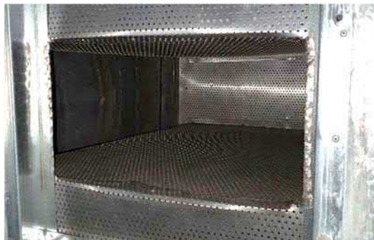
Kuva 4.5.10. Äänenvaimennuskammiossa mineraalivilla on päällystetty reikäpellillä.
