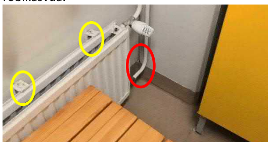
Kuva 4.3.18. VSS-tilan mv.seinän eristetilasta havaittiin pukuhuoneeseen P30 merkittävää (punainen) ilmavuotoa pilarin takaa ja vähäistä patterikannakkeista (keltainen).
