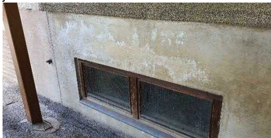
Kuva 4.1.11. Kosteusrasitusjälkiä ulkoseinän alaosassa sisäpihan puolella.
