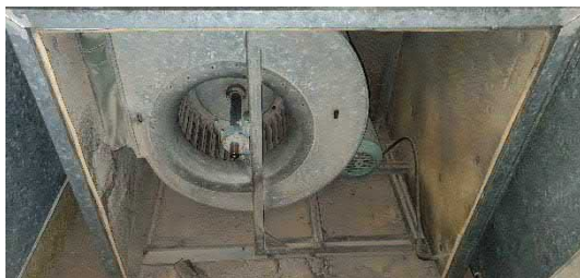
Kuva 4.5.22. Poistoilmakoneen PK-4 puhallinkammion sisäpintana on mineraalivillalevy.
