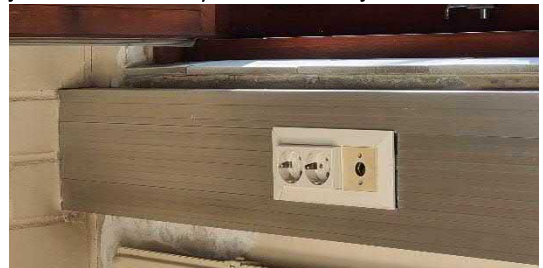
Kuva 4.2.6. Ikkunoiden alla havaittiin yleisesti kosteuden aiheuttamia jälkiä, joita oli myös osin hiottu pois.
