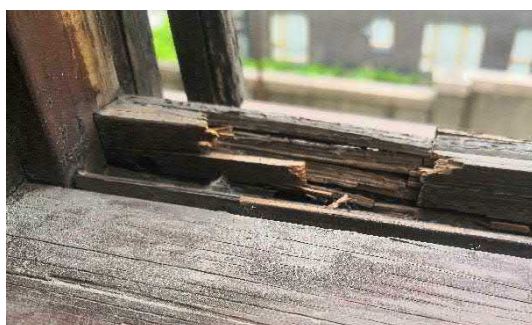
Kuva 4.3.29. Ikkunoiden puuosat ovat yleisesti huonokuntoisia ja paikoin lahoja.
