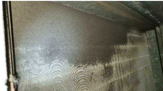
Kuva 4.5.8. Lämmityspatterin säleikön yläosa on likainen.
