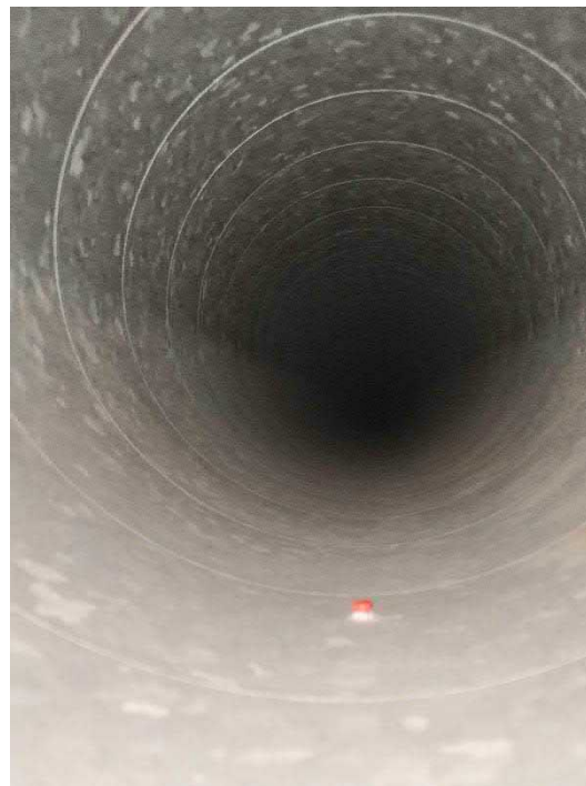
Kuva 4.5.19. Pukuhuoneen P10 tuloilmakanava oli pölyinen, pölyraja erottuu selvästi ”klo kolmessa ja yhdeksässä”.
