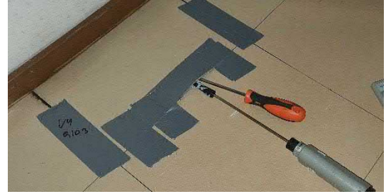
Kuva 4.3.7 Asennettaessa mittapäätä liimatilaan viiltomittauksessa V4 havaittiin liimatilasta voimakasta vaurioon viittaavaa hajua ja vinyylilaattojen olevan huonosti kiinni alustassaan.
