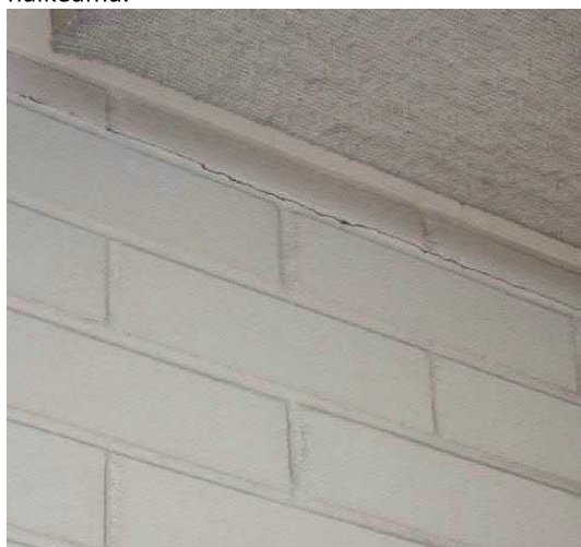
Kuva 4.6.5. Halkeama väliseinässä tilassa 104 (OT3).
