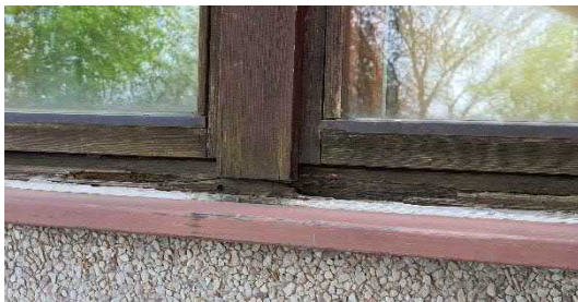
Kuva 4.1.5. Ikkunat ovat pääosin huonokuntoiset...
