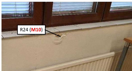
Kuva 4.3.27. Ruokasalissa ikkunan alla olevan kosteusvauriojäljen kohdalla seinän lämmöneristeet ovat mikrobivaurioituneet (näyte M10 ) ja eristetilassa havaittiin muurahaispesä.
