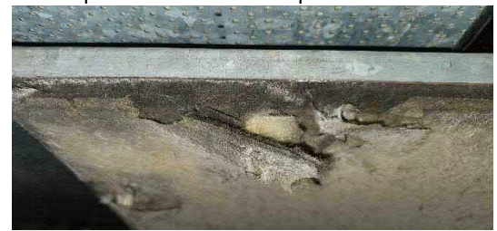
Kuva 4.5.23. PK-4 puhallinkammion äänenvaimennusmateriaalit ovat paikoin rikki ja...
