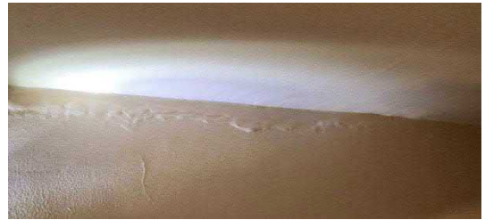
Kuva 4.2.2. WC-tiloissa P06 ja P07 havaittiin mv. seinissä kosteuseroja ja katon rajassa myös maalipinnan kupruilua.
