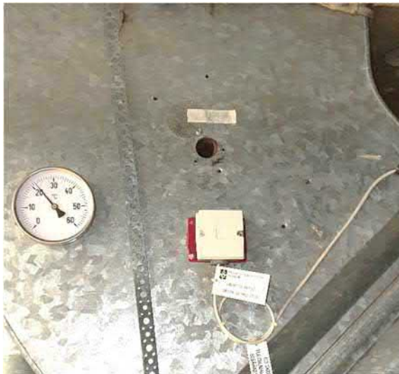
Kuva 4.5.16. TK-2 äänenvaimennuskammioon ei ollut tarkastusluukkua vaan sisäpinnoite arvioitiin kammion kyljessä olleen reiän kautta.
