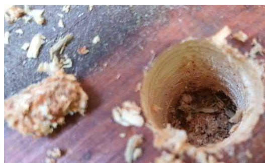
Kuva 4.3.30. Varaston 108 ikkunan apukarmin puu oli märkää ja siinä esiintyi mikrobikasvustoa.
