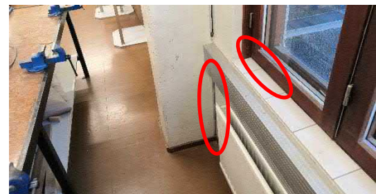
Kuva 4.3.28. Ulkoseinien eristetiloista havaittiin systemaattisia merkittäviä ilmavuotoja (punainen) pilarien takana olevista elementtisaumoista sekä ikkunaliittymistä.
