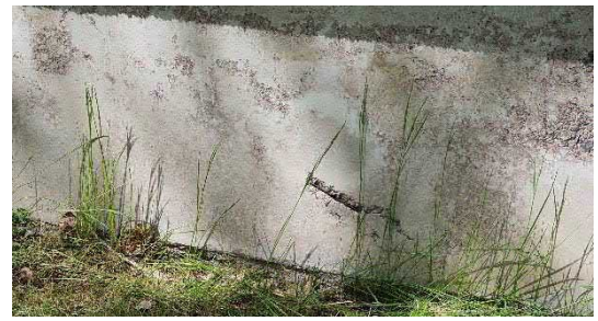
Kuva 4.1.2. Sokkeli on paikoin rapistunut ja betonin teräkset ovat monin paikoin korkanneet näkyviin (kuva eteläseinustalta).
