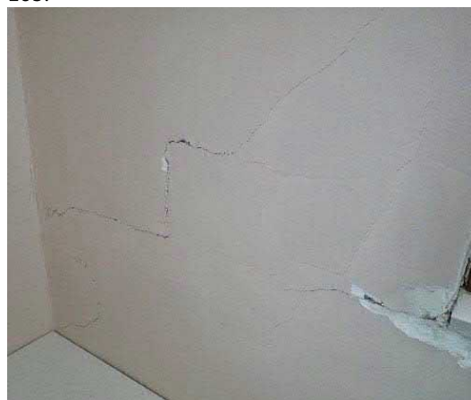
Kuva 4.6.8. Halkeama porrastanteen ikkunan vieressä Hallissa P01.
