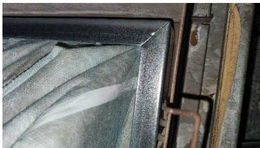
Kuva 4.5.14. Koneen TK-2 suodatin asentuu tiiviimmin kuin koneen TK-1.
