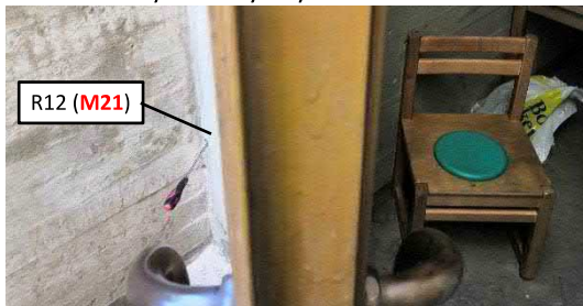
Kuva 4.3.16. VSS-tilojen maanvastaisten seinän ulkonurkkaan tehdystä avauksesta R12 otetussa mineraalivillanäytteessä M21 esiintyi aktiivista mikrobikasvua.
