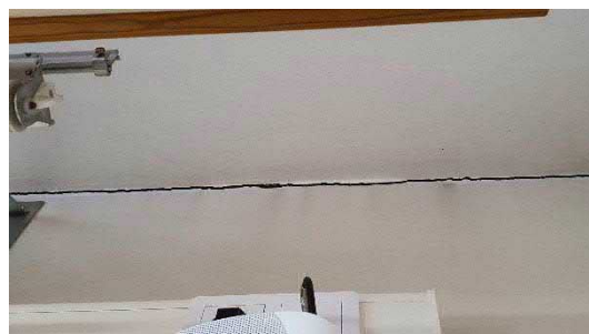
Kuva 4.6.2. Ilmavuotojälkiä halkeamasta ulkoseinän ja yläpohjan liittymässä.
