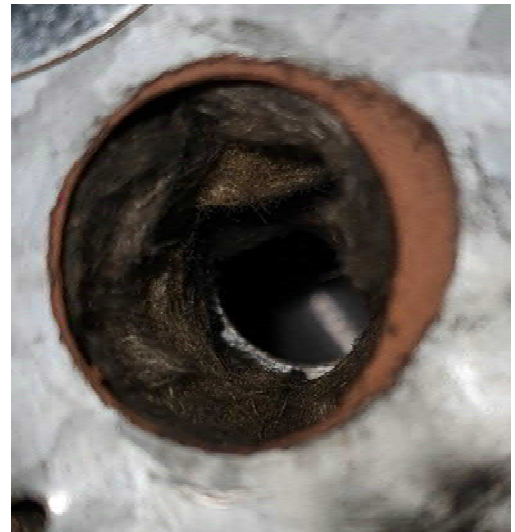
Kuva 4.5.17. Kammion kyljessä olleesta reiästä todettiin akustiikkamateriaalina olevan reikäpellillä pinnoitettua mineraalivillaa.
