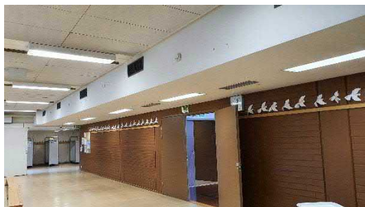
Kuva 4.5.26. Ruokasalin tulo- ja poistoilmaventtiilit oli sijoitettu katon alaslaskuun.
