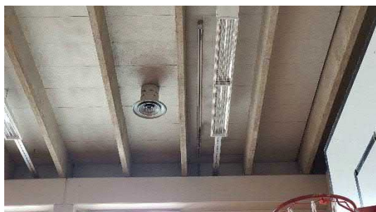
Kuva 4.6.1. Yläpohjalaatan muotoilun vuoksi liikuntasalin vaakapalkkien yläpinnoille voi kertyä runsaasti pölyä.
