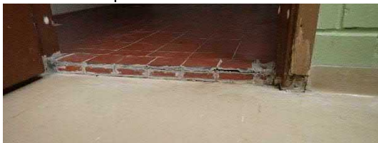
Kuva 4.2.3. Pukuhuoneissa havaittiin kohonneita kosteuksia erityisesti suihkutilojen edustalla, jossa havaittiin myös kosteusjälkiä.
