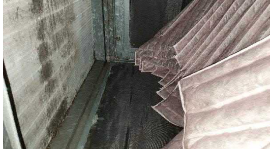
Kuva 4.5.6. Suodattimien laskeutumista kammion pohjalle ei ole estetty, lämmityspatterin pinta on likainen.
