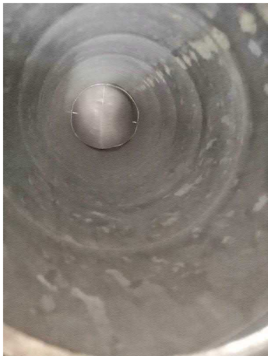
Kuva 4.5.18. Opetustilojen tuloilmakanavien pohjalla oli pölyä, mutta selvästi vähemmän kuin pukuhuoneetiloissa (kuva 4.5.19).
