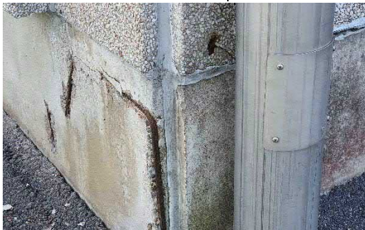
Kuva 4.1.3. Rapistunutta sokkeliä liikuntasalin ulkonurkalta.
