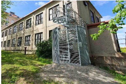
Kuva 4.3.14. Keittiön piha- ja katosrakenteiden sekä hätäpoistumistien sijaintien takia VSS-tilan maanvastaisten seinien ulkopinnan mahdollista kosteuseristystä ei kyetty tarkastamaan.
