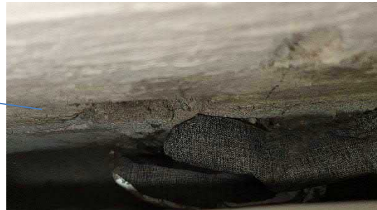
Kuva 4.3.43. Porrastasanteen alta todettiin merkittävä ilmapuoto patterin takana olevasta reiästä.
