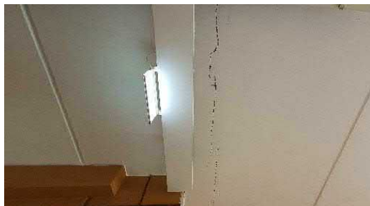
Kuva 4.6.3. Porrashuoneen 114 katossa on laaja halkeama.
