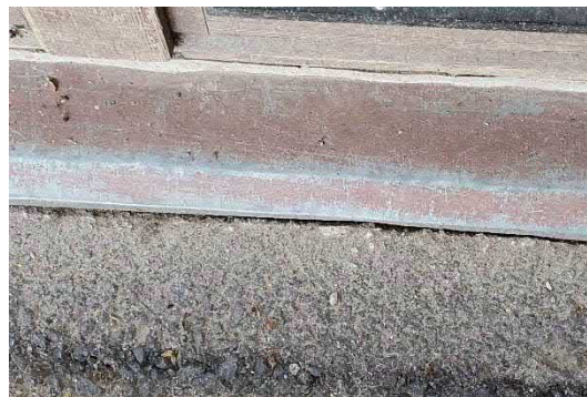
Kuva 4.1.8. Veden kulkeutuminen seinärakenteeseen on mahdollista pellityksen alta.
