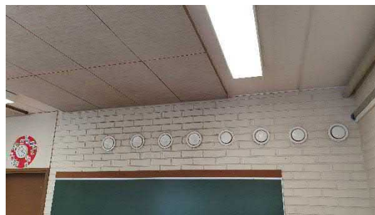
Kuva 4.5.27. Luokissa oli seinään asennetut lautasventtiilit sekä tulo- että poistoilman päätelaitteina.
