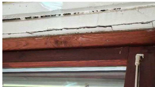
Kuva 4.6.4. Halkeama ikkunan yläpuolella tilassa 106 (OT1)
