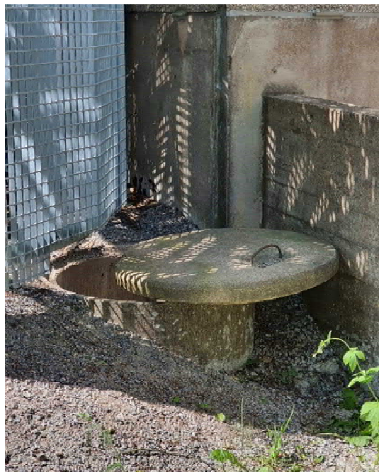
Kuva 4.5.32. Salaojakaivo VSS-tilan ulkonurkassa.
