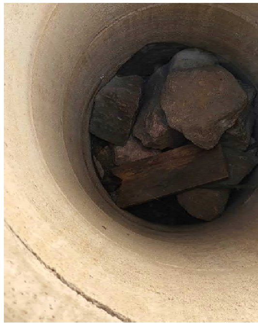
Kuva 4.5.33. Kaivo oli kuiva, salaojien päät eivät olleet näkyvissä pohjalla olevien kivien ja lautojen alta.
