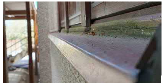
Kuva 4.1.6. ...ja ikkunapeltien kallistukset riittämättömät.
