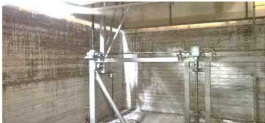
Kuva 4.2.1. Näyttämön koneistosyvennyksen maanvastaisissa betoniseinissä havaittiin pintakartoituksissa poikkeavia kosteusalueita.
