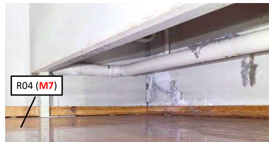
Kuva 4.3.10 Liikuntasalin alapohjan lämmöneristeistä otetuissa 4 näytteestä poikkeavaa mikrobistoa esiintyi ainoastaan seinän kosteusvauriojälkien vierestä otetussa näytteessä M7 .
