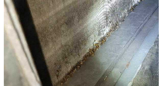
Kuva 4.5.7. Suodatinkammion pohjalla on runsaasti likaa (tuloilman kulkusuunnassa suodattimien jälkeen).
