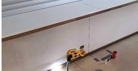
Kuva 4.3.6. Ruokasalin lattiapäällyste on vaurioitunut yläpuolisen kosteusrasituksen vaikutuksesta pieneltä alueelta keittiön vastaisen seinän vierestä.
