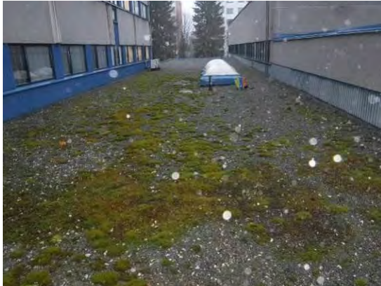
Kuva 66. Katolla kasvaa runsaasti sammalta.
