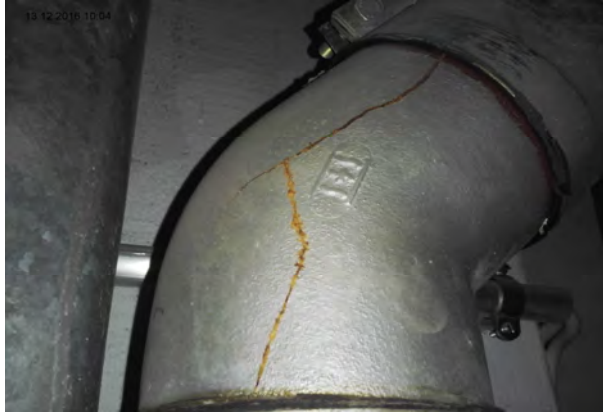
Kuva 2. Haljennut valurautaviemärin käyrä vanhassa osassa.
