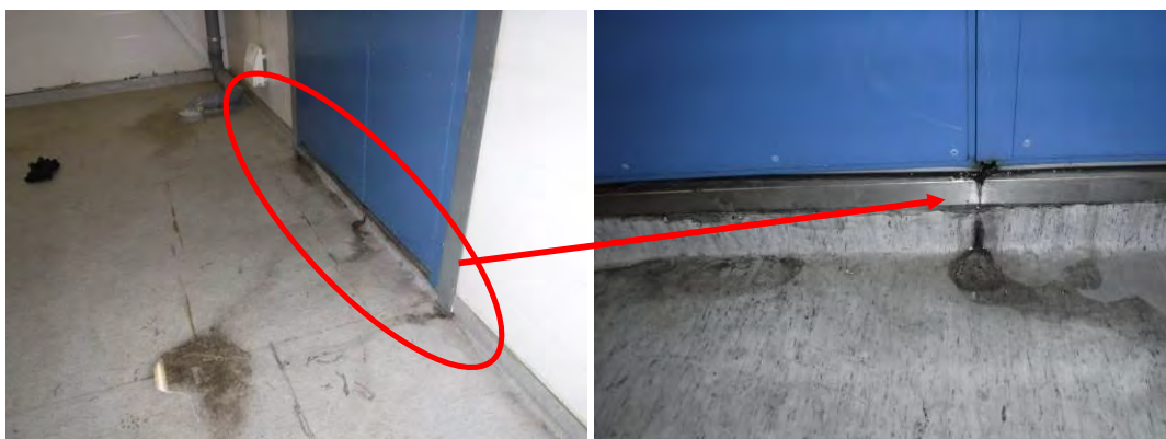
Kuvat 52 ja 53. Oven pellityksessä havaittiin kolme eri vuotokohtaa. Yksi oven keskellä ja yksi molemmissa reunoissa.
