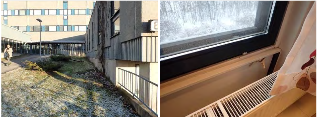
Kuva 39 ja 40. Vanhan puolen lounaissivun matalan osan ensimmäisen kerroksen ulkoseinissä on ikkunoiden alla profiilipeltiverhous. Sisäpuolella ikkunoiden alla on levyverhousta, joka huoneessa 163b oli kipsilevyä. Levy oli rikkoutunut tuuletusikkunan alta (avauskohta R5).
