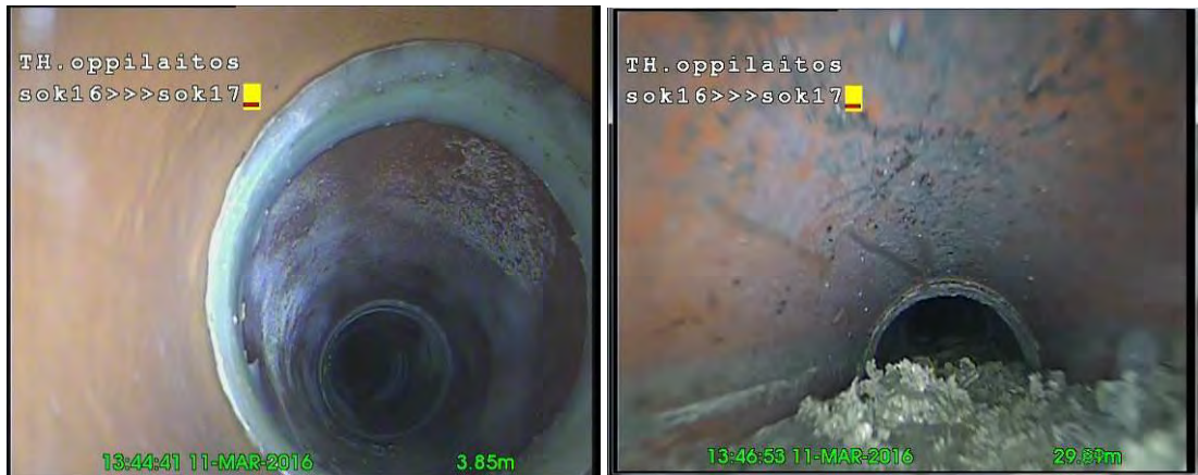
Kuvat 20 ja 21. Vanhan osan lounaissivulla salaojaputki vaihtuu muoviksi kaivon 16 läheisyydessä. Kaivojen 16 ja 17 välissä vanha savitiiliputki on tukossa.
