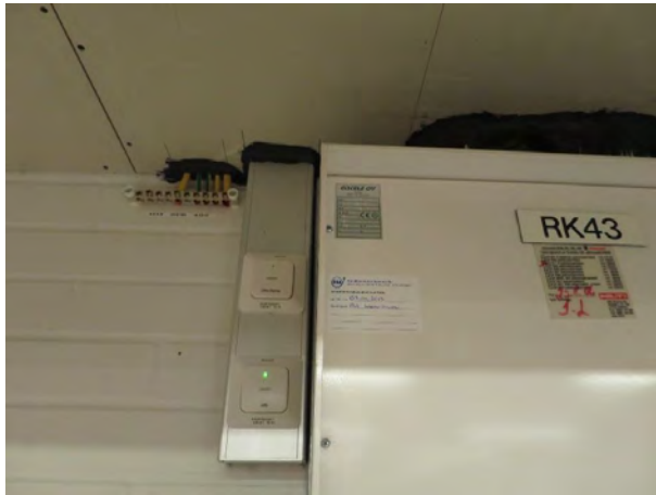
Kuva 6. Paloläpiviennit on tehty ja merkitty hyvin. Maadoituskiskot on numeroitu ja merkitty.
