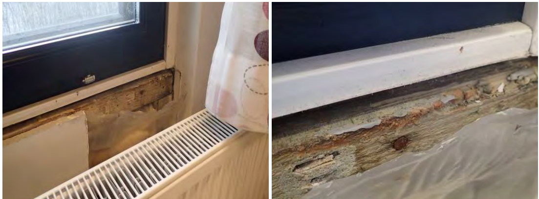
Kuva 41 ja 42. Toimistohuoneen 163b ulkoseinän sisäverhouslevyn alla oleva puukoolaus oli tummunutta, naulat ruostuneet ja mineraalivilla tummentunut (avaus R5).
