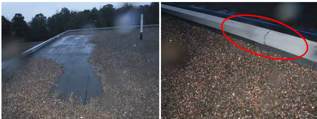
Kuvat 49 ja 50. Singeli puuttuu paikoitellen ja räystäspellityksen kiinnitys on huono.
