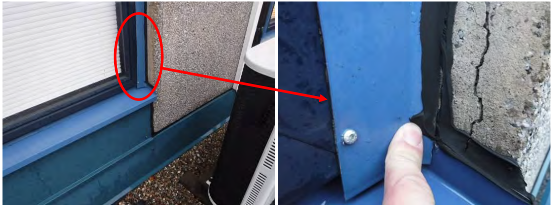
Kuvat 58 ja 59. Ikkunan ja ulkoseinän liittymän tiivistysmassat ovat paikoitellen halkeilleet. Betonipielessä todettiin myös halkeama.
