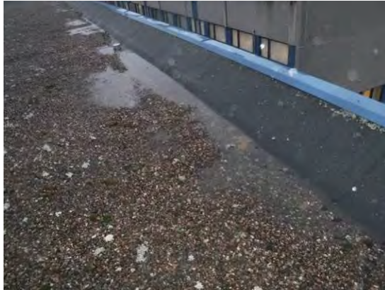
Kuva 69. Vesi lammikoituu paikoitellen voimistelusalin vesikatolla.
