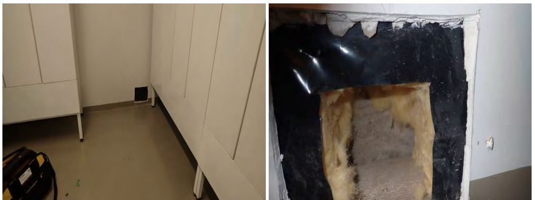
Kuva 34 ja 35. Uuden puolen väestönsuojien maanvastaisten seinien sisäpinnassa on lämmöneriste ja levyverhous (R8). Takana olevan betonin pinnassa havaittiin kohonneita lukemia pintakosteusilmmaisimella.
