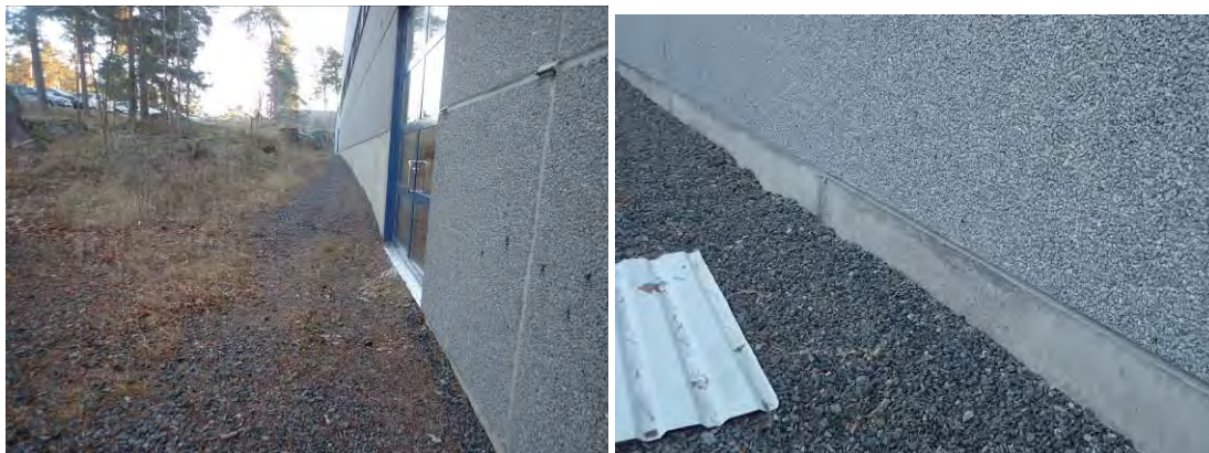
Kuvat 3 ja 4. Uimahalli- ja liikuntasaliivien koillissivulla kallio nousee jyrkästi rakennuksen vierestä. Uimahallin kohdalla sokkelin ja pesubetoniseinän liittymässä on kosteusjälkiä.
