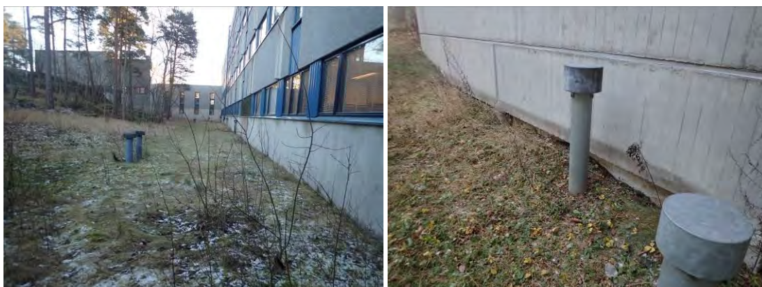
Kuvat 5 ja 6. Koillispuolella maanpinta ei kallista pois päin rakennuksesta. Sokkelin viereen on muodostunut paikoin kuoppia. Paikoitellen maanpinnan yläpuolella näkyy sokkelin eristystä.
