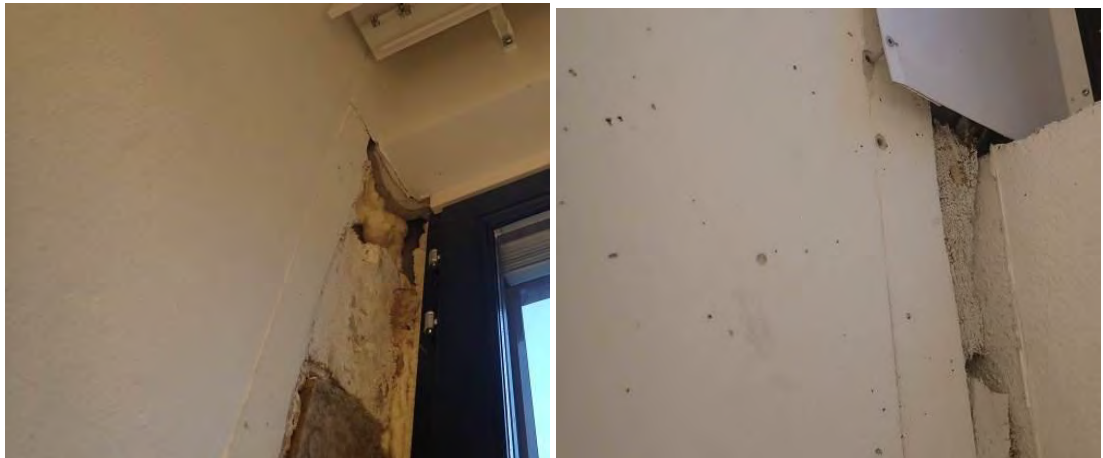
Kuva 43 ja 44. Ulkoseinien ja pilarien liittymiä on eristetty ja tiivistetty vaihtelevasti. Liittymistä havaittiin sisätiloihin suuntautuvaa ilmavirtaa. Avaukset R7 ja R9.
