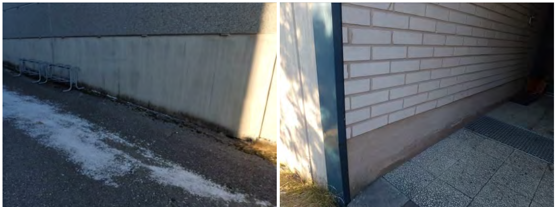
Kuvat 9 ja 10. Kaakkoissivustalla uuden puolen rakennusten sokkelin alaosa vihertävät. Uuden puolen korkeamman osan kaakkoispäädyn sisäänkäynnin sokkelin alareunassa on kosteusjälkiä.
