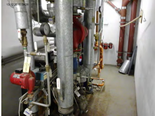
Kuva 1. Ammatti- instituutin lämmönjakokeskus.
