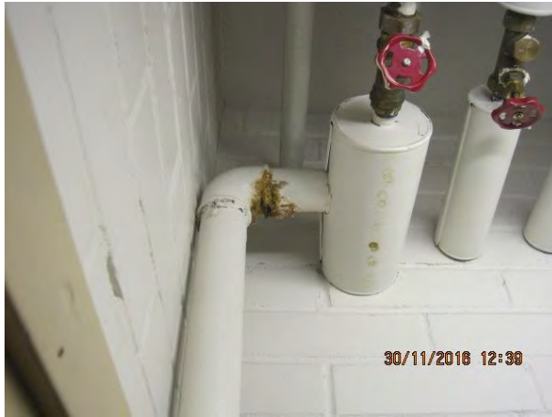
Kuva 3. Kuvassa heikkokuntoinen kylmävesijohdon kulma
