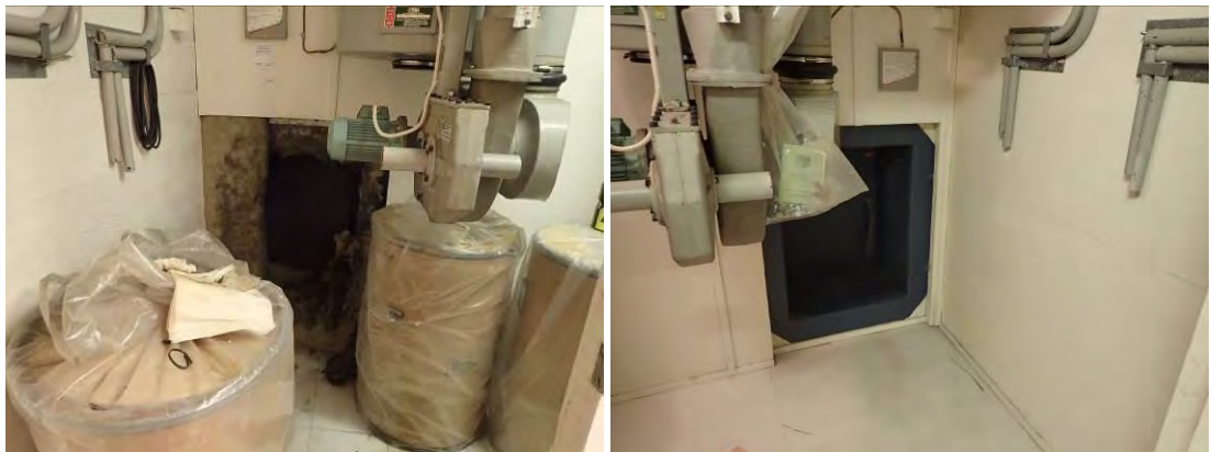
Kuva 32 ja 33. Vanhan puolen väestönsuojan 008 laitehuoneen maanvastaisen seinän eriste on hätäpoistumisaukon kohdalta mustunut (kuva 32). Muissa laitehuoneissa hätäpoistumisaukon ympäristössä ei havaittu paljasta mineraalivillaa, vaan eristys oli levytyksen takana.
