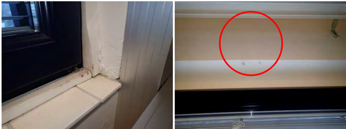
Kuvat 47 ja 48. Ulkoseinien sisäpinnoissa havaittiin paikoitellen kosteusjälkiä. Kuvassa 47 ikkunapieli ja listoitukset ovat kastuneet vanhalla puolella ja kuvassa 48 näkyy uudella puolella valumajälkiä ulkoseinän ja katon rajassa.
