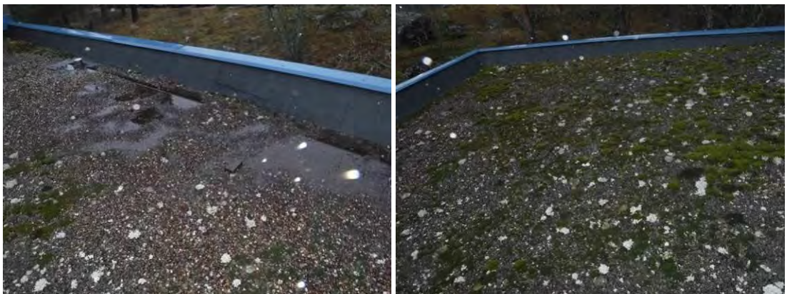
Kuvat 67 ja 68. Vesi lammikoituu paikoitellen uimahallin vesikatolla.
