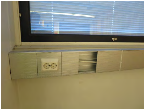
Kuva 5. Johtokanava, kansilevy puuttuu (järjestelmään ei saada enää varaosia).
