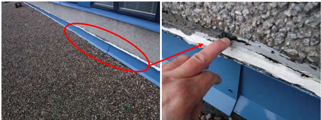
Kuvat 60 ja 61. Ulkoseinän ja vesikaton liittymän tiivistysmassat ovat paikoitellen halkeilleet ja irronneet reunoiltaan.
