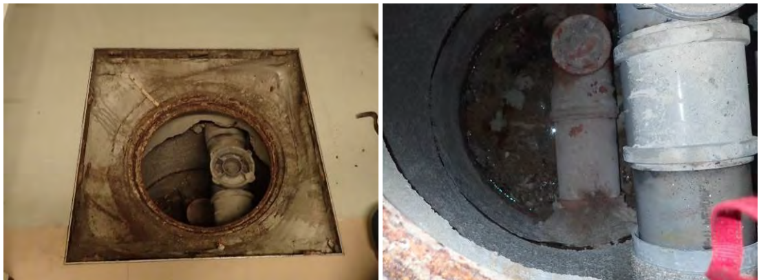
Kuvat 22 ja 23. Uuden puolen korkean osan kellarissa todettiin vettä viemärin tarkastuskaivon pohjalla.
