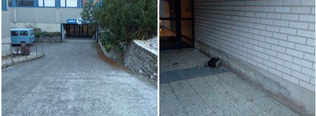
Kuvat 7 ja 8. Luoteissivustalla olevan asfalttipihan vedenpoisto on puutteellinen. D-portaan sisäänkäynti syvennyksen sokkelissa on kosteusjälkiä.
