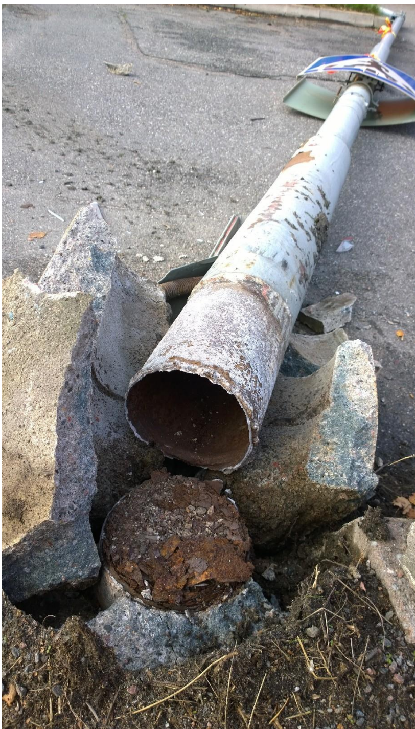
Kuva 1. Tyvikorroosion takia itsestään kaatunut valaisinpylväs Ruissalonttiellä. Koko teräspoikkileikkaus on ruostunut pois. Tolppa on pysynyt jonkin aikaa pystyssä raudoittamattoman juuriholkkavalun ansiosta, sitten sekin on antanut periksi. Ulkopuolinen juuriholkkavalu kätkee helposti tyven pahimman syöpmiskohdan, ja vauriot eivät ole silmämääräisesti aina havaittavissa ulkopuolelta.
