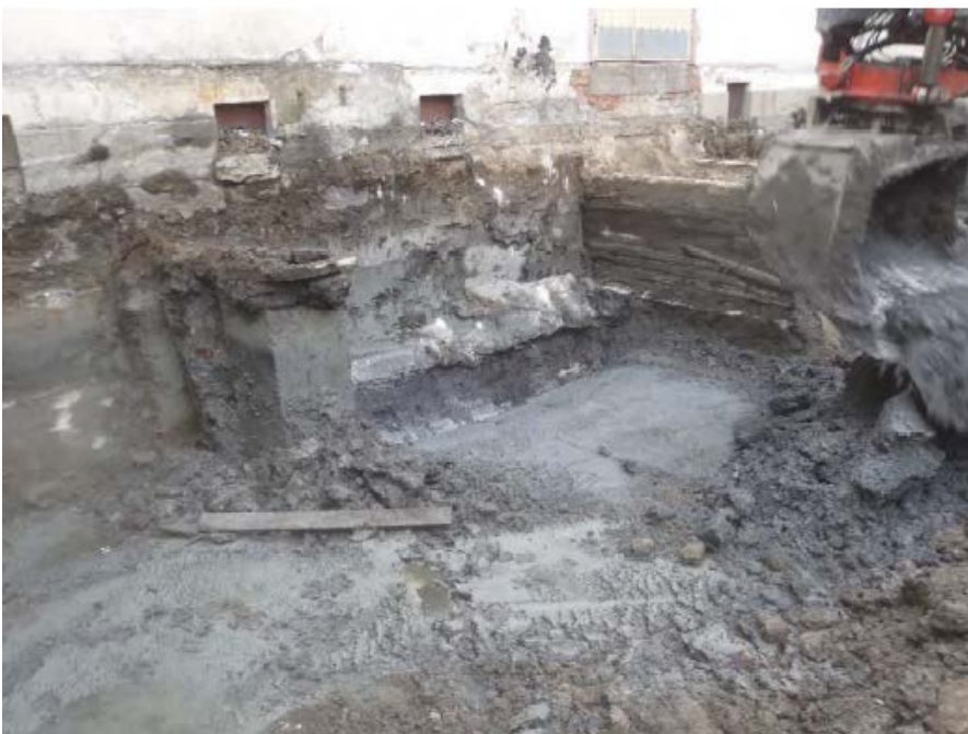
Kuva 3. Lastauslaiturin alapuolelta maan alta löytyi vanha öljyinen kaivo, johon putki kellarista.
