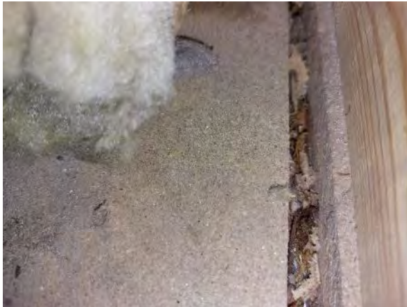
Kuva 71. Väliseinien ja alapohjan liitoksissa havaittiin avoimia rakenneliitoksia, jonka kautta ilmavirtaukset alapohjarakenteesta sisäilmaan ovat mahdollisia.
