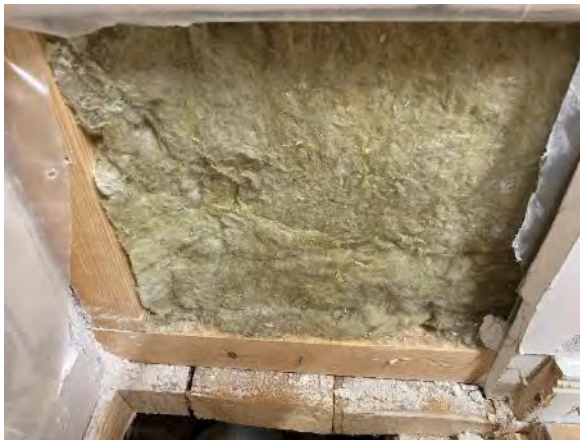
Kuva 251. Kantavan väliseinän höyrynsulun toteutustapa on epätiivis. Höyrynsulkumuovi päättyy lattia-lankun pintaan.
