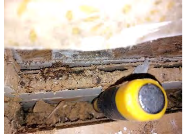
Kuva 166. Rakenneavaus US8. Ulkoseinän ja alapohjan liitos on aistinvaraisesti tarkastellen epätiivis.
