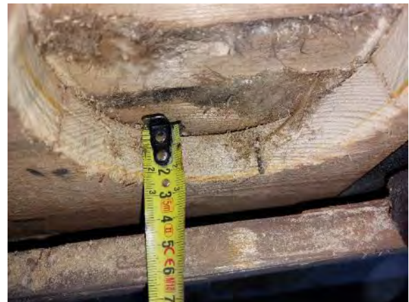
Kuva 111. Hirren ulkopinnalla havaittiin vaakalaudoitus.
