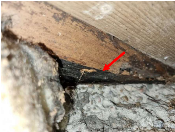
Kuva 32. Rakennuksen 2 sokkelin ja alapuun välinen kermi on tummuttanut alapuun alapintaa.
