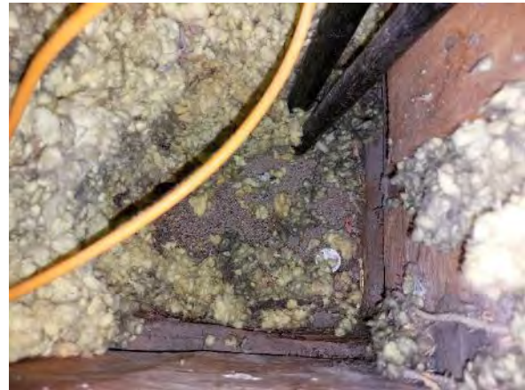
Kuva 297. Paikoin yläpohjassa on eristeenä ainoastaan puhallusvillaa.
