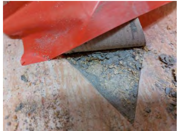
Kuva 25. WC:n muovimaton alapuolella ei ole käytetty erillistä vedeneristekerrosta. Muovimaton alla on tasoite sekä lastulevy.
