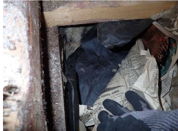
Kuva 29. Rakennuksessa 1 AP5 tervapaperi kopiohuoneessa.
