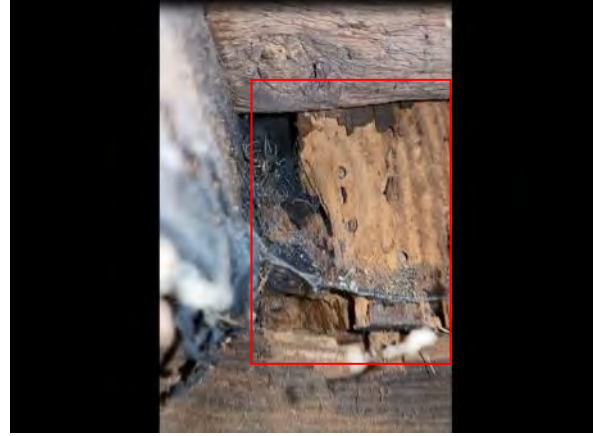
Kuva 141. Runkotolpan alaosassa havaittiin lahovaurioita. Runkotolpan alaosa merkittynä kuvaan.
