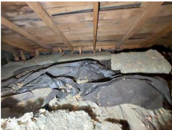
Kuva 312. Rakenneavaus YP8: Mineraalivillaeristettä on lisätty puupurueristeen päälle. Eristekerroksien pinnalla on paikoin tervapaperia.
