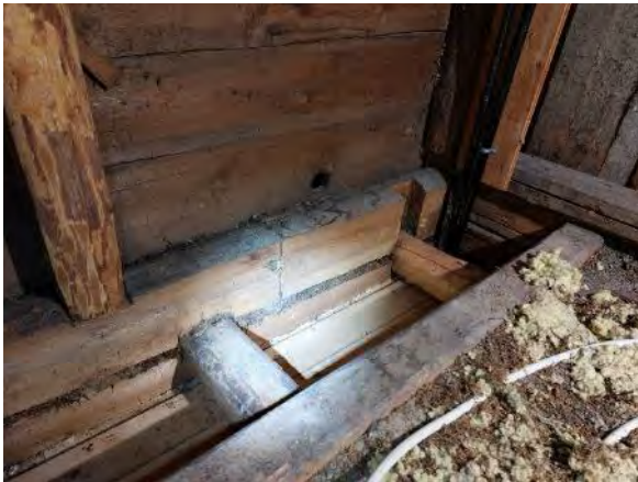
Kuva 284. Lounaissiiven ja ns. keskiosan sisänurkan alueella havaittiin lämmöneristämätön alue. Lounaissiiven alueella hirsirunko on rakennettu ns. tasakertaan.
