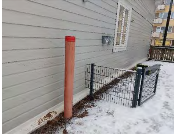
Kuva 7. Rakennuksen 1 lounaan puoleisessa siivessä ei havaittu tuulettumisen mahdollistavia tuuletusaukkoja. Maanpinta ulottuu suojapellityksen pintaan. Kuvassa näkyvän putken tarkoituksena on mahdollistaa alapohjan tuulettuminen. Tulpattuna putki ei toimi suunnitellusti.
