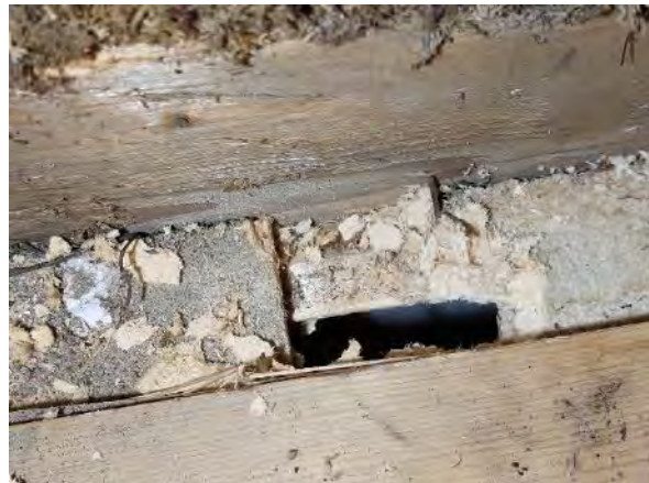
Kuva 309. Rakenneavaus YP3, puukuitulevyn alapuolella on tyhjä tila.
