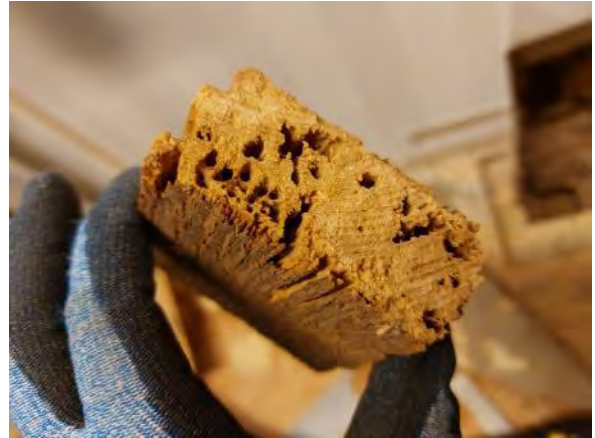
Kuva 16. Tuulettuvan alapohjan aluslaudoituksissa on havaittavissa lahovauriota ja hyönteistuoja.
