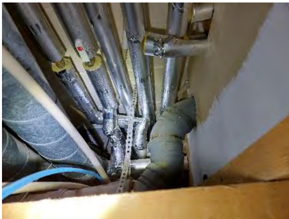
Kuva 210. Sisäkatoissa on avoimia mineraalivillaeristeisiä putkia sekä epätiivitä läpivientejä.
