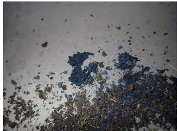
Kuva 87. Rakenneavaus AP10: Alapohjan betonilaatan alapuolella on puupohjaista materiaalia.
