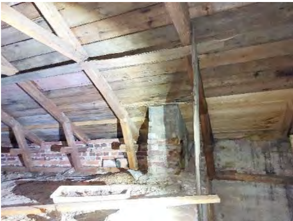
Kuva 355. Aluslaudoitusta on havaintojen perusteella uusittu.
