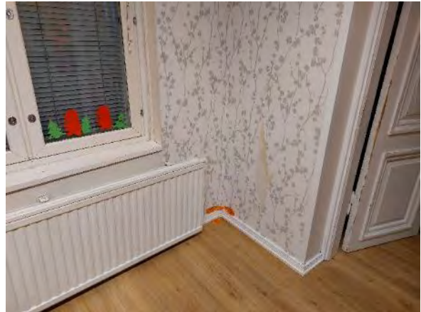
Kuva 240. Paikoin pintarakenteissa oli havaittavissa käytön aiheuttamaa kulumaa. Kantavat väliseinät ovat hirsirakenteisia.
