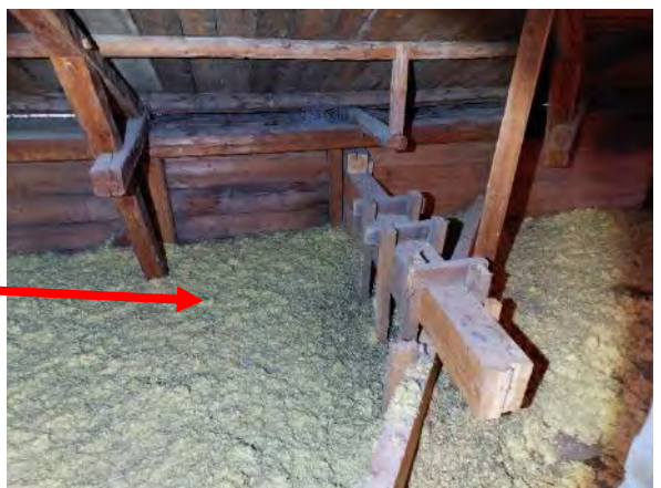
Kuva 281. Yläpohjassa havaittiin lisätuentoja lounaissiivän alueella.
