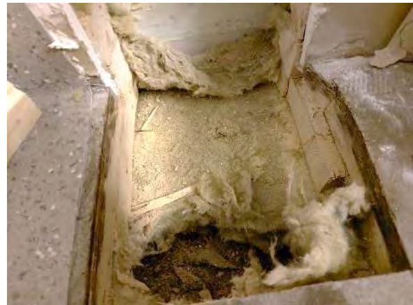
Kuva 19. Alapohjan lämmöneristeenä on mineraalivillaa, jonka alapuolella lämmöneristeenä on rakentamisaikakaudelle tyypilliseen tapaan hiekkaa, sammalta ja metsänpohjaa.
