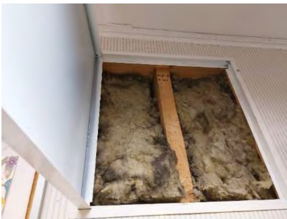
Kuva 361. Tiloissa havaittiin epätiiviitä tarkastusluukuja, joiden takana havaittiin suojaamatonta mineraalivillaeristettä.
