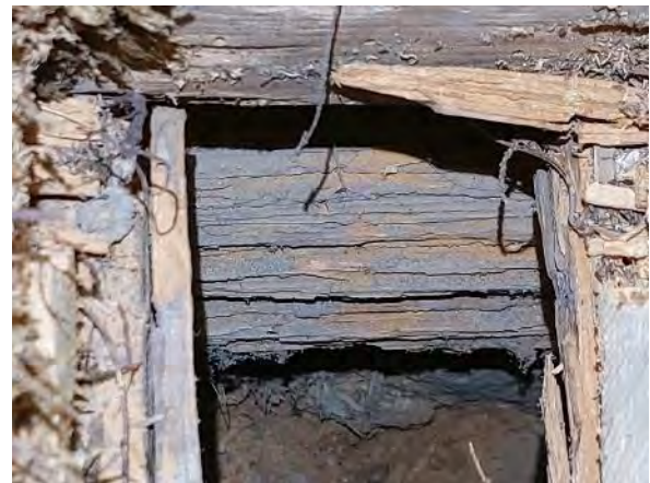
Kuva 109. Alimmissa hirsikerroksissa havaittiin lahoaurioita.
