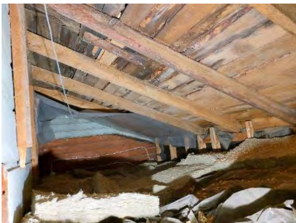
Kuva 286. Yleiskuva laajennusalueen yläpohjasta. Laajennusosan lounaispuolella havaittiin muovikaista aluslaudoituksen alapuolella.
