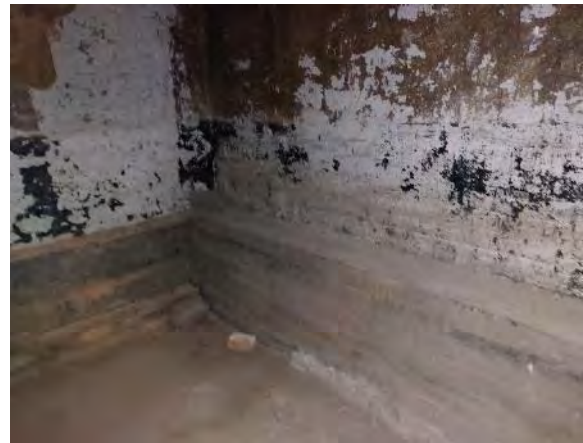
Kuva 197. Kkellarin ulkoseinärakenteen sisäpinnalla on havaittavissa bitumisivelyjämiä. Bitumisivelyn PAH-pitoisuus alittaa vaarallisen jätteen pitoisuusrajan. Seinätasoite ja maali ei sisällä asbestia.
