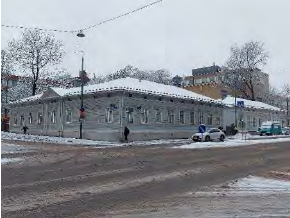
Kuva 276. Rakennus 1. Vesikate oli tutkimushetkellä lumipeitteinen, jonka vuoksi sen kuntoa ei tämän tutkimuksen yhteydessä tarkastettu.
