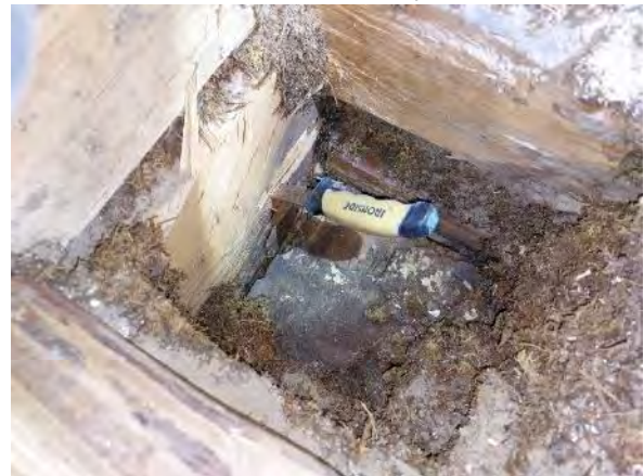
Kuva 133. Rakenneavaus US4. Ulkoseinä ja alapohjan laudoituksen alimman hirren sisäpinnalla havaittiin viitteitä lahovauriosta. Hirsien tilkkeenä on käytetty sammalta.
