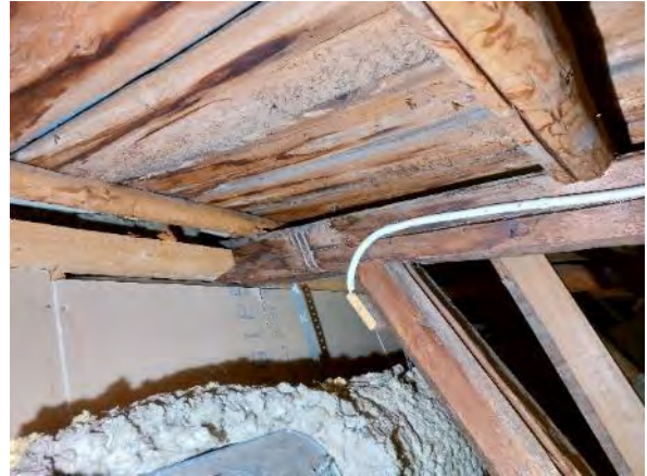
Kuva 283. Kantavissa puurakenteissa havaittiin kosteuden aiheuttamia jälkiä. Lahovaurioita ei kantavissa puurakenteissa havaittu.
