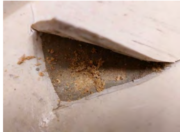
Kuva 70. Rakenneavaus AP 9: Pesuhuoneen muovimaton alapuolella ei ole käytetty vedeneristettä. Muovimaton alla on tasoite sekä puukuitulevy.
