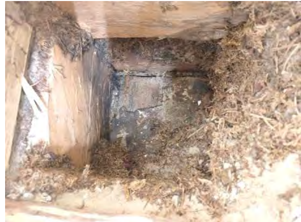
Kuva 27. Rakenneavaus AP 4: Alapohjarakenteen lisälämmöneristeenä on käytetty mineraalivillaa. Rakenteen alkuperäisenä lämmöneristeenä on käytetty hiekkaa ja sammalta, jotka sisältävät luontaisesti mikrobeja.
