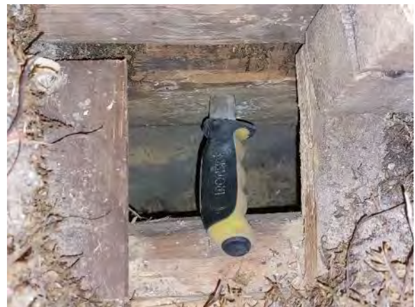
Kuva 118. Ulkoseinän alimman hirren sisäpinnalla oli havaittavissa rakenneavauksesta US2/AP2 lahovauriota. Puukko upposi n. 55 mm syvyyteen hirteen.
