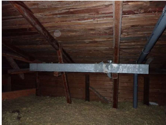
Kuva 3. Asbestipitoinen IV-kanava rakennuksen 1 ullakolla.
