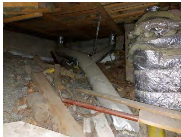
Kuva 56. Rakennuksen 2 ryömintätilassa havaittiin rakennusjätettä. Kuva tilan ET17 alapuolelta.
