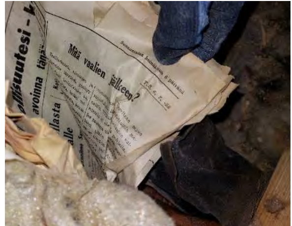
Kuva 35. Alapohjarakenteissa havaittiin vuosien 1957 ja 1958 sanomalehtiä.
