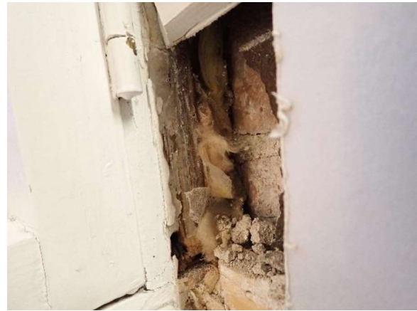
Kuva 37. Rakennuksen 3 raskasmetallipitoinen ruskea ikkunakarmin maali.
