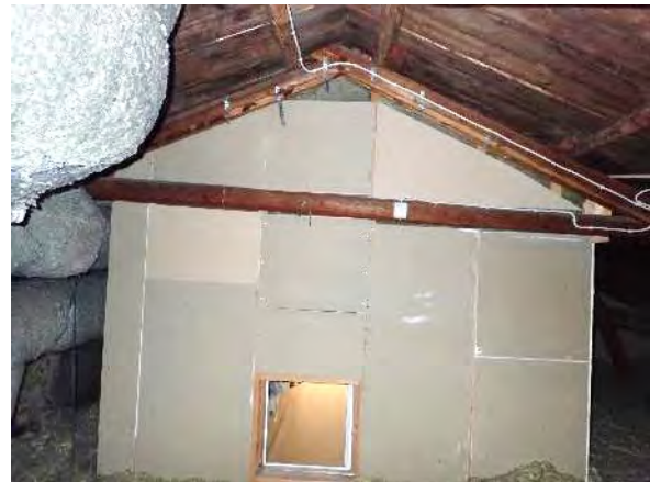
Kuva 299. Yleiskuva 2.kerroksen ullakkotilaan rajautuvista ulkoseinästä ullakkotilan puolelta kuvattuna. Kuvassa on havaittavissa tuulensuojakipsilevytyks.
