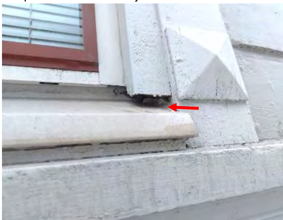
Kuva 99. Ikkunapellitöiden päätytaitteen ylösnosto on riittämätön. Sade- ja sulamisvedet voivat päätyä puurakenteiselle ikkunalaudalle ja mahdollisesti rakenteisiin. Ikkunapellitöiden asennus on voinut olla haastavaa puurakenteisten ikkunalaudojen pinnalle.
