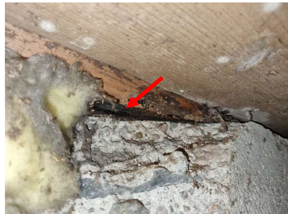
Kuva 31. Rakennuksen 2 sokkelin ja alapuun välinen kermi.
