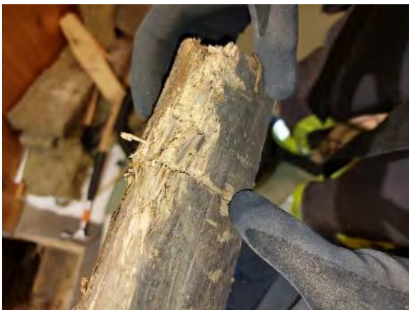
Kuva 63. Rakenneavaus AP7: Alapohjan aluslaudoituksessa on havaittavissa hyönteistuhvoja.
