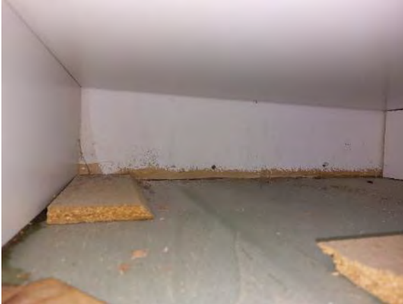
Kuva 267. Väliseinän ja alapohjan välipohjan liitos on epätiivis. Kuva rakennuksen 2 käytävältä kaapistoa.
