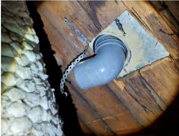
Kuva 331. Yläpohjassa havaittiin vanha viemärin tuuletusputki, joka on jätetty vesikaton läpivientiin.
