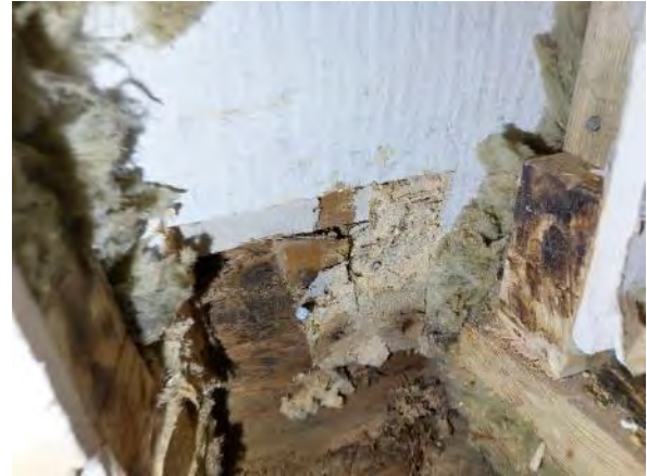
Kuva 107. Ulkoseinän sisäpinnan hirressä sekä kuitulevyn välissä on havaittavissa tummaa kiinnitysainetta.
