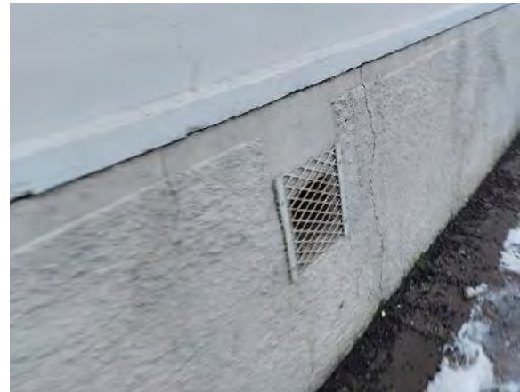
Kuva 4. Alapohjan tuulettumisen mahdollistavia aukkoja havaittiin sokkelirakenteessa.
