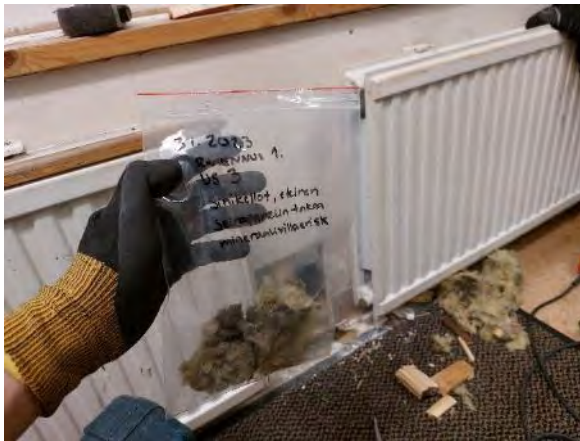
Kuva 124. Mineraalivillaeristeessä on havaittavissa tummentumaa.
