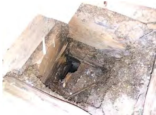
Kuva 29. Rakenneavaus AP 4: Aluslaudoitus on lahovaurioitunut.
