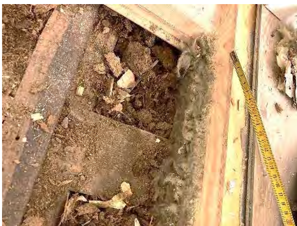
Kuva 67. Rakenneavaus AP9: Mineraalivillakerroksen alapuolella havaittiin turvetta.
