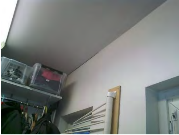
Kuva 221. Ulkoseinän ja välipohjan liitoksessa havaittiin paikoin rakoja.
