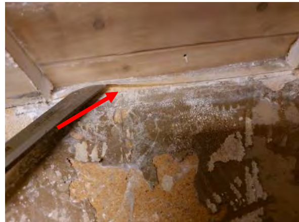
Kuva 105. Rakenneavaus US1: Ulkoseinän höyrnsulun toteutustapa on epätiivis. Sisäverhouslevyn takana on höyrnsulkumuovi ja vaakalaudoitus.
