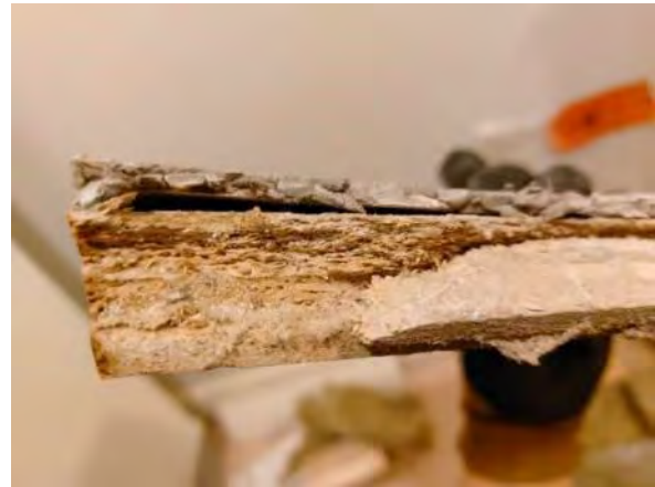
Kuva 37. Rakenneavaus AP 6. Lattian lastulevyssä on havaittavissa aistinvaraisesti kosteuden aiheuttamaa vaurioitumista (levy on turvonnut).
