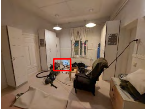
Kuva 134. Rakenneavaus US5 tehtiin päiväkotiryhmän Ruusunnuput ryhmähuoneen (lepo) alapohjan ja väliseinän liitokseen. kuvan osoittamaan kohtaan.
