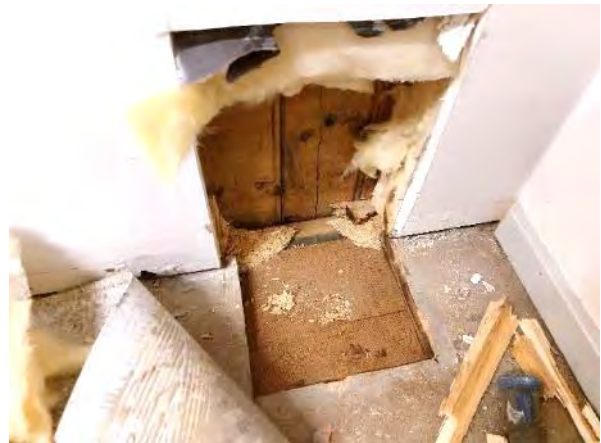
Kuva 199. Rakenneavaus US12: Rakenteessa ilmansulkuna on käytetty tervapaperia.
