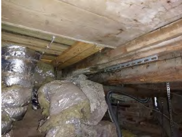
Kuva 57. Aluslaudoitusta on havaintojen perusteella uusittu paikallisesti, mahdollisesti edellisen laajemman korjauksen yhteydessä. Aluslaudoituksen alapinnalla havaittiin kosteuden aiheuttamia jälkiä.
