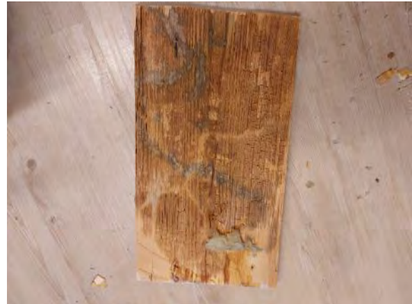
Kuva 66. Lattialankun alapinnalla havaittiin lahovaurioita.
