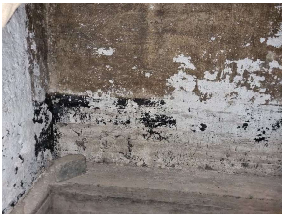
Kuva 16. Rakennuksen 3 kellarin ison huoneen tummempi rappaus ja maali eivät sisällä asbestia.
