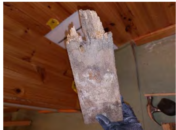
Kuva 64. Rakenneavaus AP7: Alapohjan aluslaudoituksessa on havaittavissa kosteuden aiheuttamaa vaurioitumista ja lahovauriota.
