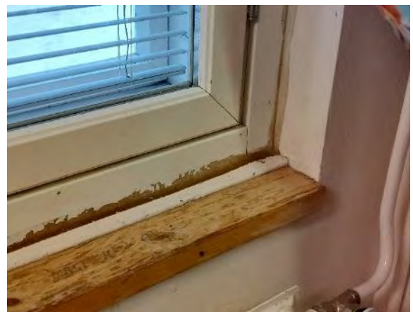
Kuva 100. Paikoin sisäpuolisen ikkunapenkkin pinnassa on havaittavissa kulumaa.
