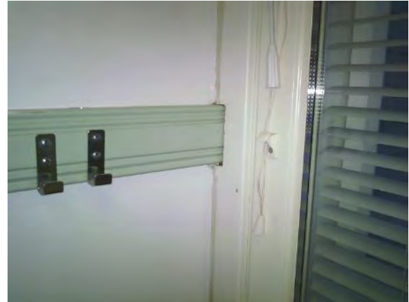
Kuva 181. Ilmavuotoa havaittiin lämpökameralla ulkoseinän ja ikkunan liitoksesta.
