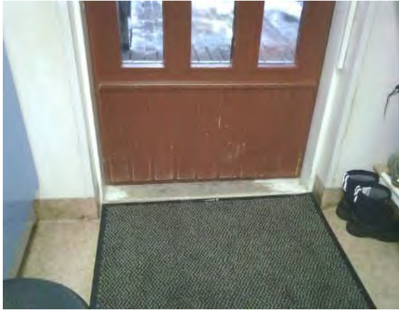
Kuva 103. Ovien sisäpinnoissa on paikoin käytöstä aiheutunutta kulumaa. Kuva rakennuksesta 1.
