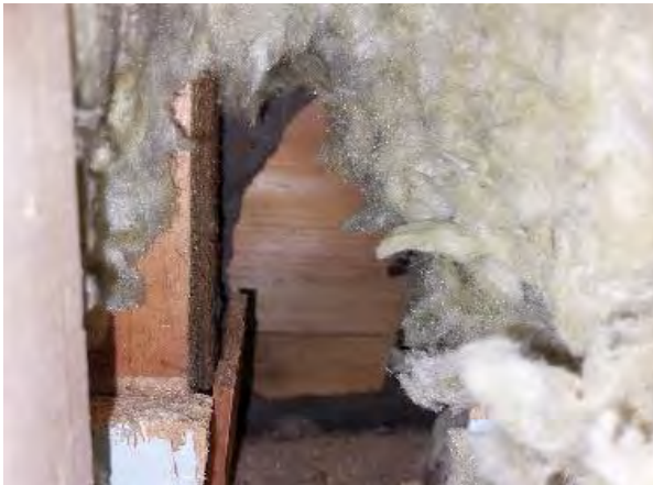
Kuva 126. US3 Rakenneavauksen ulkoverhouksen takana on tervapaperi.
