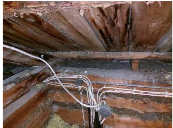
Kuva 291. Yleiskuva yläpohjasta luoteissiivestä. Räyställä ei havaittu tuulettumisen mahdollistavia rakoja.
