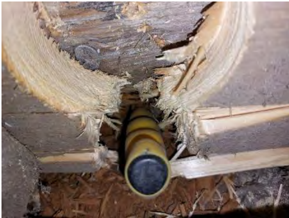
Kuva 121. Hirsiverhouksen pinnassa on havaintojen pe- rusteella uusittua vaakalaudoitusta. Vaakalaudoituksen takana havaittiin lahonnutta hirsirunkoa. Puukko up- posi hirsirakenteeseen koko terän mitalta (10cm).
