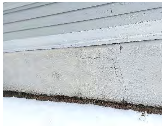
Kuva 93. Sokkelirakenteen pinnalla on paikoin havaittavissa halkeamia.
