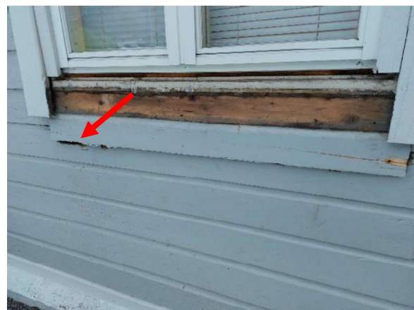
Kuva 24. Vaakalaudan alareunan kitti ei sisällä asbestia, mutta sisältää lyijyä yli raja-arvon.
