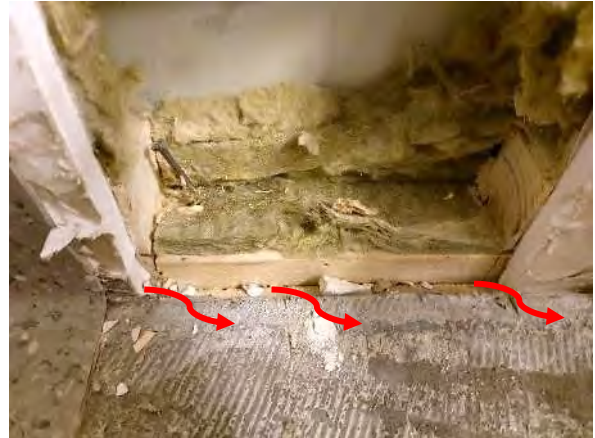
Kuva 40. Ulkoseinän ja alapohjan liitos on avauksista tehtyjen havaintojen perusteella toteutustavaltaan epätiivis
