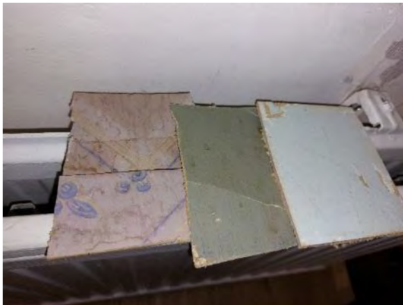
Kuva 132. US4: Ulkoseinärakenteessa on useita vanhoja tapettikerroksia.
