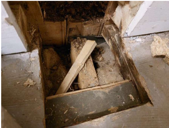
Kuva 38. Rakennuksen 3 neuvotteluhuoneen ponttilaudoituksen raskasmetallipitoinen maali.
