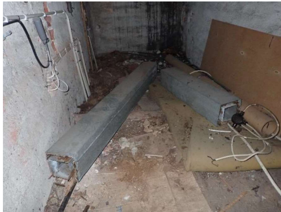
Kuva 5. Kaksi asbestipitoista IV-kanavaa rakennuksen 3 ullakolla.
