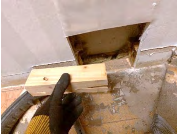
Kuva 106. US1: Sisäpuolinen lisäkoolauksen alaojhauspuu on hyväkuntoinen, eikä siinä havaittu kosteuden aiheuttamia jälkiä.
