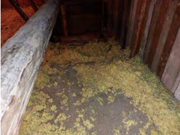
Kuva 294. Puhallusvillaa ei ole yläpohjassa tasaisesti.
