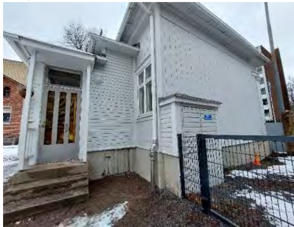
Kuva 160. Rakennuksessa 1 on havaittavissa julkisivun puuverhoilussa paikoin paikkakohtia.
