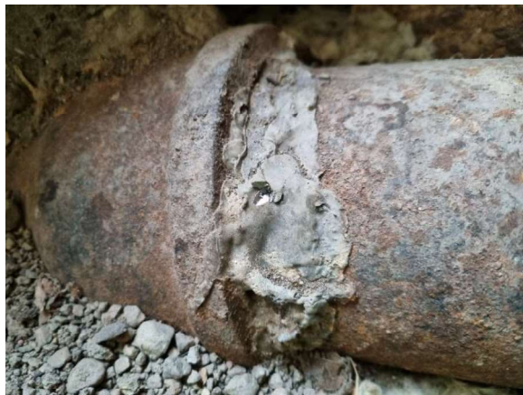
Kuva 39. Lyijypitoista tiivistettä rakennuksen 3 vaakaviemärin valurautaisessa muhviitoksessa.
