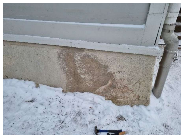
Kuva 2. Asbestipitoinen sokkelin pinnoite.
