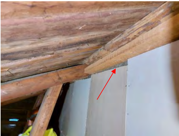
Kuva 298. 2.kerroksen yläpohjarakenteen tuulettuminen on puutteellista vähintään paikoin.
