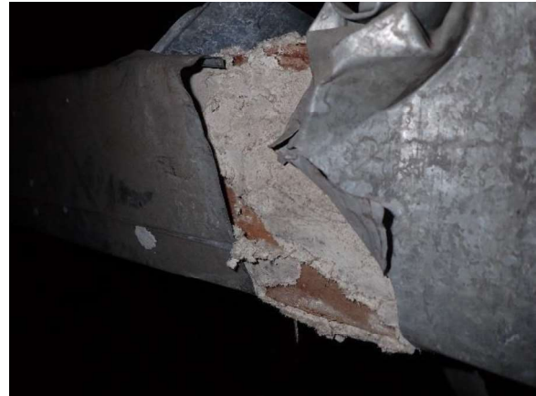
Kuva 4. Lähikuva IV-kanavan rikotusta peltipinnasta ja sen alla näkyvästä vaaleasta asbestipahvista.
