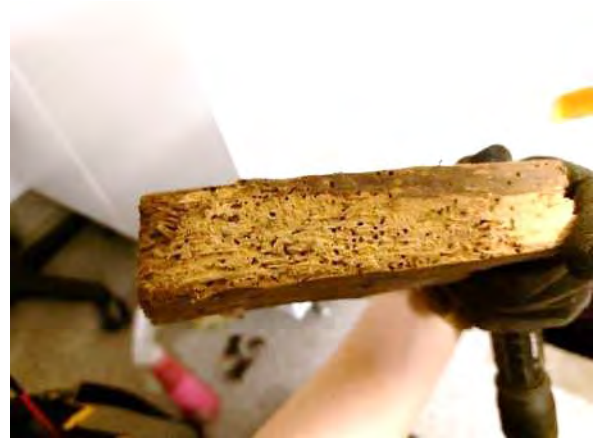
Kuva 21. Rakenneavaus AP2: Alapohjarakenteen alus-laudoituksessa on havaittavissa lahovauriota sekä hyönteistuhhoa.
