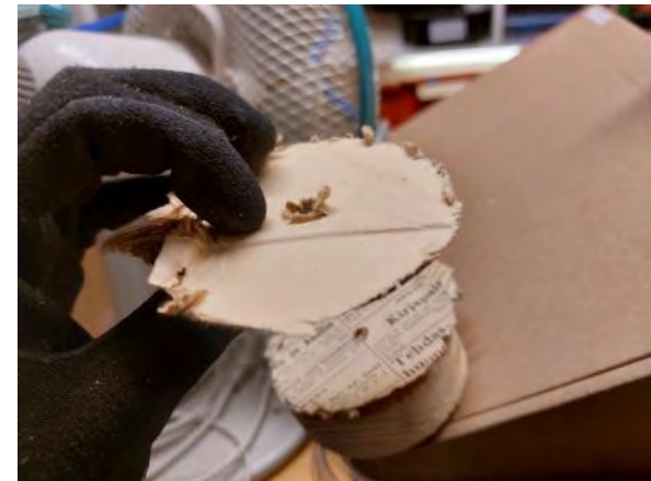
Kuva 338. Rakenneavaus YP4: Kattolaudan takana on paperia ja huokoinen puukuitulevy.
