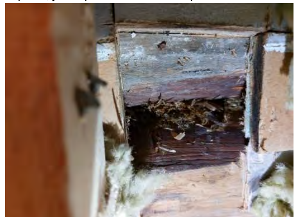
Kuva 137. Rakenneavaus US5. Pinkopahvin takana havaittiin hirsirunko. Hirsien tilkkeenä on käytetty sammalta.
