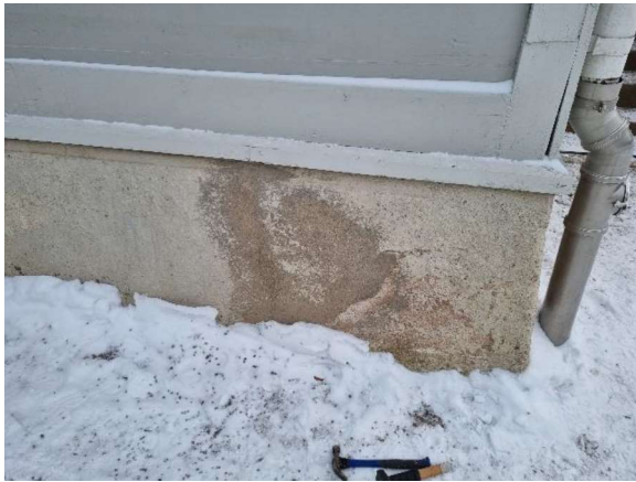
Kuva 36. Rakennuksen 1 asbesti- ja raskasmetallipitoinen sokkelin pinnoite.
