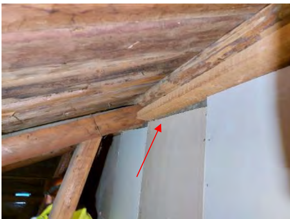
Kuva 292. Rakennuksen toisen kerroksen yläpohjan tuulettuminen on puutteellista.
