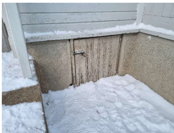
Kuva 1. Asbestipitoinen sokkelin pinnoite
