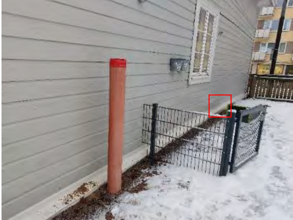
Kuva 119. Ulkoseinä on kiinni maanpinnassa luoteissii- ven päädyn alueella. Ulkoseinän alaosa on pellitetty. Pellitystä avattiin kuvaan merkityltä kohdalta.
