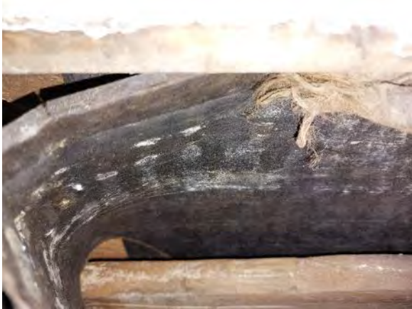
Kuva 112. US1: Vaakalaudoituksen ja julkisivuverhouksen välissä on tervapaperi, jonka PAH-yhdistepitoisuus ylittää vaarallisen jätteen pitoisuusrajan.
