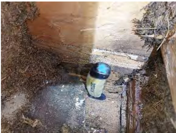
Kuva 28. Rakenneavaus AP 4: Aluslaudoituksen pinnalla on kaarnakerros. Aluslaudoitus on lahovaurioitunut.
