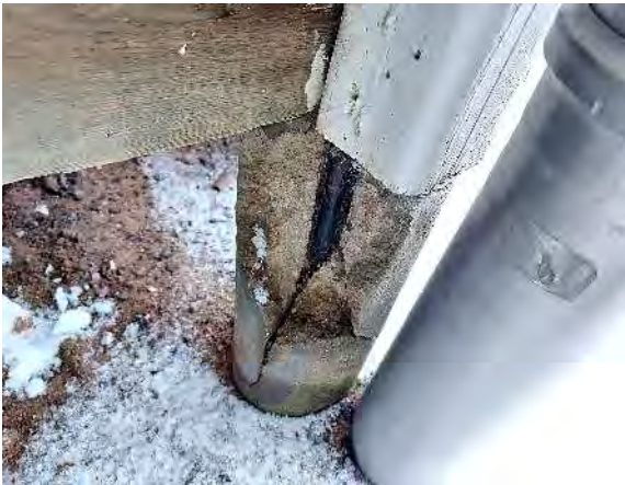
Kuva 91. Kuistin betonirakenteiset pilarit ovat heikkokuntoisia.
