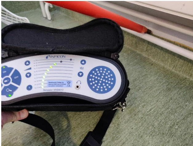
Kuva 73. Merkkiainelaitteistolla havaittiin välipohjan eristekerroksesta ilmayhteyksiä sisätiloihin.
