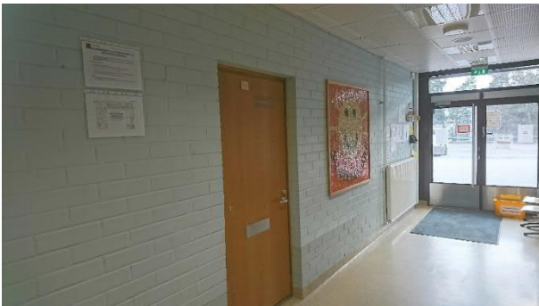
Kuva 205 Muutamassa ulko-oviin päättyvässä käytävätilassa havaittiin puutteellista ilmanvaihtoa.
