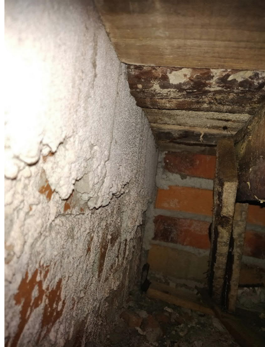
Kuva 101. Ulkoseinärakenteen sisäpuolinen rappaus ei jatku välipohjarakenteen / alapohjarakenteen alaosaan asti. Ulkoseinän eristekerroksesta on ilmayhteys sisäilmaan rappaamattoman pinnan kautta.
