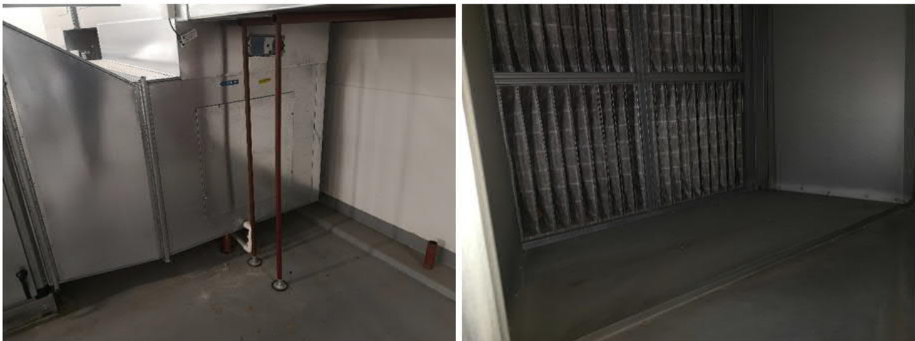
Kuva 202. TK4:n ulkoilma kammion viemäröinti ja tuloilmasuodattimet.
