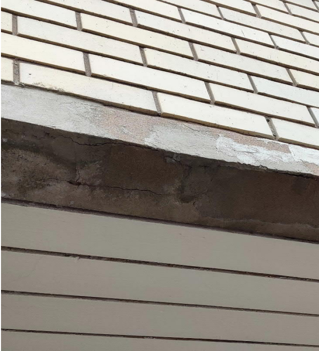
Kuva 100. Tiiliverhousta kannattelevissa leukapalkeissa on rapautumia ja palkkeihin on tehty paikkakorjauksia.
