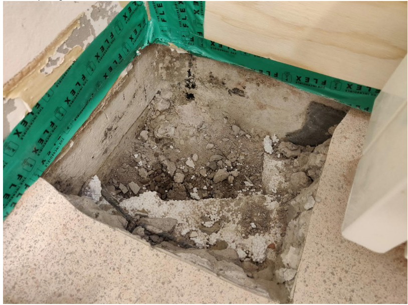
Kuva 34. Maanvastaisten seinärakenteiden muuraukset nousevat kantavan pohjalaatan päältä. Pintalaatan alapuolista tiilimuurauksen pintaa ei ole rapattu.
