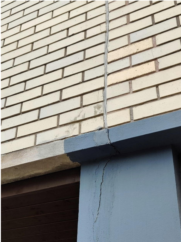
Kuva 98. Leukapalkissa on halkeama liikuntasauaman kohdalla.
