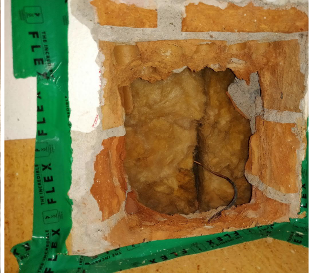
Kuva 97. Ulkoseinän lämmöneristeissä oli rakoja.
