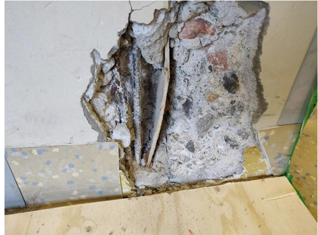
Kuva 81. Rakenneosien välisestä liikuntasaumasta aistittiin mikrobiperäistä hajua ja kovalevy oli rakennuksen alaosissa mikrobivaurioitunut.
