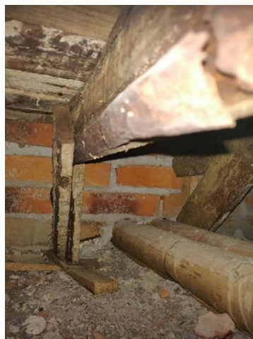
Kuva 51. Kuva rakenteen ilmatilasta. Rakenteessa muottilautoja ja vanhoja lämpölinjoja. Lämpölinjojen eristeet sisältävät asbestia.
