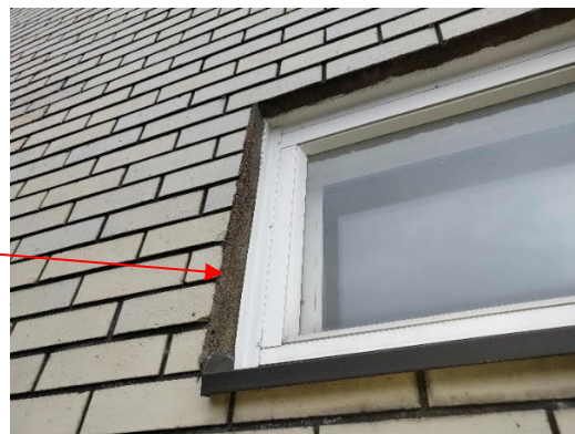
Kuva 104. Ikkunan pellitys vuotaa.
