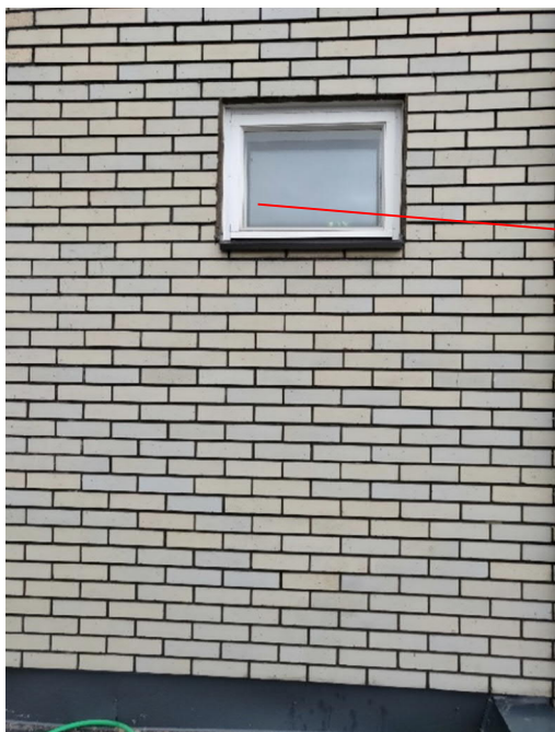
Kuva 103. Poikien wc:n yläikkunan pellitys vuotaa. Ikkunan alapuolisista seinärakenteista havaittiin kosteuden aiheuttamia vaurioita.
