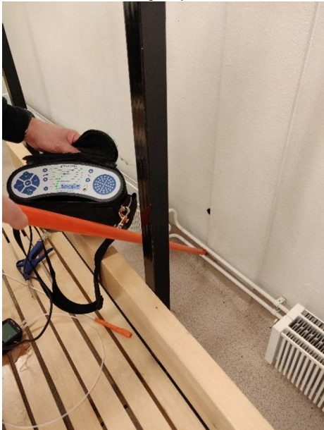
Kuva 33. Merkkiainekokeissa havaittiin ilmavuotoja maanvastaisten seinien eristekerroksesta sisäilmaan. Ilmavuotoreittejä olivat lattian ja seinärakenteen liittymäkohdat.
