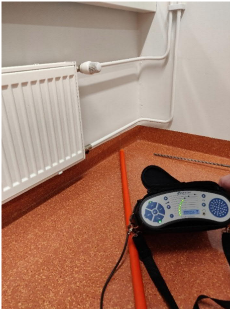
Kuva 172. Ilmavuotoja ulkoseinärakenteen eristetilsta havaittiin alapohjan ja ulkoseinän liittymäkohdasta.
