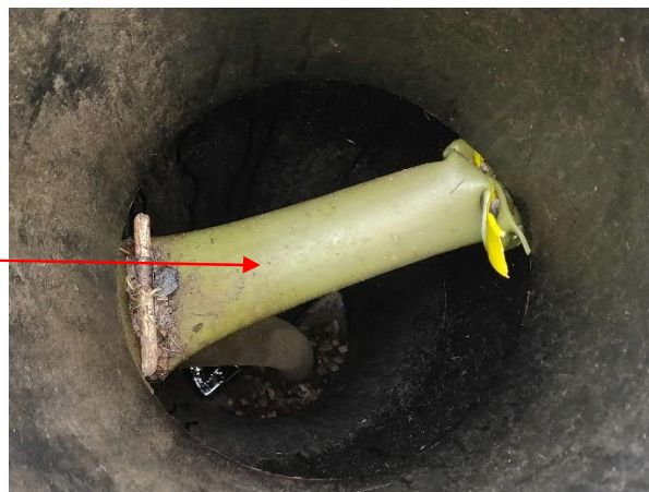
Kuva 21. Sadevesikaivon rassiputki on rikkoutunut.
