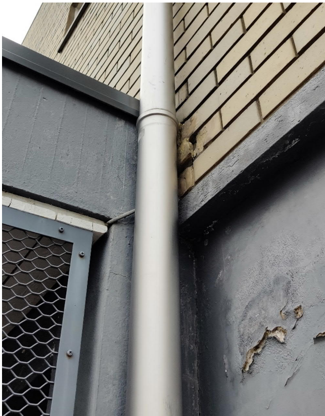
Kuva 102. Julkisivun tiiliverhouksessa ja alemman osan betonisessa julkisivussa havaittiin rakennuksen etelänurkalla kosteuden aiheuttamia vaurioita.
