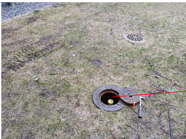
Kuva 18. Sadeveden tarkastuskaivo rakennuksen koillisen puoleisella seinustalla.
