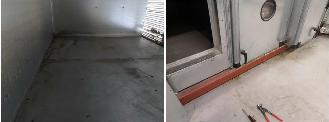
Kuva 198. TK2:n tuloilmakammio todettiin kohtuullisen puhtaaksi, ainoastaan säleikössä havaittiin pieniä määriä lehtiä. TK2:n viemärointi puutteellista, jonka takia koneeseen päätnyt vesi valuu koneen rungon lävitse.
