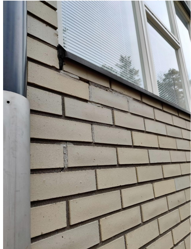
Kuva 99. Julkisivuverhouksesta havaittiin paikallisia rapautumia. Tiilisauvoja oli korjattu.
