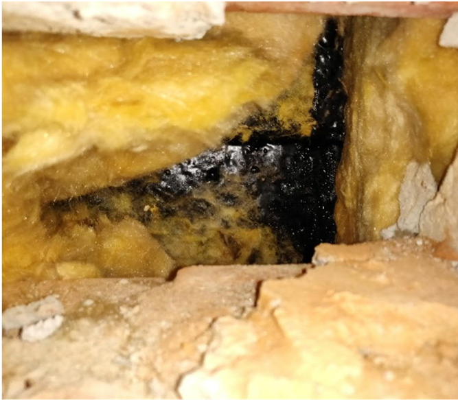
Kuva 39. Ulkoseinärakenteen sisäpuolisen pikisivelyn pinnassa havaittiin vesipisaroita.
