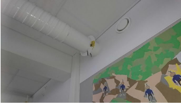
Kuva 203 Luokkatiloissa ilmanjako on toteutettu sekoitavana ilmajakoon hyvin soveltuvilla suutinkanavilla.
