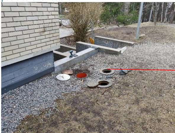
Kuva 20. Sadeveden tarkastuskaivot sekä salaojan tarkastuskaivo rakennuksen pohjoisnurkalla.
