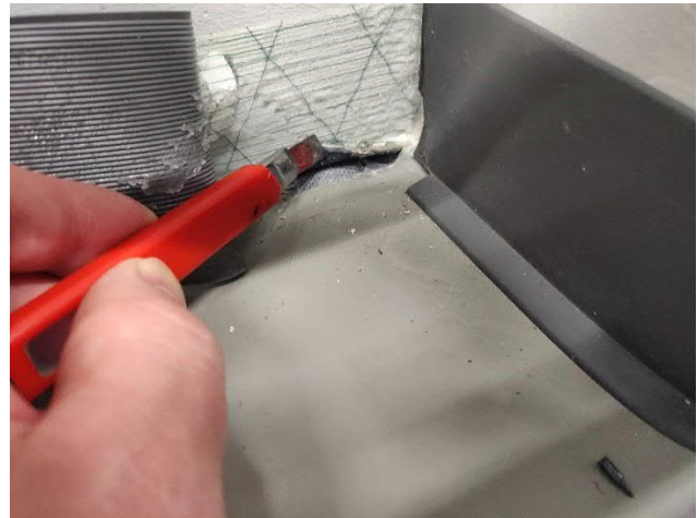
Kuva 74. Myös tiivistyskorjatuissa tiloissa havaittiin ilmayhteyksiä sisätiloihin.
