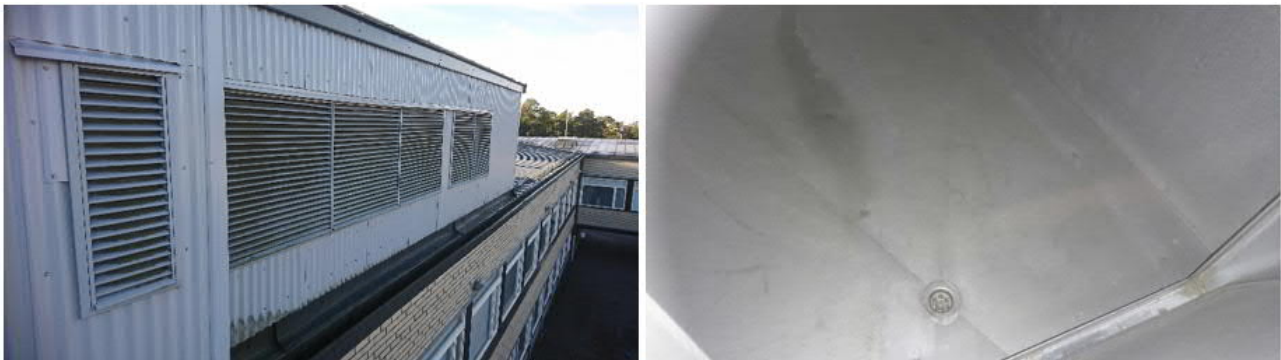
Kuva 197. C-osan IV-konehuoneen ulkoilmasäleiköt. TK1:n ulkoilmakammio oli siisti ja asianmukaisesti viemäroity.
