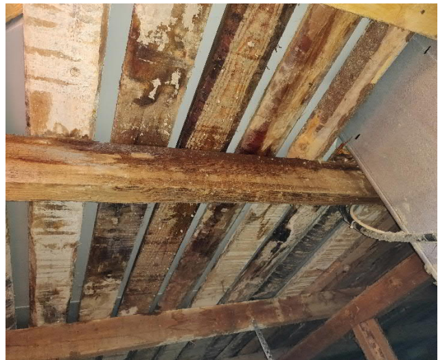
Kuva 114. Vesikatteen alla ei ole aluskatetta. Harvalaudoituksessa oli vesivuotojälkiä huoltoluukkujen ympäristössä.
