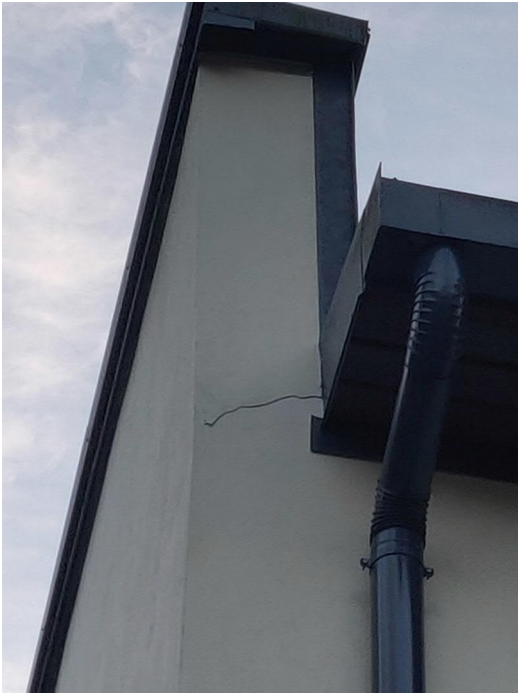
Kuva 174. Julkisivun korotetun osan saumakohtasta havaittiin halkeama. Halkeaman kautta on sadeveden mahdollista kulkeutua rakenteeseen.
