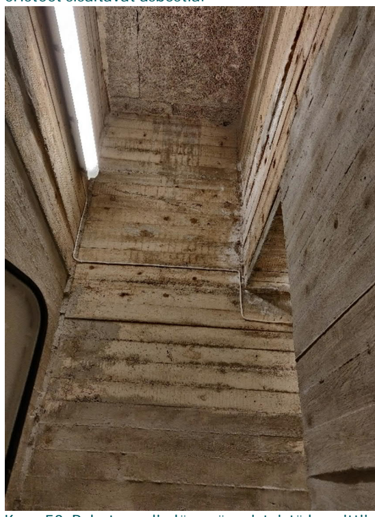
Kuva 53. Pakotunnelin lämmöneristeistä havaittiin kosteusjälkiä.
