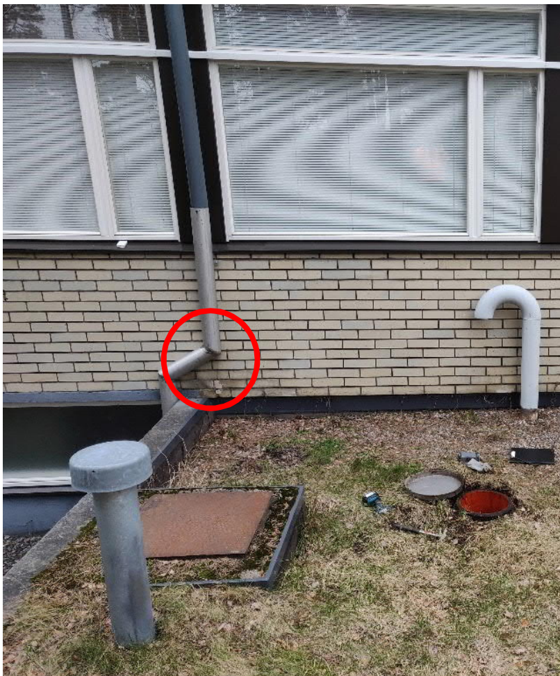
Kuva 17. Rakennuksen lounaissivustalla väestönsuojan kohdalta havaittiin vuotava rännisyöksputki.
