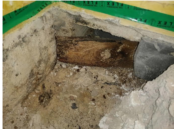
Kuva 46. Alapohjan eristetilasta havaittiin orgaanista materiaalia (mm. muottilautoja).
