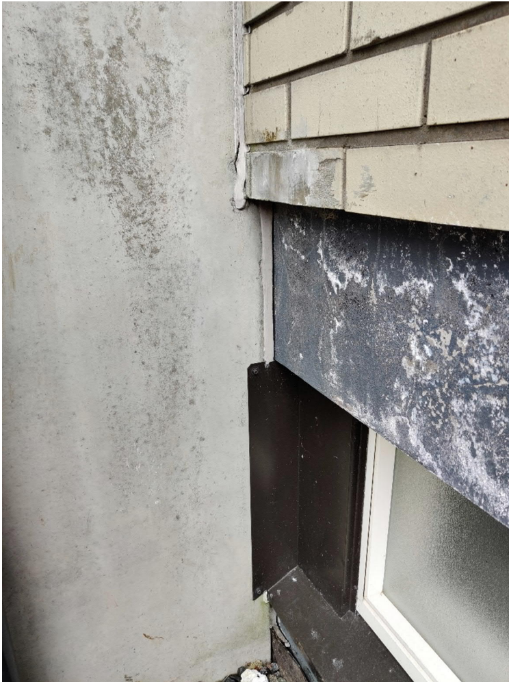
Kuva 162. Rakennusten välinen liikuntasäuma ulkopuolelta. Liikuntasäuma on auennut.
