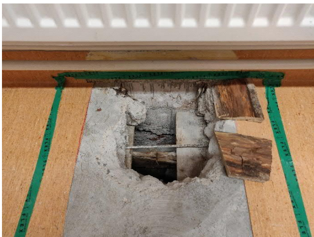
Kuva 50. Rakenneavaus VSS1.1 luokan 263 kautta. Rakenteessa on lahovaurioitunutta puutavaraa. Muovimaton alla sekä rakenteessa todettiin mikrobiperäinen haju.
