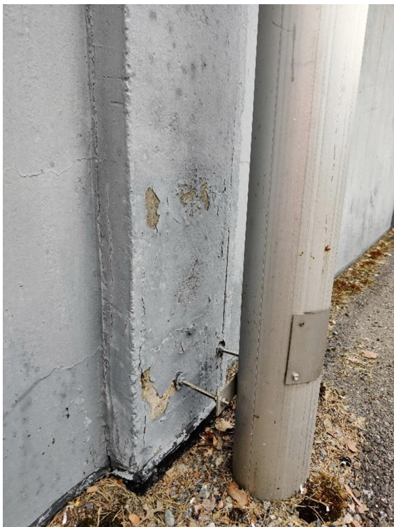
Kuva 41. Sokkelirakenteista havaittiin merkkejä betonin rapautumisesta.
