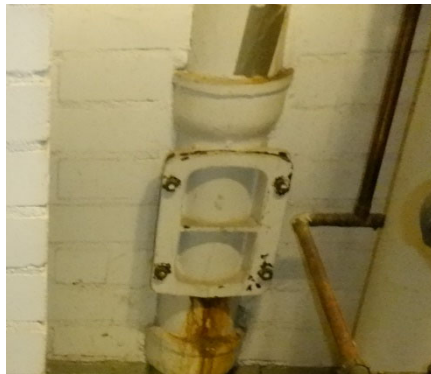
Kuva 4.1.1 Valurautaviemäreiden tiivisteissä ja muhviliitoksissa on voitu käyttää asbestinarua.
