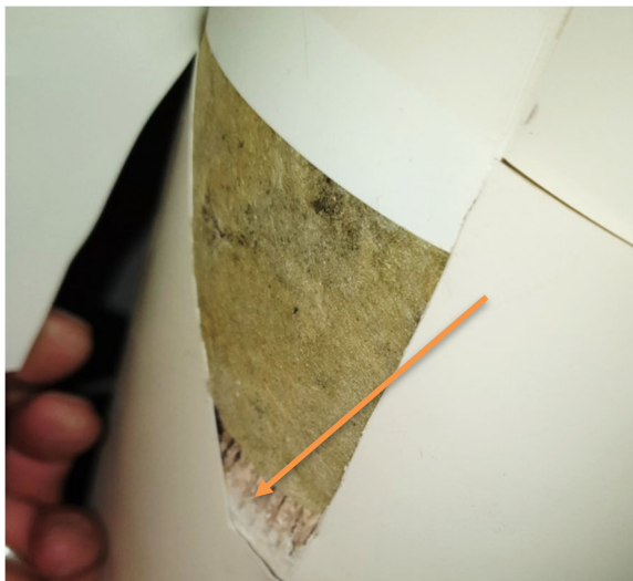
Kuvat 3.1.3 Osa asbestipitoisista putkieristeistä on poistettu. Paikoin asbestipitoisia materiaaleja todettiin myös Genopakilla päällystetyissä putkissa.
