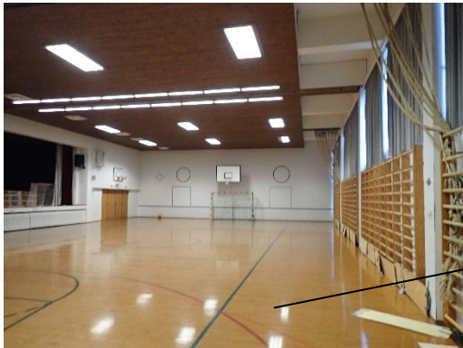
Kuva 3.2.8 2. krs. liikuntasalin lattia/välipohjarakenne, ASB 39 lattiarakenteen sisällä olevasta bitumihuovasta.
