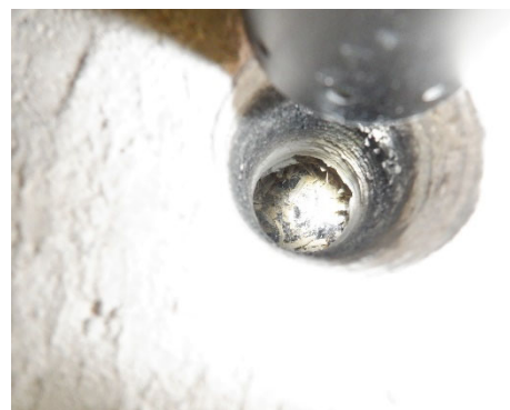
Kuva 3.2.4 1. krs. WC-tila, lattiaan pintabetonilaatan alla pikisively+bitumikermit – sementtilastuvillalevy – pikisively – pohjabetonilaatta. Näyte ASB9 pikisive-lystä ja bitumikermitistä. Pikisiveilyssä on asbestia (antofylliitti).
