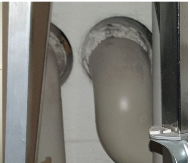
Kuvat 3.1.4 Osa asbestipitoisista putkieristeistä on poistettu. Paikoin asbestipitoisia materiaaleja todettiin myös Genopakilla päällystettyjen putkien läpiviennissä.
