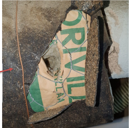
Kuvat 3.1.2 Vuorivillan päällä oleva bitumihuopa sisältää asbestia, näyte ASB 15.
