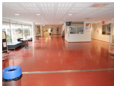
Kuva 3.2.6 1. krs. lattiaan punainen kvartsivinyylilaatta. Näyte ASB 25 kvartsivinyylilaatasta ja mustasta liimasta, aulatilasta. Mustassa liimassa on asbestia (antofylliitti).
