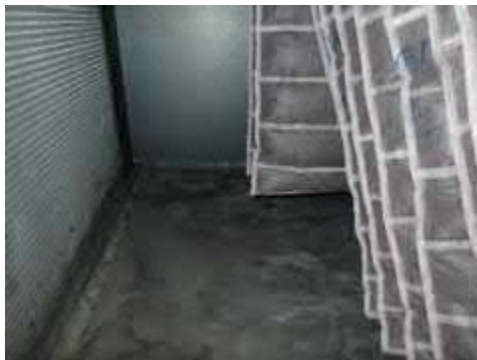
Kuva 7.1.7. Tuloilmakoneen TK3 pohjalla oli pinttynyttä likaa ja merkkejä veden pääsystä kammion pohjalle.
