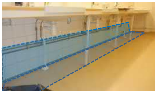
Kuva 5.3.2. Tyttöjen WC-tilassa lavuaarien alla seinän ja lattian pintakosteuspoikkeama-alue. Poikkeama-arvot 100-110, vertailuarvot 50-60.
