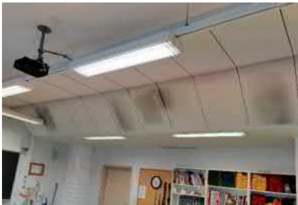
Kuva 7.2.6 Osan I luokkatilojen alakatoissa on tummia jälkiä, jotka viittaavat ilmapuotoihin luokan ja alakattotilan välillä.
