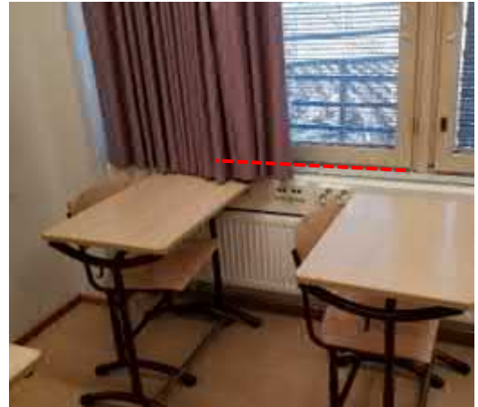
Kuva 6.2.4. Ilmavuotoa luokassa 304 ikkunaliittymistä.
