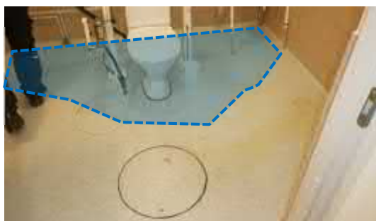
Kuva 5.3.6. Kosteuspoikkeama-alue inva-WC:n lattian märkätilamuovimatossa. Poikkeama-arvot 100-110, vertailuarvot 50-60.
