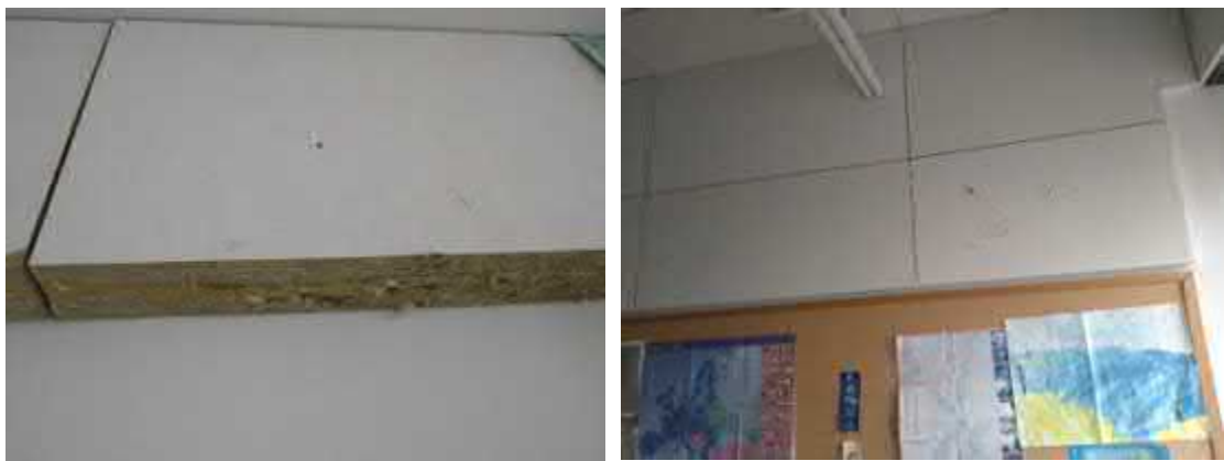
Kuva 7.5.1. Osassa tiloja on vanhoja, reunoiltaan avoimia ja/tai rikkoutuneita akustiikkalevyjä, joista voi irrota kuituja.
