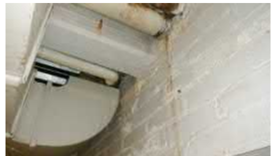
Kuva 5.1.5. Kosteusvauriojäljet rajautuvat perusmuurissa sijaitsevien putkiläpivientien alueelle.
