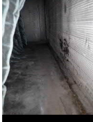
Kuva 7.1.5. Tuloilmakoneessa TK2 oli jonkin verran likaa.
