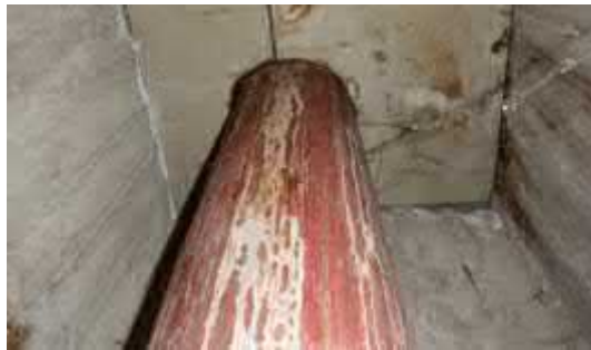
Kuva 5.1.6. Pohjakuvaan merkitsemättömässä tilassa tuuletusputki pihakannelle. Läpiviennissä vuotojälkiä.
