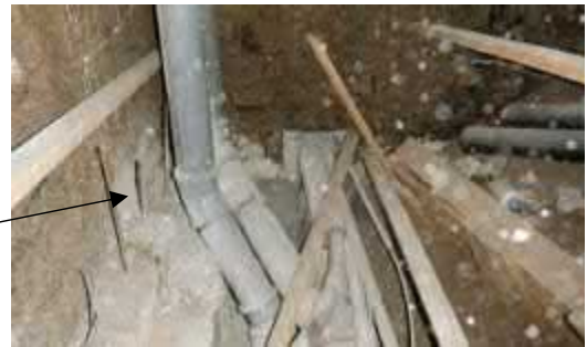
Kuva 6.6.3. Hiekkapohjaisessa onkalotilassa rakennusjätteitä ja muottilaidoituksia.
