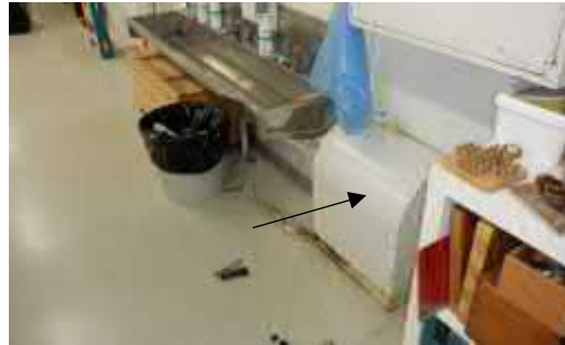
Kuva 6.6.6. Teknisen työn luokkatilassa sijaitseva putkikanaaliläpivienti pellityksen alla.
