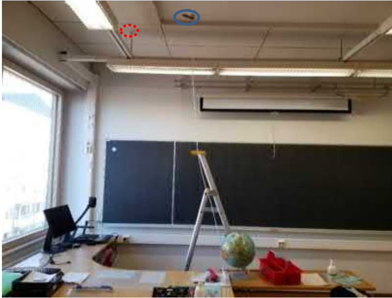
Kuva 6.3.4. Yläpohjan merkkiainekoe tilassa 311. Mittauksessa todettiin ainoastaan yksi pistemäinen ilmapuoto valaisimen kiinnikkeen läpiviennistä (punainen ympyrä). Merkkiaineen laskupaikka on merkattu sinisellä ympyrällä.
