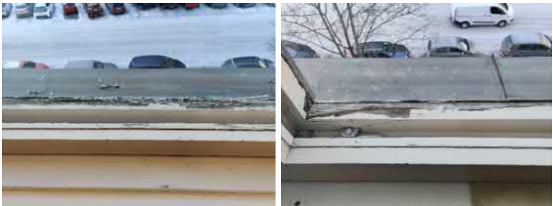
Kuva 6.2.8. Ikkunoissa on paikoin kosteusvaurioita.
