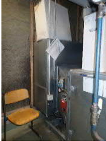
Kuva 7.1.4. Konehuoneen 301 seinillä on kanaverkon takana paljasta mineraalivillaa.
