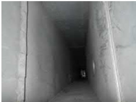
Kuva 7.1.14. Tuloilmarunkokanavistossa oli myös pölyä.
