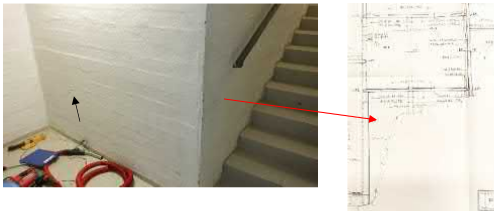
Kuva 6.6.1. Ylemmän kellarikerroksen hissiaulassa olevan portaan alustilassa on muottilaudoitusta.
