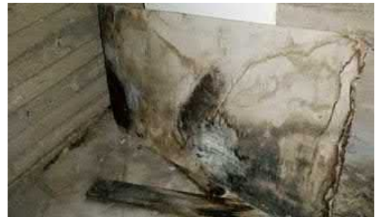
Kuva 5.1.7. Pohjakuvaan merkitsemättömässä tilassa oli kosteusvaurioitunutta puutavaraa.
