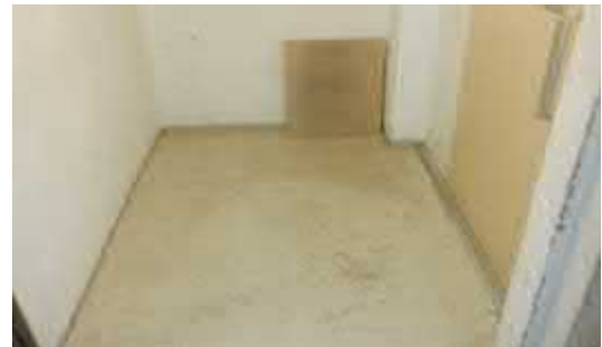
Kuva 5.2.3. Kellarin lattian ja seinien maalipinnoitteet paikoin kuluneita.
