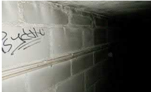
Kuva 6.6.12. Ilmavuotojälkiä sisäverhoukseen muurauksen takan olevasta eristetilasta.
