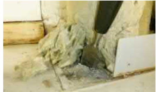
Kuva 6.6.7. Putkiläpivienti kanaaliin on epätiivis.
