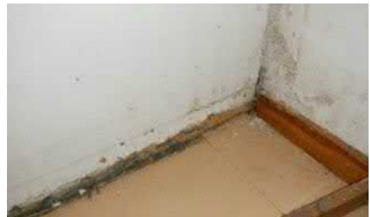
Kuva 6.1.26. Maanpaineseinän sisäpintaan asennetussa lastulevytyksessä oli vanhoja kosteusvauriojälkiä, pyöröportaan porrastila.
