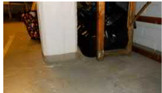
Kuva 5.1.3. Alemman kellarikerroksen lattiamaalit olivat kuluneita. Rakennepinnoilla ei yleisesti ottaen ollut liiallisen kosteuden aiheuttamia pinnoitevauriota.
