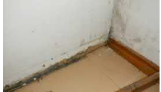
Kuva 5.3.9. Porrashuoneessa maanpaine-seinän eteen on koolattu lastulevyseinä, vanhoja kosteusvauriojälkiä seinän alaosassa (ei pintakosteuspikkeamaa).
