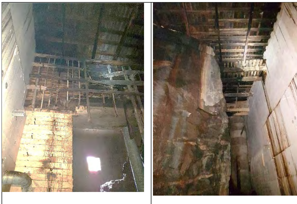
Kuva 5.20. Sulkutilassa on lahonneita muottilaudoituksia.
