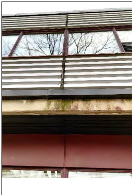
Kuva 5.8. Luokkasiiven pitkällä julkisivulla on kosteusrasituksen jälkiä.
