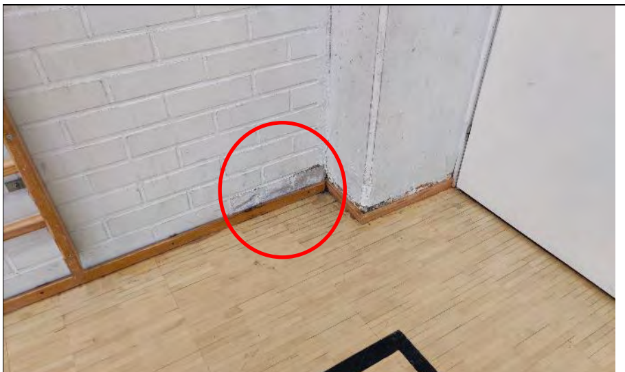
Kuva 5.29. Liikuntasalin lounaiskulmassa on kosteusvauriojälki. Jäljen kohdalta otettiin mineraalivillaeristeestä materiaalinäyte M3 , jossa esiintyi aktiivista mikrobikasvua.
