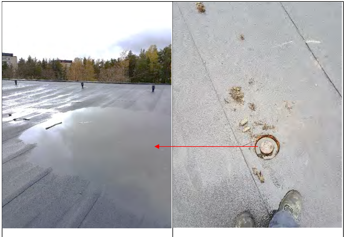
Kuva 5.61. Yksi sadevesikaivoista oli kuitenkin tukkeutunut. Tukos avattiin tutkimusten yhteydessä.
