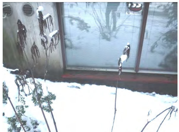
Maanpinta on lähellä ikkunan alareunaa
