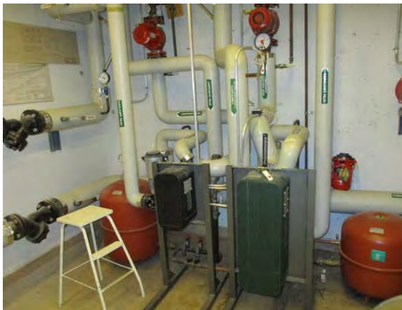
Lämmönjakokeskuksen v. 1995 osa
