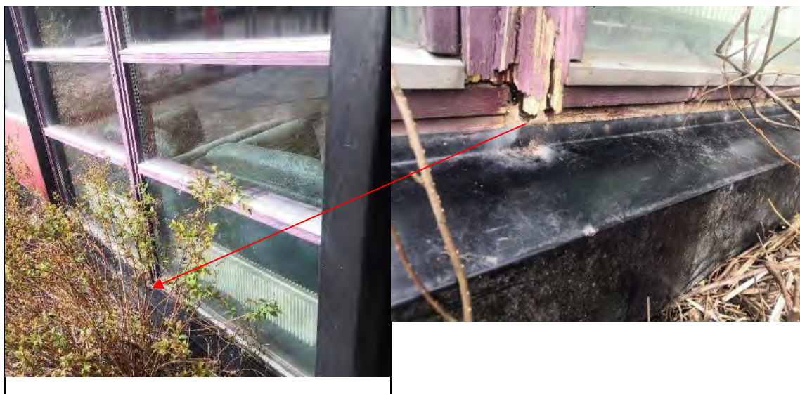
Kuva 5.43. Itäsivulla maanpinnan lähellä olevissa ikkunakarmeissa on lahovaurioita.
