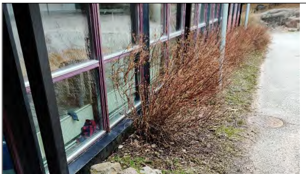
Kuva 5.10. Ulkoseinän vierustalla on runsaasti kasvillisuutta (kuva luokkasiiven itäisivulta).
