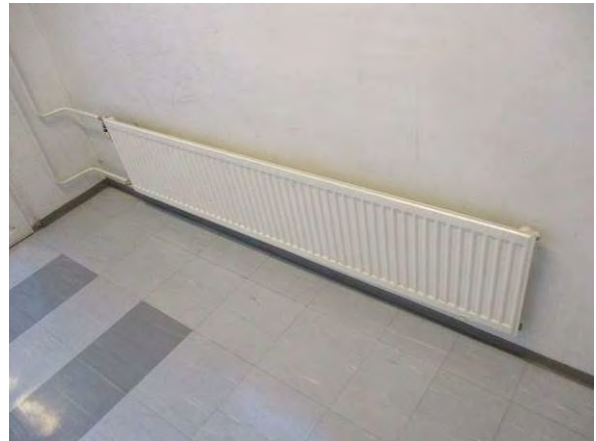
Patterit ovat hyväkuntoisia
