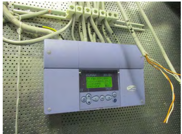
Ilmanvaihtokoneiden paikallissäätimet on ilmeisesti liitetty DDC-rakennusautomaation piiriin
