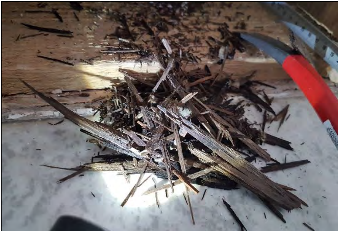
Kuva 5.32. Rakennevausten yhteydessä ulkoseinän puuosissa havaittiin paikon lahovaurioita (kuva tilasta 106, R42). Myös tilassa 112 (R31) todettiin lahovaurioita.
