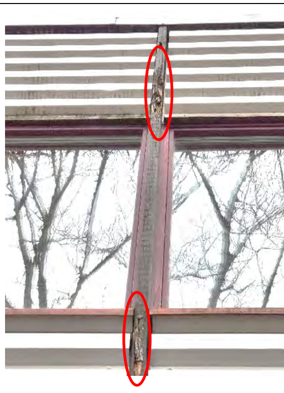
Kuva 5.9. Julkisivuelementtien välissä olevat puuosat ovat paikoin lahonneet.
