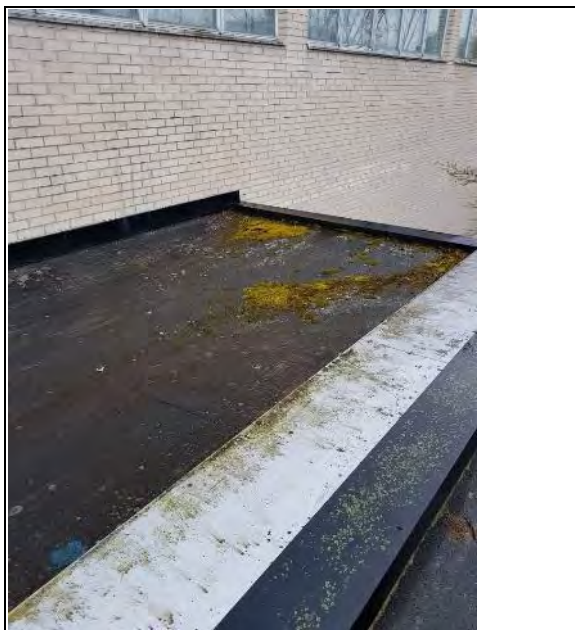
Kuva 5.59. Nivelosan vesikatolle on kertynyt sammalta
