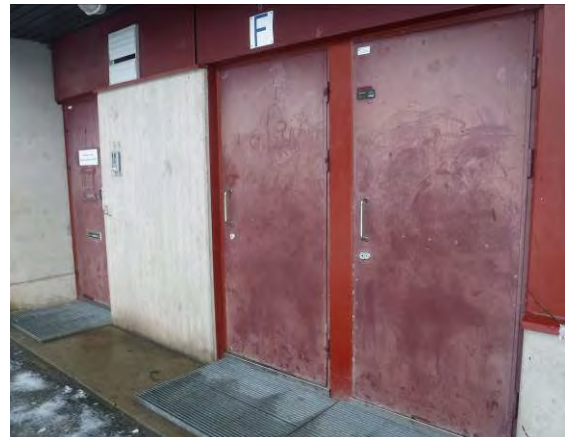
Teräksistä umpiovea; maalipinta välttävä
