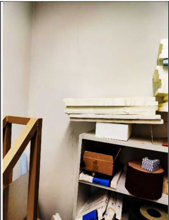
Kuva 5.37. Halkeama luokkasiiven kellarikerroksen maanvastaisessa ulkoseinässä (varasto 045).
