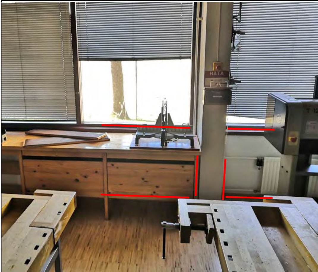
Kuva 5.42. Merkittävää ilmavuotoa ikkunaliittymistä, lattianrajasta sekä pilarin liittymistä (tila 027).
