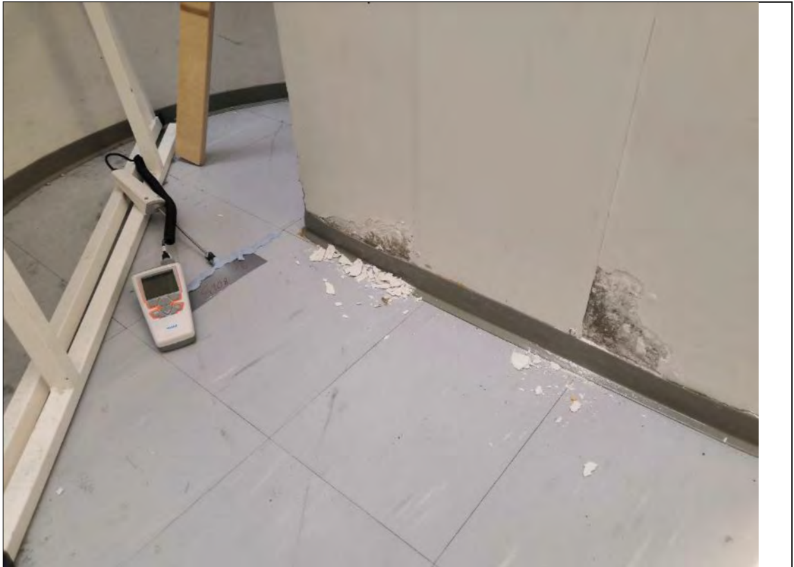
Kuva 5.12. Pyöreässä porrashuoneessa (001) on paikallinen kosteusvaurio, joka on syntynyt seinäkotelon sisällä olevan sadevesiviemärin vuodosta.
