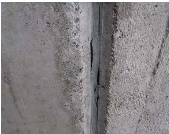
Liikuntahallin sokkelin elastisissa saumauksissa on halkeamia
