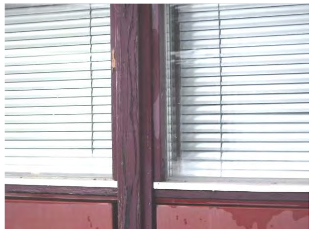
Ikkunoiden ulkopuolisissa karmirakenteissa ja listoituksissa on säärasituksesta johtuvaa puun halkeilua ja maalipinnan hilseilyä. Ikkunoiden liittymät eivät ole kaikilta osin tiiviit
