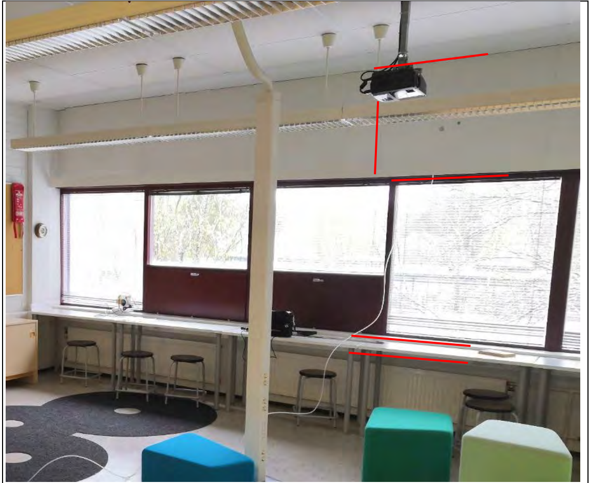
Kuva 5.41. Merkittävää ilmavuotoa ikkunaliittymistä, sähkökourun takaa, ulkoseinän ja yläpohjan liittymästä sekä lujalevyn saumoista/halkeamista (tila 112).
