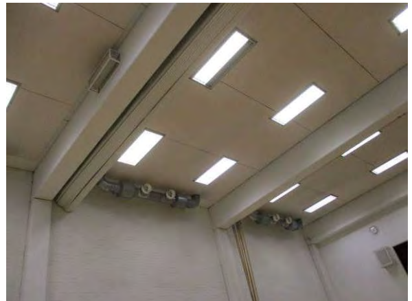
Ilmanvaihtolaitteita liikuntasalin katon rajassa
