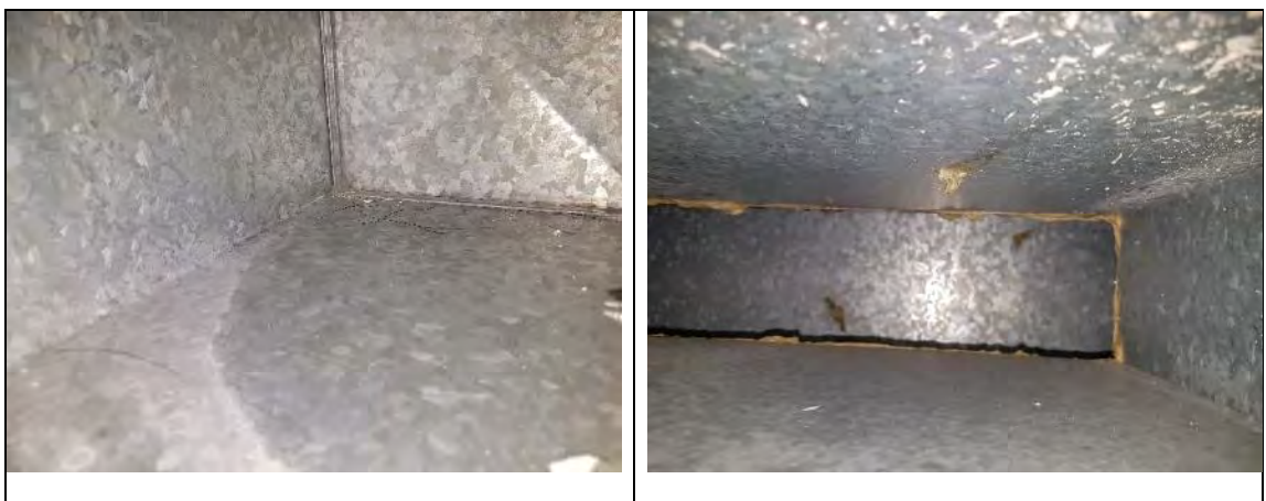
Kuva 5.78. Tuloilmakanavan pohjalla todettiin sekä irtolikaa että pinttynyttä likaa.
