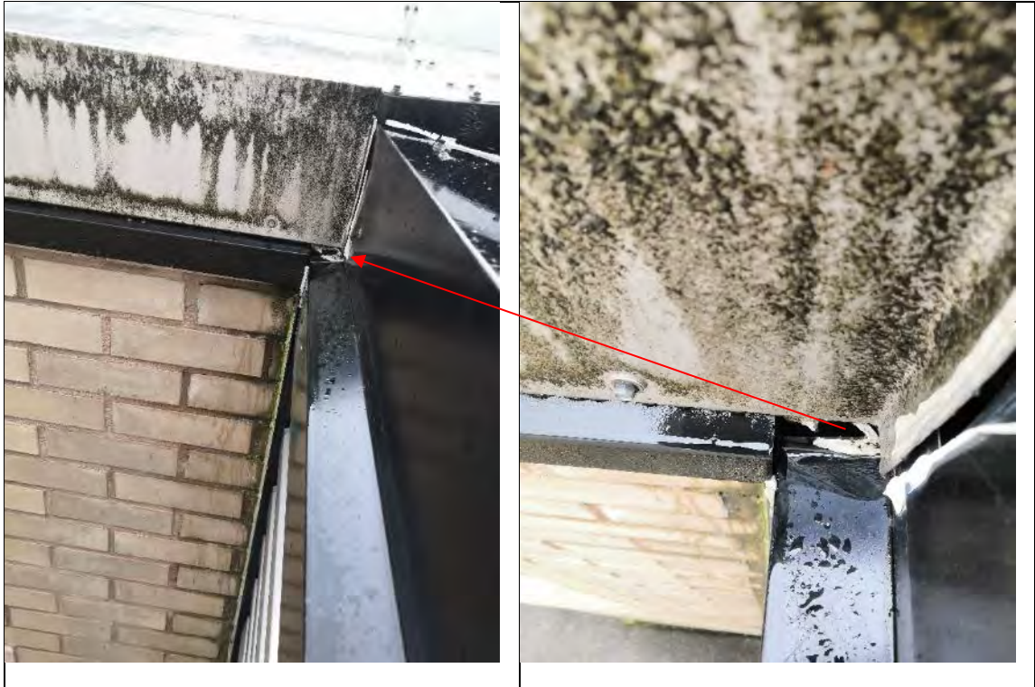
Kuva 5.58. Luokkasiiven päädyissä räystäältä tuleva vesi kerääntyy räystäspellityksen liittyisiin, josta se valuu seinäpintaa pitkin.
