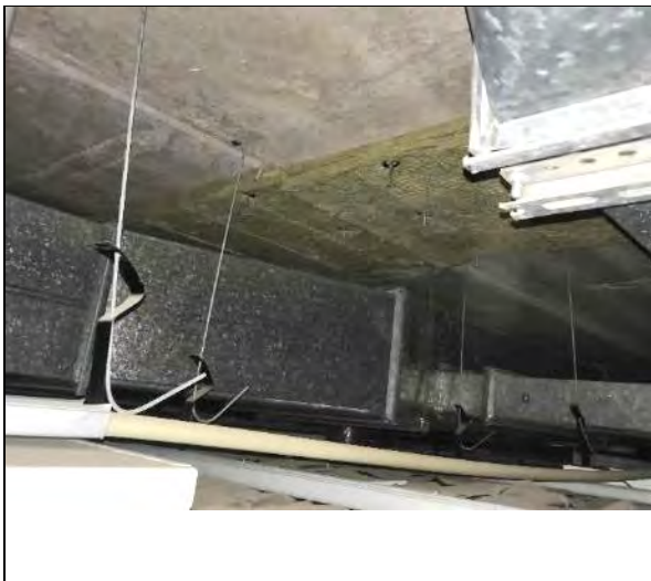
Kuva 5.74. Alakaton päällä on paikoin paljaita mineraalivillaeristeitä
