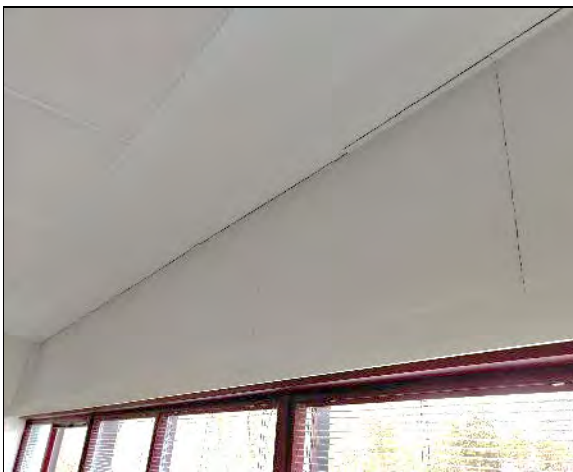
Kuva 5.38. Halkeamia luokkasiiven ensimmäisen kerroksen levyrakenteisessa ulkoseinässä (luokka 111).
