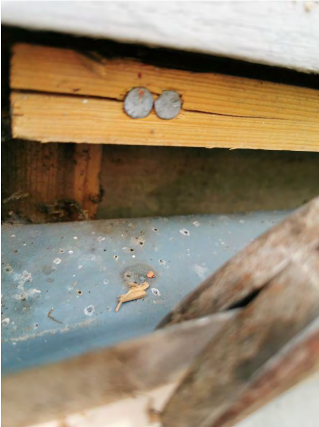
Kuva julkisivun asbestipitoisesta lujalevystä.
