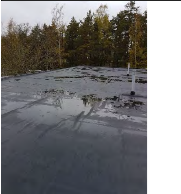
Kuva 5.55. Luokkasiiven vesikatolle lammikoituu vettä.
