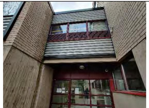
Kuva 5.7. Nivelosan vieressä olevassa luokkasiiven tiilijulkisivussa (vasen reuna) on kosteusrasituksen jälkiä. Oikealla olevassa liikuntasalirakennuksessa jälkiä ei ole.
