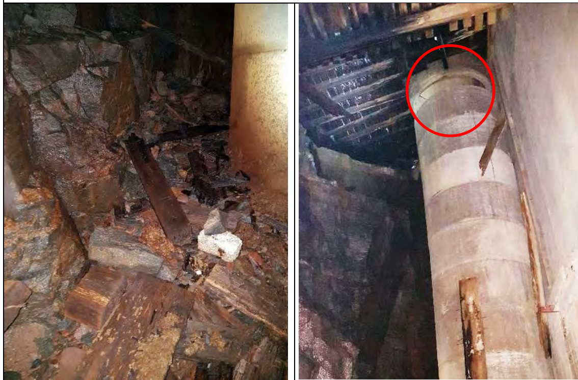
Kuva 5.21. Sulkutilan pohjalla on paikon sadevettä. Sadevesikaivo on yläosasta poikki.
