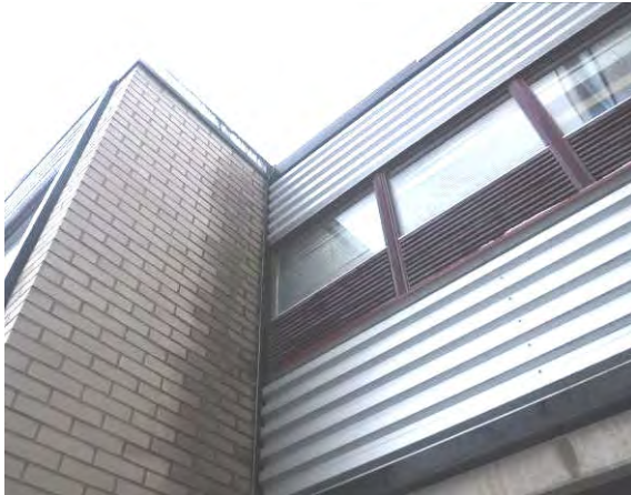
Suojapellitykseltä valuva sadevesi kastelee kalkkihiiekkakivimuurausta ja sisänurkkaa
