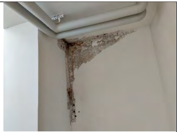
Kuva 5.4. Korjauskohdan sisäpuolella on näkyvä kosteusvauriojälki, joka tutkimushetkellä oli pinta-kosteudenosoittimen mukaan kuiva.
