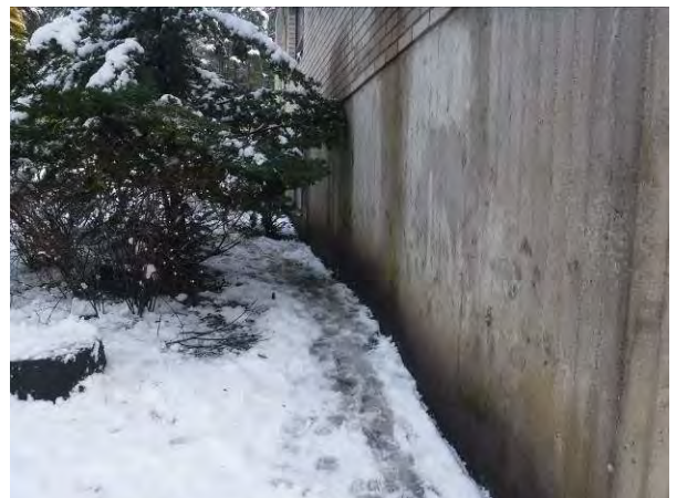
Sokkeliin kohdistuu paikallisesti ylimääräinen kosteuskuorma johtuen ulkopuolen pintavesien pääsystä sokkelin viereen
