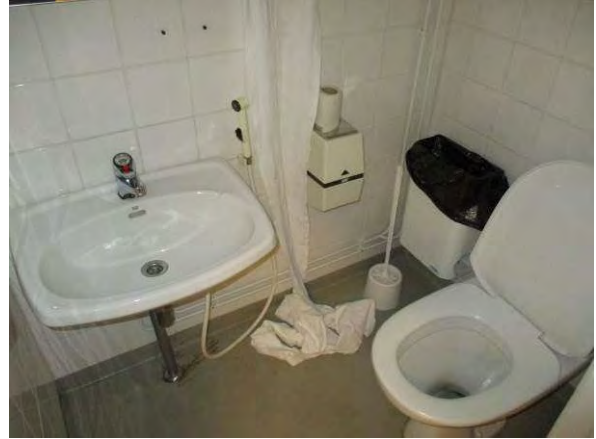
Vesi- ja viemärikalustusta
