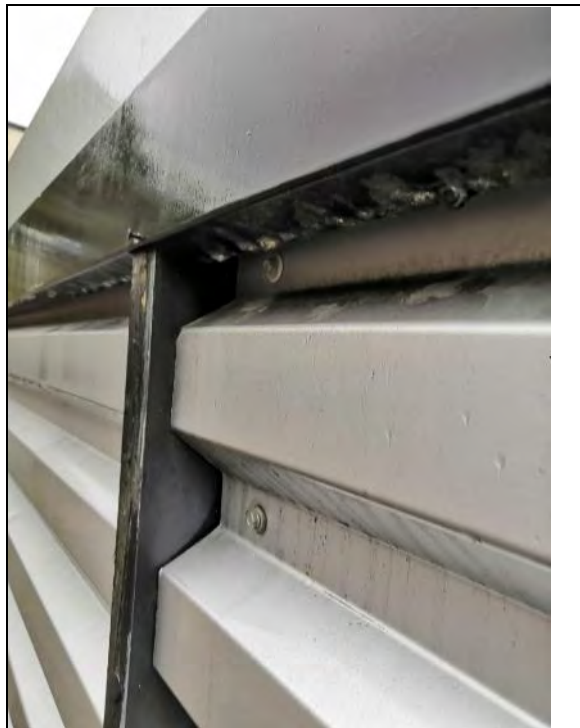
Kuva 5.57. Luokkasiiven pitkällä sivulla sadevedet ohjautuvat räystäältä julkisivuja päin. Vettä pääsee myös julkisivun peltiprofiiliin ja pystypuun väliin.
