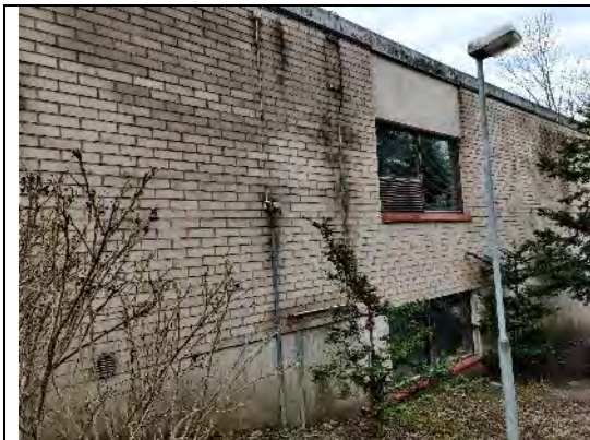
Kuva 5.6. Pohjoissivun tiilijulkisivussa on kosteusrasituksen jälkiä.
