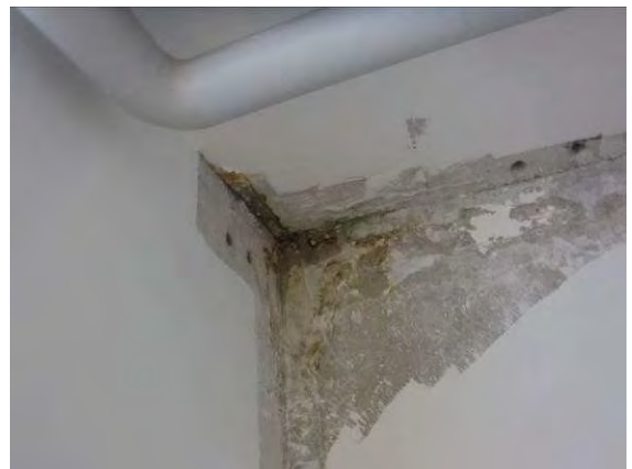
Kosteusvaurio pohjakerroksen ulkoseinässä
