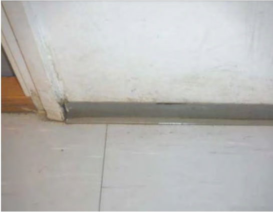
Seinien alaosissa on normaalista käytöstä johtuvia kulumajälkiä
