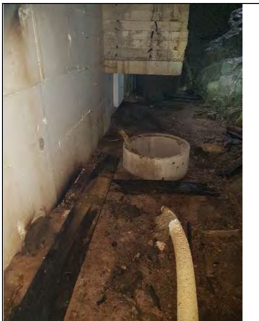
Kuva 5.80. Salaojat kulkevat maanpinnan yläpuolella. Maa on märkää salaojien ympärillä, mutta salaojissa ei virtaa vesi.
