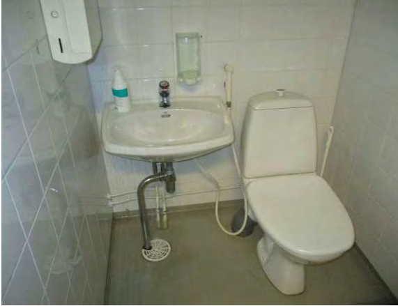
Vesi- ja viemärikalustusta
