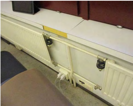
Patteriventtiilin ovat pääosin alkuperäisasennuksia
