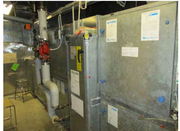
Liikuntasalin ja pukutilojen ilmanvaihtokone
