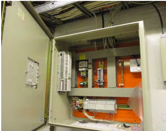
VAK-kaappi lämmönjakuhuoneen seinällä
