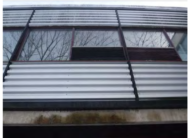
Betonirakenteeseen kohdistuu ylimääräinen kosteusrasitus ylhäältä valuvista sadevesistä
