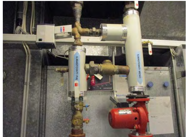
Toimilaitteet ovat osin alkuperäisasennuksia
