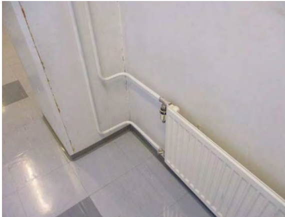
Lämpöjohdot ovat perinteisiä teräsputkiasennuksia
