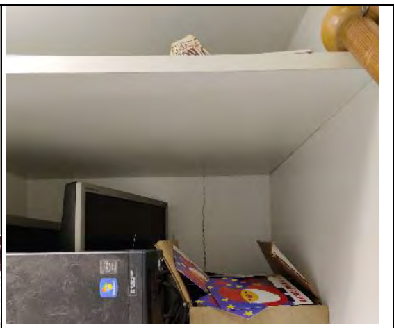
Kuva 5.39. Halkeama luokkasiiven ensimmäisen kerroksen maanvastaisessa ulkoseinässä (varasto 123).
