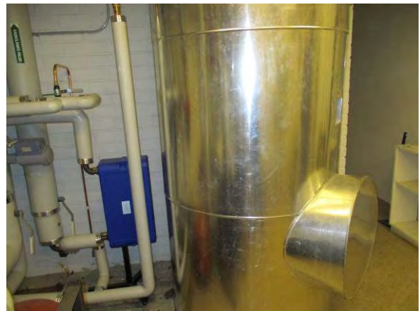
Käyttövesisiirrin on uusi ja lämminkäyttövesivaraaja alkuperäinen
