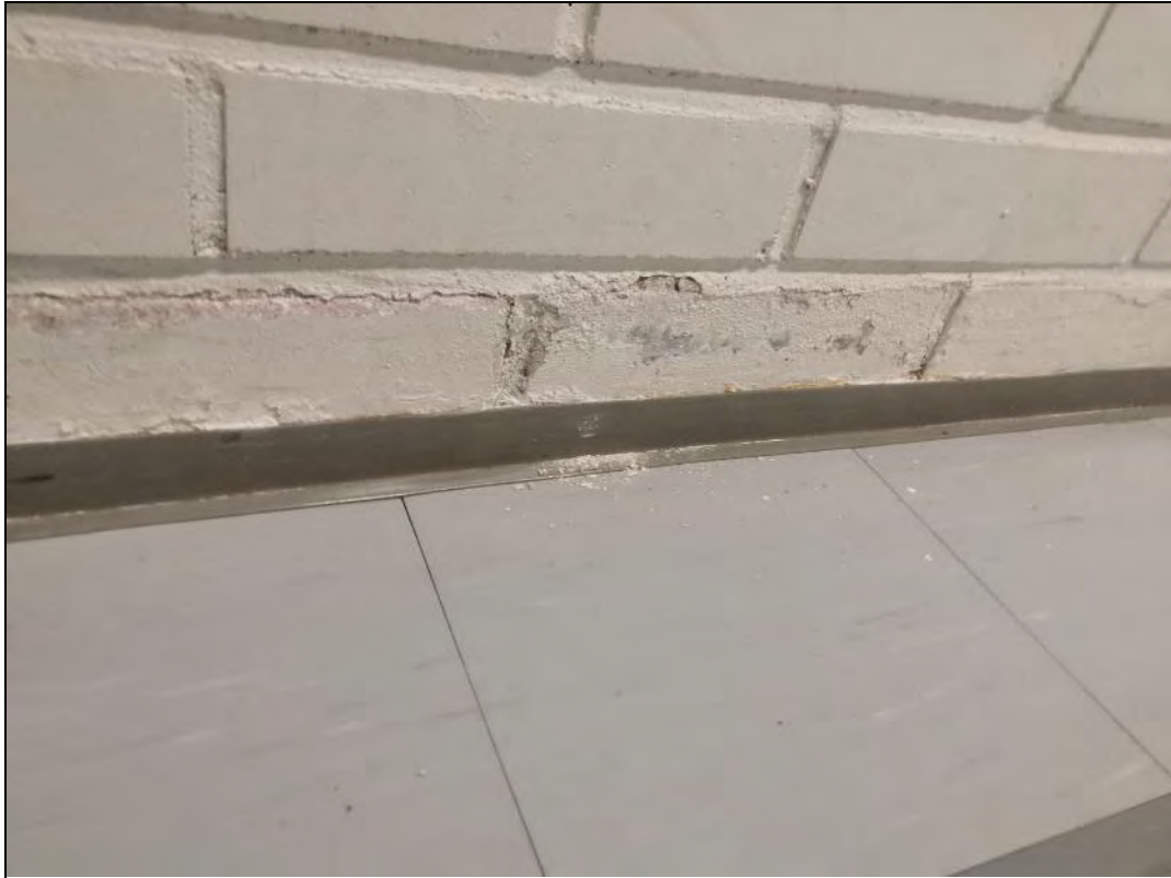
Kuva 5.13. Käytävällä 037 wc-tilan 042 kohdalla todettiin kohonnutta kosteutta seinän alaosassa sekä lattiapäällysteessä.
