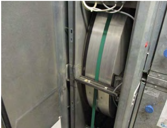
Ilmanvaihtokoneissa on pyörivät LTO-roottorit
