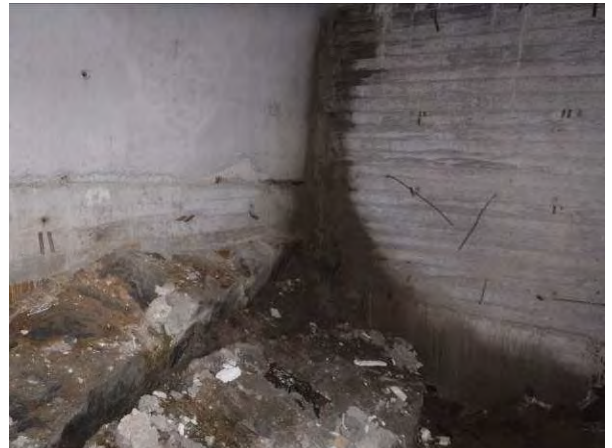
Rakentamattomaan tilaan tulee vettä ulkonurkan kohdalta
