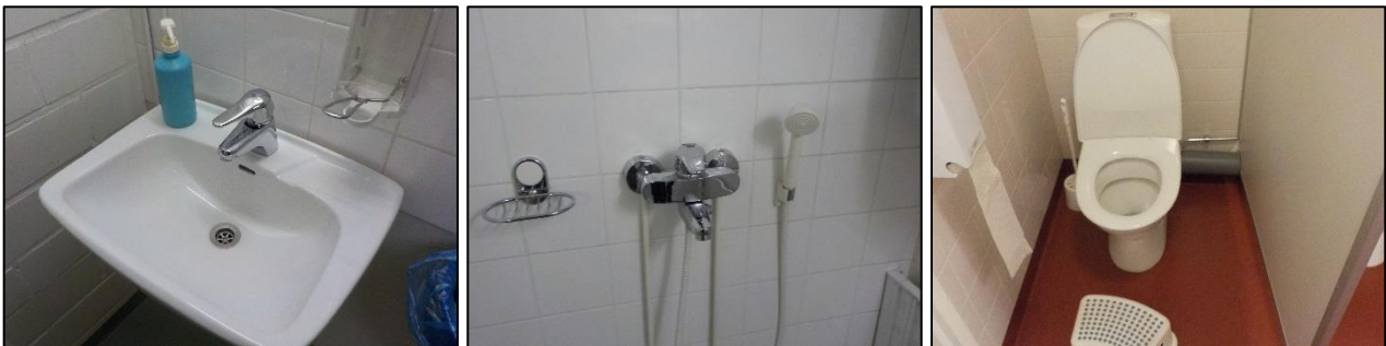
Kuva 3.20. Vesikalusteiden yleiskunto on kuntoarvion havaintojen mukaan hyvä, eikä niiden laajamittaiseen uudistamiseen todennäköisesti ole aihetta lähitulevaisuudessa.
