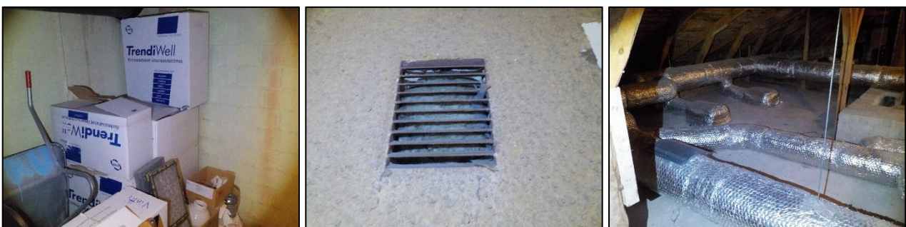
Kuva 3.12. Käyttämättömiä ilmanvaihdon suodattimia säilytetään kellarissa, mitä voidaan pitää sisäilmariskinä. Vanhoja ilmanvaihtokanavia on suljettu mineraalivillalla. Yläpohjan palopermantoon on tehty lukuisia läpivientejä ilmanvaihtokanavia varten.
