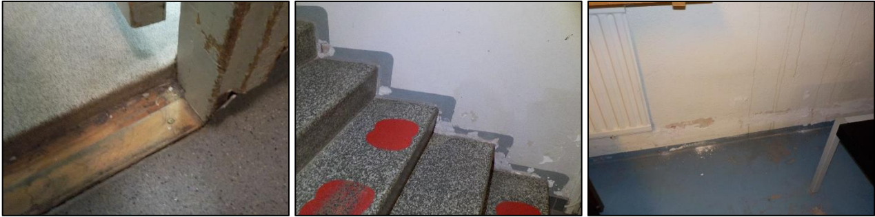
Kuva 3.7. Sisätilojen pinnoissa on erilaisia kulumajälkiä ja pinnoitevaurioita, joista voi vapautua ärsytysoireita aiheuttavaa pölyä sisäilmaan. Kuntoarvion yhteydessä ei havaittu selkeitä välipohja- ja väliseinärakenteisiin liittyviä vaurioita, mutta välipohjaan liittyvien riskien ja käyttäjien oireilun johdosta välipohjan kuntoarviota tarkempi tutkiminen katsotaan aiheelliseksi.
