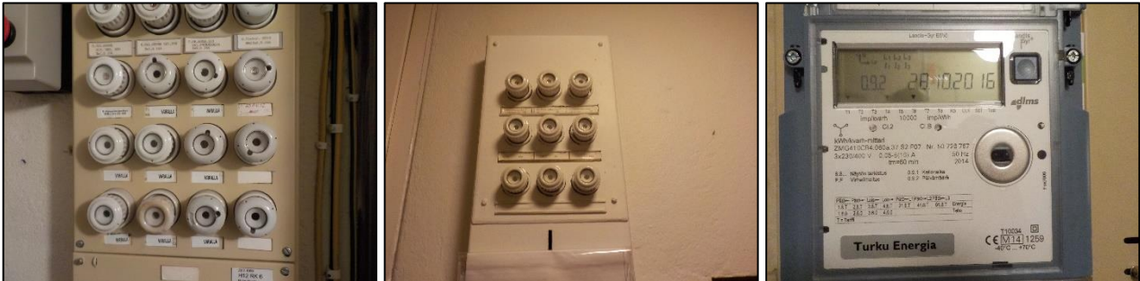
Kuva 3.15. Sähkökeskukset ovat vanhoja/alkuperäiskuntoisia ja niiden käyttöiän odote on siten tullut täyteen ja niiden uusiminen lähitulevaisuudessa katsotaan aiheelliseksi.
