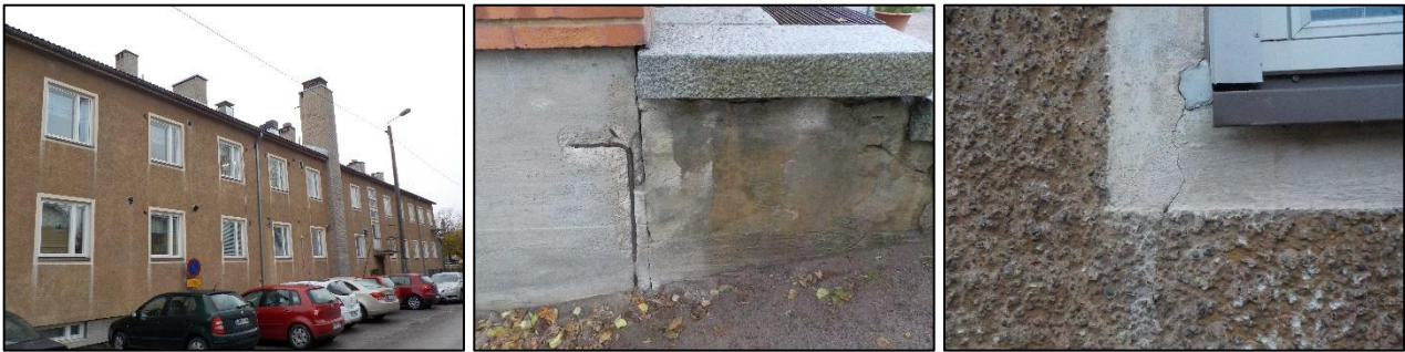
Kuva 3.4. Rapattujen julkisivujen yleiskunto on hyvä, mutta ikkunoiden läheisyydessä esiintyy jonkin verran halkeilua. Betonirakenteissa sokkelit mukaan lukien esiintyy selkeitä betonirakenteiden vaurioita.
