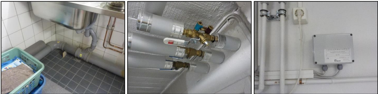
Kuva 3.17. Viemäreitä ja putkistoa on uusittu ainakin jossain laajuudessa, mutta uusimisen ajankohta ja sisältö eivät olleet kuntoarvion yhteydessä tiedossa.
