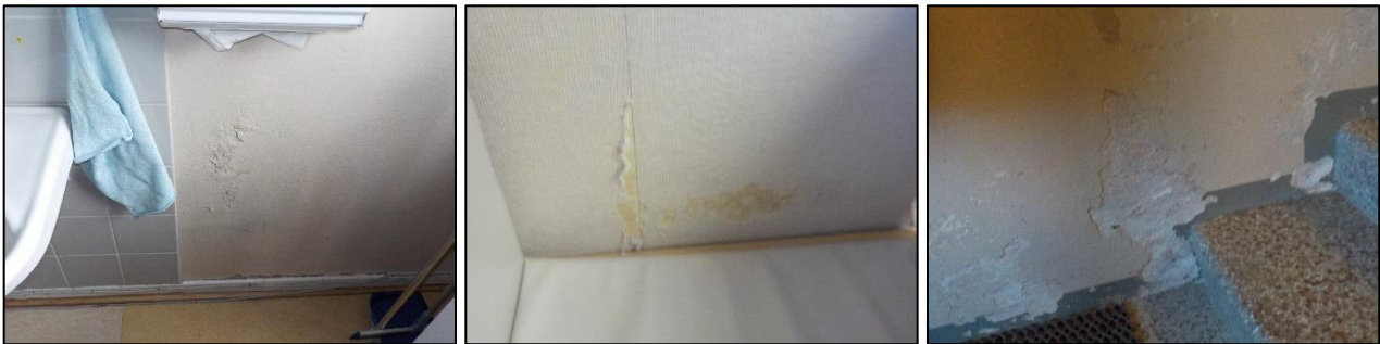
Kuva 3.8. Pintamateriaaleissa esiintyviä erilaisia vaurioita.
