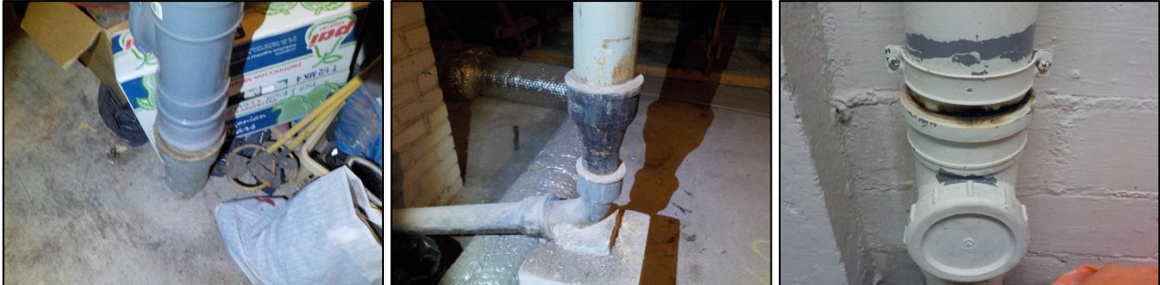
Kuva 3.19. Alkuperäisiä valurautaviemäreitä on ainakin jossain laajuudessa korvattu muoviputkin, mutta uusimisen laajuudessa ei ollut käytettävissä tietoa.
