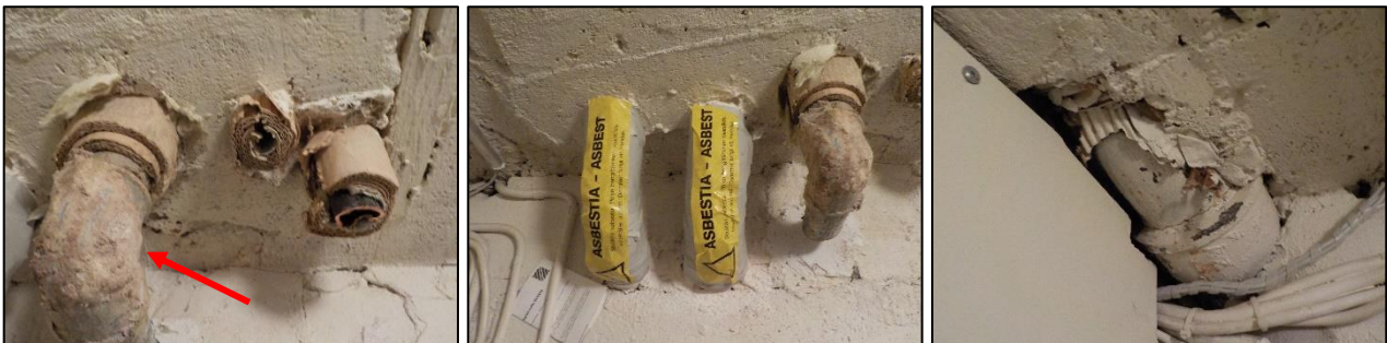
Kuva 3.18. Vanhoja viemäreitä ja putkistoa on havaittavissa kellaritilojen kautta. Putkieristeitä on osittain poistettu ja osittain koteloitu ja merkitty varoitusarvoilla eristeiden asbestipitoisuudesta
