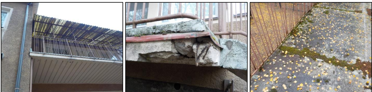
Kuva 3.5. Parvekkeiden yleiskunto on heikko ja niiden betonirakenteissa on havaittavissa pitkälle edenneitä vaurioita. Parvekkeiden käyttöä suositellaan vältettävän.
