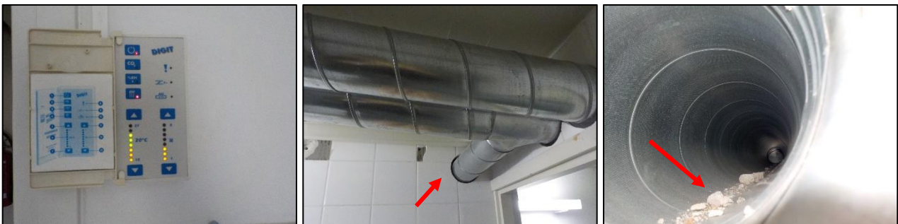
Kuva 3.11. Rakennuksen koneellinen ilmanvaihto perustuu useampaan pieneen ilmanvaihtokoneeseen, joiden ohjauspaneelit sijaitsevat koneiden läheisyydessä. Ilmanvaihtokanavia varten tehtyjä läpivientejä ei ole tiivistetty ja ilmanvaihtokanavien pistokoetarkastuksissa erityisesti poistokanavat havaittiin huomattavan likaisiksi.
