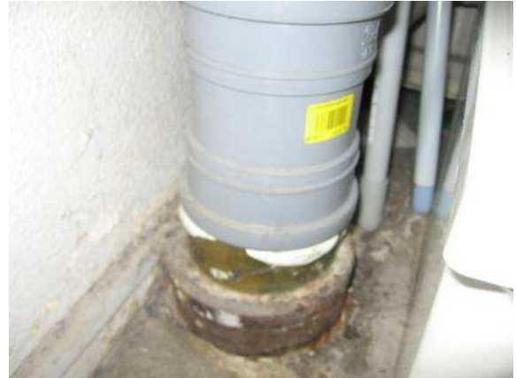
ErillISRakennuksessa muovisen pystyviemäriin liitos valurautaviemäriin
