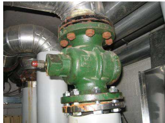
Vanha tulppaventtiili kauppahallin lämmönjakohuoneessa
