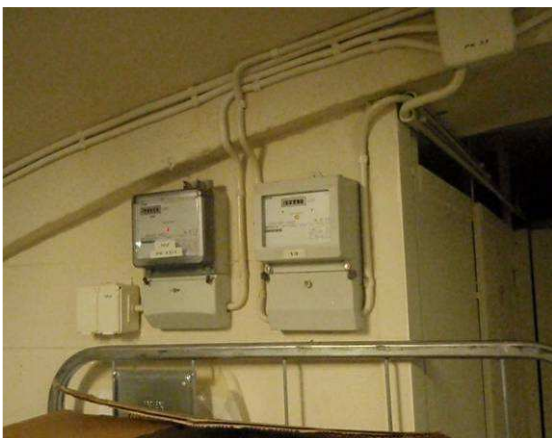
Energiamittareita kellarikäytävän seinällä.
