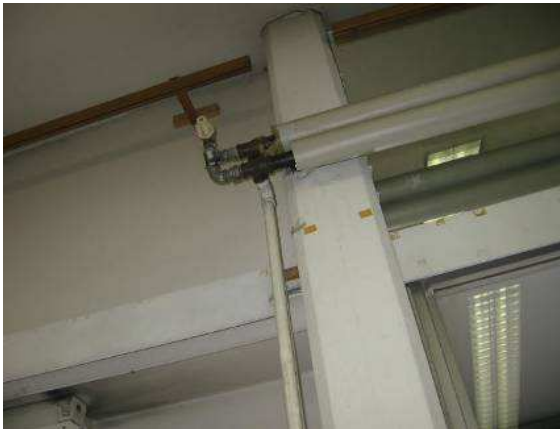
Erillsrakennuksen yhden lämmityspatterin patteriventtiili
