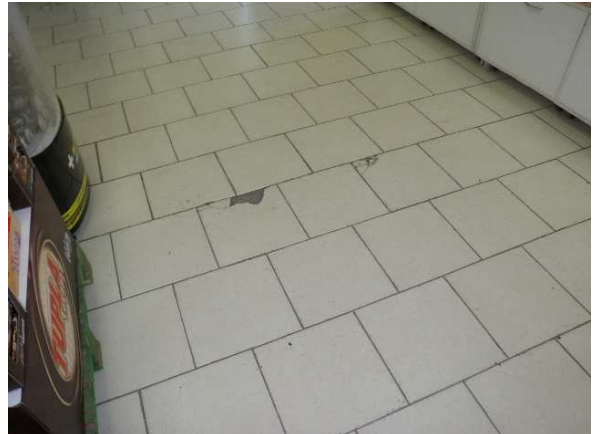
Videovuokraamon lattiassa rikkonaisia laattoja.
