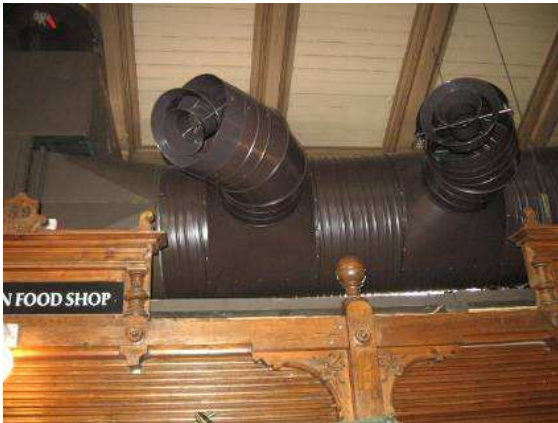
Kauppahallin tuloilmakoneen tuloilmaventtiilit
