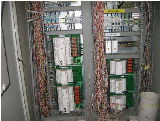
Lämmönjakohuoneessa oleva alakeskus
