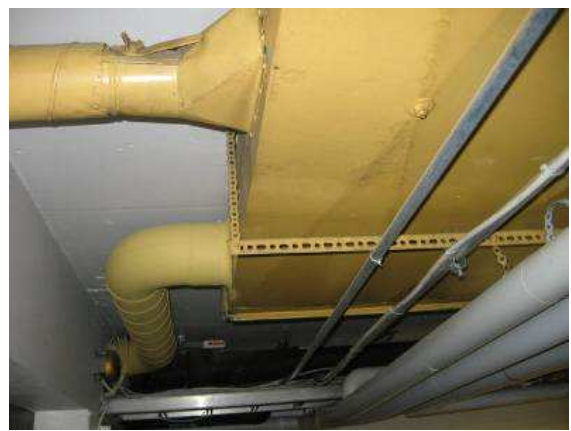
Ilmanvaihtokanavia kauppahallin pohjakerroksessa
