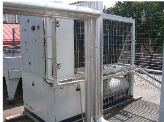
Laajennusosan tuloilmakoneita palveleva vedenjäähdytin
