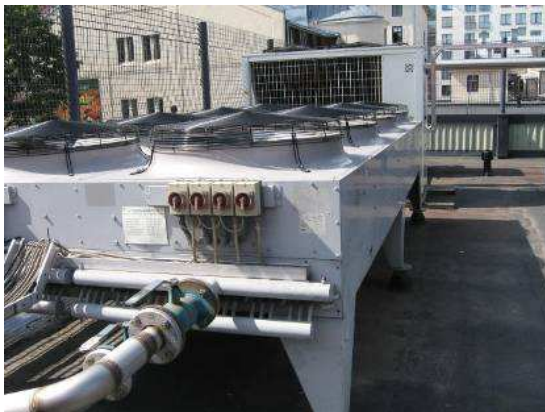
Kylmähuoneiden vedenjäähdyttimen lauhdutin vesikatolla
