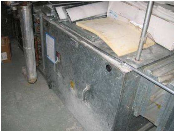
Kauppahallin pohjakerroksessa oleva tuloilmakone
