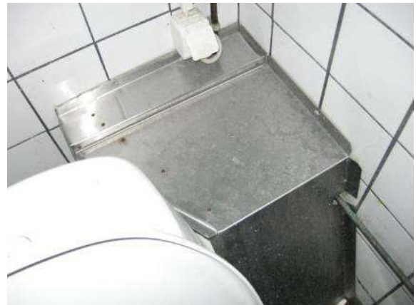
ErillISRakennuksen yhden wc-tilan pumppu
