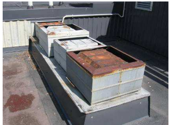
Kauppahallin vesikatolla olevia poistoilmamureita
