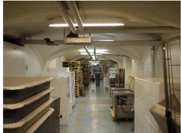
Kellarin valaistusta. T8- loisteputki.
