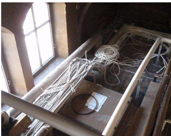
Kaapelihyllyä kauppahallin puolella.
