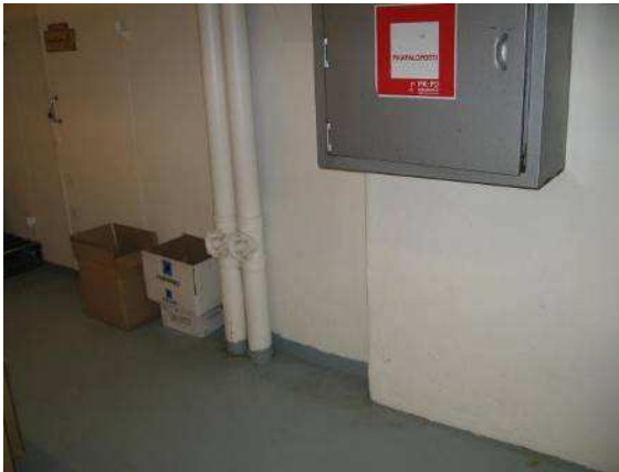
Kauppahallirakennuksen pohja-kerroksessa muovisia pystyviemäreitä
