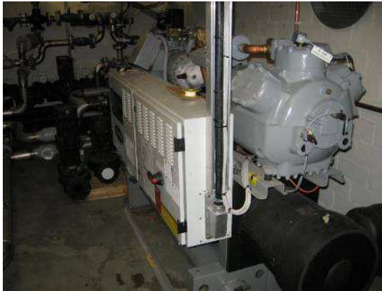
Kauppahallin kylmähuoneiden yksi kompressoriyksikkö
