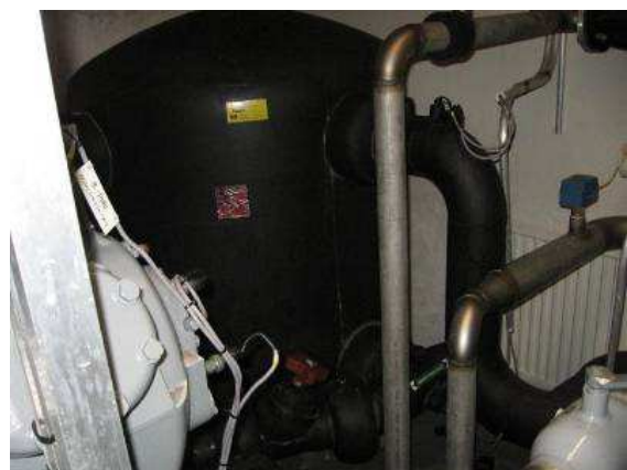
Jäähdytysverkoston lataussäiliö ja solukumi lämpöeristyksiä
