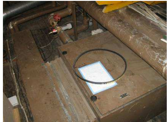
Kauppahallin yhden tuulikaapin kiertoilmalämmitin
