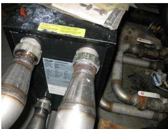
Kylmäkoneikon lämmönvaihdin ja ruostumattomia teräsputkia
