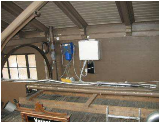
Jätevesiviemäriin syöttävä liuotinaine, sininen asti
