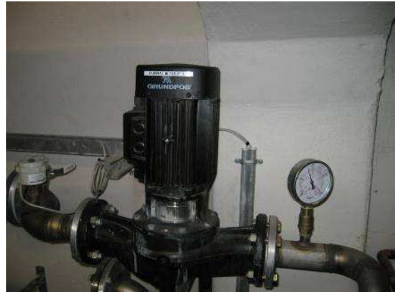
Kylmäkoneiden yksi lauhdutus-pumppu
